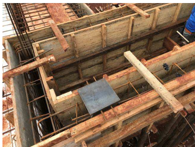
Figura 15C: Formas e armaduras das vigas e lajes da cobertura - junta de dilatação.
