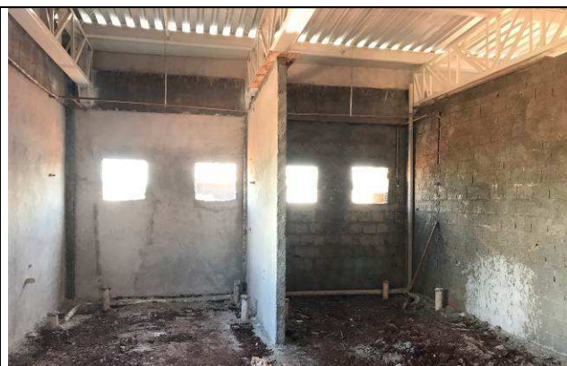
Figura 45C: Revestimento argamassado das paredes internas - Arquivo.
