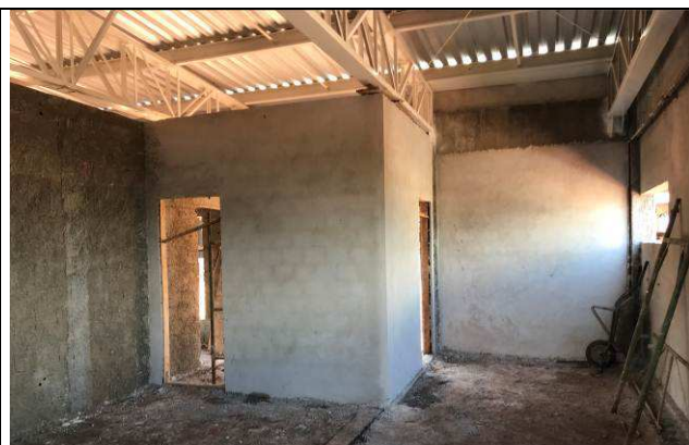
Figura 46C: Revestimento argamassado das paredes internas - Arquivo.
