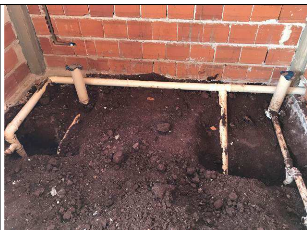
Figura 65C: Pontos de esgoto - Arquivo.
