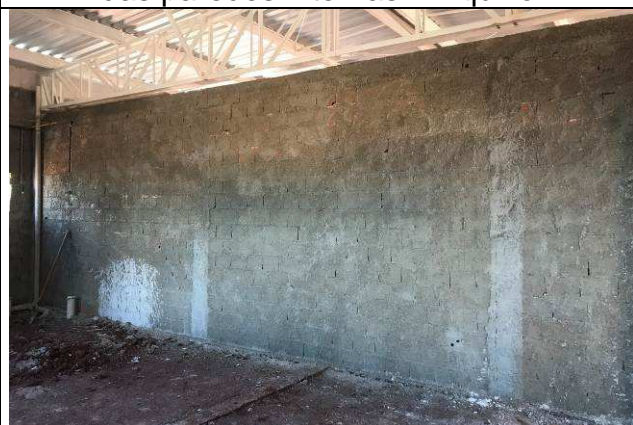
Figura 47C: Revestimento argamassado das paredes internas - Arquivo.
