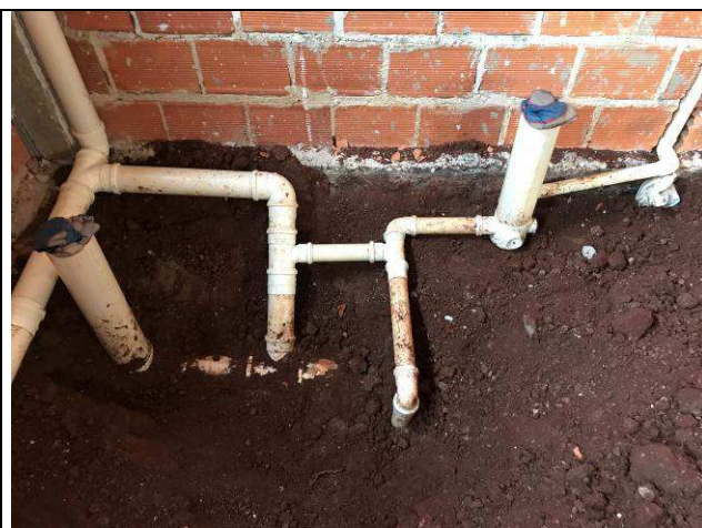
Figura 66C: Pontos de esgoto - Arquivo.
