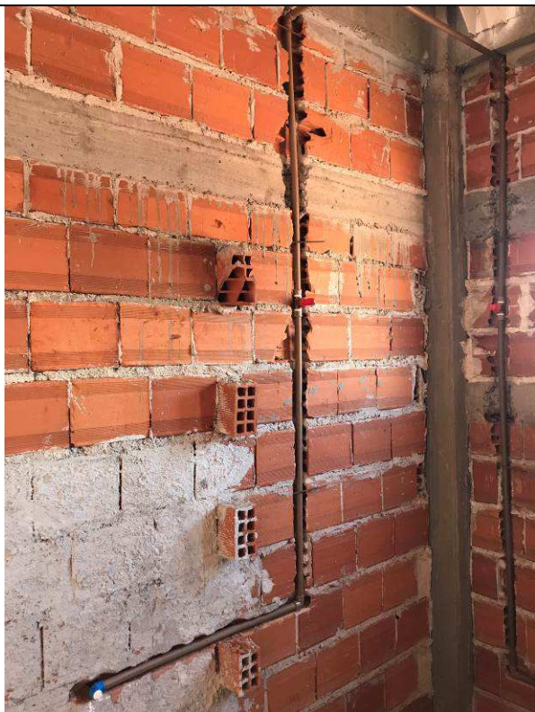
Figura 67C: Pontos de água fria - Arquivo.
