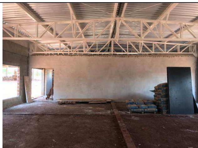
Figura 49C: Revestimento argamassado das paredes internas - Arquivo.
