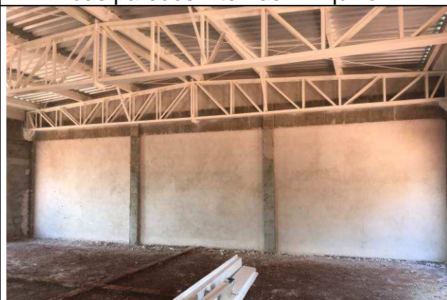
Figura 48C: Revestimento argamassado das paredes internas - Arquivo.
