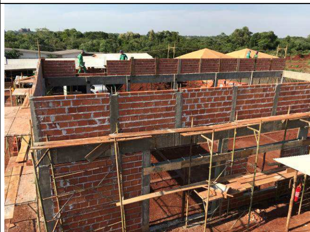
Figura 52C: Pilaretes da platibanda do arquivo.
