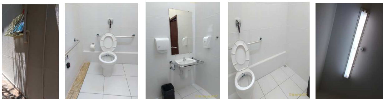
Figura 18: Banheiro adaptado: Instalações, louças, metais, iluminação.
