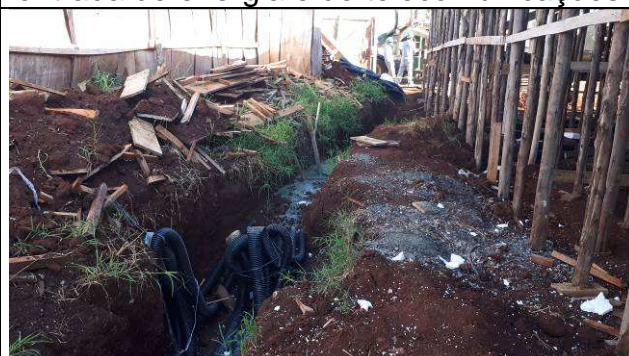
Figura 04E: Eletrodutos dos ramais de entrada de energia e de telecomunicações.
