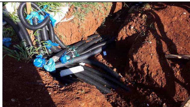
Figura 05E: Eletrodutos dos ramais de entrada de energia e de telecomunicações.
