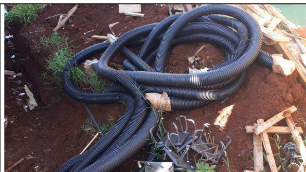
Figura 02E: Eletrodutos dos ramais de entrada de energia e de telecomunicações.
