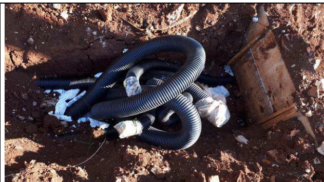
Figura 06E: Eletrodutos dos ramais de entrada de energia e de telecomunicações.
