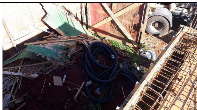
Figura 01E: Eletrodutos dos ramais de entrada de energia e de telecomunicações.
