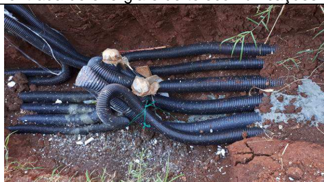
Figura 03E: Eletrodutos dos ramais de entrada de energia e de telecomunicações.
