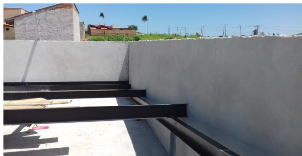
Figura 27: Rebôco interno de platibanda do prédio do arquivo
