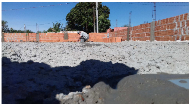
Figura 7: vista geral sobre a laje - serviço de levantamento da alvenaria da platibanda
