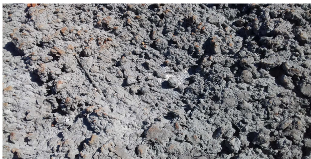
Figura 13: Detalhe da situação da capa da laje. Em alguns pontos se pode observar o EPS, o que significa que não houve capa neste local. A contratada irá refazer a capa com aplicação de uma ponte de aderência e graute com Fck de 40MPa
