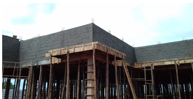
Figura 9: Chapisco na face externa de platibanda - lateral direita (noroeste)
