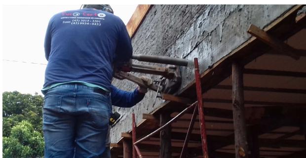
Figura 15: Realização da retirada de amostras do concreto, após a cura de 28 dias. Teste de compressão simples será feito para garantir que não houve desagregação argamassa-agregado durante a concretagem, por suspeita de lançamento após fim de péga
