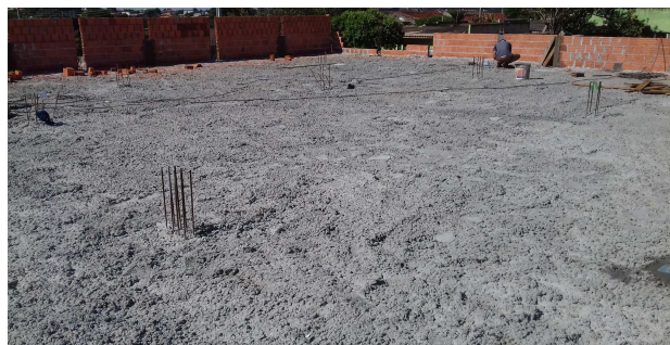
Figura 14: Situação da laje pós-cura. Acabamento muito irregular, sem sarrafeamento. A contratada irá regularizar sua superfície com aplicação de argamassa forte, após o lixamento dos pontos de maior irregularidade
