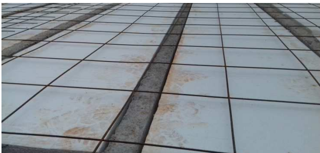
Figura 11: detalhe de vigota, lajotas de EPS e armadura de distribuição em laje pré-moldada
