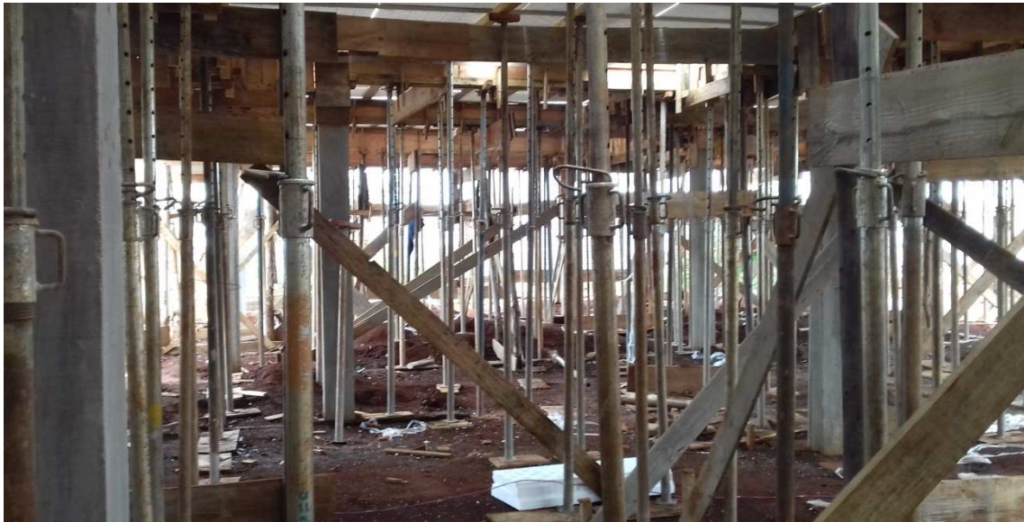
Figura 02: região do interior do fórum, onde já houve o reaterro das baldrames
