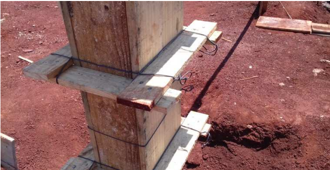
Figura 3C: Detalhe do sistema de gravatas de travamento da emenda das barras (sobreposição ou solda) das fôrmas dos pilares
