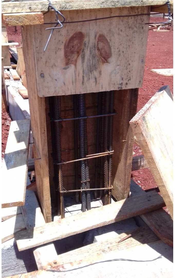
Figura 4C: Detalhe da janela de limpeza e verificação dos arranques dos pilares. Facilita a remoção de caliças de obra no pé do pilar e favorece à fiscalização a verificação da emenda das barras (sobreposição ou solda)
