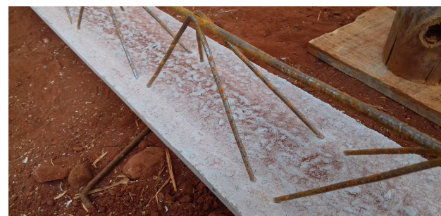
Figura 21: Laje treliçada 8cm fornecida para a maioria dos panos de lajes da obra
