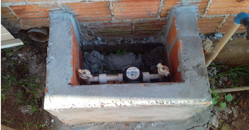
Figura 1: caixa de proteção do hidrômetro
