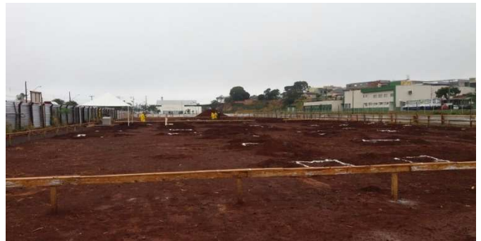
Figura 2: Marcação da geometria dos blocos no terreno, para facilitar a abertura das valas
