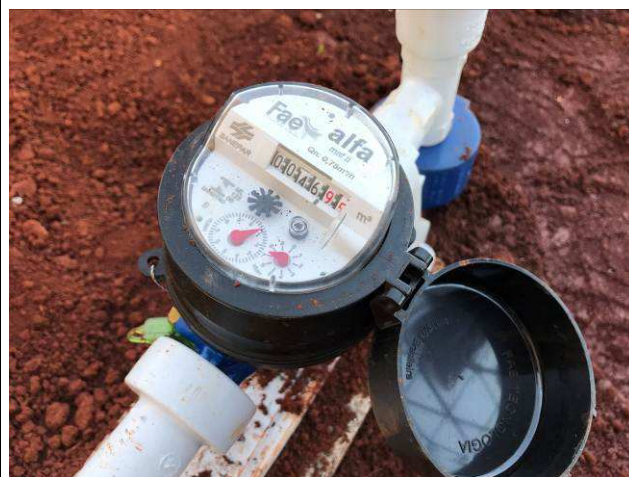
Figura 02C: Ligeação de água - cavalete de entrada.
