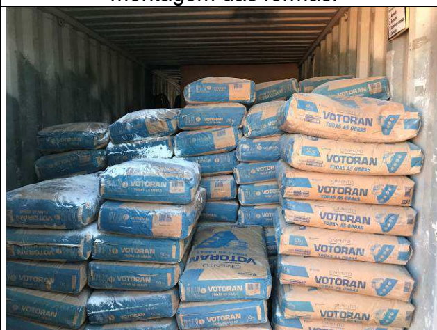
Figura 12C: Barracão de obra - depósito - contêiner para materiais miúdos e cimento.
