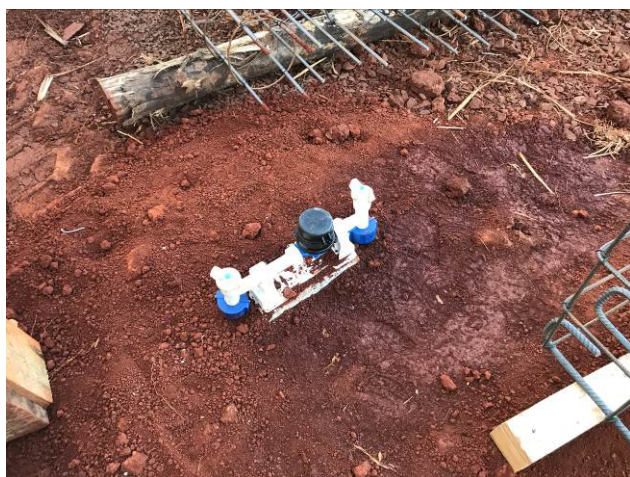
Figura 01C: Ligeação de água - cavalete de entrada.
