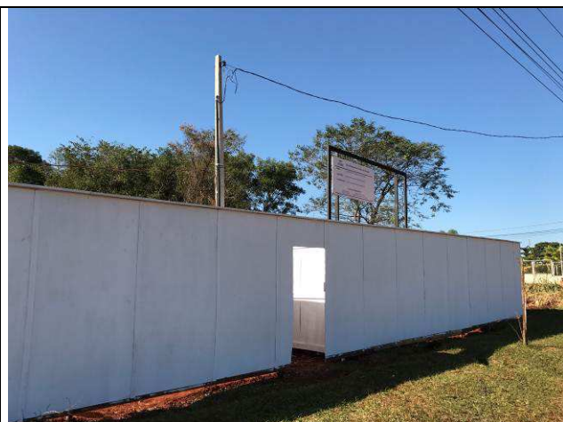
Figura 03E: Entrada de serviço provisória de energia elétrica.
