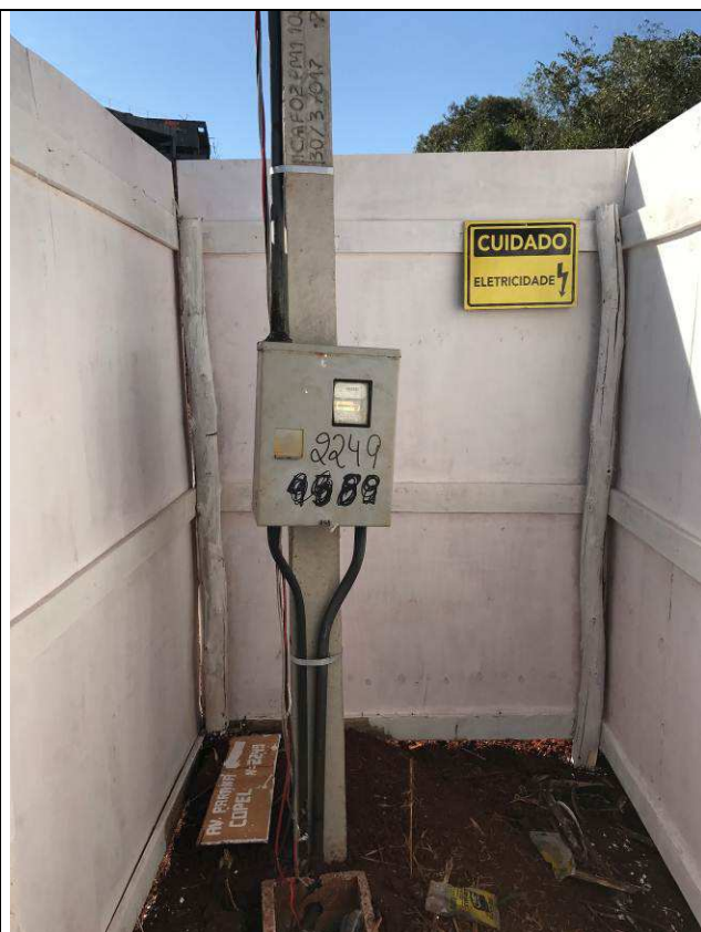
Figura 01E: Entrada de serviço provisória de energia elétrica.
