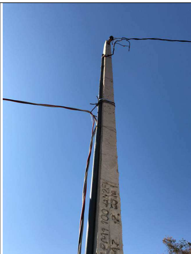
Figura 02E: Entrada de serviço provisória de energia elétrica.
