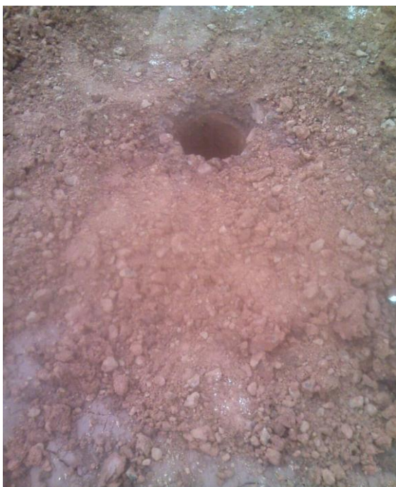
Figura 28: Um dos furos iniciais realizados na tentativa de perfurar estaca de 8m de profundidade. Sem sucesso, a broca somente conseguiu alcançar 2,50m e atingiu rocha impenetrável
