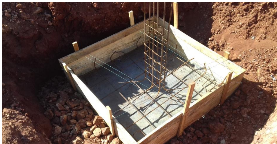
Figura 16: Execução das fôrmas das sapatas, execução do lastro de concreto magro e instalação das armaduras das sapatas e arranques
