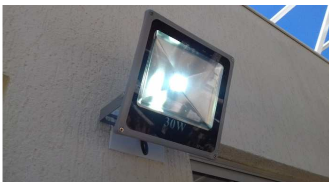
Figura 44: Refletor de LED, 30W, instalado na platibanda da guarita
