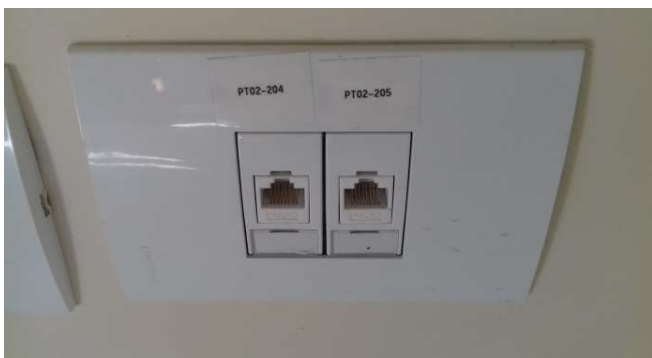
Figura 50: Tomadas lógicas instaladas na guarita
