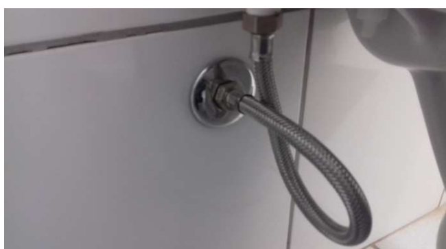
Figura 23: No detalhe da imagem, flexível que alimenta a torneira do lavatório
