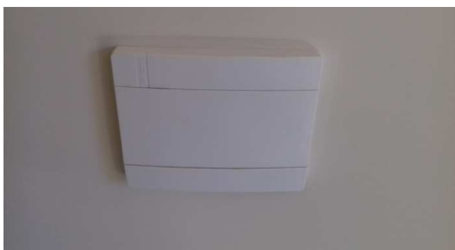
Figura 46: Quadro elétrico instalado na guarita
