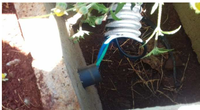
Figura 37: Cabos 4mm 2 alimentando o aparelho de ar condicionado da guarita
