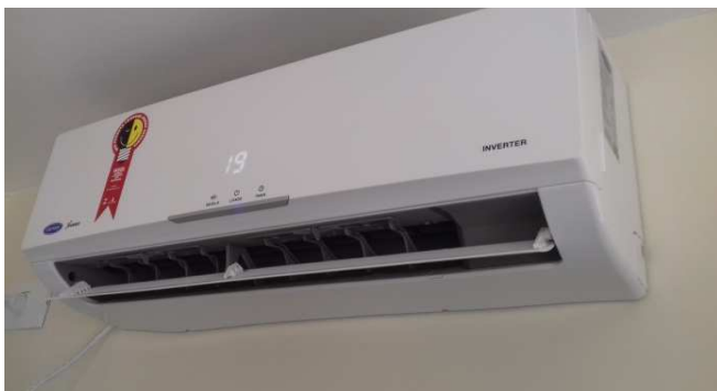
Figura 24: Unidade evaporadora, com capacidade de 9.000 BTU/h, instalada na guarita
