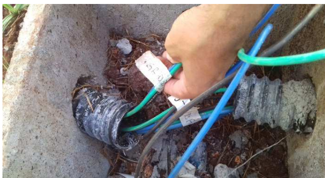
Figura 36: Cabos 2,5mm 2 alimentando o quadro da guarita
