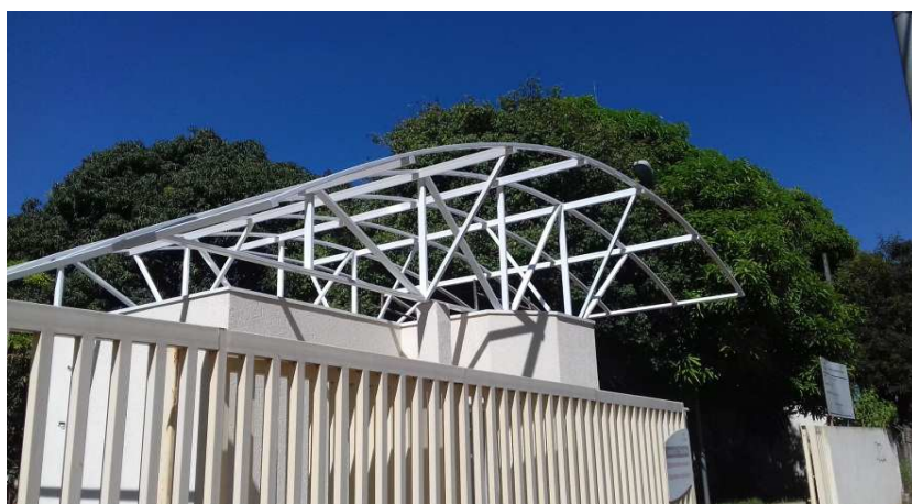
Figura 8: Outra vista da cobertura metálica, que foi executada em perfis retangulares (caixão) nas suas diagonais, montantes e terças.
