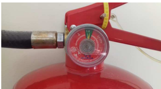
Figura 30: Detalhe da pressão no aparelho
