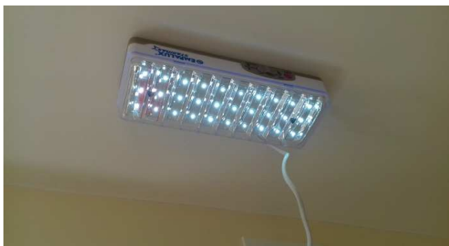
Figura 42: Bloco de iluminação de emergência
