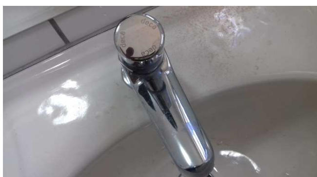
Figura 22: Torneira metálica de pressão com desligamento automático, instalada junto ao lavatório
