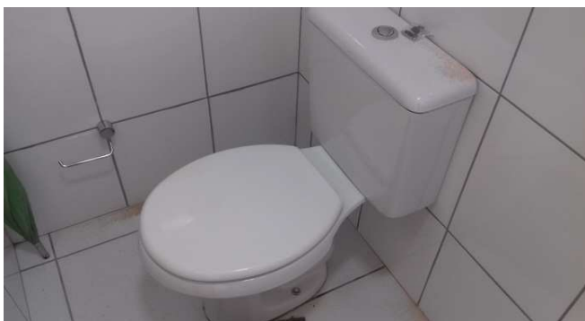
Figura 15: Detalhe do assento instalado junto ao vaso sanitário
