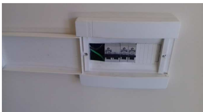
Figura 47: Quadro elétrico instalado na guarita, detalhe dos disjuntores
