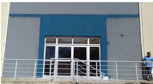
Figura 51: Visão frontal do vão onde foi removida a porta metálica e instalada esquadria de alumínio com fechamento em vidro temperado
