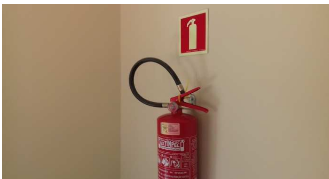
Figura 28: Extintor de PQS, instalado na guarita
