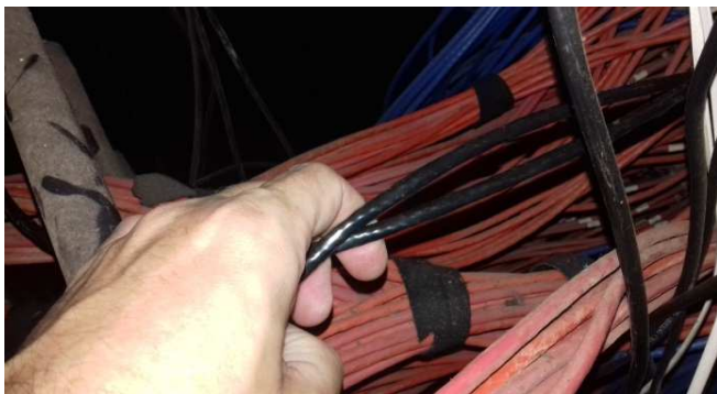
Figura 48: Cabos UTP categoria 6, que ligam o rack do primeiro pavimento às tomadas lógicas da guarita
