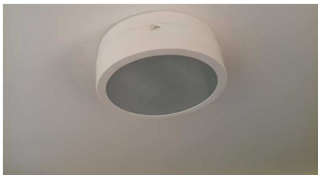
Figura 43: Luminária p/ 2 lâmpadas, instalada no teto da guarita
