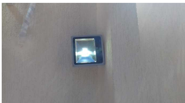
Figura 45: Refletor de LED, 30W, instalado na platibanda da guarita
