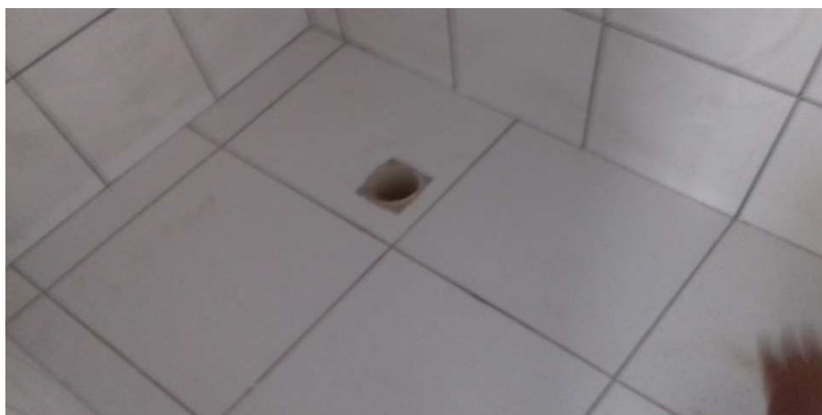
Figura 17 - Piso do banheiro
