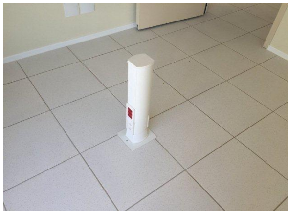
Figura 23 . 26 totens técnicos sala de conciliação - porta equipamentos, tomadas, blocos cegos
