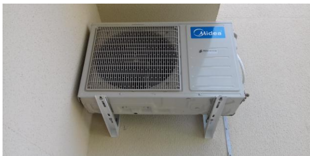
Figura 16.1: Unidade condensadora de 12.000 BTU/h, atendendo à sala técnica
