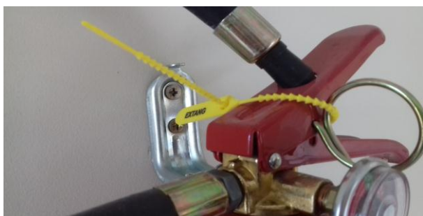
Figura 17.3: Verificação dos lacres dos extintores
