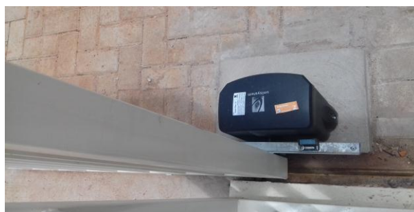
Figura 18.8: Motor automatizador do portão do estacionamento público
