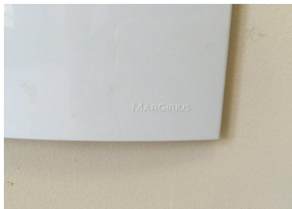
Figura 23 . 22 interruptores, tomadas, espelhos cegos padrão modular marca MarGirius
