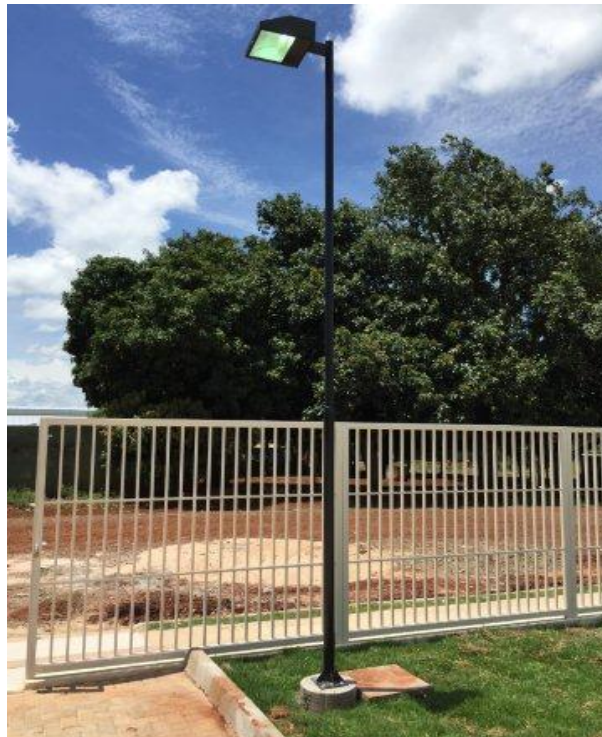
Figura 23 . 46 iluminação externa - luminárias tipo poste de uma pétala, lâmpada VM250W
