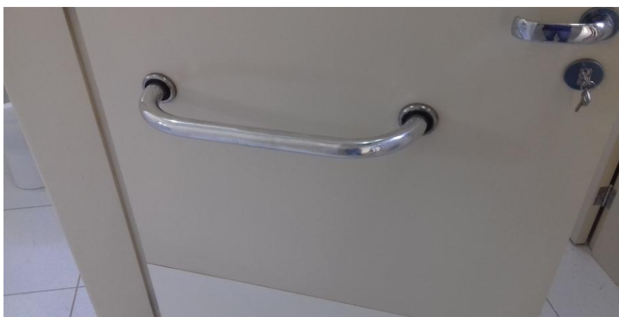
Figura 7.1: Barra de apoio para abertura, instalada em porta do BWC PNE da secretaria
