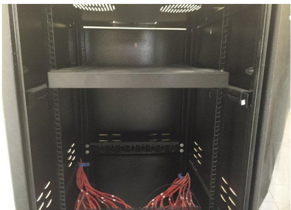
Figura 24 . 15 rack - bandeja, régua tomadas
