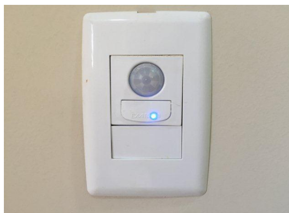
Figura 23 . 24 sensores de presença
