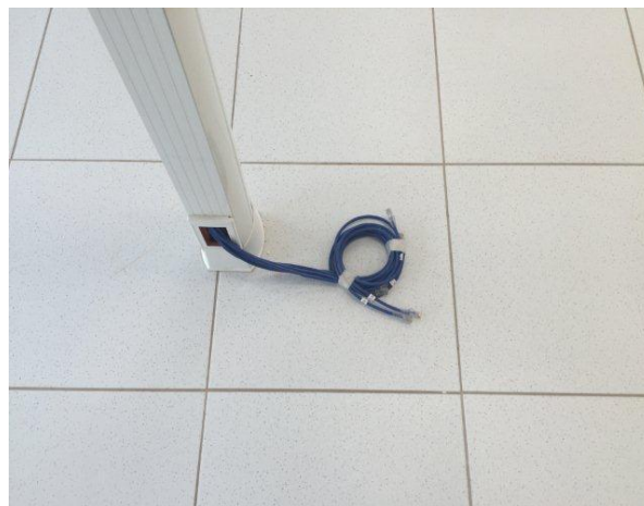
Figura 24 . 20 patch cords de 10m para conexão microcomputadores padrão genérico
