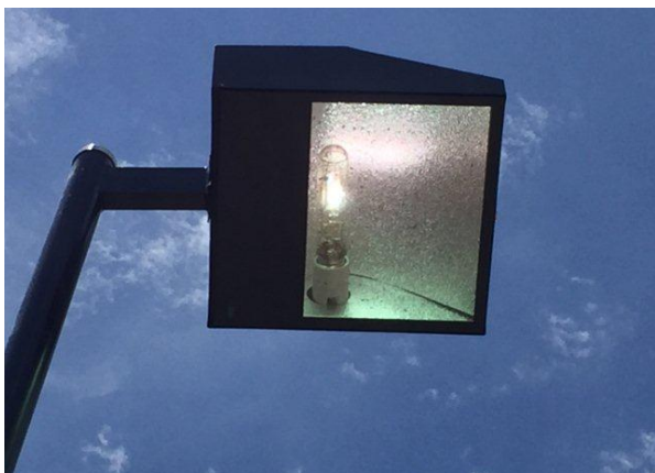
Figura 23 . 43 iluminação externa - luminárias tipo poste de uma pétala, lâmpada VM250W
