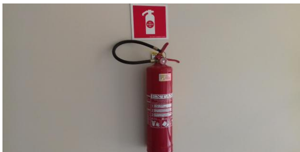
Figura 17.1: Detalhe de extintor instalado na secretaria
