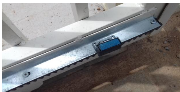
Figura 18.10: Ímã de desligamento automático do portão
