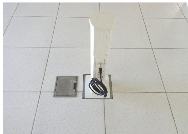
Figura 24 . 12 sonorização sala audiências - plugues e cabos para amplificador P10
