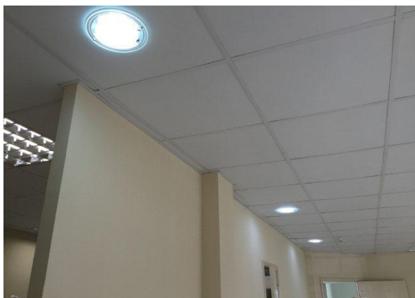
Figura 23 . 37 luminárias redondas embutir, lâmpadas LED
