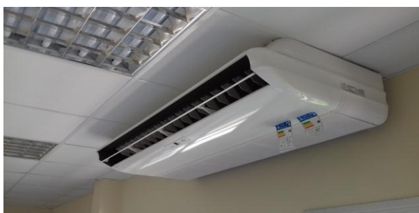
Figura 16.7: Unidade de 42.000 BTU/h, instalada na secretaria
