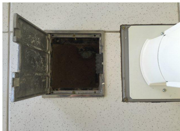
Figura 24 . 6 caixa Dutotec para passagem cabo de vídeo sala
