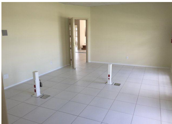
Figura 23 . 25 totens técnicos sala de audiências - porta equipamentos, tomadas, blocos cegos
