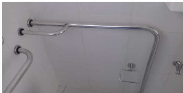
Figura 15.12: Barras de apoio para PNE, instaladas na bacia sanitária do BWC PNE público
