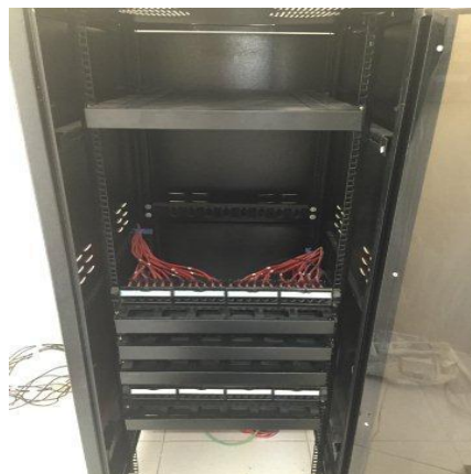
Figura 24 . 14 rack sala técnica
