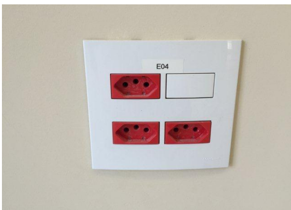
Figura 23 . 19 tomadas elétricas rede estabilizada
