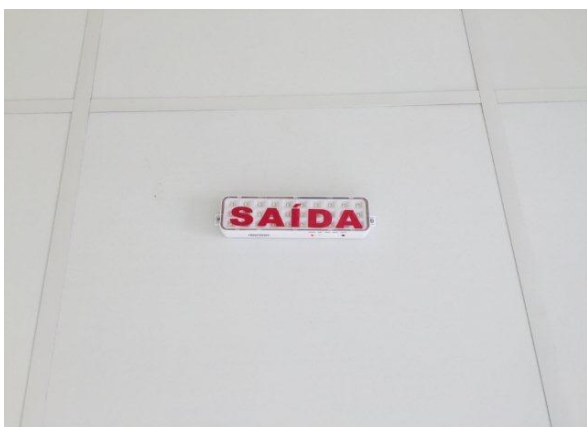
Figura 23 . 33 blocos de iluminação de emergência
