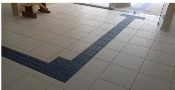
Figura 13.3: Piso podotátil em porcelanato, instalado no interior do imóvel
