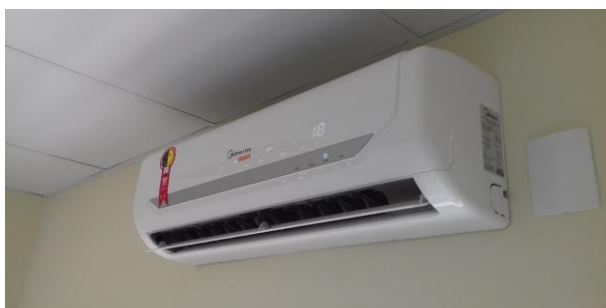
Figura 16.5: Unidade evaporadora de 12.000 BTU/h que atende ao gabinete do juiz auxiliar
