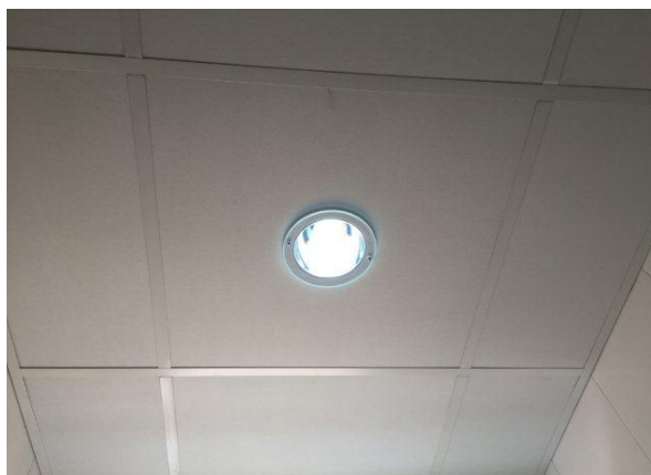
Figura 23 . 38 luminárias redondas embutir, lâmpadas LED
