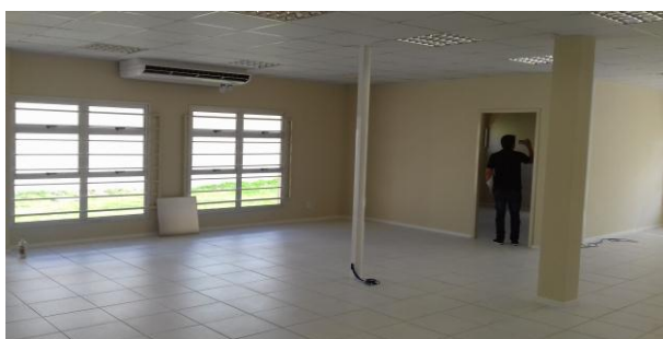
Figura 7.5: Janelas 1,80m x 1,80m com seus gradis instalados
