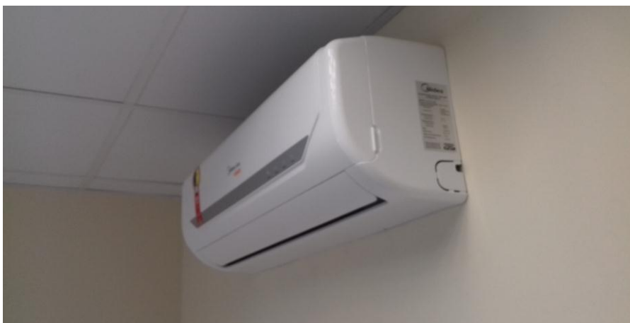
Figura 28.1: Aparelho de ar condicionado de 12.000 BTU/h, instalado na
