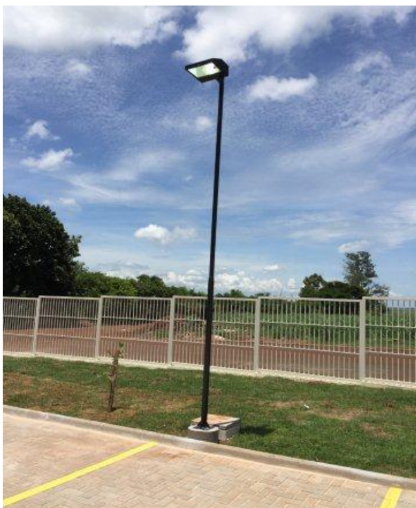
Figura 23 . 45 iluminação externa - luminárias tipo poste de uma pétala, lâmpada VM250W
