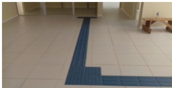
Figura 13.2: Piso podotátil em porcelanato, instalado no interior do imóvel
