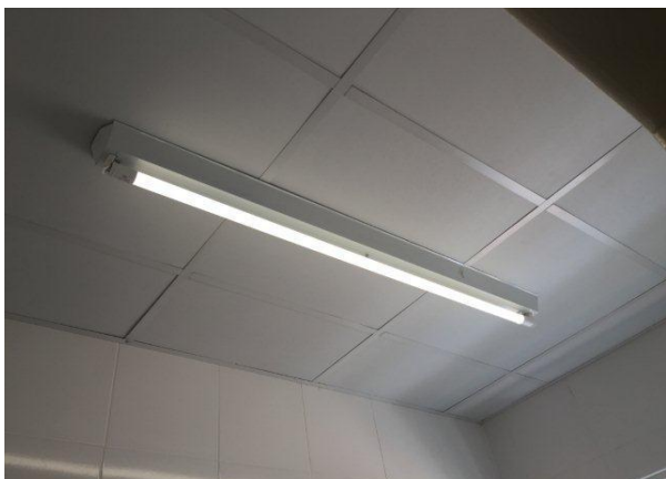
Figura 23 . 39 luminárias tipo comercial 125mm
