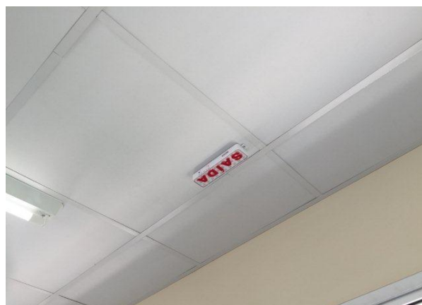
Figura 23 . 32 blocos de iluminação de emergência
