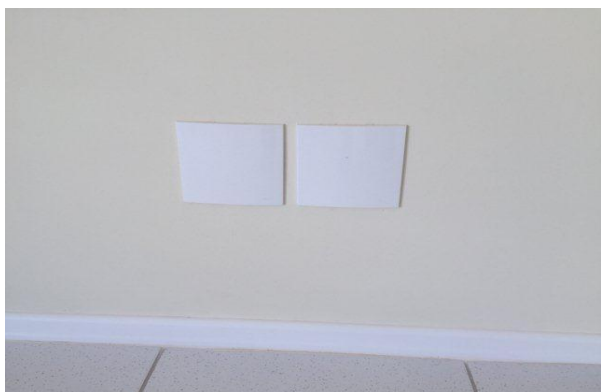
Figura 24 . 1 espelhos cegos 4x4 caixas de passagem
