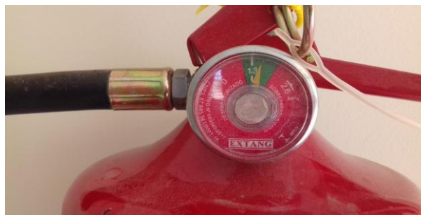
Figura 17.2: Verificação da carga de extintor
