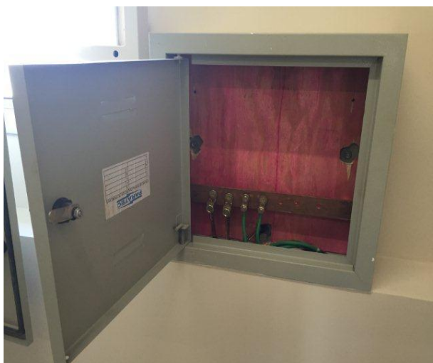
Figura 25 . 3 barramento de equipotencialização - quadro BEP
