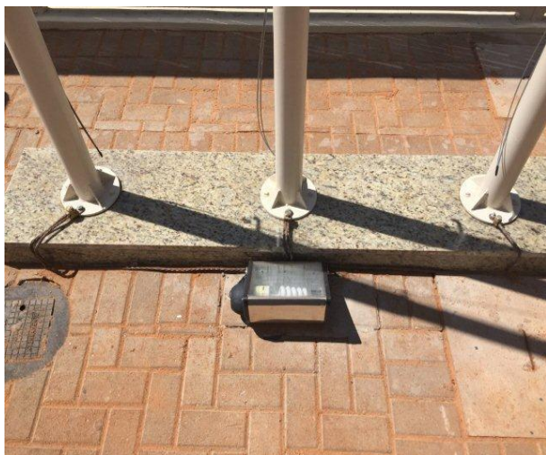
Figura 25 . 1 equipotencialização aterramento das partes metálicas
