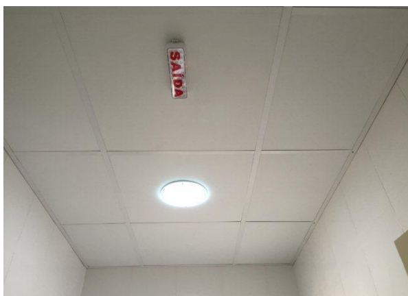
Figura 23 . 31 blocos de iluminação de emergência
