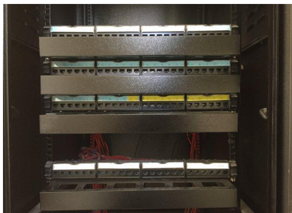
Figura 24 . 16 rack - patch panels e organizadores
