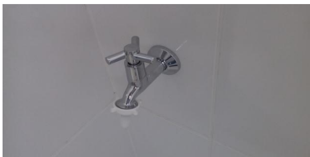
Figura 15.9: Torneira de pressão de uso geral, instalada no BWC público
