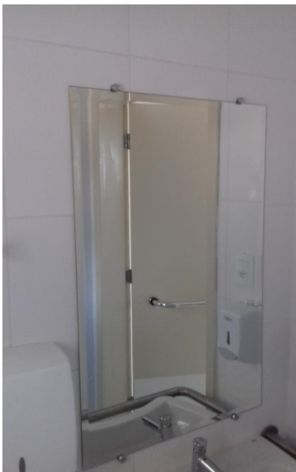
Figura 15.7: Espelho instalado no BWC da secretaria
