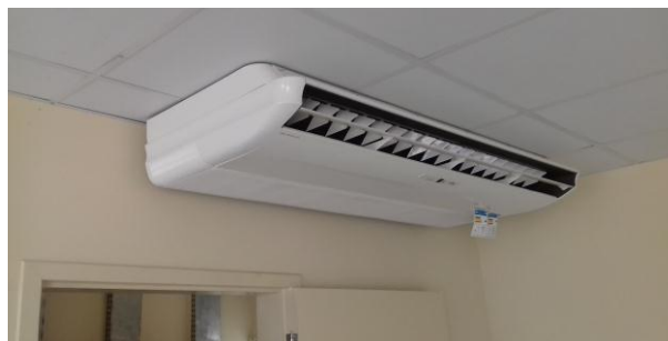
Figura 16.4: Unidade evaporadora de 42.000 BTU/h, que atende ao hall público
