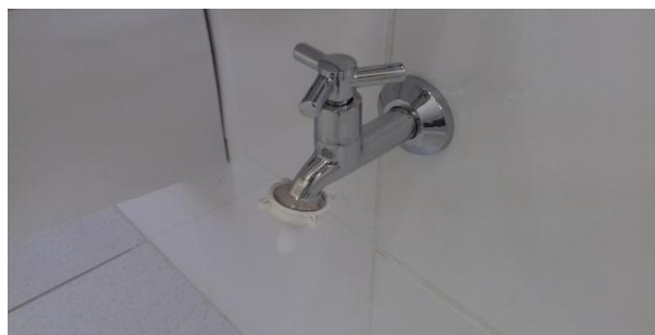
Figura 15.10: Torneira de pressão de uso geral, instalada no BWC da secretaria
