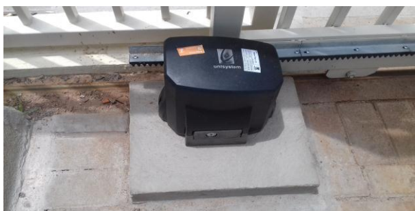
Figura 18.7: Motor automatizador do portão privativo
