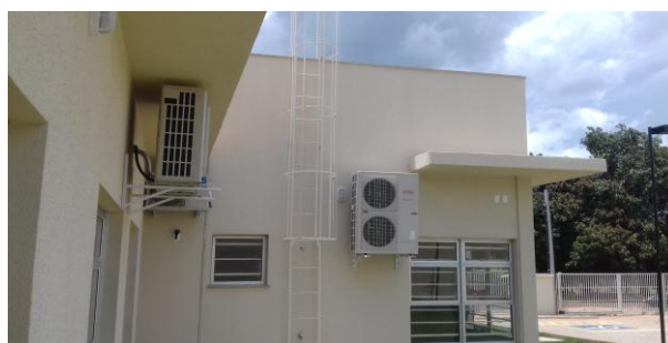
Figura 16.8: Detalhe de 3 equipamentos condensadores instalados na face leste
