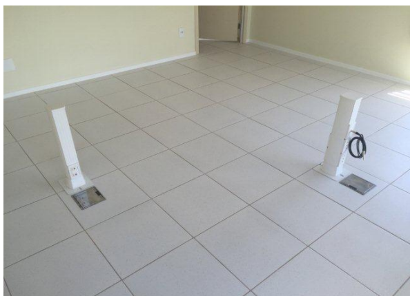
Figura 23 . 27 totens técnicos sala de audiências - porta equipamentos, tomadas, blocos cegos
