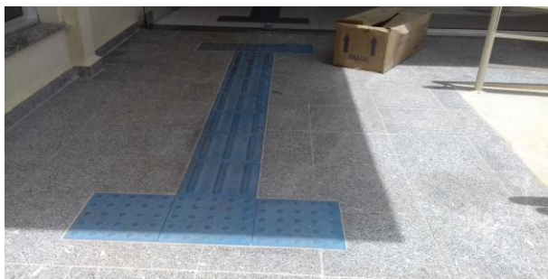
Figura 13.1: Piso podotátil em porcelanato, instalado no hall de entrada
