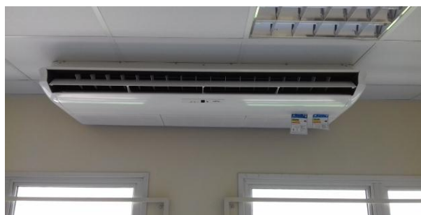
Figura 16.6: Unidade evaporadora de 30.000 BTU/h, atendendo à sala de audiência principal
