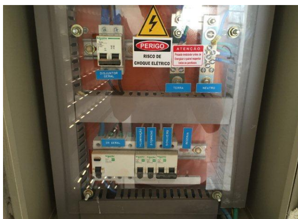
Figura 23 . 42 Quadro elétrico Arquivo
