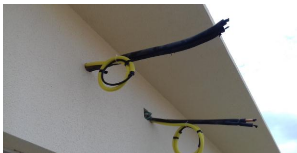
Figuras 16.3 e 16.4: Detalhe de rede frigorífica com capacidade de 30.000 BTU/h (acima) e redes com capacidade de 42.000 BTU/h (abaixo)
