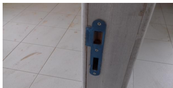
Figuras 7.4, 7.5 e 7.6: Na sequência, detalhes das maçanetas, liguetas e espelhos das fechaduras instaladas
