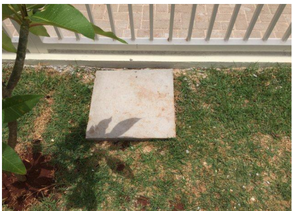
Figura 23 . 9 infraestrutura externa - caixas 30x30
