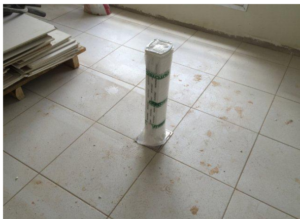
Figura 23 . 38 postes, totens e acessórios - totem Dutotec sala de conciliação
