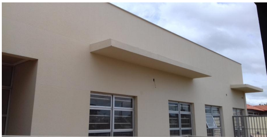
Figura 19.2: Aplicação de textura acrílica na cor doric white, em paredes da fachada principal
