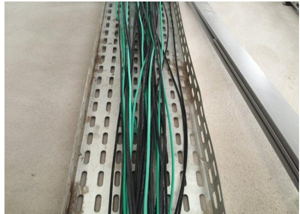
Figura 23 . 20 cabreamento elétrico - cabos 2,5mm 2 e 4,0mm 2 isolamento 750V (ar-condicionado)
