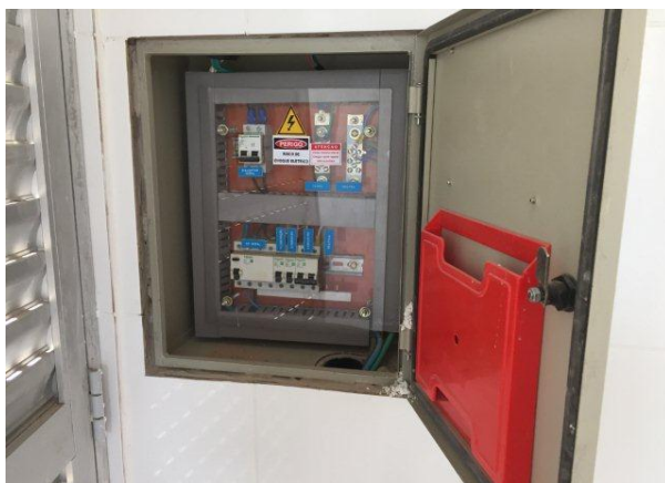
Figura 23 . 41 Quadro elétrico Arquivo
