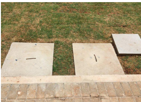
Figura 23 . 13 infraestrutura externa - caixas 50x50 e caixas 30x30
