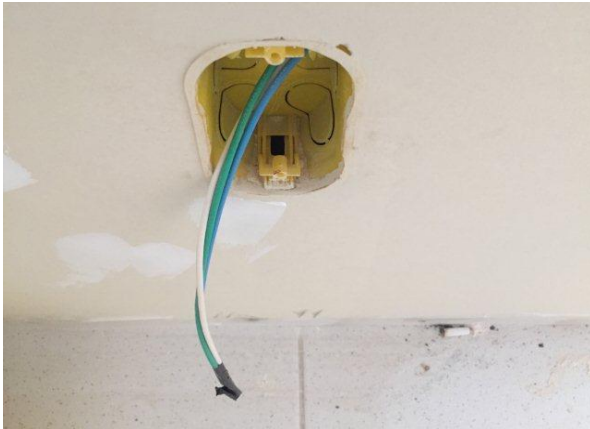
Figura 23 . 17 cabreamento elétrico - cabos 2,5mm 2 e 4,0mm 2 isolamento 750V (rede comum)
