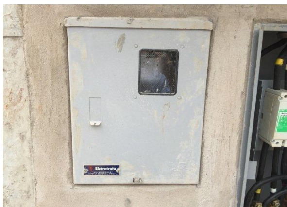
Figura 23 . 3 entrada de energia elétrica - módulo caixa CN - PAB
