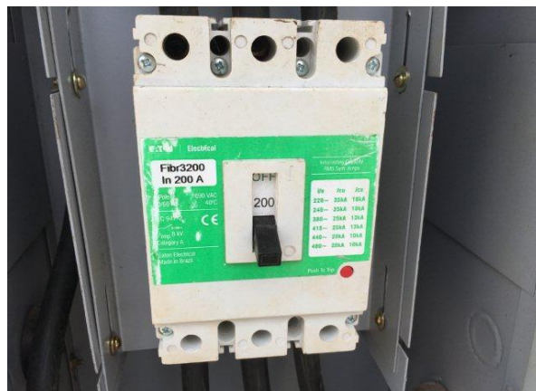
Figura 23 . 2 entrada de energia elétrica - módulo barramento, disjuntor 200A geral
