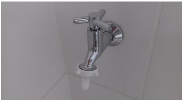
Figuras 15.28, 15.29 e 15.30: Torneiras metálicas 3/4" de uso comum. Na primeira imagem, torneira instala na área de serviço do arquivo. Na segunda, torneira instalada no reservatório de reúso e, na terceira, torneira instalada em sanitário público
