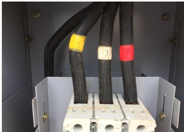
Figura 23 . 4 entrada de energia - cabo #95mm 2 ramal do poste
