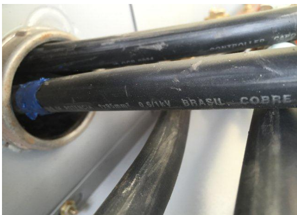
Figura 23 . 5 entrada de energia - cabo #95mm 2 ramal do poste
