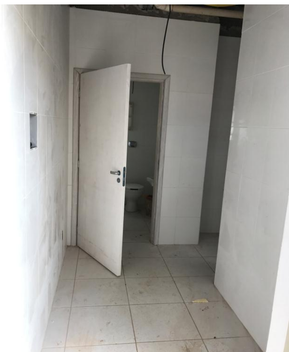
Figura 7.12: Porta PNE, de madeira, tamanho 90x210, instalada no sanitário PNE público.
