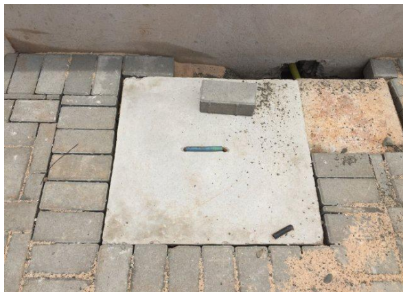
Figura 23 . 12 infraestrutura externa - caixas 50x50
