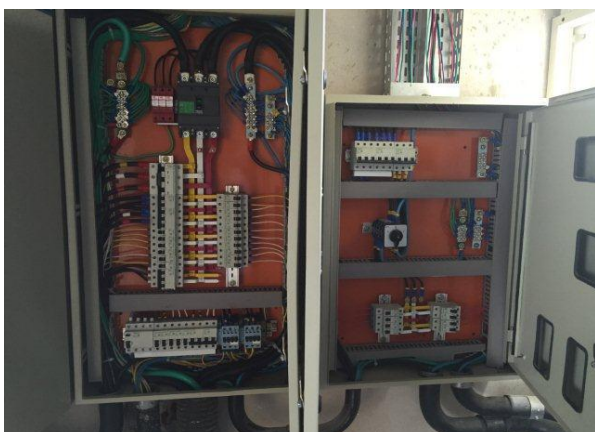
Figura 23 . 39 Quadros elétricos QDG, QDE
