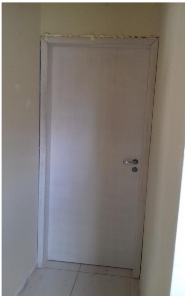
Figura 7.14: Porta 70x210, de madeira, instalada no sanitário público feminino
