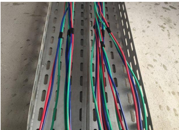
Figura 23 . 21 cabreamento elétrico - cabos 2,5mm 2 e 4,0mm 2 isolamento 750V (rede estabilizada)
