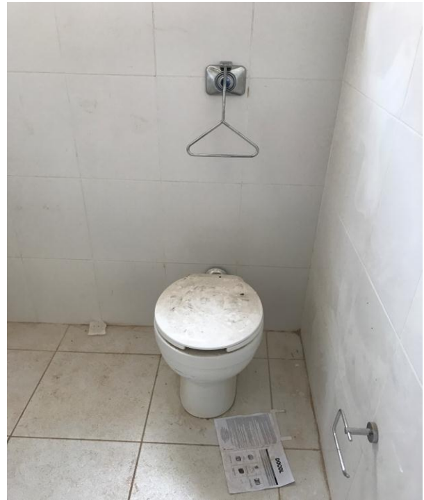
Figura 15.12: Bacia sanitária PNE, instalada no sanitário PNE que atende aos servidores. Também no detalhe, acionador e suporte metálico de papel higiênico
