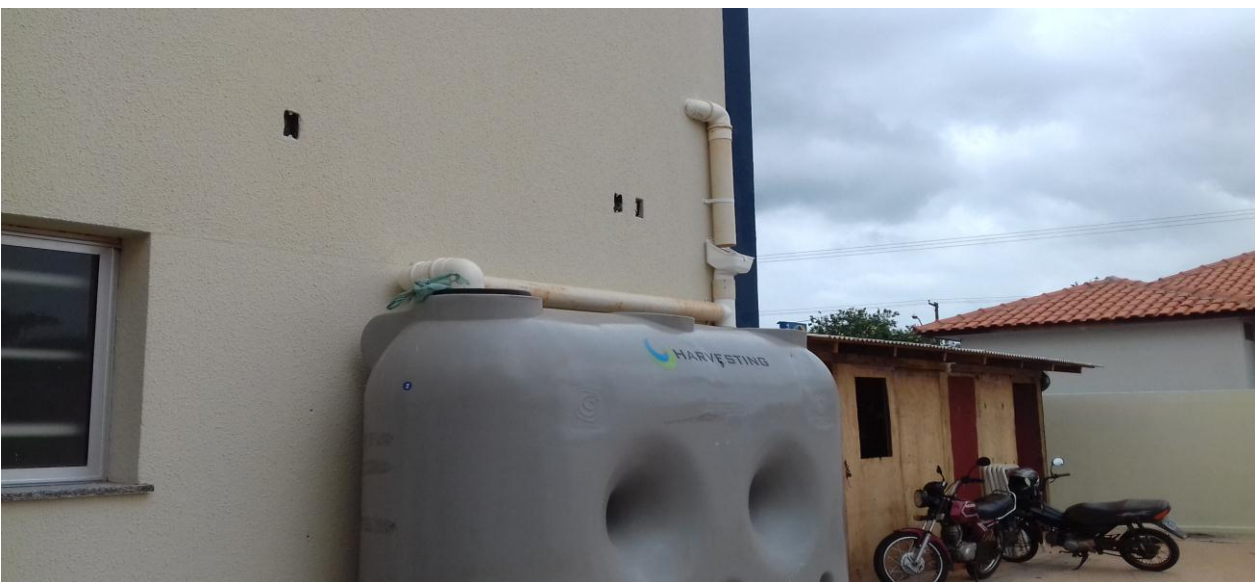
Figuras 15.7, 15.8 e 15.9: Detalhe do sistema de aproveitamento da água da chuva, já com todas as ligações (abastecimento e by-pass) finalizadas
