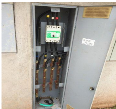
Figura 23 . 1 entrada de energia elétrica - módulo barramento
