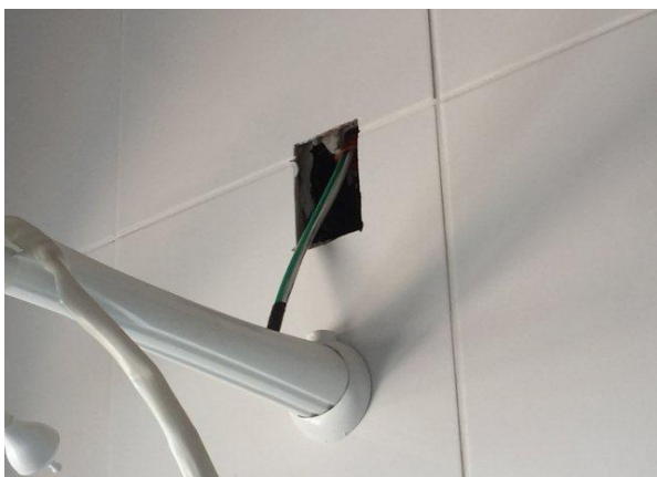
Figura 23 . 23 cabearno elétrico - cabos 6,0mm 2 isolamento 750V (rede comum)
