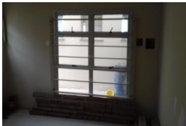
Figura 7.23: Grades de proteção de janela J1, localizada na sala de assistentes
