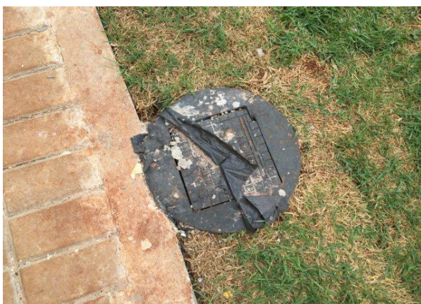
Figura 25 . 1 aterramento - caixa de inspeção, tampa em ferro fundido
