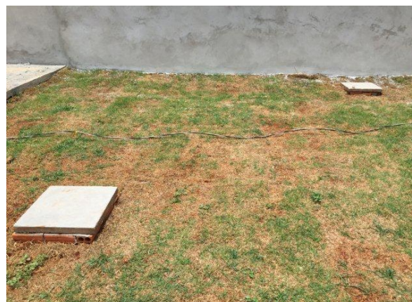
Figura 23 . 10 infraestrutura externa - caixas 30x30
