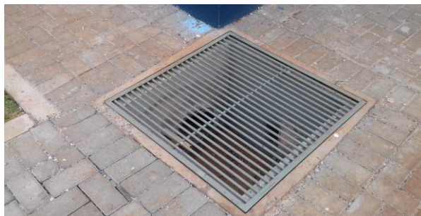
Figuras 15.4, 15.5 e 15.6: Caixas de passagem pluviais com suas tampas instaladas. Também encontram-se com seus interiores rebocados
