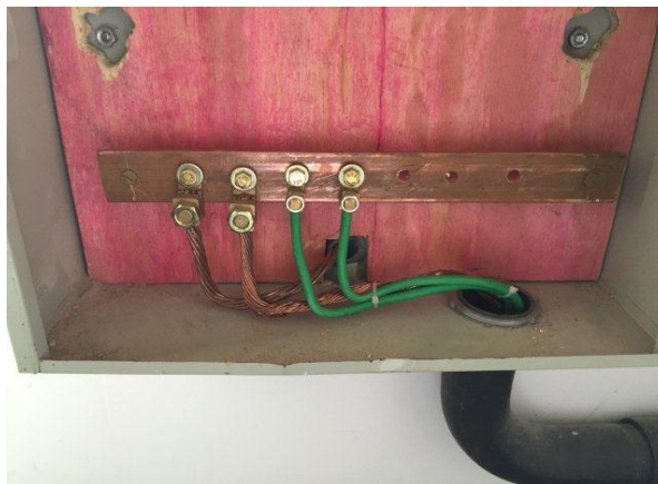
Figura 25 . 6 equipotencialização - quadro BEP, eletroduto, aterramento QDG, DG telecom, rack, SPDA
