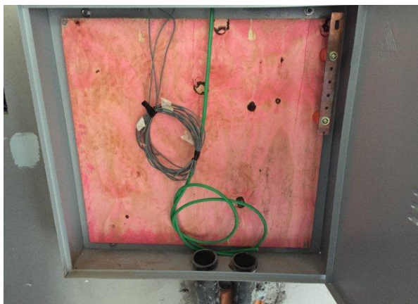
Figura 25 . 7 equipotencialização - aterramento DG telecom
