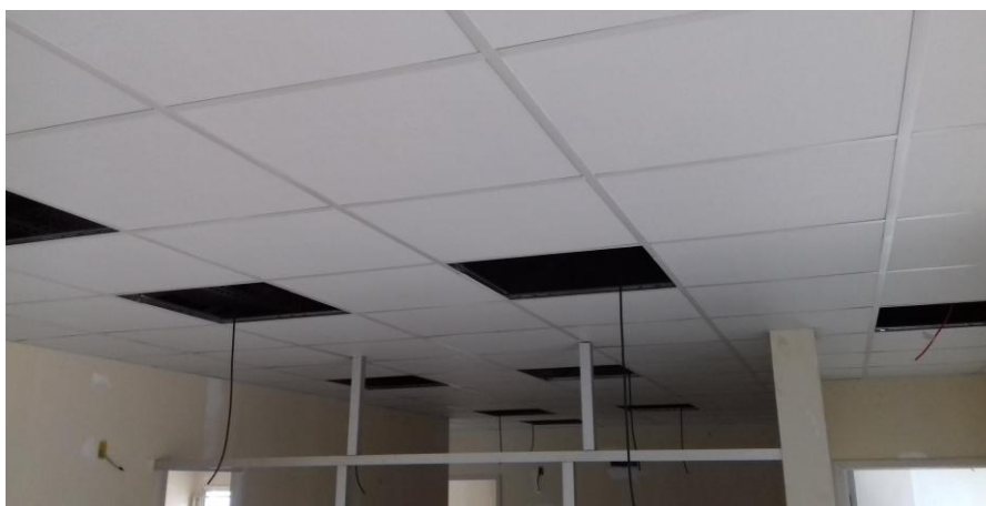
Figura 10.1: Forro em placas modulares de gesso acartonado, tamanho 62,5cm x 62,5cm, no hall público
