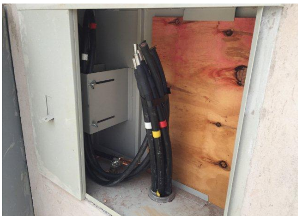
Figura 23 . 7 entrada de energia - cabo #95mm 2 ramal da proteção e medição TRT
