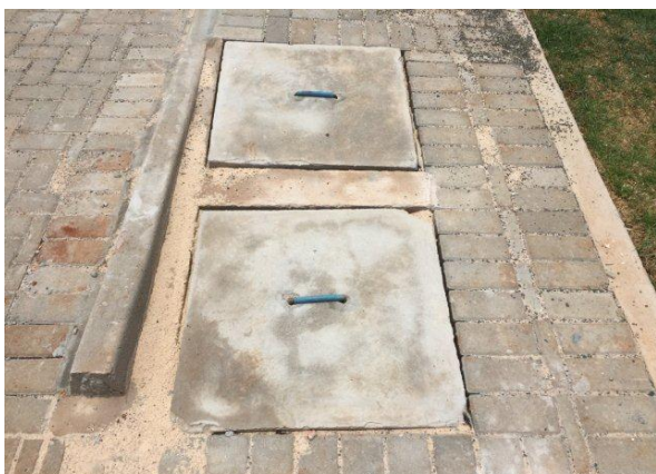
Figura 23 . 11 infraestrutura externa - caixas 50x50
