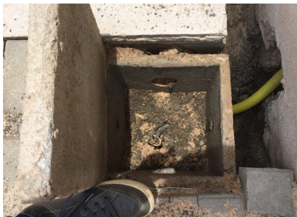
Figura 23 . 8 entrada de energia - aterramento
