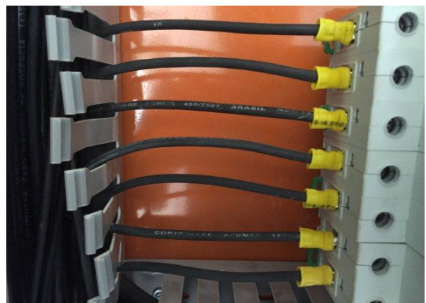
Figura 23 . 22 cabreamento elétrico - cabos 2,5mm 2 e 4,0mm 2 isolamento 750V (ar-condicionado)
