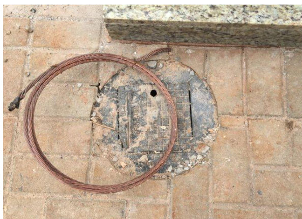
Figura 25 . 2 aterramento - caixa de inspeção, tampa em ferro fundido, aterramento mastros
