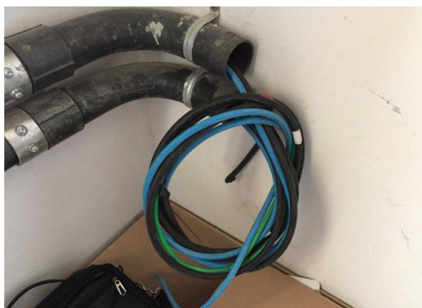
Figura 23 . 40 Ramal alimentador nobreak - Entre QDE e nobreak
