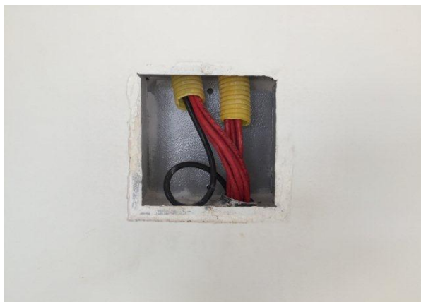
Figura 24 . 2 caixas para passagem cabeamento lógico salas de audiências, cabo pp sonorização
