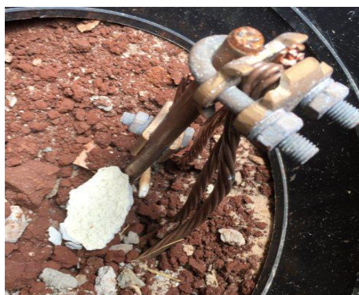
Figura 25 . 4 aterramento - cabo de cobre nu, haste de aterramento BEP
