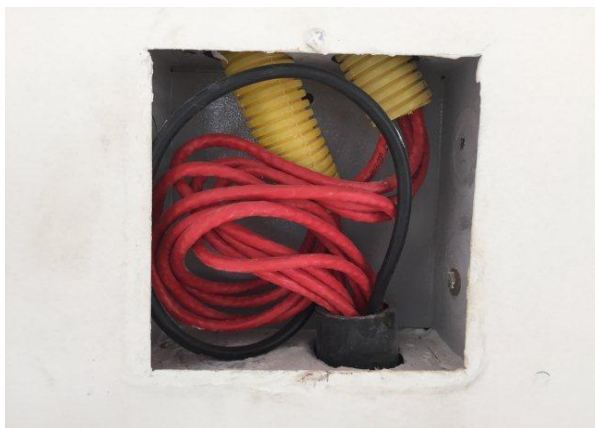
Figura 24 . 1 caixas para passagem cabeamento lógico salas de audiências, cabo pp sonorização
