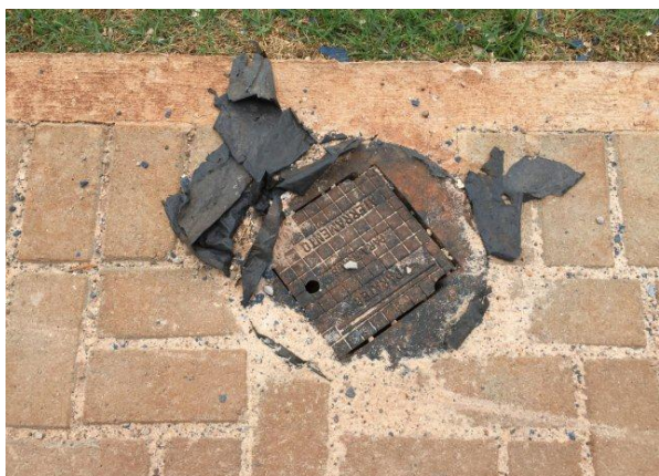
Figura 25 . 3 aterramento - caixa de inspeção, tampa em ferro fundido
