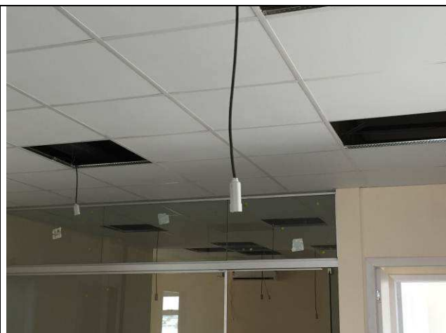
Figura 19E: cabos PP iluminação interna
