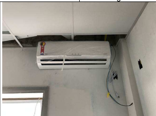
Figura 80C: Evaporadora - 12.000 BTU's - sala site.
