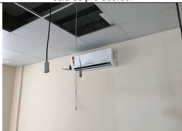
Figura 78C: Evaporadora - 12.000 BTU's - balcão de atendimento.
