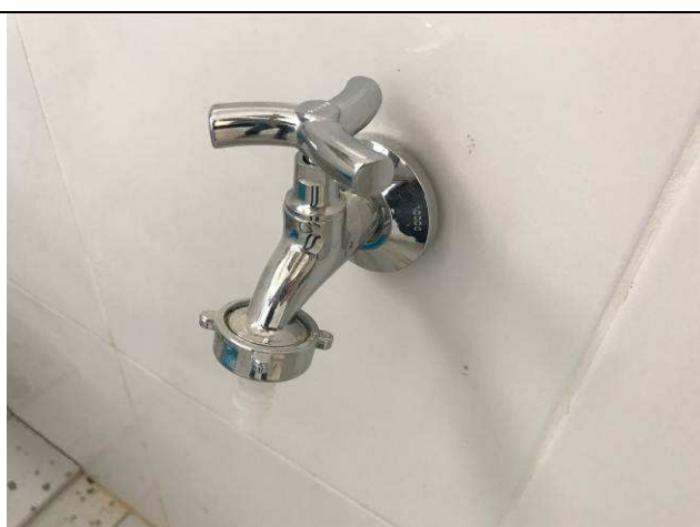
Figura 68C: Torneira de pressão para uso geral - limpeza banheiros.
