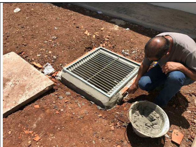
Figura 55C: Caixas pluviais com grelha.
