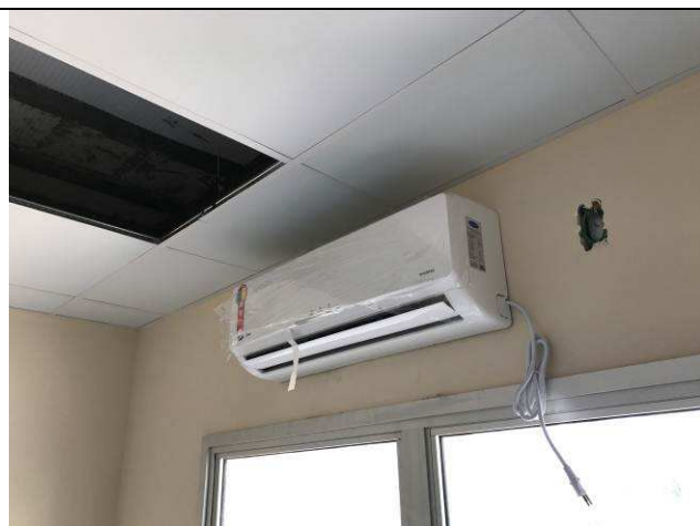
Figura 76C: Evaporadora - 12.000 BTU's - sala de pré-acordo.
