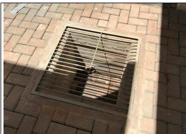
Figura 50C: Caixas pluviais com grelha.
