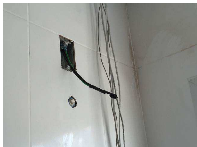
Figura 09E: cabearno elétrico chuveiro
