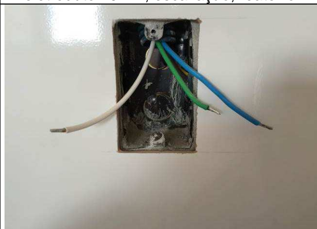
Figura 06E: cabeamento elétrico rede comum
