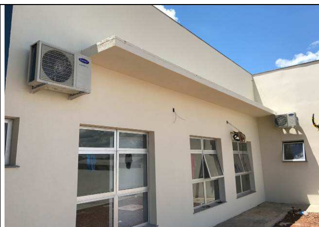
Figura 72C: Condensadoras - sala site e gabinete do juiz auxiliar.
