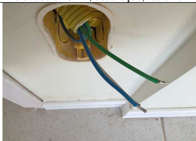
Figura 05E: cabeamento elétrico rede comum
