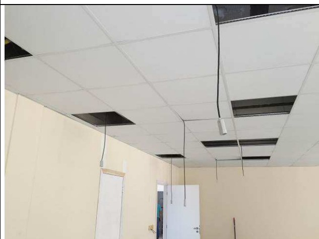
Figura 16E: cabos PP iluminação interna
