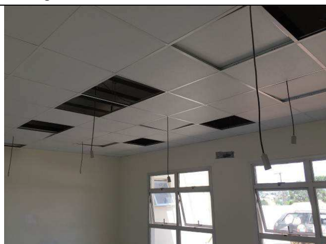
Figura 17E: cabos PP iluminação interna
