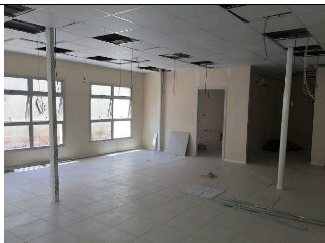
Figura 15E: colunas técnicas Dutotec
