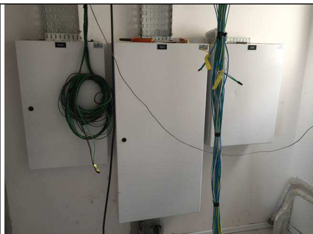
Figura 20E: quadros elétricos sala técnica
