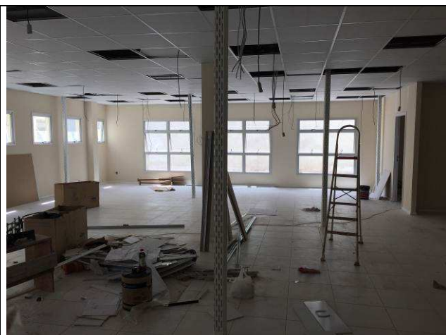
Figura 14E: colunas técnicas Dutotec
