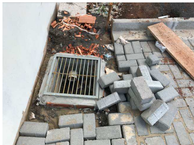
Figura 56C: Caixas pluviais com grelha.
