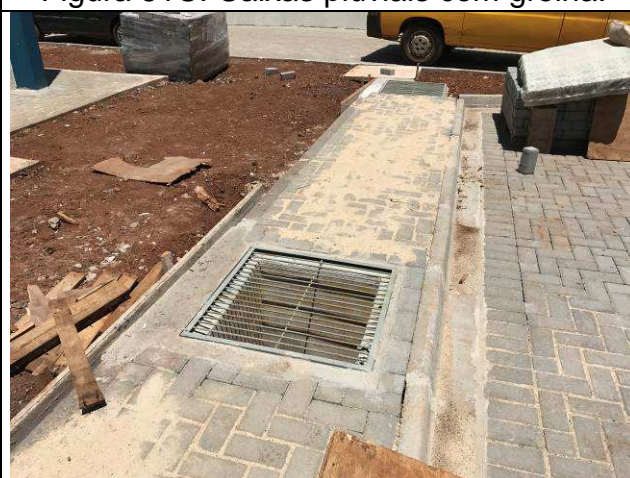
Figura 53C: Caixas pluviais com grelha.
