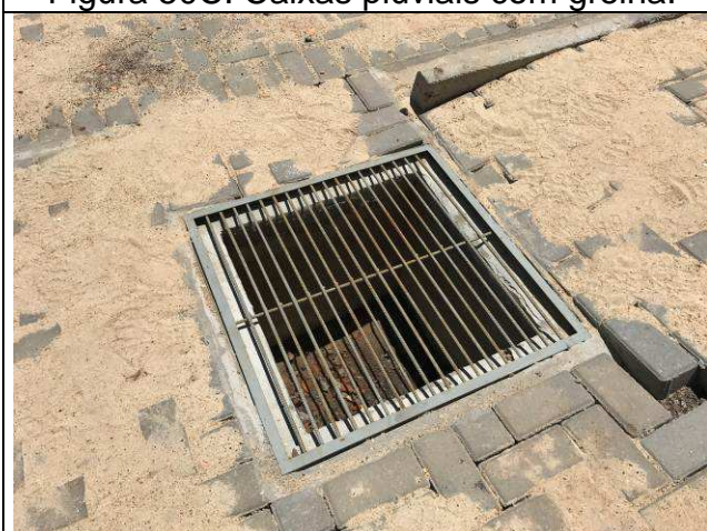
Figura 52C: Caixas pluviais com grelha.
