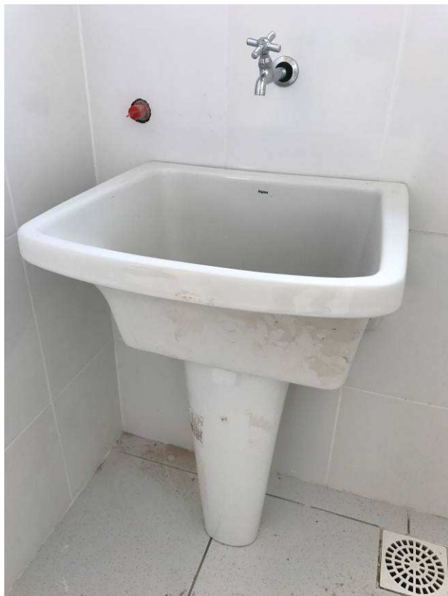
Figura 66C: Louças - tanque da área de serviço.
