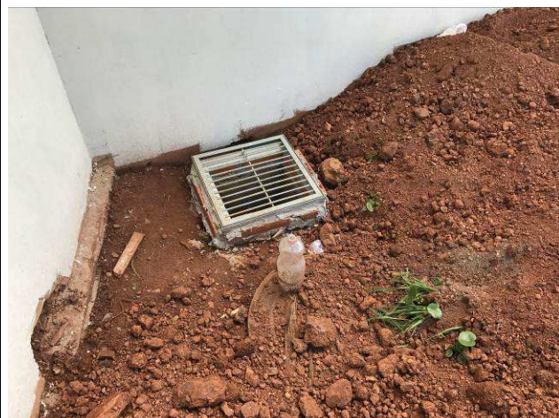
Figura 57C: Caixas pluviais com grelha.
