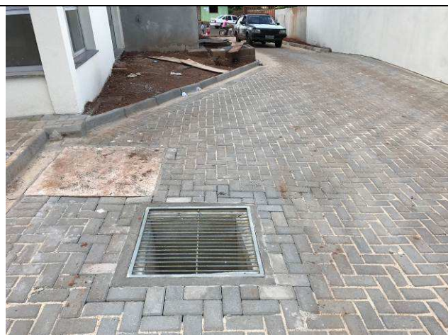
Figura 58C: Caixas pluviais com grelha.
