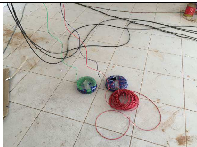
Figura 07E: cabearno elétrico rede estabilizada
