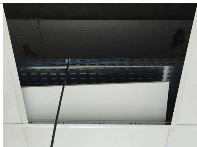
Figura 18E: cabos PP iluminação interna
