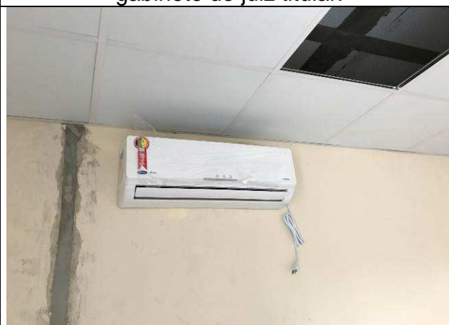
Figura 79C: Evaporadora - 12.000 BTU's - gabinete do juiz auxiliar.
