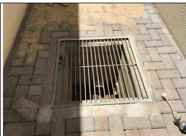
Figura 51C: Caixas pluviais com grelha.
