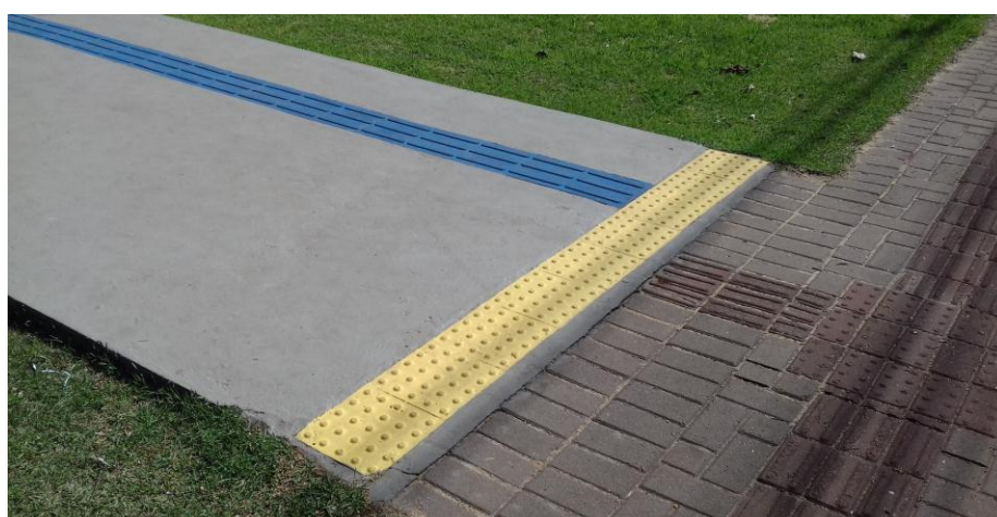
Figura 14.25 - Pintura realizada na calçada de acesso principal ao imóvel. Também foi realizada a pintura do piso podotátil existente.
