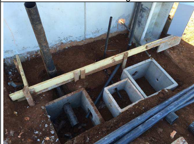
Figura 03E: Caixas de passagem - entrada de energia.
