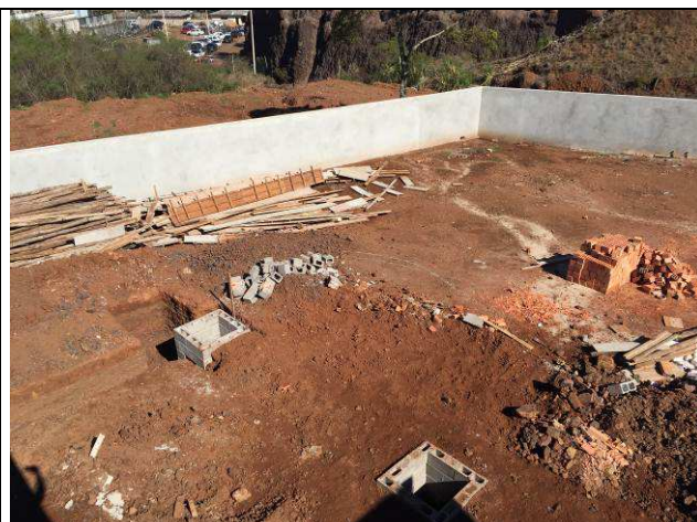
Figura 72C: Caixas de inspeção de águas pluviais.
