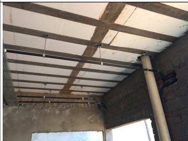
Figura 22E: Infraestrutura interna - Eletrodutos de PVC rígido e corrugado.
