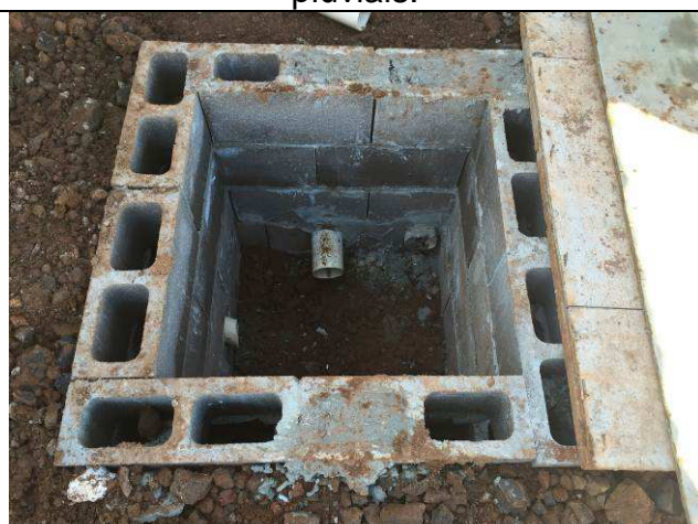
Figura 75C: Caixa de inspeção de esgoto.
