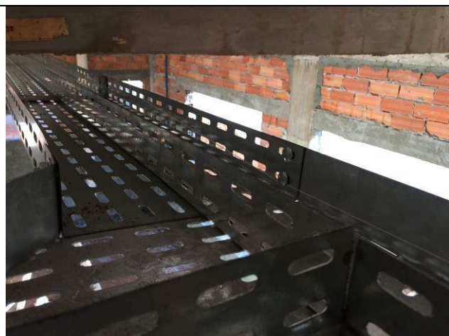
Figura 17E: Infraestrutura interna - eletrocalhas, septo divisor.
