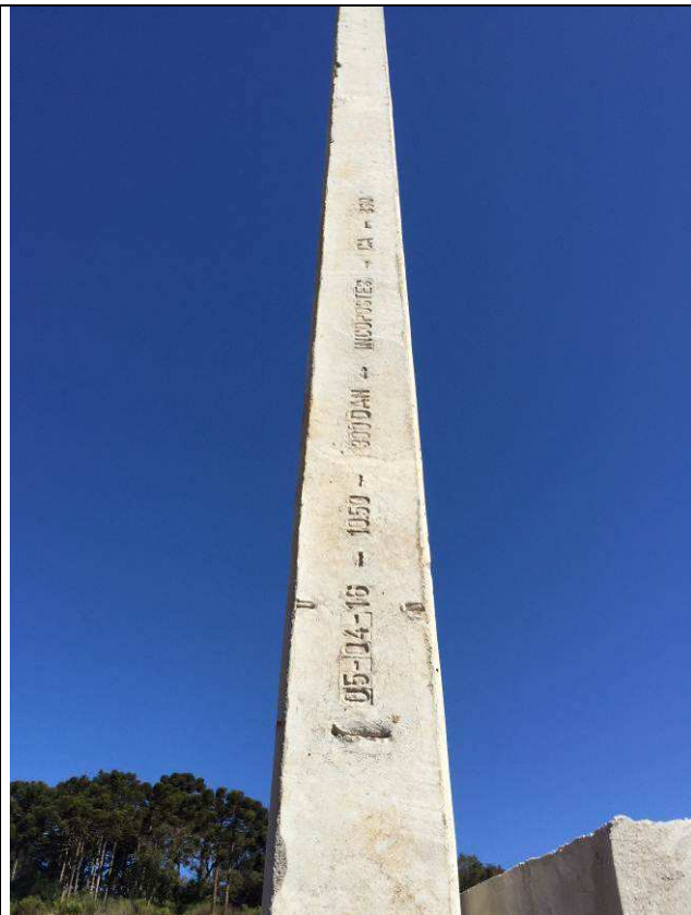
Figura 02E: Poste de concreto armado - entrada de energia.
