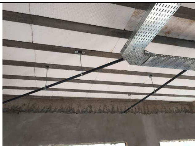
Figura 23E: Infraestrutura interna - Eletrodutos de PVC rígido e corrugado.
