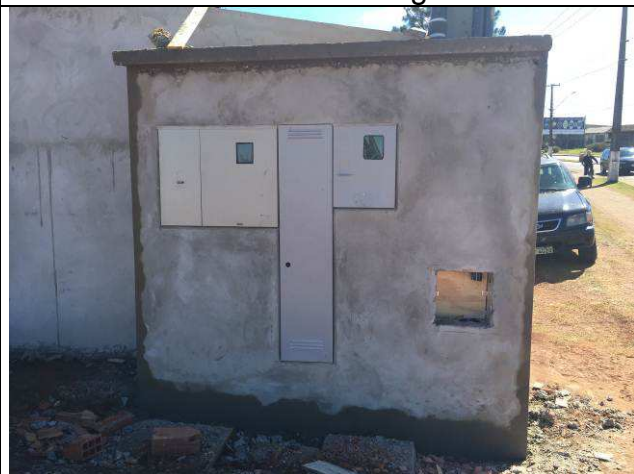
Figura 04E: Caixas GNE, CN1 e de telecomunicações na mureta.
