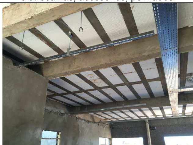
Figura 15E: Infraestrutura interna - eletrocalhas, acessórios, perfilados.
