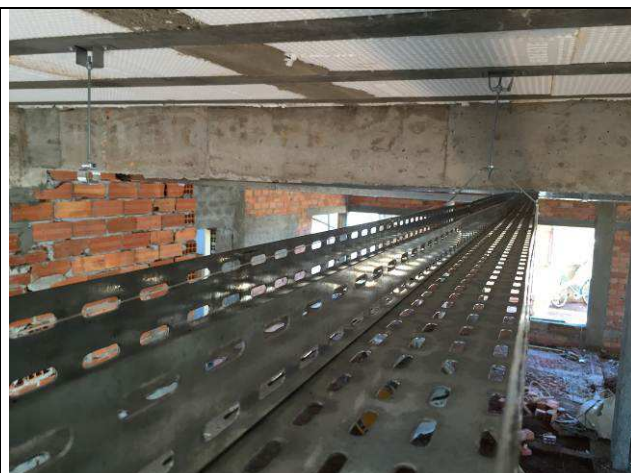
Figura 18E: Infraestrutura interna - eletrocalhas, septo divisor.
