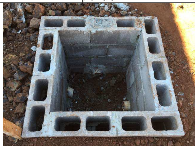
Figura 74C: Caixas de inspeção de águas pluviais.
