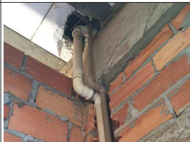
Figura 58C: Tubulações de água fria e ventilação de esgoto.
