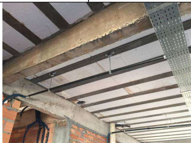
Figura 21E: Infraestrutura interna - Eletrodutos de PVC rígido e corrugado.
