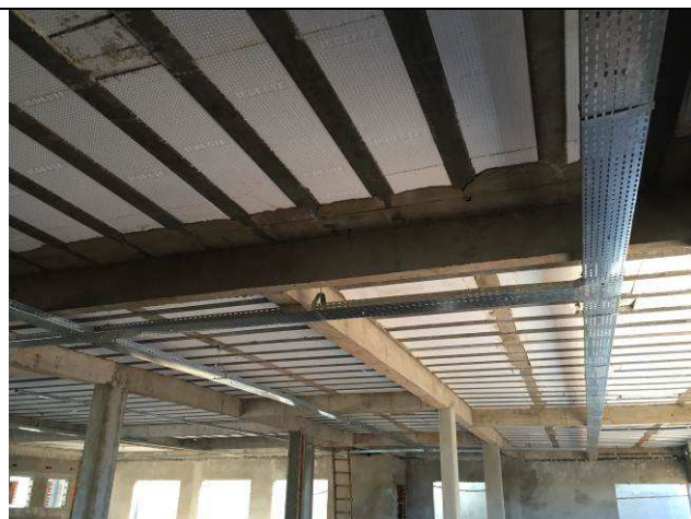
Figura 11E: Infraestrutura interna - eletrocalhas, acessórios, perfilados.
