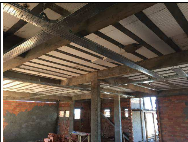
Figura 12E: Infraestrutura interna - eletrocalhas, acessórios, perfilados.
