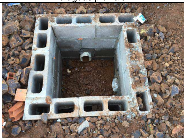
Figura 73C: Caixas de inspeção de águas pluviais.
