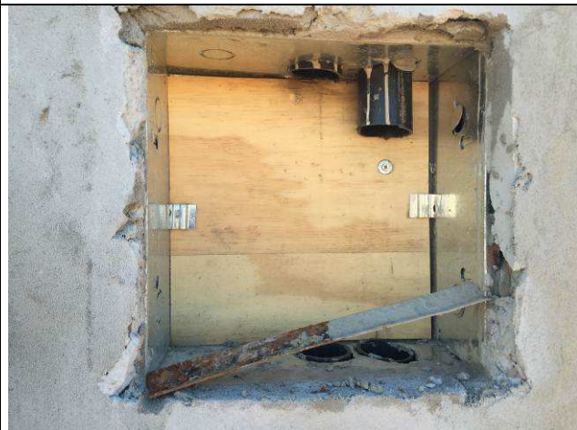
Figura 08E: Caixa de passagem de telecomunicações.
