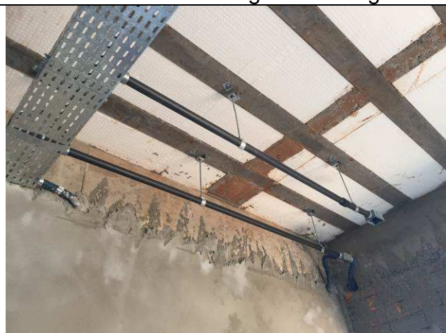
Figura 25E: Infraestrutura interna - Eletrodutos de PVC rígido.
