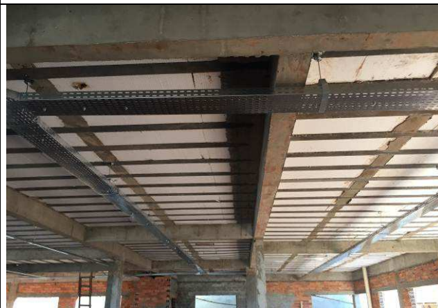
Figura 10E: Infraestrutura interna - eletrocalhas, acessórios, perfilados.
