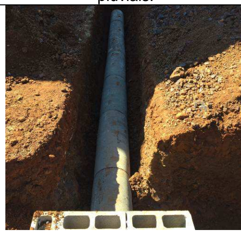
Figura 76C: Tubulação de concreto - rede de águas pluviais.
