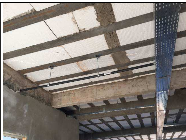
Figura 24E: Infraestrutura interna - Eletrodutos de PVC rígido e corrugado.
