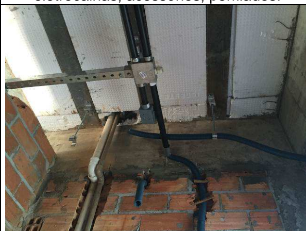
Figura 16E: Infraestrutura interna - perfilados e eletrodutos.
