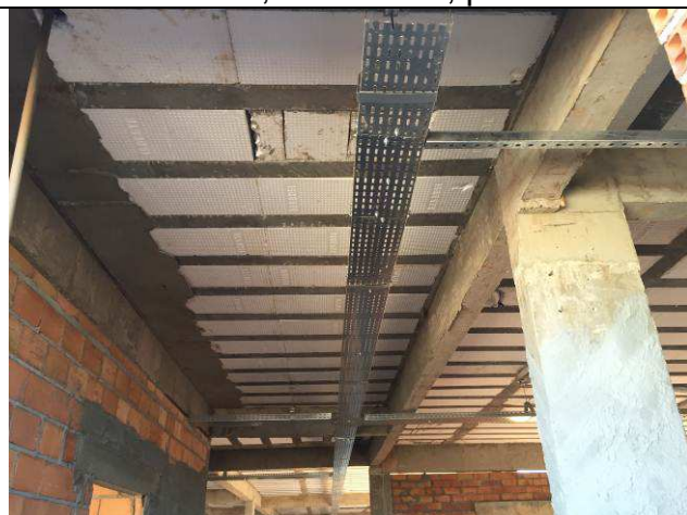
Figura 13E: Infraestrutura interna - eletrocalhas, acessórios, perfilados.
