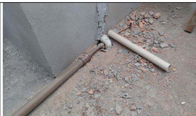
Figura 110C: Tubos de PVC de Ø 50mm no barrilete sobre a laje de cobertura.
