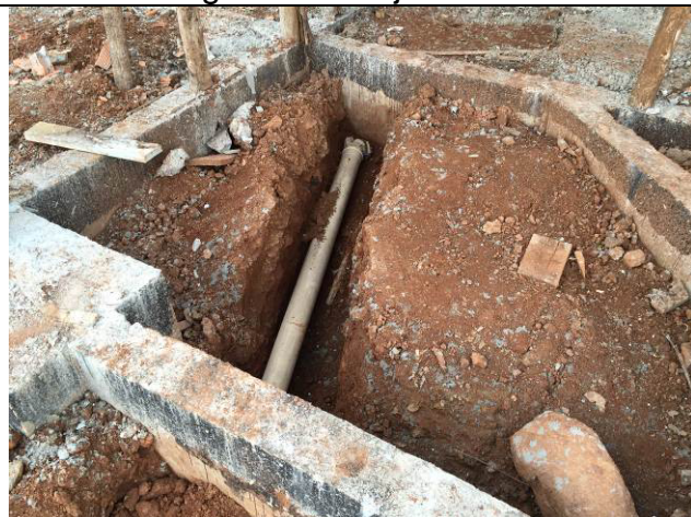
Figura 119C: Tubos de PVC de Ø 100mm da rede de coleta de esgoto.
