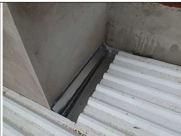
Figura 82C: Calhas e rufos em chapa de aço galvanizado # 22.
