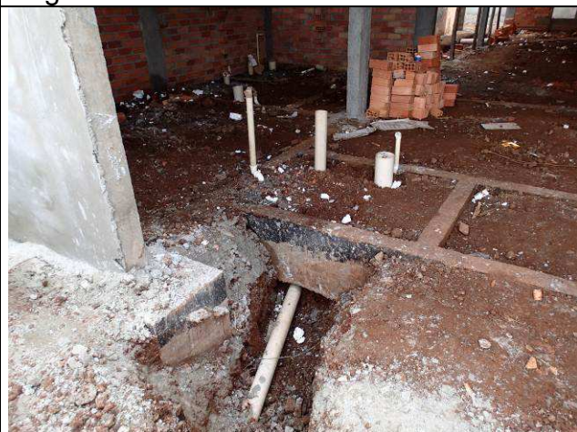
Figura 116C: Pontos de esgoto - banheiro do gabinete do juiz auxiliar.
