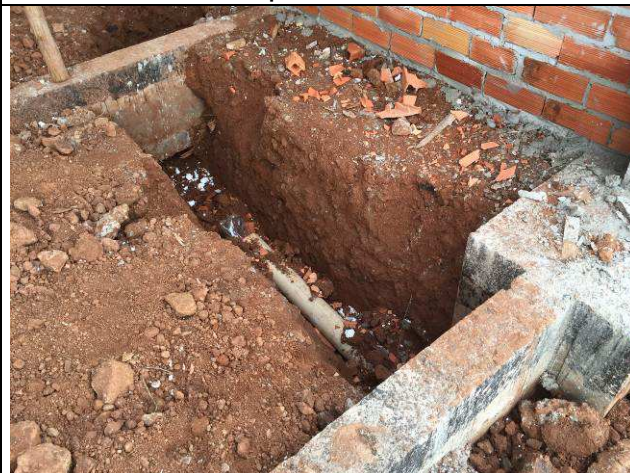
Figura 120C: Tubos de PVC de Ø 100mm da rede de coleta de esgoto.
