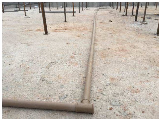
Figura 112C: Tubos de PVC de Ø 50mm no barrilete sobre a laje de cobertura.
