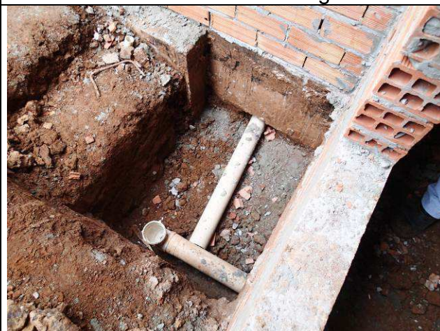
Figura 122C: Tubos de PVC de Ø 100mm da rede de coleta de esgoto.
