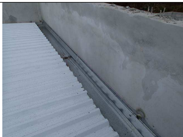
Figura 81C: Calhas e rufos em chapa de aço galvanizado # 22.
