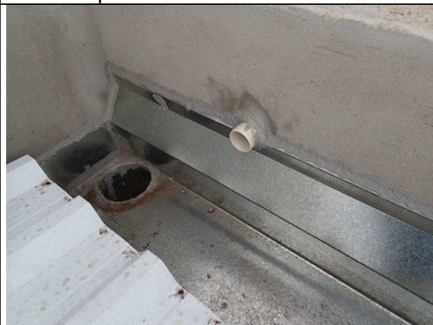
Figura 80C: Calhas e rufos em chapa de aço galvanizado # 22.
