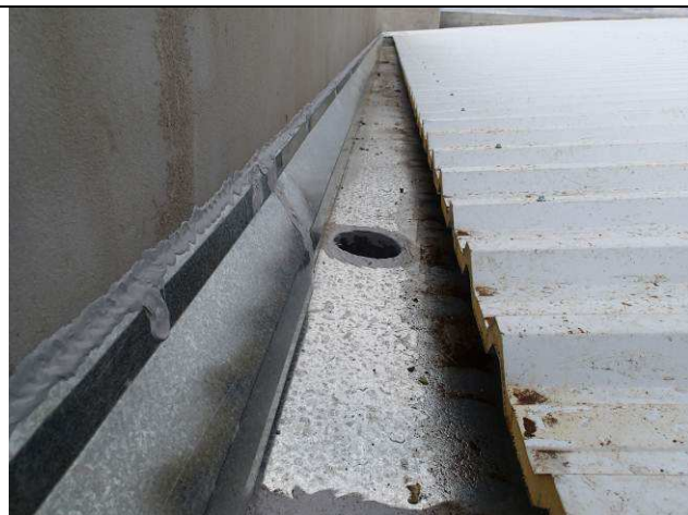
Figura 79C: Calhas e rufos em chapa de aço galvanizado # 22.
