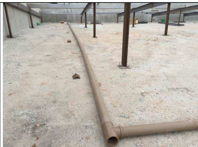
Figura 111C: Tubos de PVC de Ø 50mm no barrilete sobre a laje de cobertura.
