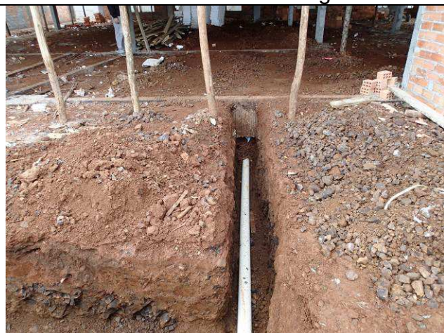
Figura 121C: Tubos de PVC de Ø 100mm da rede de coleta de esgoto.
