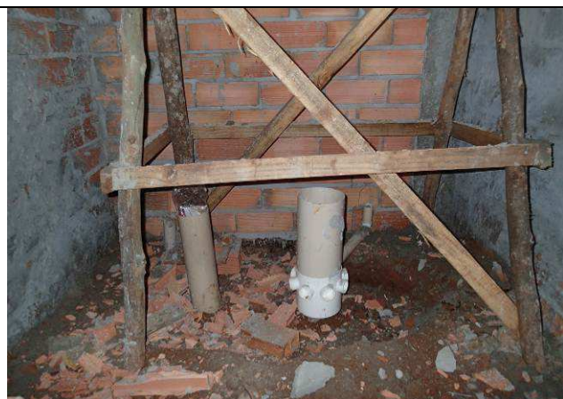
Figura 117C: Pontos de esgoto - banheiro do gabinete do juiz titular.
