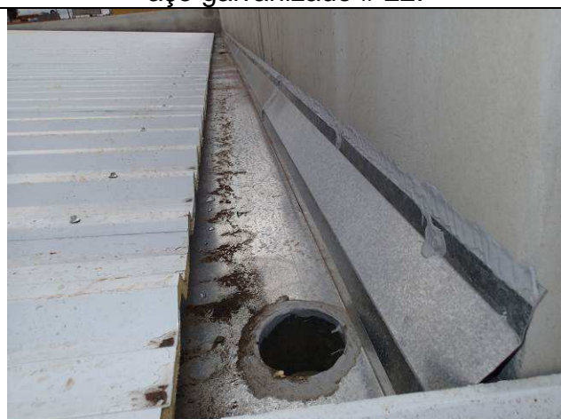
Figura 83C: Calhas e rufos em chapa de aço galvanizado # 22.
