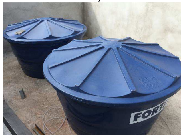
Figura 113C: Reservatórios de 1000 litros.
