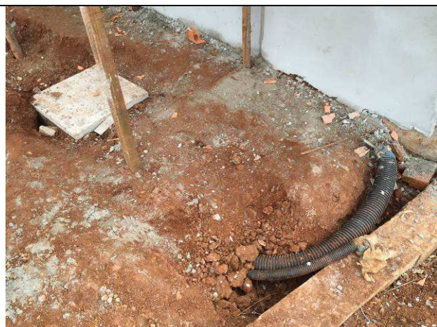
Figura 05E: Entrada de energia TRT (eletroduto 75mm) e PAB (40mm), caixas 50x50.
