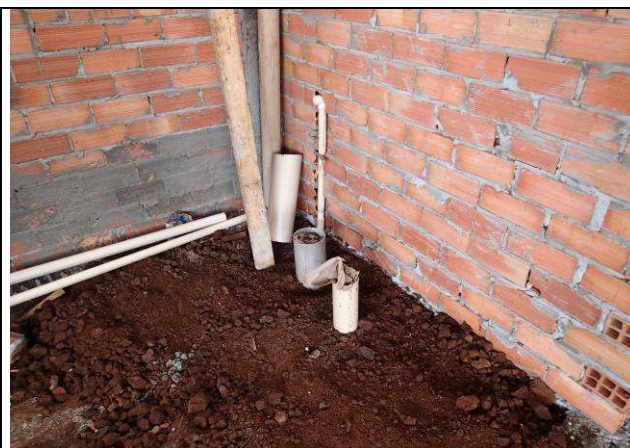
Figura 118C: Pontos de esgoto - banheiro público.
