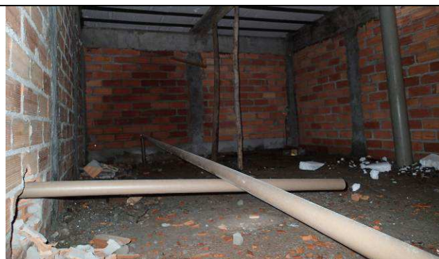
Figura 109C: Tubos de PVC de Ø 50mm no barrilete sobre a laje de cobertura.
