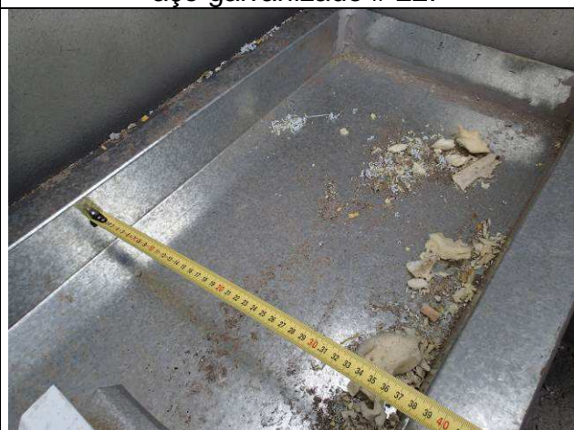
Figura 84C: Calhas e rufos em chapa de aço galvanizado # 22.
