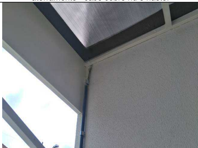
Figura 70E: descida SPDA - união cabo cobre nu e fitas em alumínio.
