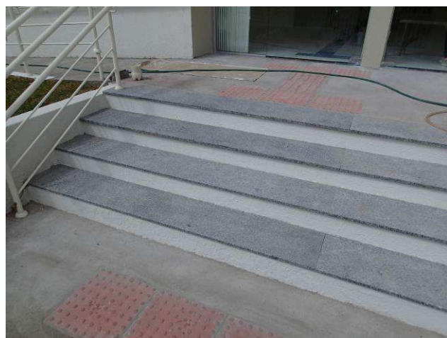
Figura 31C: Degraus e faixa de 30 cm (em nível) da escada externa revestidos em granito.
