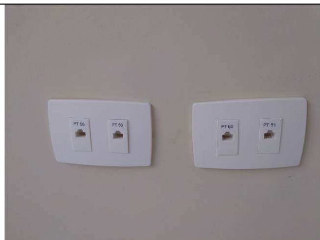
Figura 61E: Conectores RJ45 cat6.
