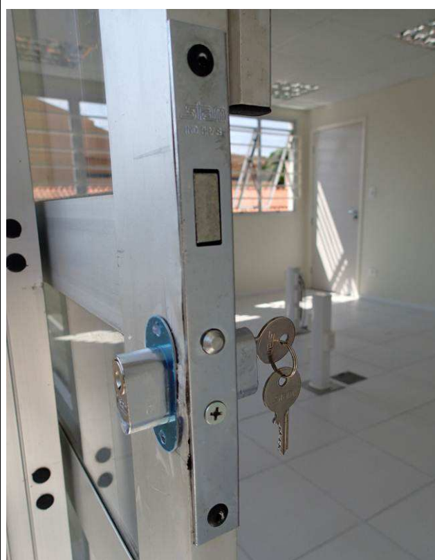
Figura 09C: Fechadura, marca Stam, instalada em porta-janela da sala de espera do pavimento superior.
