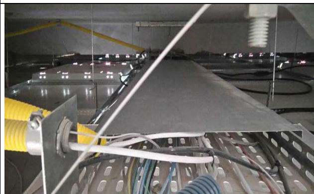
Figura 6E: Eletrocalhas tampadas.
