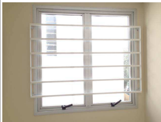
Figura 11C: Grade metálica instalada pelo lado interno da janela J1 localizada na sala de espera (pavimento superior).
