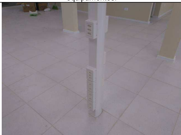
Figura 58E: Conectores RJ45 cat6, porta equipamentos.
