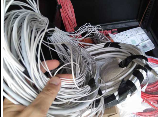
Figura 49E: cabeamento para CFTV - alimentação.
