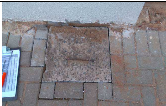
Figura 1E: Caixa 30x30 aterramento entrada de energia.
