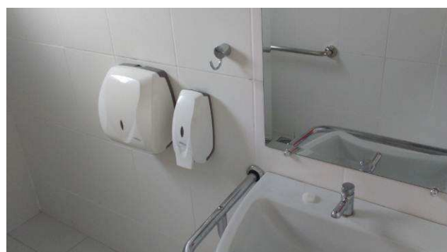
Figura 67C: Dispensers de sabonete líquido e papel toalha - banheiro PNE pavimento inferior.
