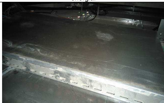
Figura 3E: Eletrocalhas tampadas.
