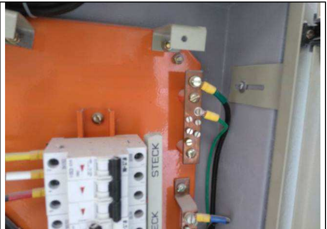
Figura 38E: Cabos de aterramento dos quadros.
