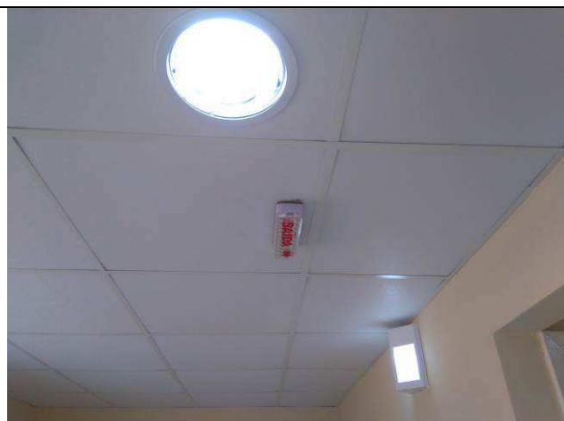
Figura 32E: luminária 2x23W, bloco de emergência e arandela.
