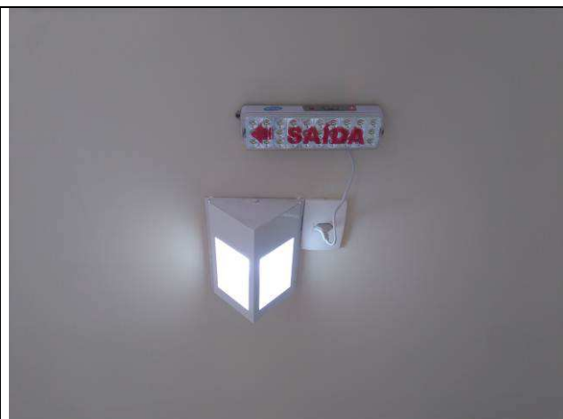
Figura 31E: bloco de emergência e arandela.
