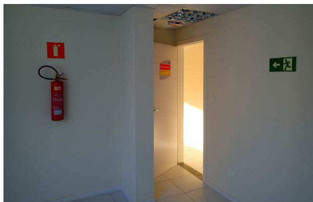
Figura 75C: Extintor classe ABC instalado na sala de audiências 1.
