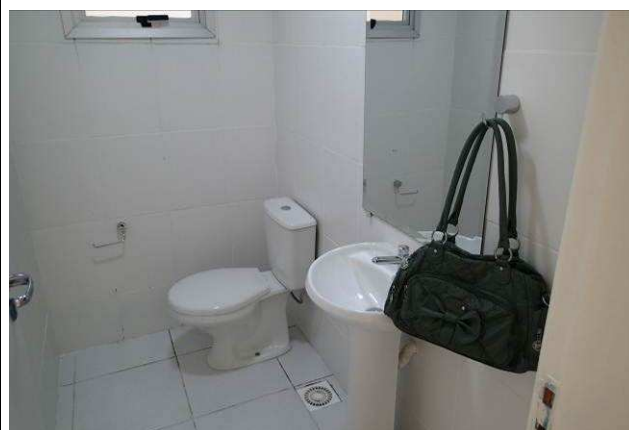
Figura 60C: Assento sanitário instalado em banheiro da secretaria, no pavimento inferior.
