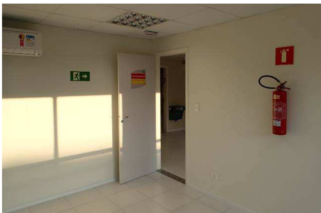
Figura 76C: Extintor classe ABC instalado na sala de audiências 2.
