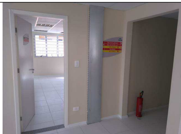
Figura 7E: Eletrocalhas tampadas.
