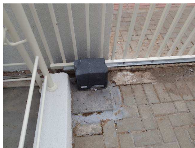
Figura 85C: Motor instalado junto ao portão de acesso ao estacionamento coletivo.
