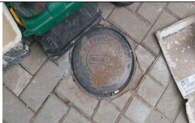
Figura 67E: caixa de piso para inspeção de aterramento - descidas SPDA.
