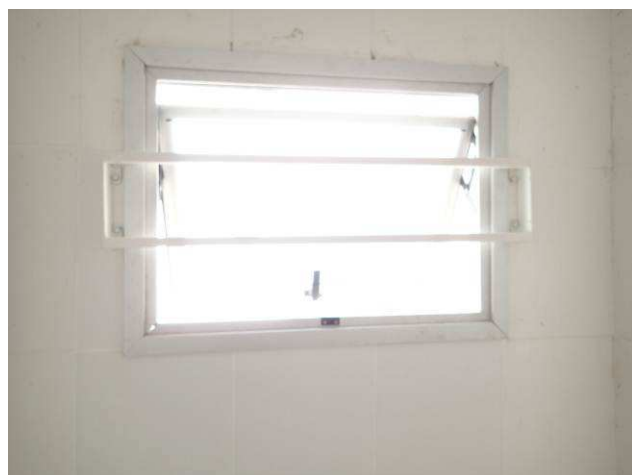
Figura 12C: Grade metálica instalada pelo lado interno da janela J3 localizada no banheiro PNE.
