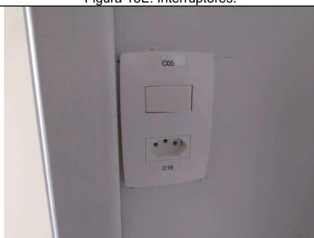
Figura 18E: Interruptores e tomadas elétricas.
