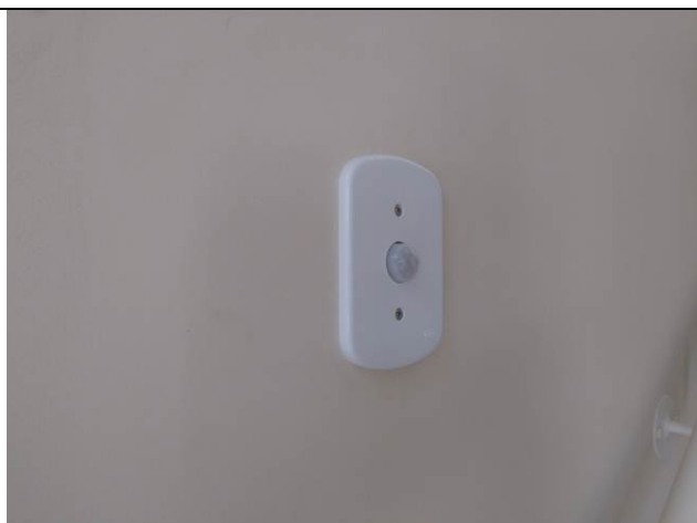
Figura 20E: sensor de presença escada.
