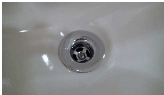
Figura 61C: Válvula de escoamento cromada instalada no banheiro de uso público, no pavimento superior.
