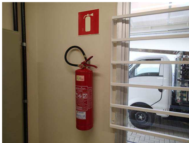
Figura 73C: Extintor classe ABC instalado na sala site.
