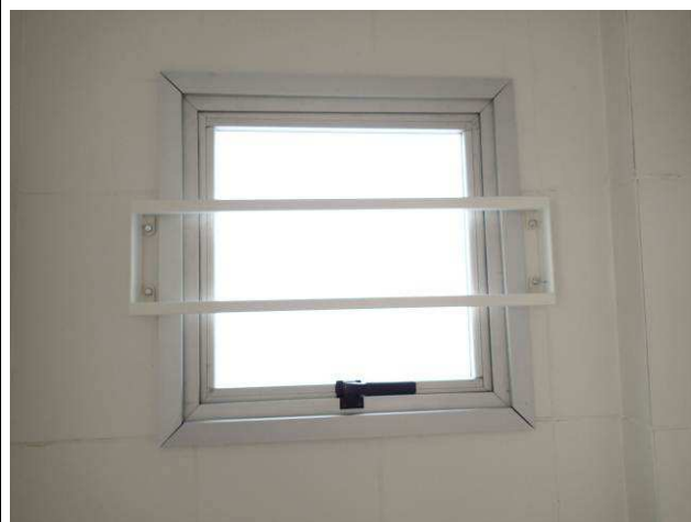
Figura 13C: Grade metálica instalada pelo lado interno da janela J3 localizada em banheiro da Secretaria.
