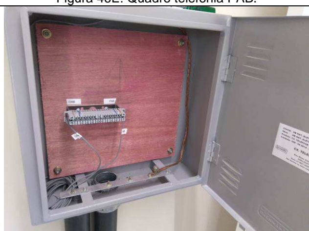
Figura 48E: Quadro DG de telefonia, blocos e cabeamento para PAB e OAB.
