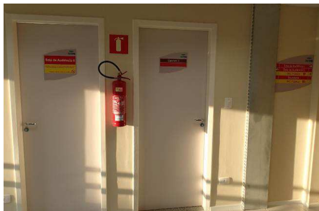
Figura 77C: Extintor classe ABC instalado no hall público do pavimento superior.
