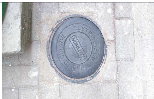
Figura 66E: caixa de piso para inspeção de aterramento - descidas SPDA.
