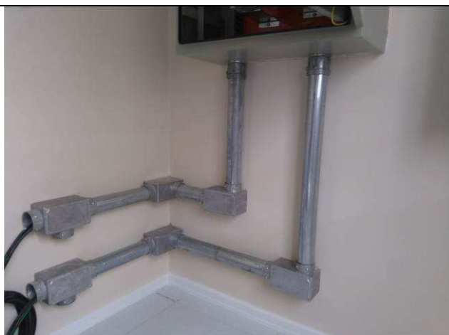
Figura 8E: Infraestrutura com dutos FG e condutes 2" - alimentadores nobreak.
