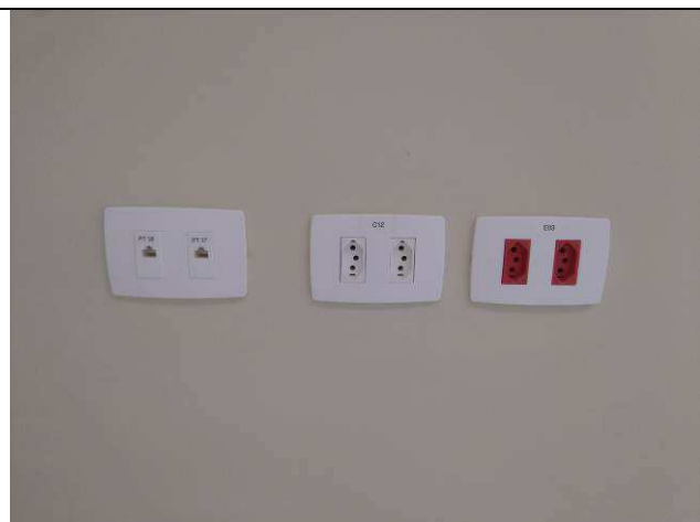
Figura 19E: Tomadas elétricas rede comum e estabilizada.
