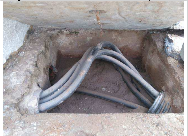
Figura 40E: Novo ramal alimentador QDG.
