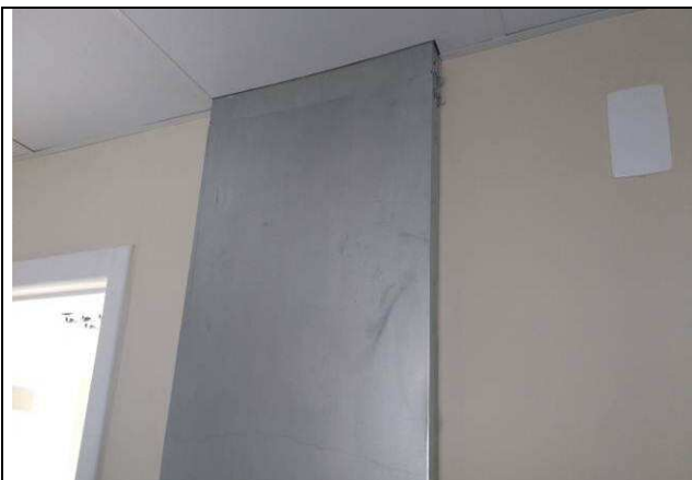
Figura 41E: eletrocalhas rack - tampa.
