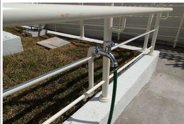
Figura 50C: Ponto de água fria relocado para área mais próxima ao guarda corpo da rampa PNE.
