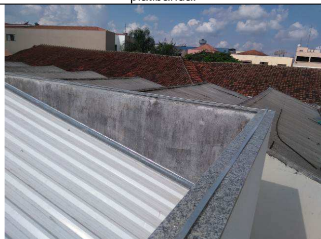
Figura 75E: Gaiola de Faraday - fitas ao redor da platibanda.
