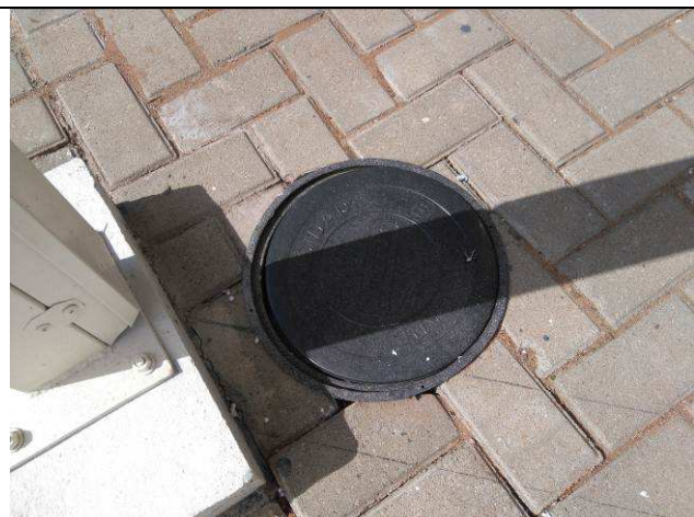
Figura 69E: caixa de piso para inspeção de aterramento - descidas SPDA.
