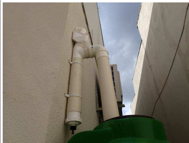
Figura 56C: Tubo de descida e separador de folhas interligando calha ao tanque de aproveitamento.
