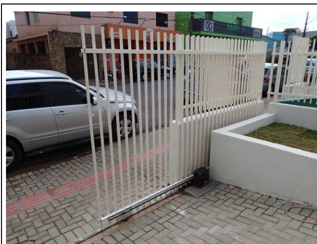
Figura 84C: Motor instalado junto ao portão de acesso à vaga privada de juiz.
