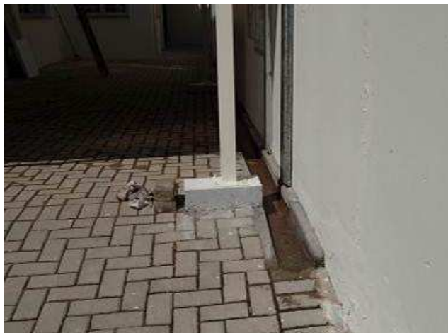
Figura 53C: Prolongamento da canaleta para águas pluviais na rampa de acesso de veículos (vaga juiz).
