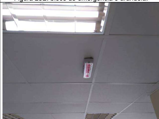
Figura 30E: bloco de emergência e iluminação interna.
