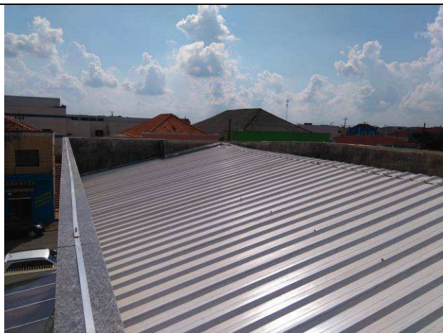
Figura 74E: Gaiola de Faraday - fitas ao redor da platibanda.
