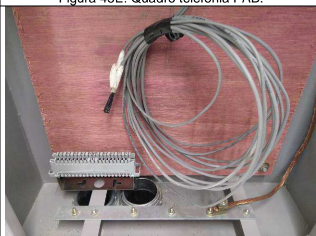
Figura 47E: Quadro DG de telefonia, blocos e cabeamento para PAB e OAB.
