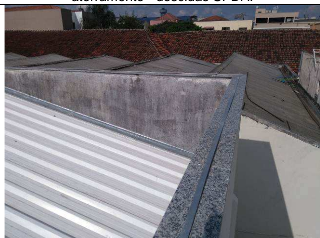
Figura 71E: Gaiola de Faraday - fitas ao redor da platibanda.
