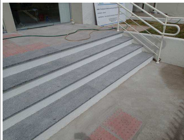
Figura 32C: Degraus e faixa de 30 cm (em nível) da escada externa revestidos em granito.
