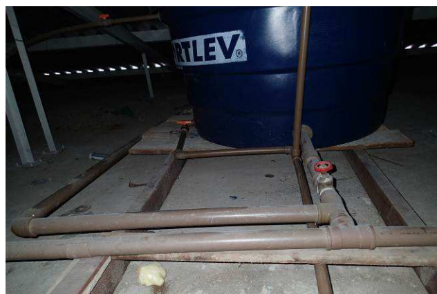
Figura 49C: Registro de esfera e tubulação para limpeza do reservatório.
