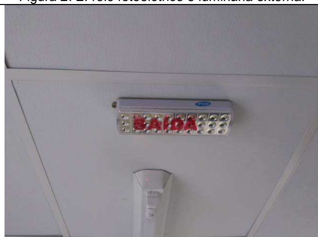
Figura 29E: bloco de emergência.
