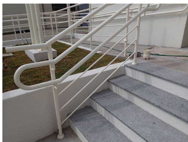
Figura 82C: Guarda corpo e corrimão da escada de entrada.
