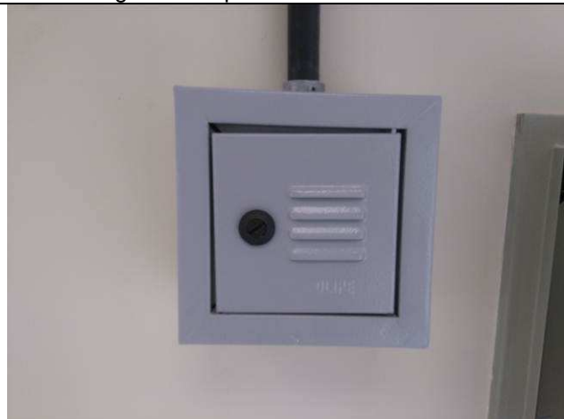
Figura 46E: Quadro telefonia PAB.
