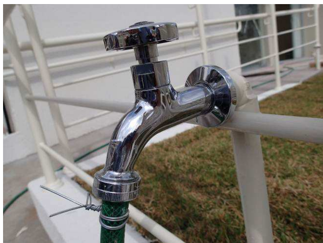
Figura 55C: Torneira para uso geral, instalada no ponto de água anexo à rampa PNE.
