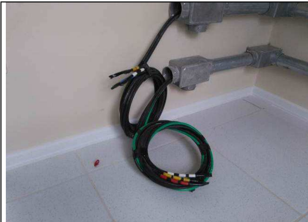
Figura 37E: Alimentadores do Nobreak - QDE.
