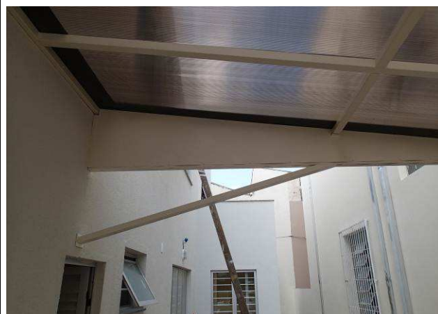
Figura 16C: Mãos francesas instaladas sob a cobertura da vaga privativa de juiz.
