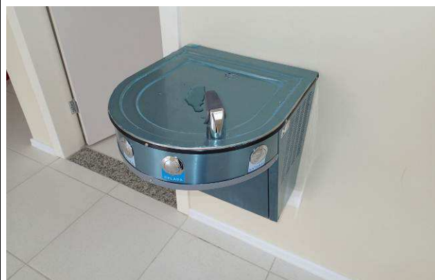
Figura 48C: Bebedouro instalado na sala de espera do pavimento superior.
