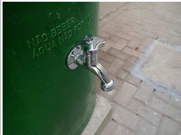
Figura 54C: Torneira para uso geral, instalada no tanque de aproveitamento de água da chuva.
