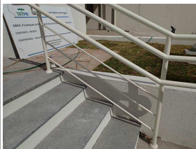
Figura 83C: Guarda corpo e corrimão da escada de entrada.
