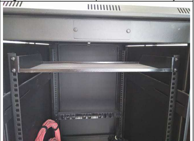
Figura 52E: rack TI - sala técnica.
