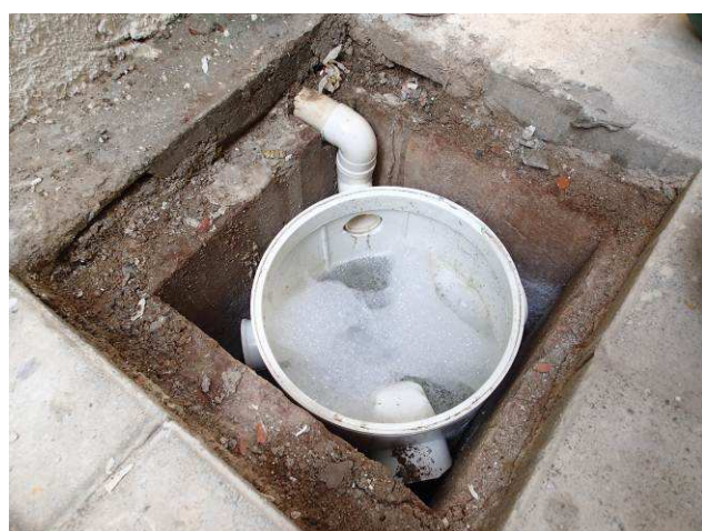
Figura 51C: Caixa de gordura de polietileno instalada na saída do esgoto secundário da copa.
