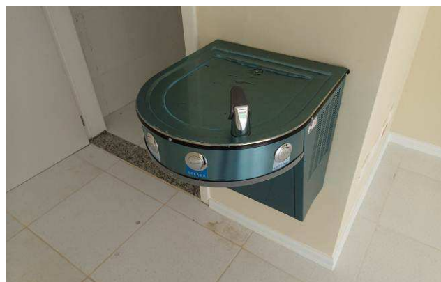
Figura 47C: Bebedouro instalado no hall público do pavimento térreo.
