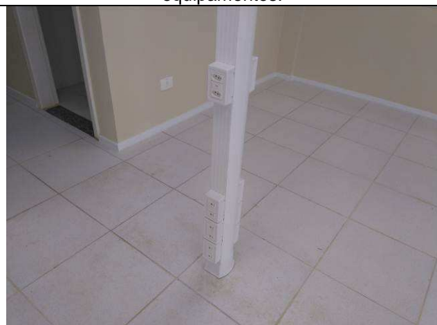
Figura 57E: Conectores RJ45 cat6, porta equipamentos.
