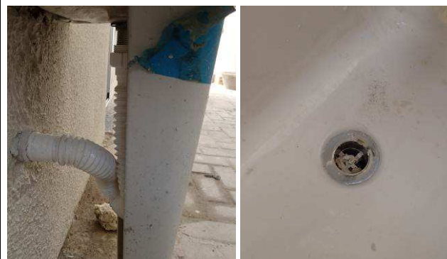
Figura 62C: Sifão e válvula de escoamento cromada instalados no tanque localizado no corredor dos fundos do imóvel.
