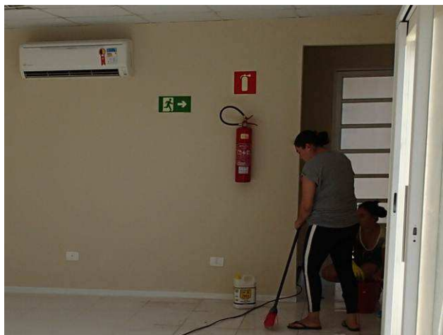
Figura 72C: Extintor classe ABC instalado no hall público do pavimento térreo.
