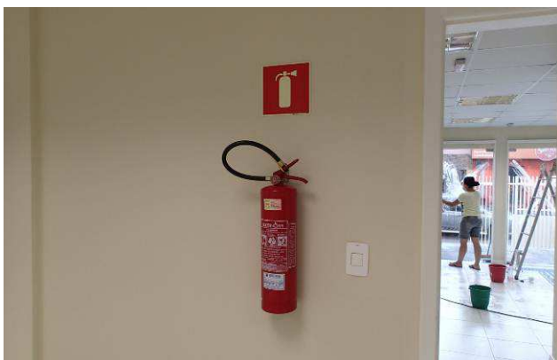
Figura 74C: Extintor classe ABC instalado na Secretaria.
