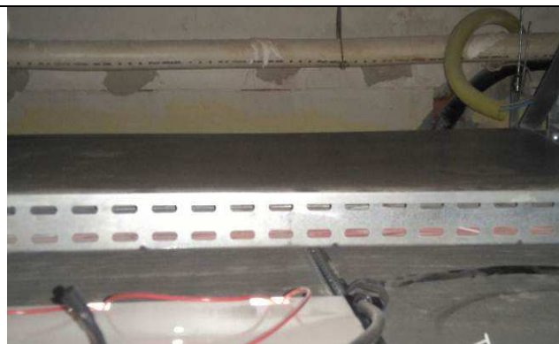
Figura 5E: Eletrocalhas tampadas.
