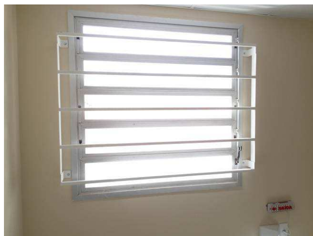
Figura 10C: Grade metálica instalada pelo lado interno da janela J1 localizada na escada metálica (pavimento superior).
