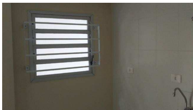
Figura 14C: Grade metálica instalada pelo lado interno da janela J1 localizada na copa.
