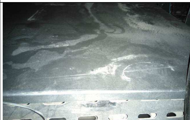
Figura 4E: Eletrocalhas tampadas.
