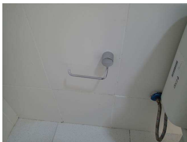
Figura 63C: Papeleira em metal cromado instalada no banheiro do gabinete de juiz 2.
