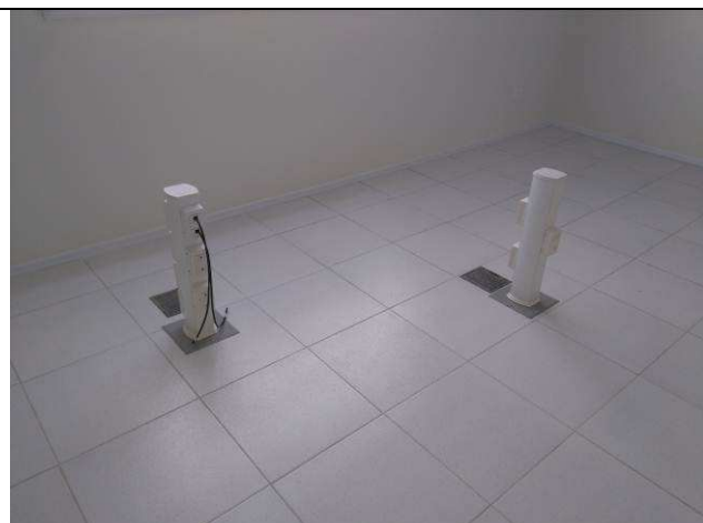
Figura 55E: Conectores RJ45 cat6, porta equipamentos.
