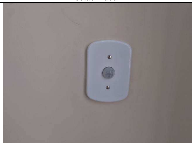
Figura 21E: sensor de presença escada.
