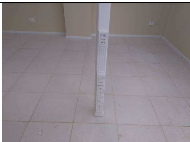
Figura 56E: Conectores RJ45 cat6, porta equipamentos.
