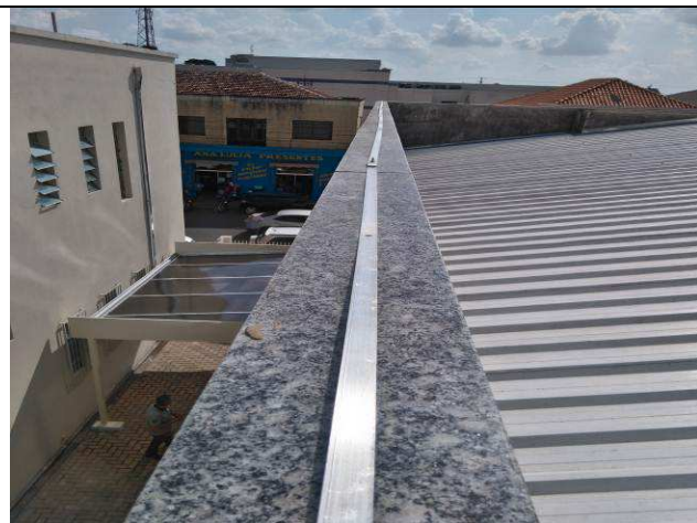
Figura 73E: Gaiola de Faraday - fitas ao redor da platibanda.
