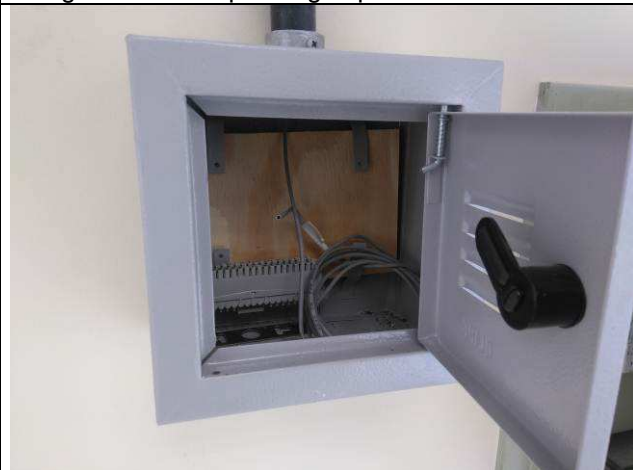
Figura 45E: Quadro telefonia PAB.
