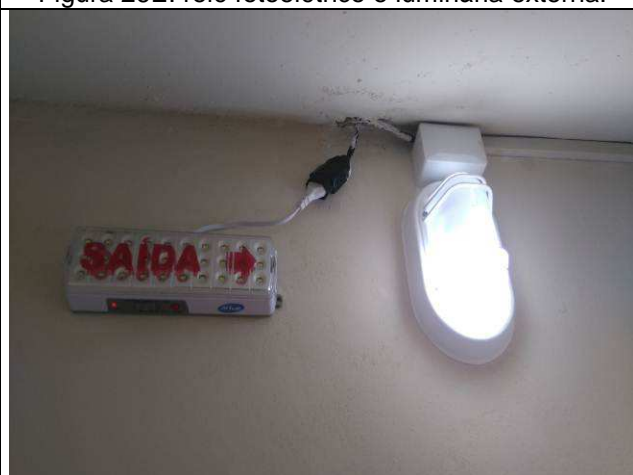
Figura 28E: bloco de emergência e arandela.
