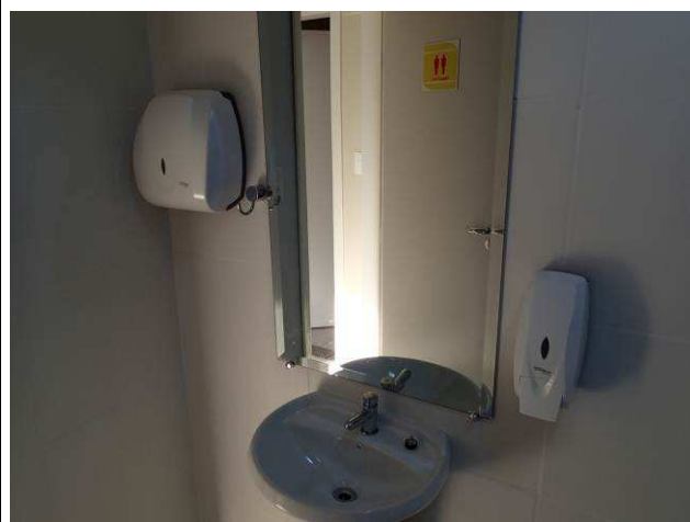
Figura 66C: Dispensers de sabonete líquido e papel toalha - banheiro público pavimento superior.
