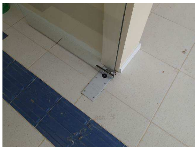
Figura 08C: Mola hidráulica instalada junto à porta PJ2, marca Stanley.
