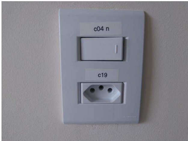
Figura 13E: interruptores e tomadas elétricas de embutir
