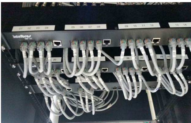
Figura 87E: régua balloons, cabos UTP e cabos BNC.
