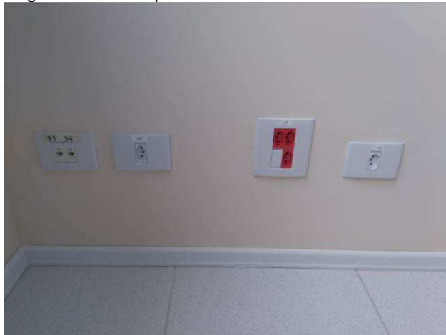
Figura 15E: interruptores e tomadas elétricas de embutir
