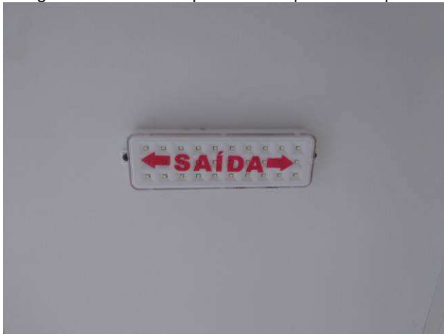
Figura 27E: blocos de emergência
