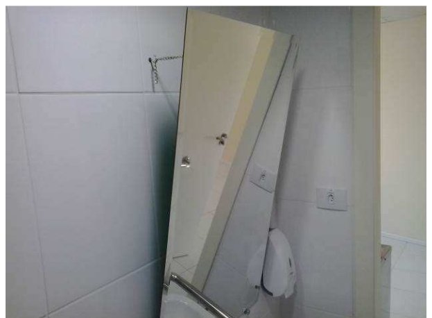
Figura 34C: Espelho cristal, inclinado, instalado nos sanitários PNE
