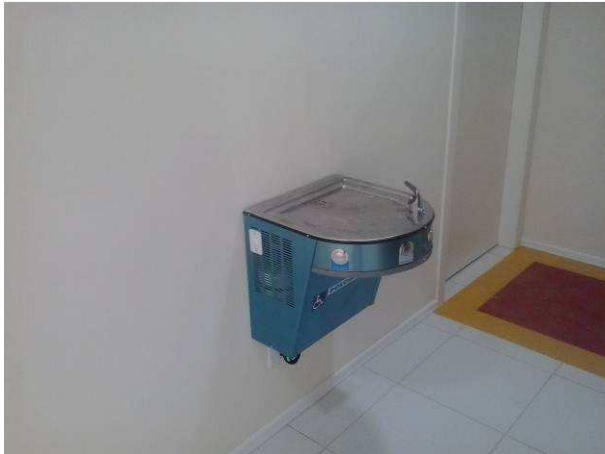
Figura 29C: Bebedouro fornecido pelo TRT, instalado no segundo pavimento
