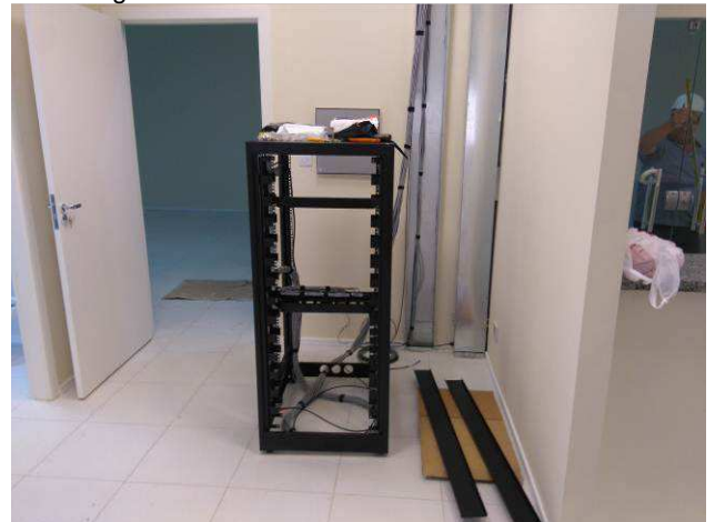
Figura 66E: racks e acessórios térreo
