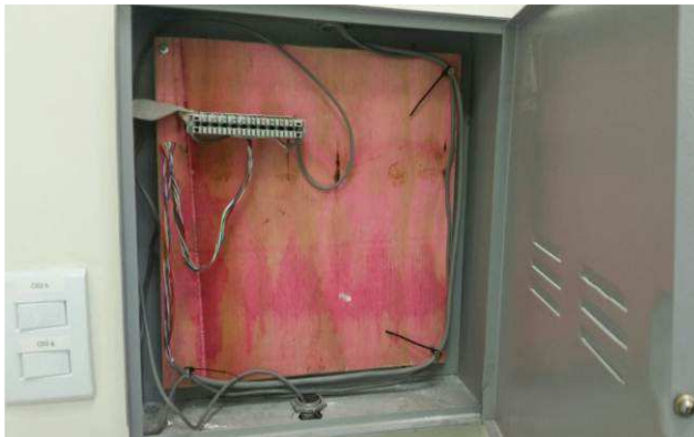
Figura 57E: Blocos Barga - Caixa de telefonia sala técnica
