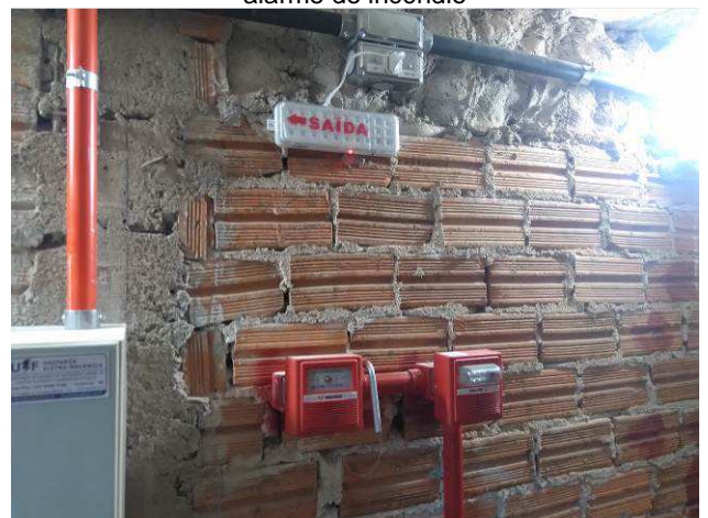
Figura 54E: acionadores manuais para acionamento e desligamento da bomba de combate à incêndio e para alarme de incêndio
