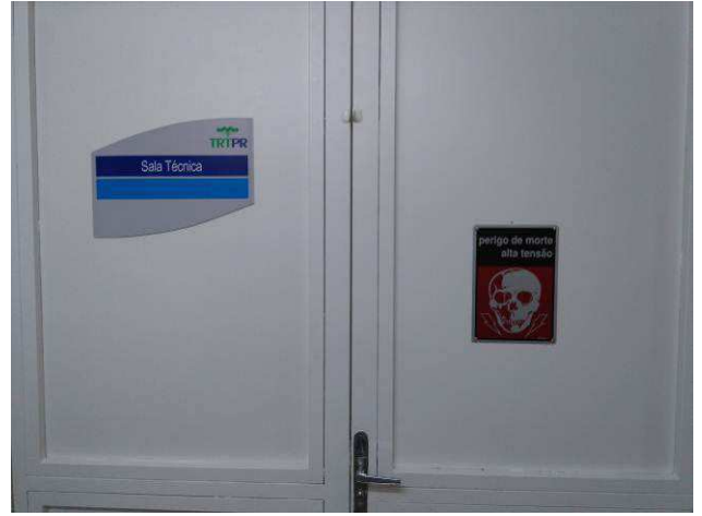
Figura 2E: placas de alerta - cabine de transformação
