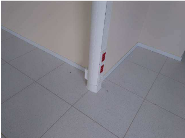
Figura 19E: colunas técnicas e tomadas elétricas Dutotec
