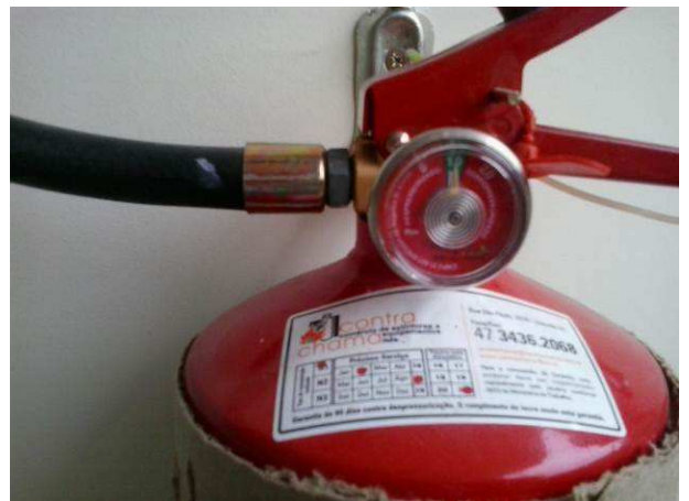
Figura 50C: Verificação da carga e prazo de validade do extintor
