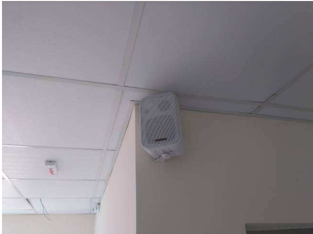
Figura 83E: sonorização - caixas de som
