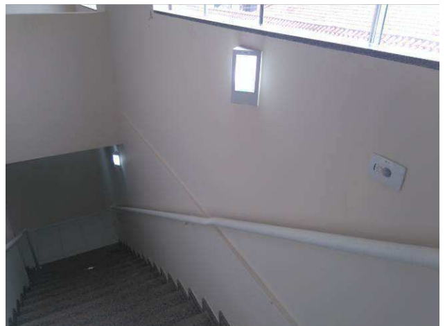
Figura 36E: arandelas de parede nas escadas internas
