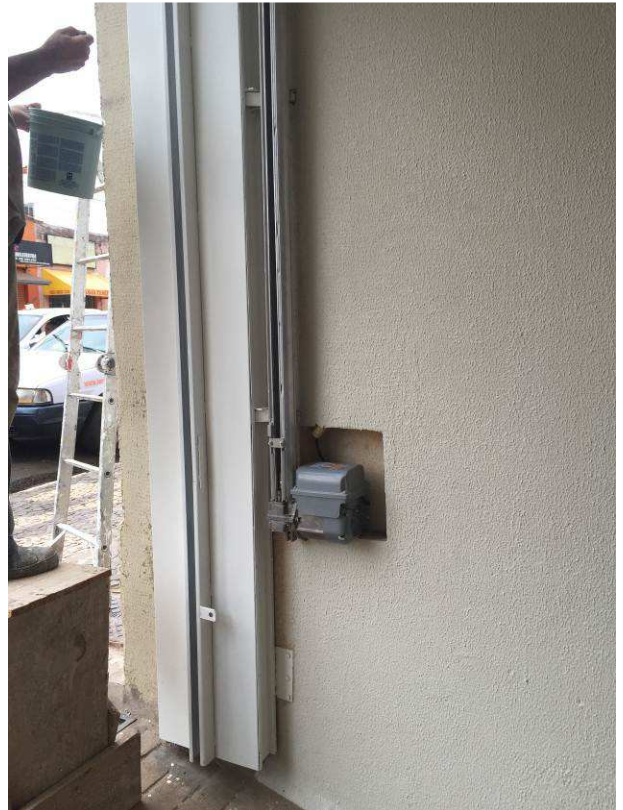
Figura 85C: Detalhe do motor de acionamento do portão e cremalheira tipo rosca infinita
