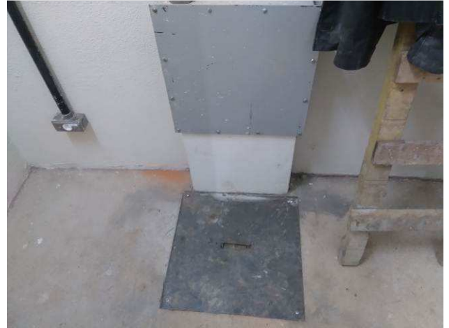
Figura 4E: BEP Barramento de Equipotencialização
