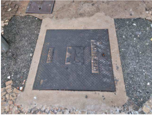
Figura 1E: caixa de passagem para e inspeção dos cabos de média tensão
