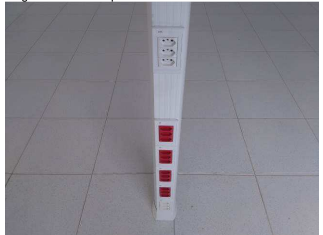
Figura 18E: colunas técnicas e tomadas elétricas Dutotec
