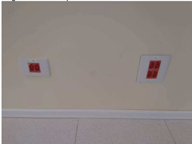
Figura 17E: interruptores e tomadas elétricas de embutir
