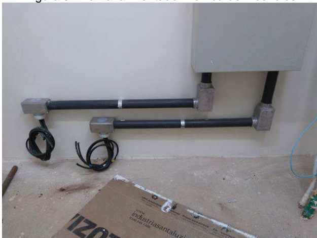
Figura 11E: infraestrutura elétrica e conexões do nobreak ao QDEG
