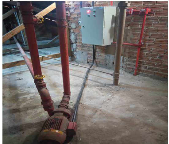
Figura 10E: ramal alimentador Bomba de Incêndios
