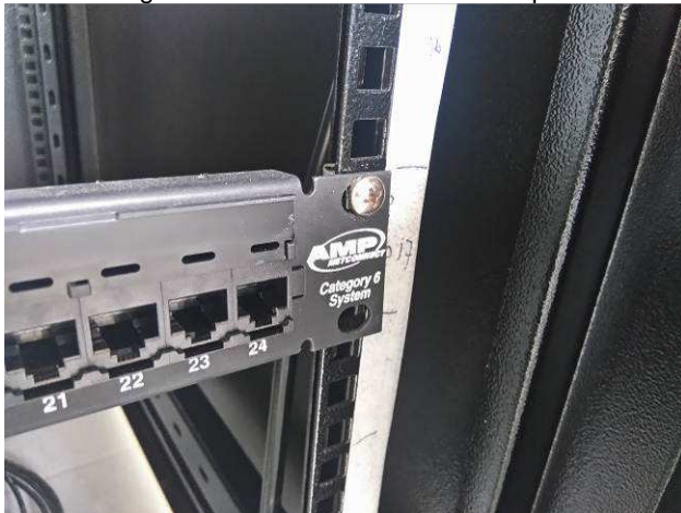
Figura 63E: racks e acessórios - patch panel
