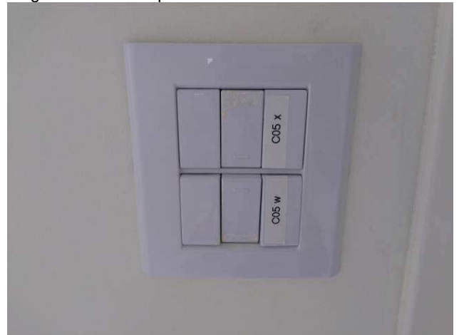
Figura 16E: interruptores e tomadas elétricas de embutir
