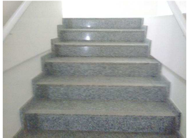
Figura 12C: Escada de acesso ao subsolo, com patamar eliminado e acabamento em granito, no mesmo padrão do existente
