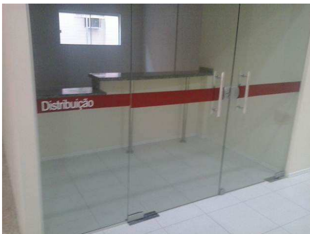
Figura 79C: Adesivos instalados nas portas de vidro
