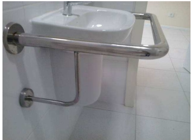
Figura 38C: detalhe de uma das barras de apoio instaladas junto a lavatórios, em sanitários PNE
