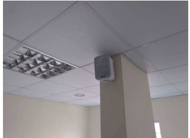
Figura 84E: sonorização - caixas de som
