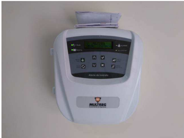
Figura 51E: central de alarme de incêndio, marca Multiseg 24 setores
