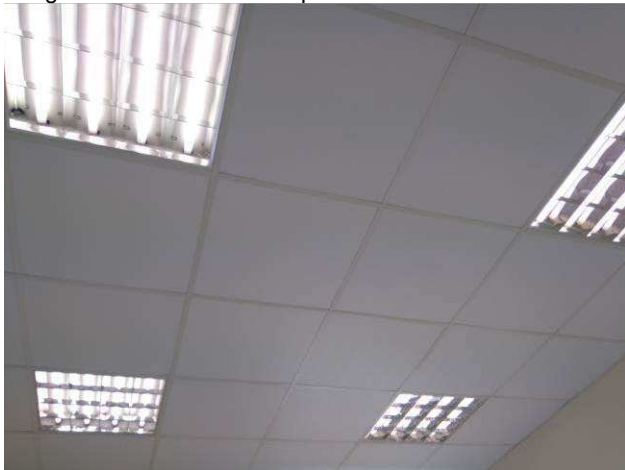
Figura 39E: luminárias 4x16W
