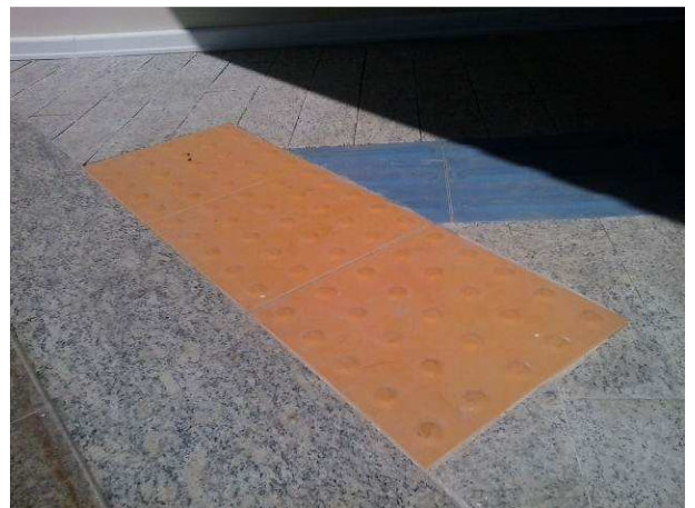
Figura 14C: Acabamento da faixa entre a escada e a porta de acesso principal ao imóvel - Granito bruto. Também na imagem, granito bruto
