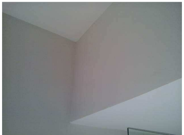
Figura 89C: Detalhe das paredes de adequação da porta de acesso principal
