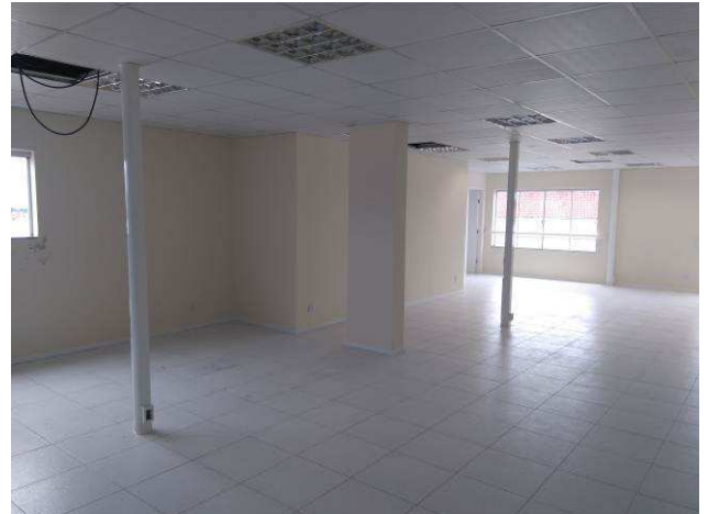
Figura 20E: colunas técnicas e tomadas elétricas Dutotec
