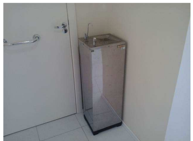
Figura 28C: Bebedouro fornecido pelo TRT, instalado no primeiro pavimento
