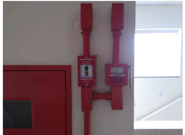
Figura 52E: acionadores manuais para acionamento e desligamento da bomba de combate à incêndio e para alarme de incêndio
