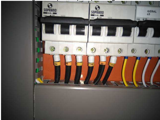
Figura 9E: ramal alimentador Bomba de Incêndios
