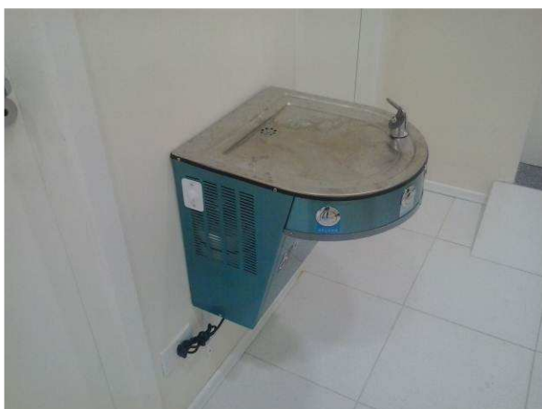
Figura 27C: Bebedouro fornecido pelo TRT, instalado no pavimento térreo
