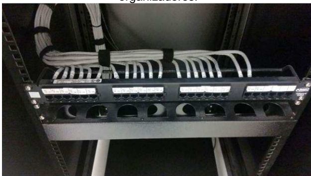
Figura 71E: racks e acessórios - patch panel, organizadores.
