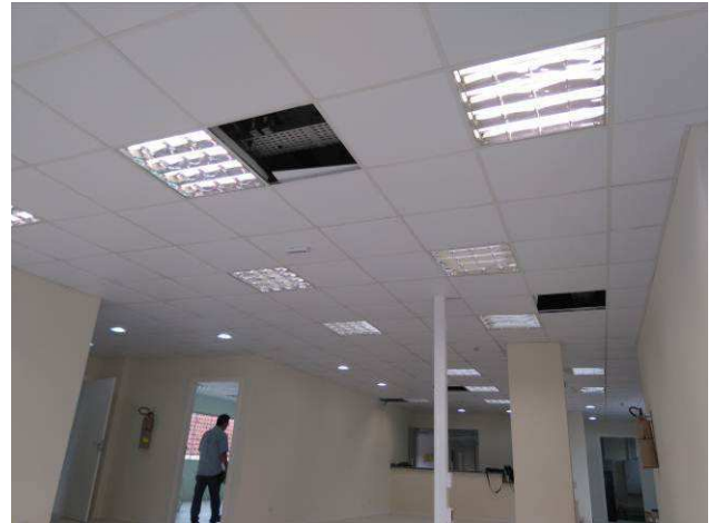
Figura 38E: luminárias 4x16W e 2x20W
