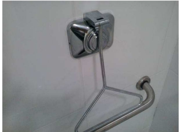
Figura 42C: detalhe de um dos acabamentos de válvula de descarga, instalados em BWC PNE
