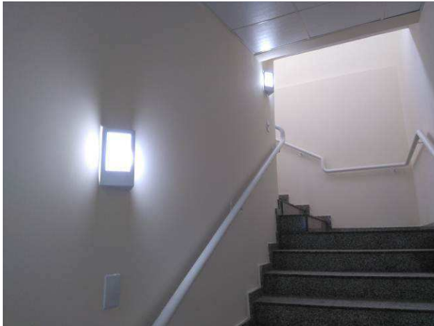
Figura 37E: arandelas de parede nas escadas internas
