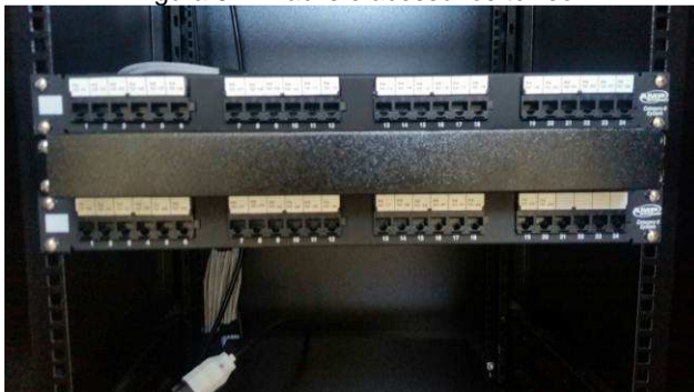
Figura 69E: racks e acessórios - patch panel, organizadores.
