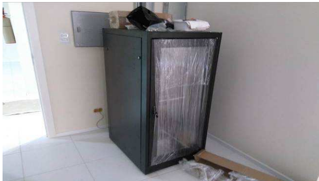
Figura 67E: racks e acessórios térreo
