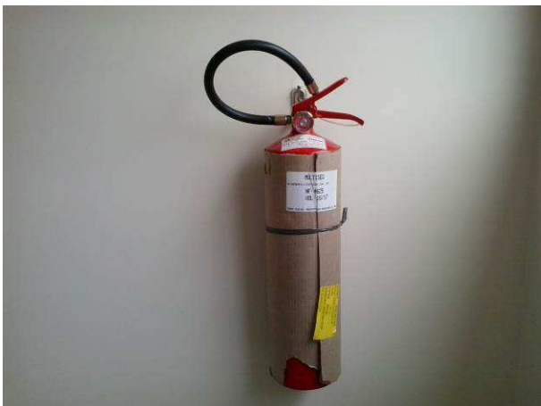
Figura 49C: Extintor ABC, instalado no pavimento térreo
