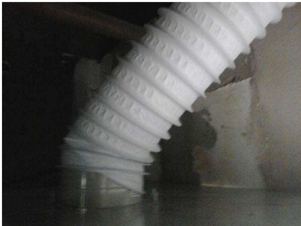
Figura 43C: Detalhe de um duto de ventilação, conectado em exaustor (tipo ventokit)
