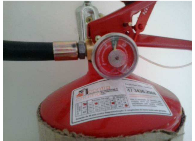
Figura 48C: Verificação da carga e prazo de validade do extintor
