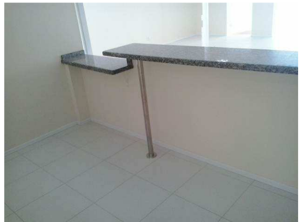
Figura 02C: Balcão de atendimento instalado no primeiro pavimento
