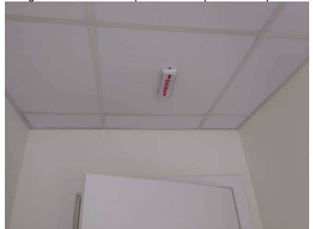
Figura 28E: blocos de emergência
