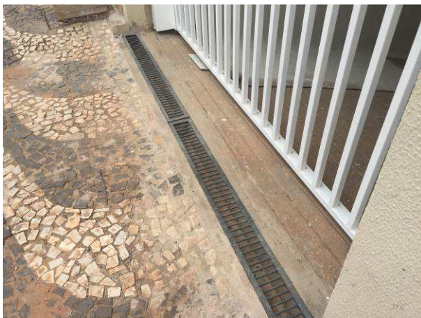
Figura 88C: Canaleta e grelha de drenagem pluvial junto à rampa de acesso ao subsolo
