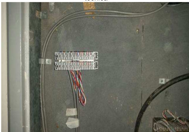
Figura 59E: Blocos Barga - Caixa de telefonia geral
