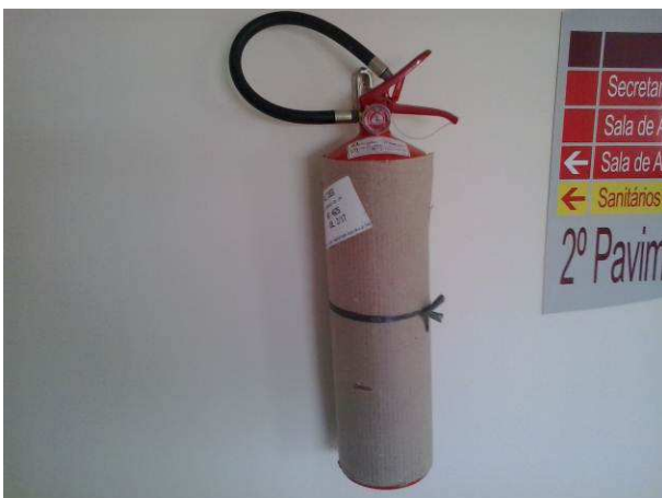
Figura 45C: Extintor ABC, instalado no segundo pavimento
