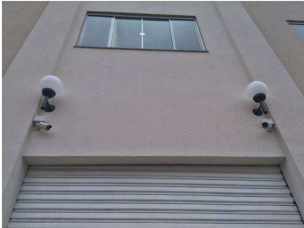
Figura 31E: luminárias externas fachada
