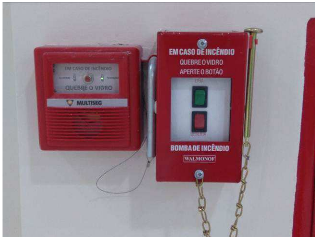
Figura 55E: acionadores manuais para acionamento e desligamento da bomba de combate à incêndio e para alarme de incêndio
