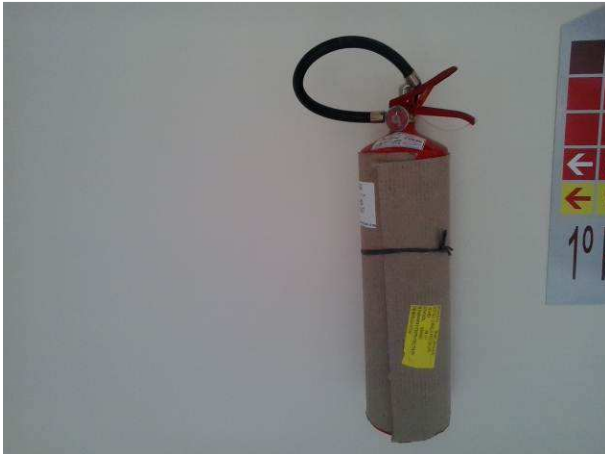
Figura 47C: Extintor ABC, instalado no primeiro pavimento
