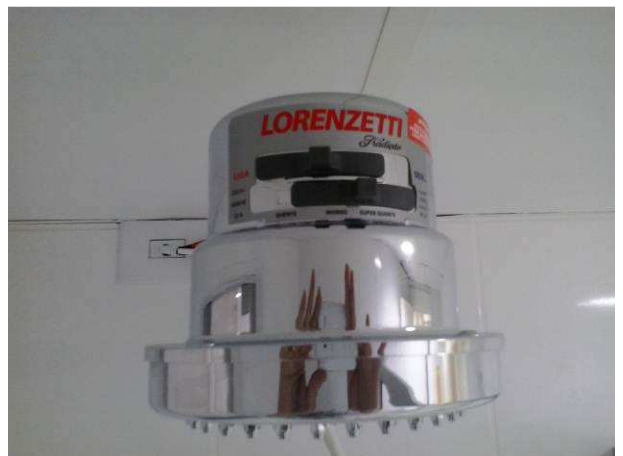
Figura 40C: Chuveiro elétrico instalado em banheiro de vestiário
