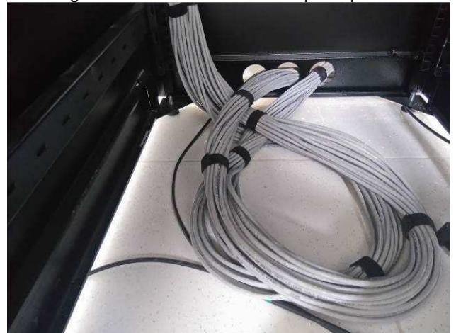
Figura 64E: racks e acessórios - cabeamento
