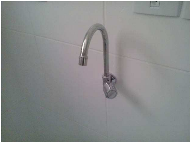
Figura 37C: Modelo de torneira de bica alta móvel, instalada nas copas do imóvel
