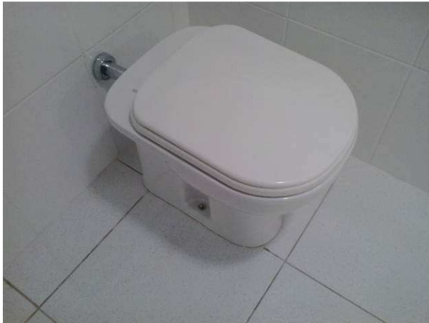
Figura 23C: Bacia de louça sanitária para PNE, instalada no térreo
