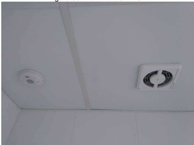
Figura 41E: sensor de presença, ventokits.
