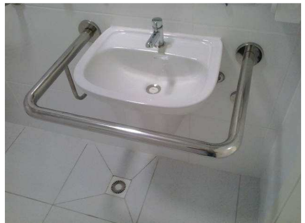
Figura 26C: Lavatório com coluna suspensa, instalado no BWC PNE do térreo
