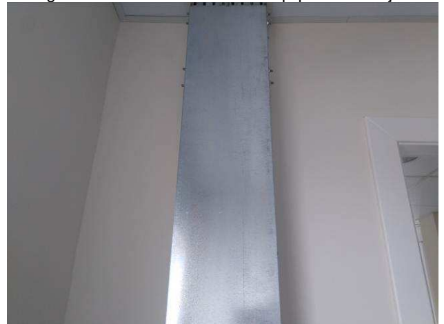
Figura 6E: eletrocalhas tampadas
