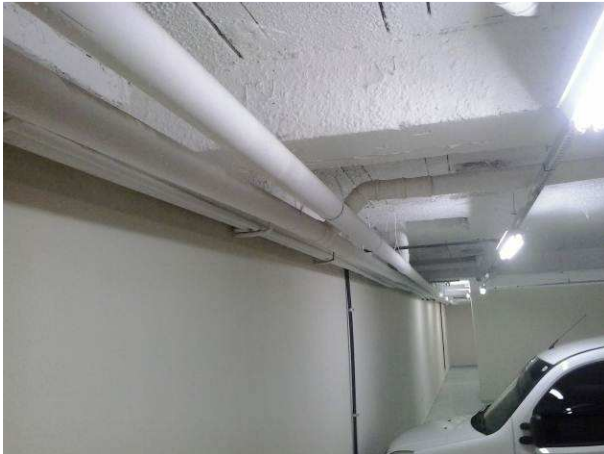
Figura 92C: Detalhe da tubulação exclusiva para drenagem pluvial do corredor lateral esquerdo do térreo (tubulação mais à direita, na imagem)
