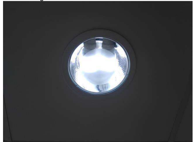
Figura 40E: luminárias 2x20W
