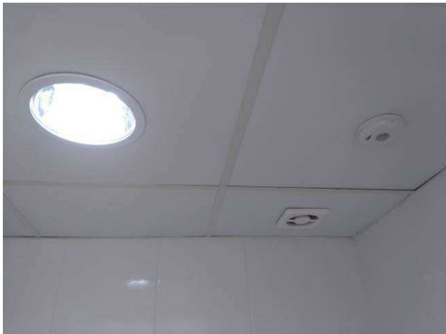
Figura 45E: sensor de presença, ventokits, luminárias 2x20W.
