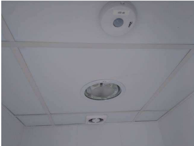
Figura 43E: sensor de presença, ventokits, luminárias 2x20W.
