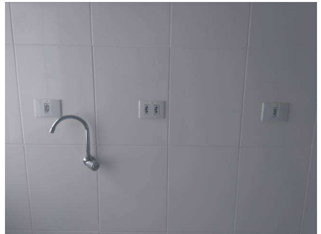
Figura 14E: interruptores e tomadas elétricas de embutir
