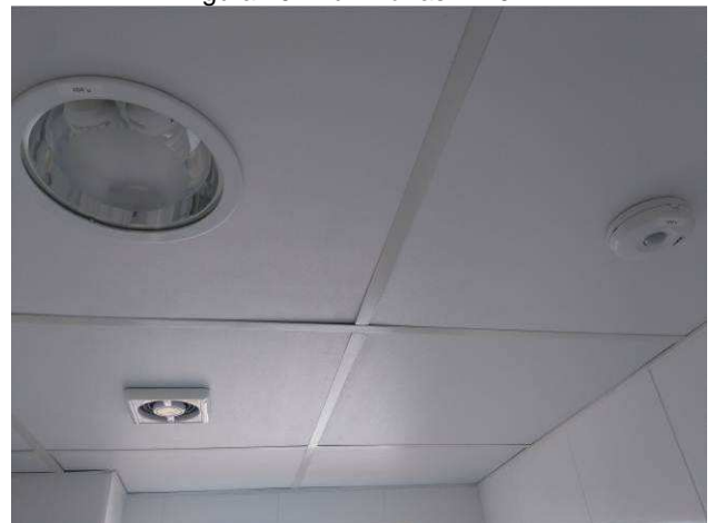
Figura 42E: sensor de presença, ventokits, luminárias 2x20W.
