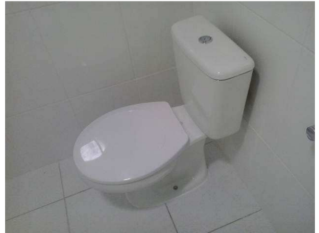
Figura 24C: Detalhe de vaso sanitário com assento, instalado nos banheiros comuns
