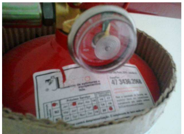
Figura 46C: Verificação da carga e prazo de validade do extintor
