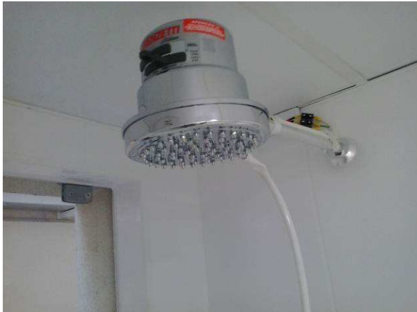
Figura 41C: Chuveiro elétrico instalado em banheiro de vestiário
