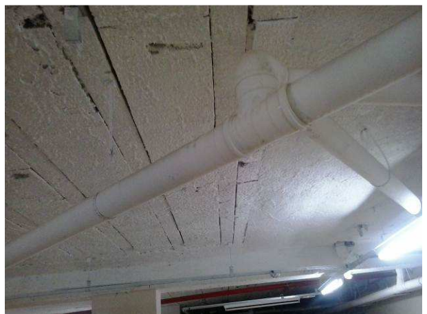
Figura 91C: Detalhe da tubulação exclusiva para drenagem pluvial do corredor lateral esquerdo do térreo
