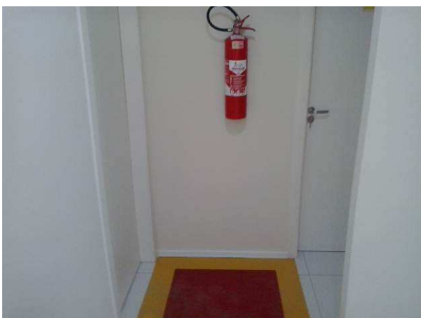
Figura 51C: Detalhe da sinalização de piso
