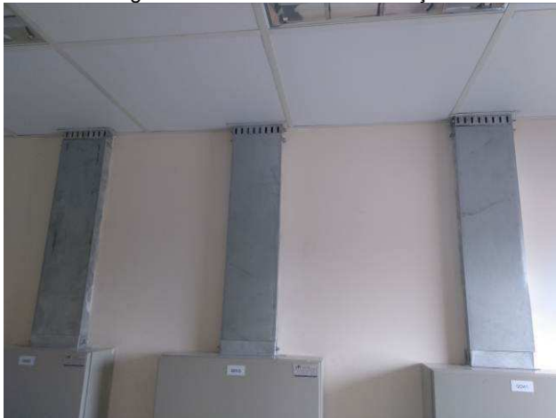
Figura 5E: eletrocalhas tampadas
