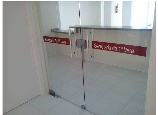
Figura 78C: Adesivos instalados nas portas de vidro
