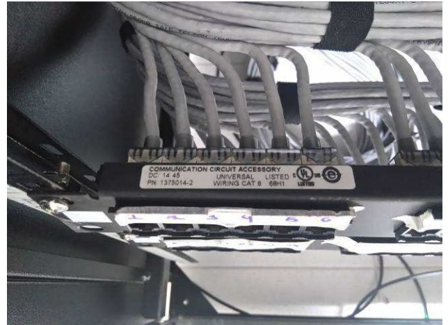
Figura 62E: racks e acessórios - patch panel
