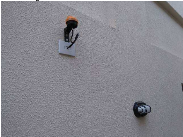
Figura 33E: luminárias externas laterais e fundos; relé fotoelétrico
