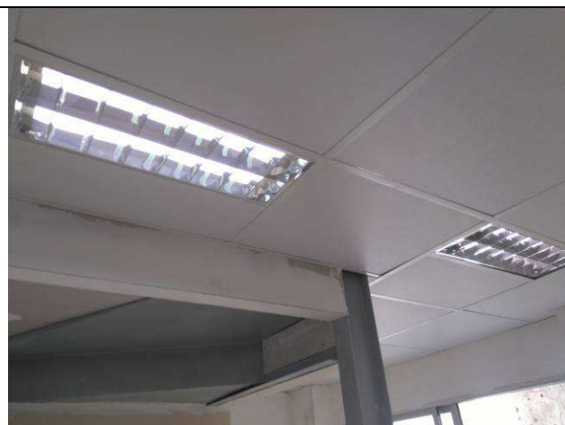
Figura 19E: iluminação interna - luminárias 2x10 LED; blocos de emergência
