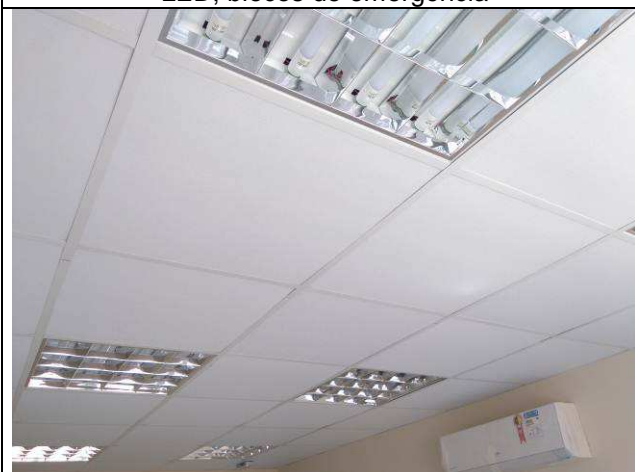
Figura 15E: iluminação interna - luminárias 4x10 LED; blocos de emergência
