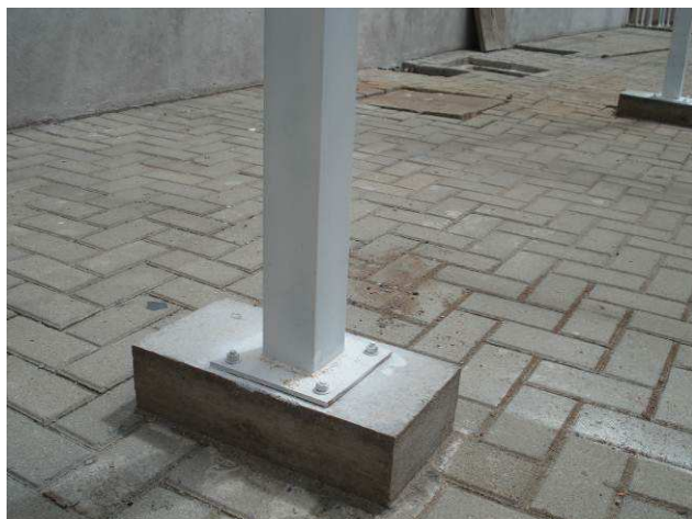
Figura 31C: Detalhe de pilar soldado em placa de aço. Placa parafusada a bloco de concreto.
