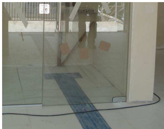
Figura 11C: Pendente instalação de mola hidráulica.
