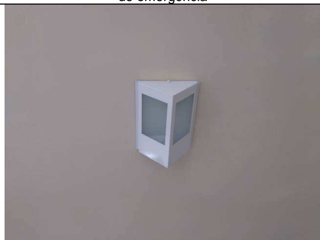
Figura 23E: iluminação interna - arandelas
