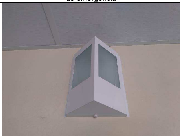
Figura 24E: iluminação interna - arandelas
