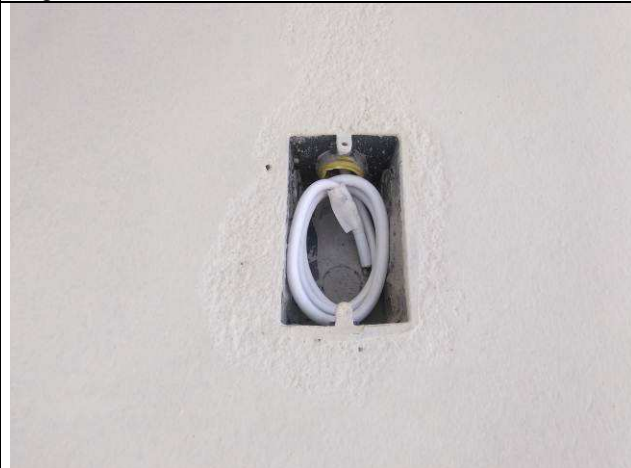
Figura 39E: cabejamento coaxial CFTV; caixas 2x4"
