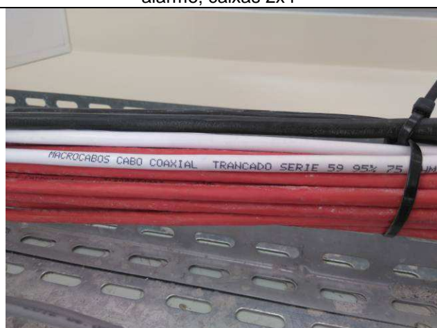
Figura 36E: cabeamento coaxial CFTV
