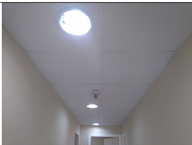
Figura 20E: iluminação interna - luminárias; blocos de emergência
