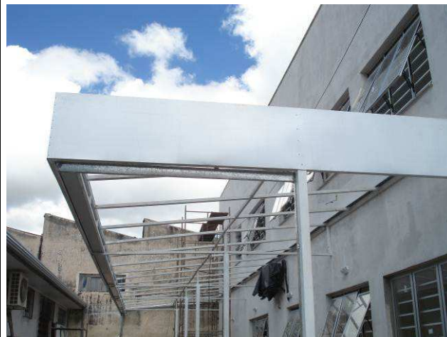
Figura 40C: Calhas (embutidas na testeira) e condutor instalados na cobertura do estacionamento lateral esquerdo.
