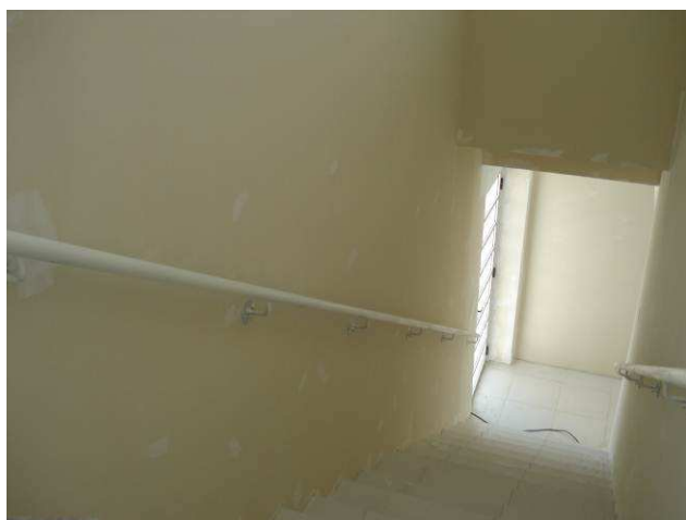
Figura 67C: Pintura em parede da escada em alvenaria executada em tinta látex acrílica, cor palha, marca Acrillínea. Nessa área, permanece pendente a aplicação da 2ª demão.
