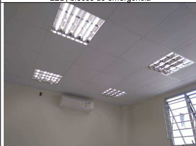
Figura 17E: iluminação interna - luminárias 4x10 LED; blocos de emergência
