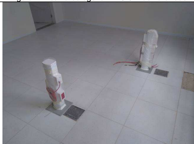
Figura 4E: totens das salas de audiências - tomadas e porta equipamentos
