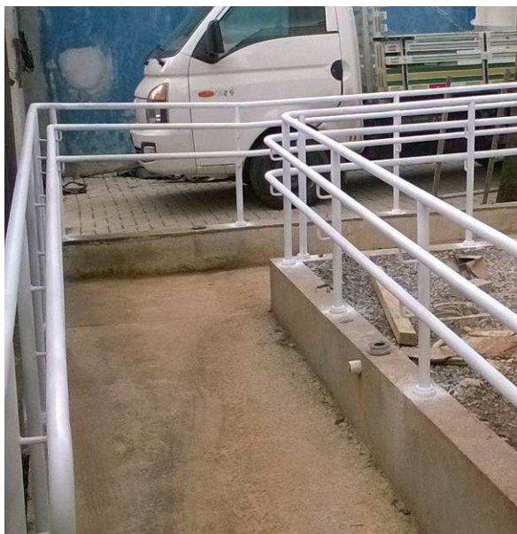
Figura 62C: Guarda corpo e corrimão executados junto à rampa PNE. Pendente instalação de barras transversais intermediárias (abaixo do corrimão).
