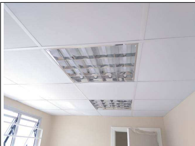
Figura 13E: iluminação interna - luminárias 4x10 LED; blocos de emergência
