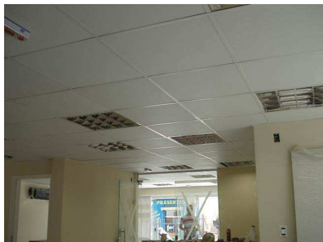
Figura 44C: Forro em placa de gesso acartonado removível (0,625x0,625 m) instalado na área da Secretaria.
