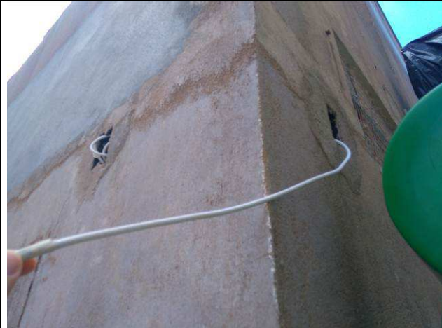
Figura 37E: cabejamento coaxial CFTV; caixas 2x4"
