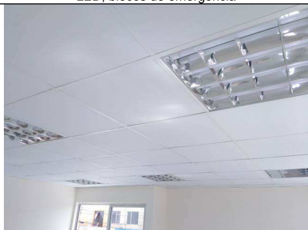
Figura 16E: iluminação interna - luminárias 4x10 LED; blocos de emergência
