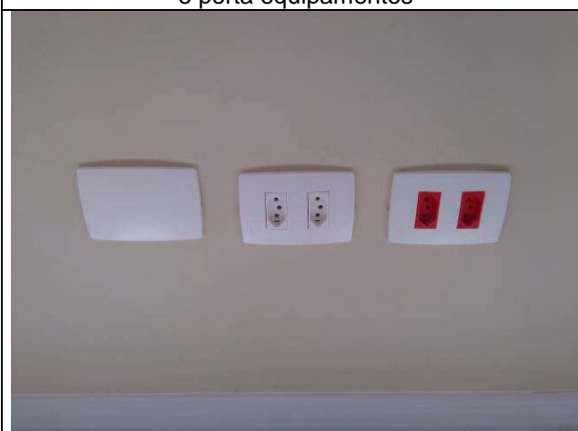
Figura 5E: tomadas elétricas de parede pav. superior - Enerbrás Reale
