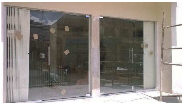
Figura 13C: Instaladas 2 portas PJ1A de vidro temperado incolor (10mm) no acesso principal do edifício.
