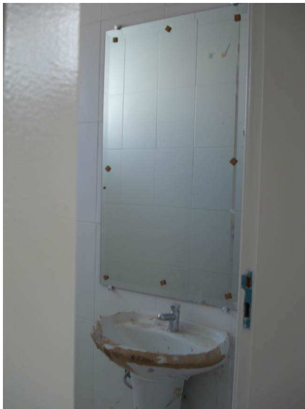
Figura 61C: Espelho cristal ( e=5 mm), com bisotê de 1,5 cm, instalado no banheiro do gabinete de juiz I.
