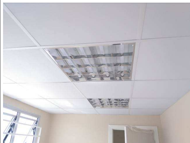
Figura 47C: Forro em placa de gesso acartonado removível (0,625x0,625 m) instalado na sala de assistentes de juiz (pav. superior).
