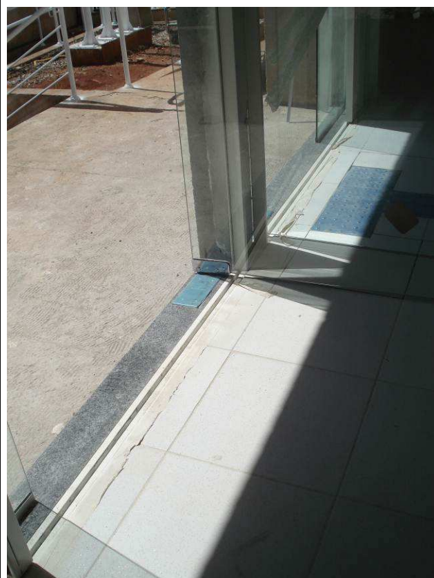
Figura 56C: Soleiras em granito polido cinza andorinha instalado junto às portas PJ1A do pavimento térreo (entrada principal térreo).
