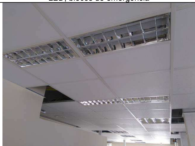
Figura 18E: iluminação interna - luminárias 2x10 LED; blocos de emergência
