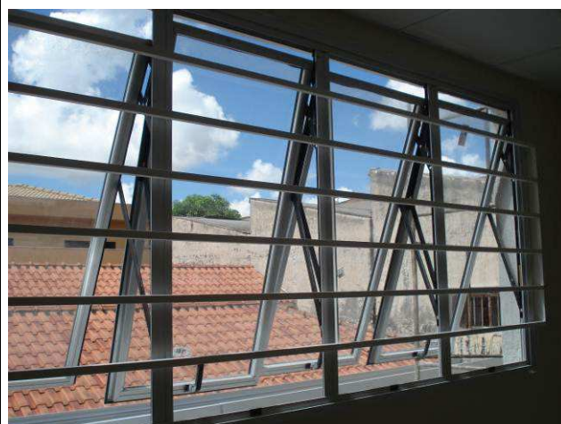
Figura 23C: Gradil em ferro tubular instalado junto à janela da sala de assistentes de juízes.
