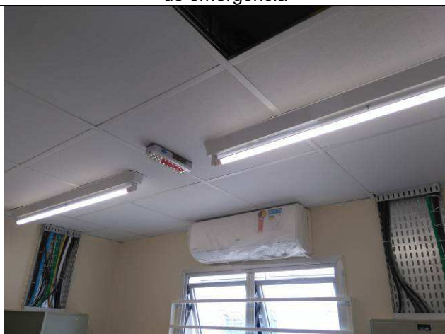
Figura 22E: iluminação interna - luminárias; blocos de emergência
