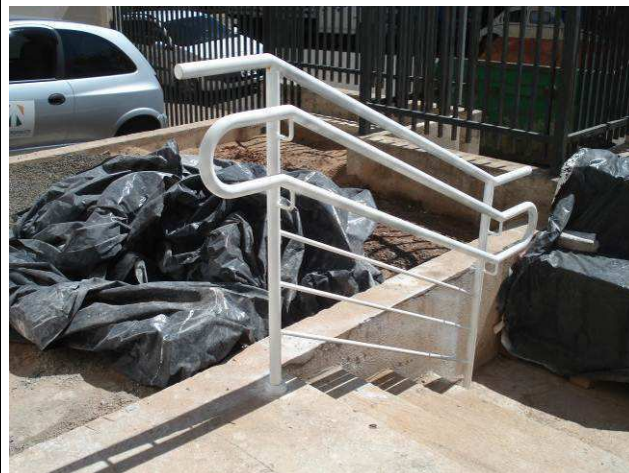
Figura 63C: Guarda corpo e corrimão executados junto à escada externa de acesso ao edifício.
