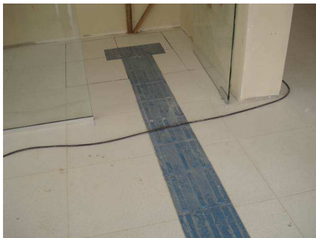
Figura 49C: Placas de piso podotátil em porcelanato (e=2mm), marca Eliane, instaladas no trajeto de acesso ao balcão de atendimento.
