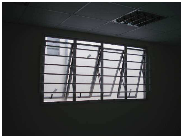
Figura 20C: Gradil em ferro tubular instalado junto à janela do gabinete I.
