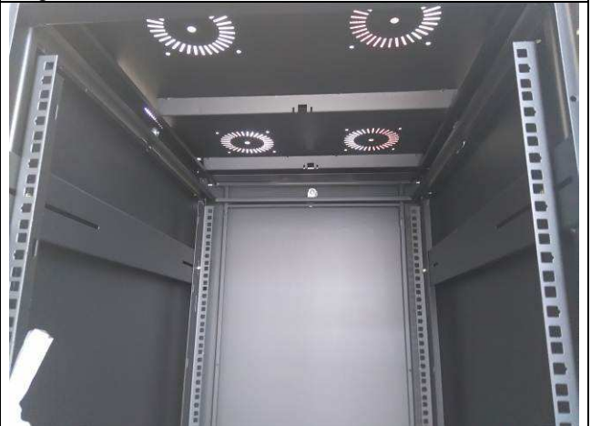
Figura 40E: rack telecomunicações
