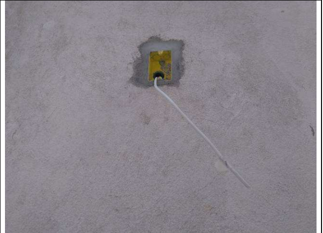
Figura 38E: cabejamento coaxial CFTV; caixas 2x4"
