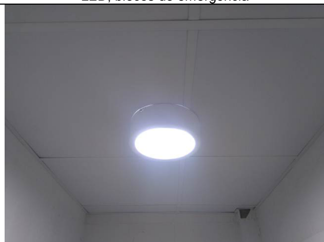
Figura 21E: iluminação interna - luminárias; blocos de emergência
