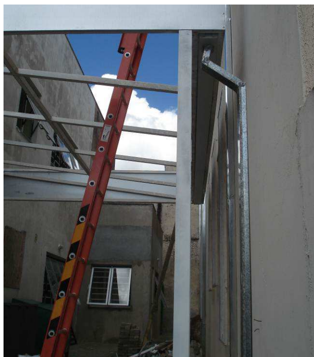
Figura 41C: Calhas e condutor instalados na cobertura da vaga privativa de juiz.
