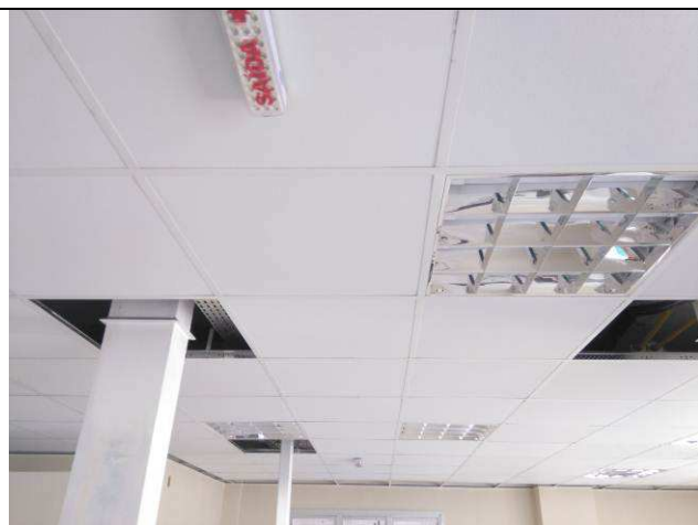
Figura 14E: iluminação interna - luminárias 4x10 LED; blocos de emergência
