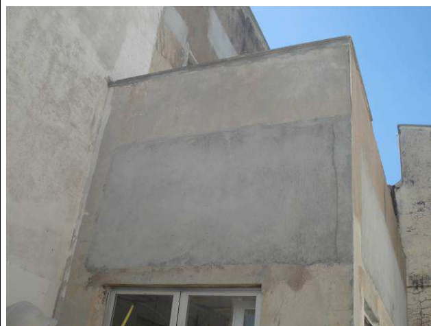
Figura 24C: Chapisco e emboço executados na lateral direita do imóvel (área abrangidas pela correção das trincas).
