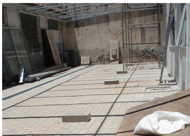
Figura 22C: Blocos de concreto em dimensão 20x40x30 na cobertura do estacionamento lateral esquerdo.
