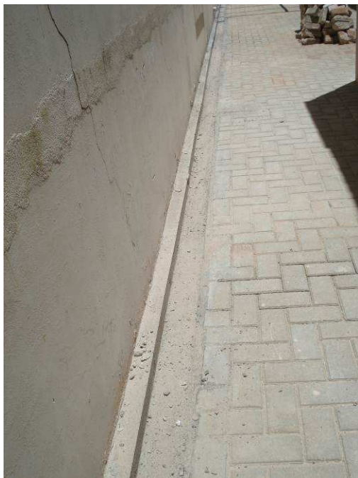
Figura 34C: Canaleta em concreto para escoamento de águas pluviais, executada com largura de 15 cm, na lateral direita do imóvel.
