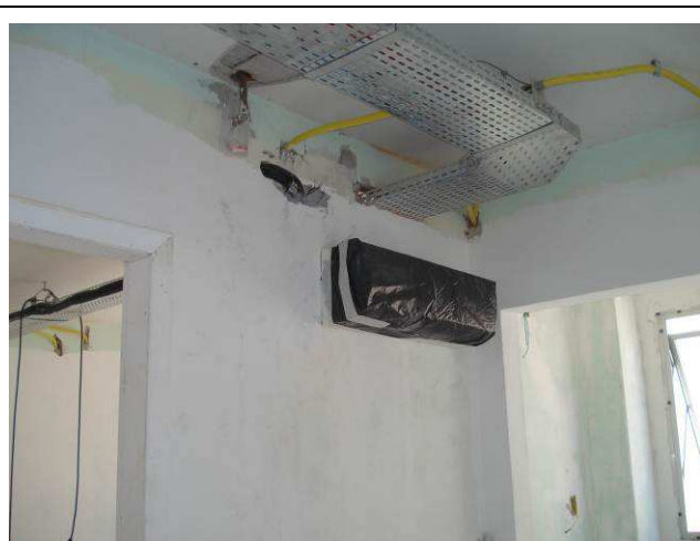
Figura 41C: Equipamento de ar condicionado instalado no hall público do pavimento superior (Fujitsu 12.000 BTUs).
