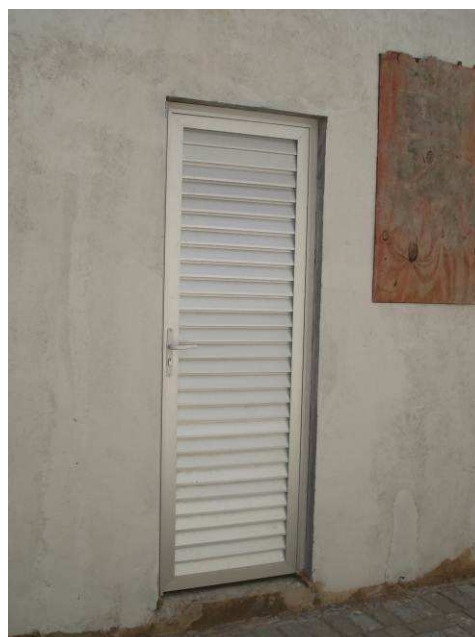
Figura 18C: Porta de abrir P06, em veneziana metálica, instalada no acesso ao depósito (sob a escada).
