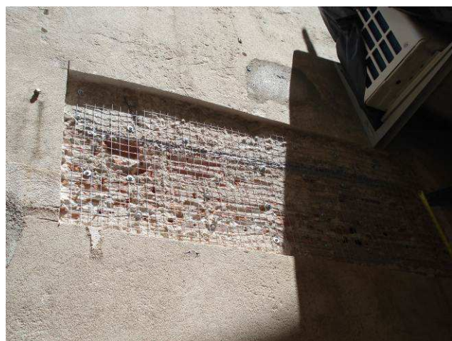
Figura 07C: Remoção de argamassa (faixa de 50 cm de largura) em área onde haverá correção de trincas, na parede dos fundos (lado externo).
