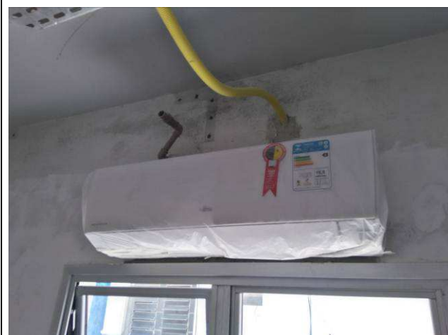
Figura 39C: Equipamento de ar condicionado instalado na Secretaria (Fujitsu 30.000 BTUs).
