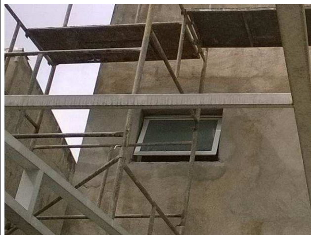
Figura 10C: Peitoril removido na janela do gabinete de juiz I.
