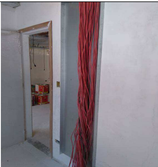
Figura 03E: eletrocalhas lisa para descida cabeamento UTP - rack.
