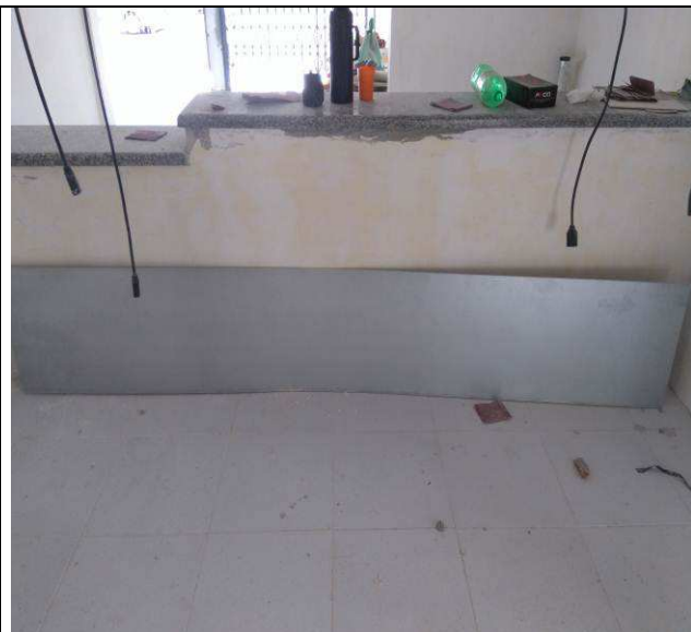
Figura 04E: tampa para eletrocalhas de descida cabeamento UTP - rack.
