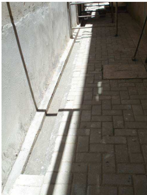
Figura 32C: Canaleta em concreto para escoamento de águas pluviais, executada com largura de 15 cm, nos fundos do imóvel.
