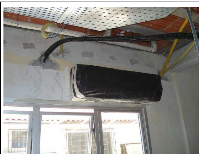
Figura 37C: Rede frigorígena em tubo de cobre, com respectivo isolamento térmico, trecho interno.
