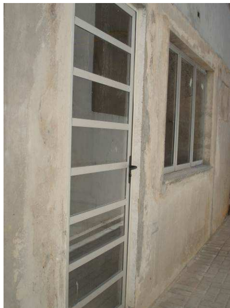
Figura 16C: Porta P04 de alumínio e vidro, instalada no acesso lateral da Secretaria.
