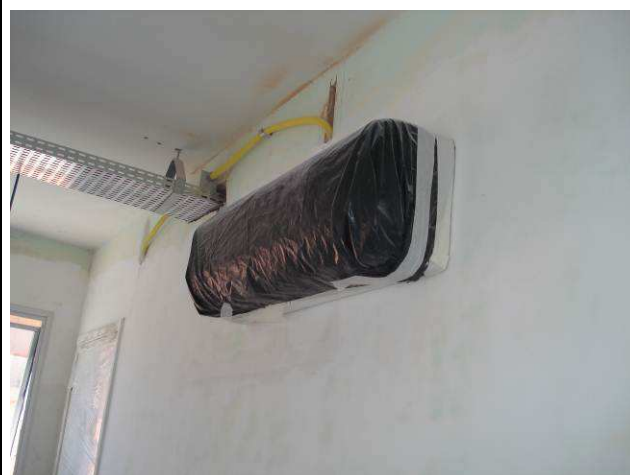
Figura 40C: Equipamento de ar condicionado instalado no gabinete de juiz I (Fujitsu 12.000 BTUs).
