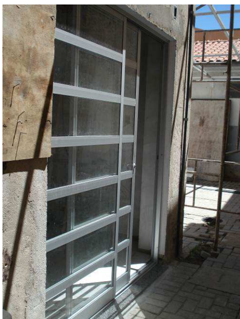
Figura 17C: Porta de correr PJ3, em duas folhas, instalada na copa.
