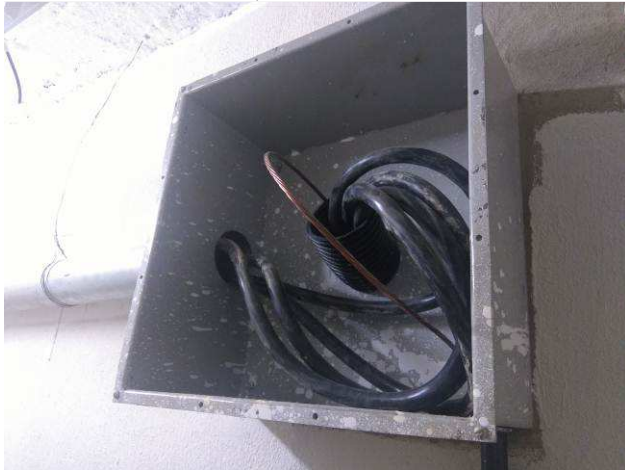
Figura 15E: entrada de energia em tensão primária - caixa 50x50cm
