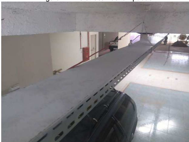
Figura 23E: eletrocalhas tampadas
