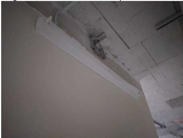
Figura 51E: luminárias 1x32 e 2x32 pavimento subsolo
