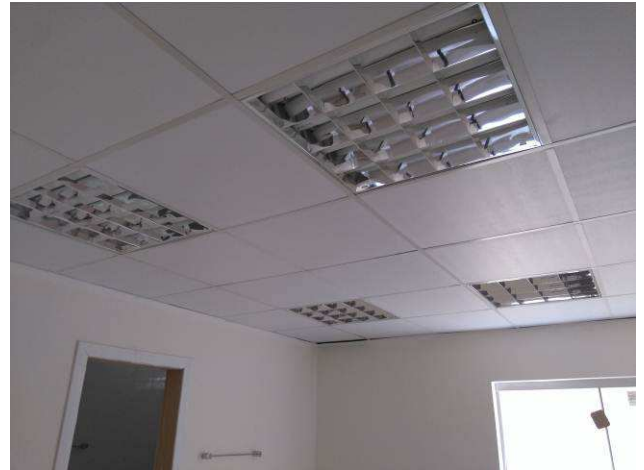
Figura 44E: luminárias 4x16 e 2x20 1º pavimento
