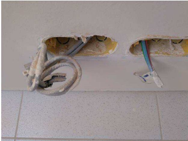
Figura 61E: cabeamento UTP e infraestrutura térreo
