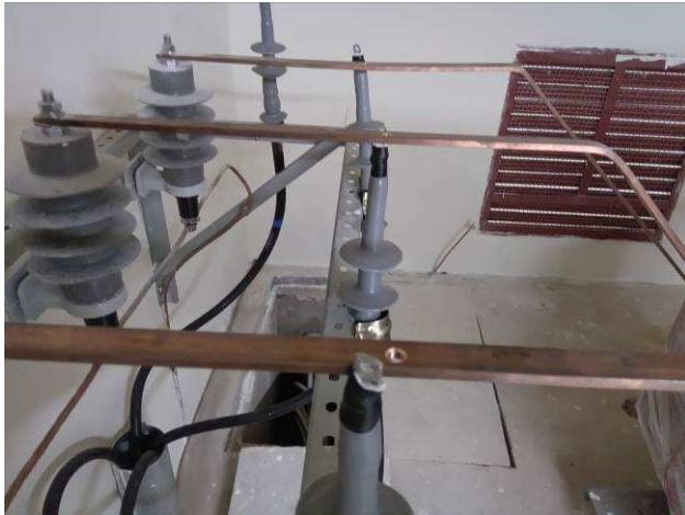
Figura 13E: entrada de energia em tensão primária - muflas, cabos AT 35mm 2
