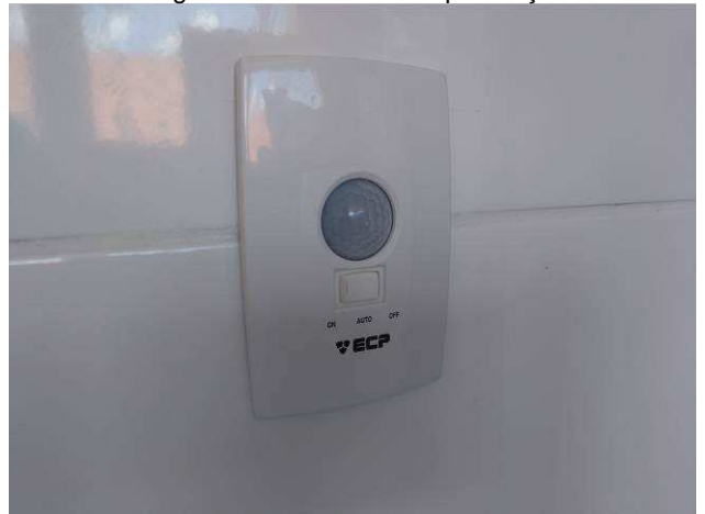
Figura 54E: sensores de presença
