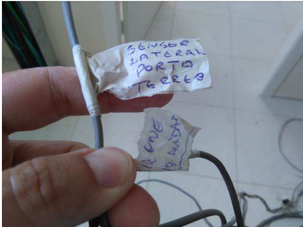
Figura 73E: cabeamento para alarme patrimonial
