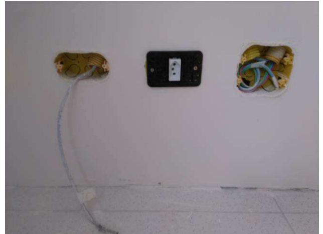
Figura 62E: cabeamento UTP e infraestrutura térreo
