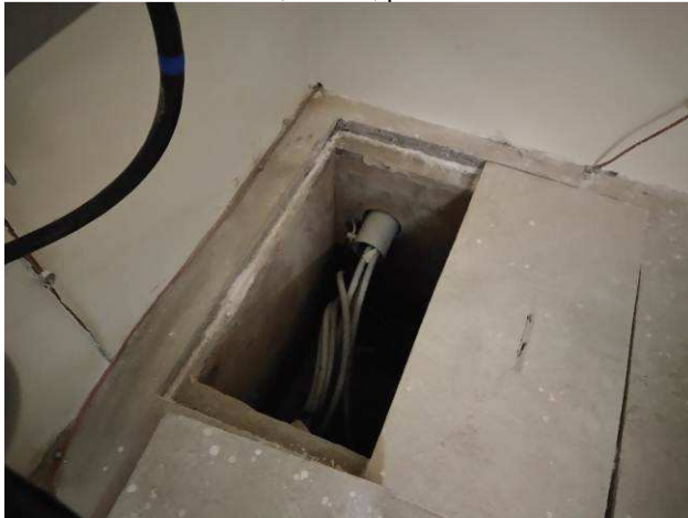
Figura 9E: entrada de energia em tensão primária - cabos AT 35mm²
