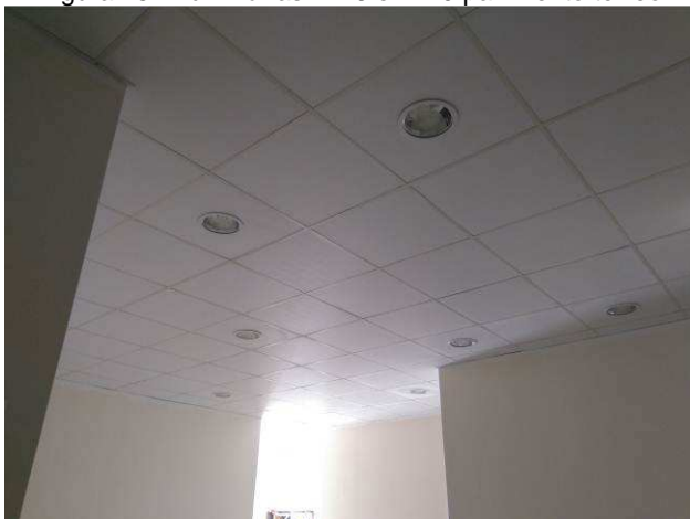
Figura 47E: luminárias 4x16 e 2x20 pavimento térreo
