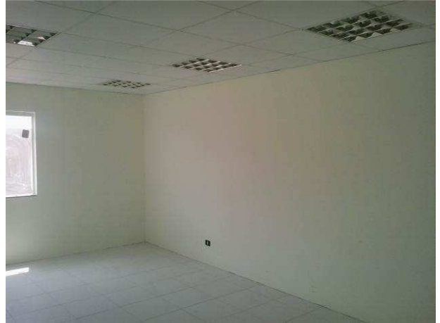
Figura 84C: Segunda demão de pintura das paredes do segundo pavimento - em detalhe, sala de audiência 2
