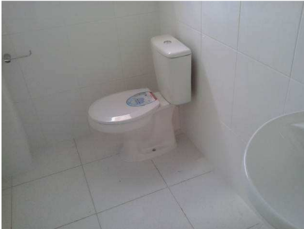
Figura 61C: bacia de louça sanitária c/ caixa acoplada instalada no banheiro do juiz auxiliar - 2º pavimento
