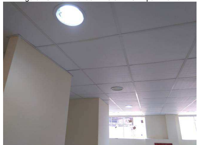
Figura 42E: luminárias 4x16 e 2x20 1º pavimento
