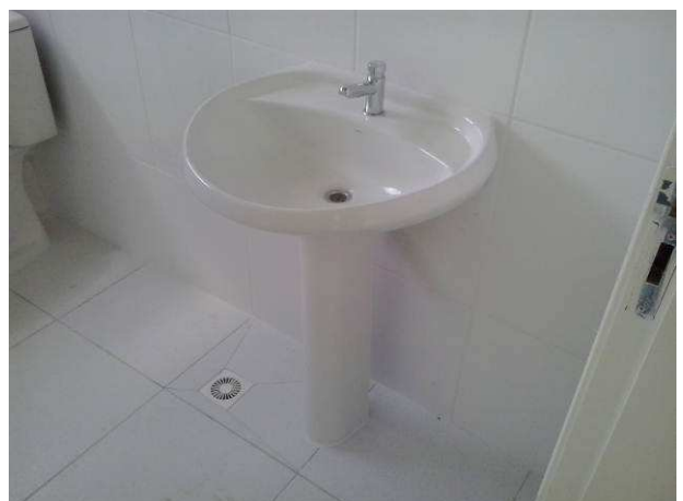
Figura 66C: Lavatório com coluna, linha Deca Ravena, instalado no sanitário do gabinete do juiz titular, 2º pavimento
