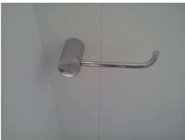
Figura 65C: papelreira em metal cromado instalado em sanitário do segundo pavimento
