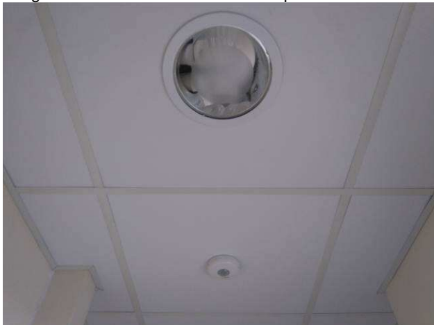
Figura 53E: sensores de presença
