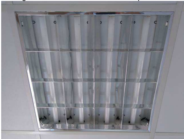
Figura 39E: luminárias 4x16 e 2x20 2º pavimento
