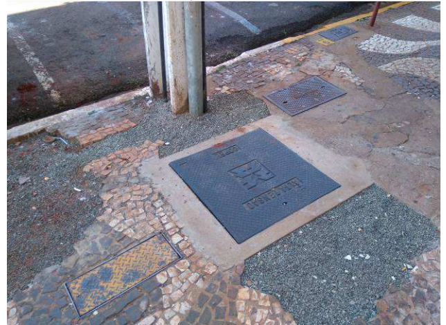
Figura 10E: entrada de energia em tensão primária - caixa 80x80cm, cabos AT 35mm²
