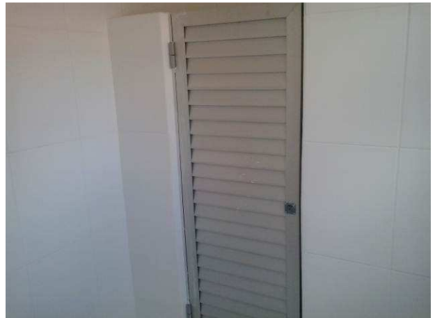
Figura 24C: Outra porta de alumínio em boxe de banheiro público, no primeiro pavimento
