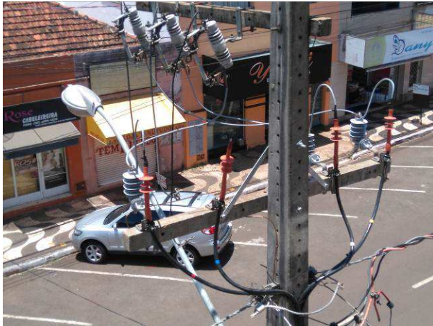
Figura 7E: entrada de energia em tensão primária - cruzeta, mulfas, para-raios
