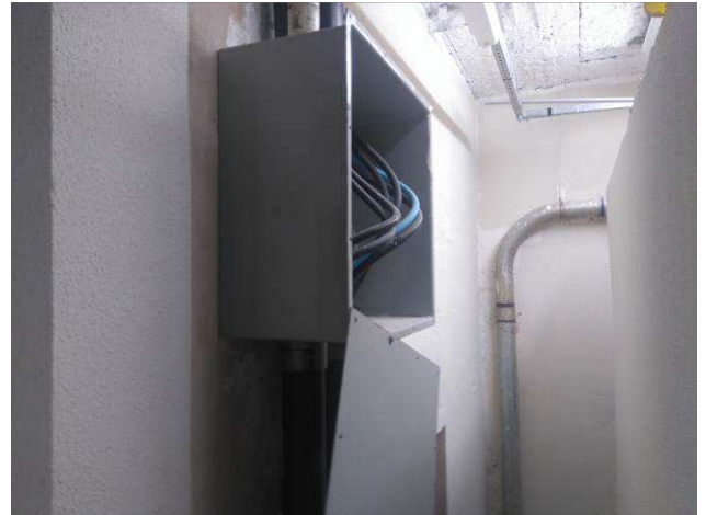
Figura 14E: entrada de energia em tensão primária - caixa 50x50cm
