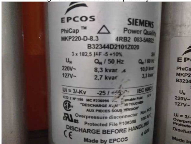
Figura 57E: banco de capacitores
