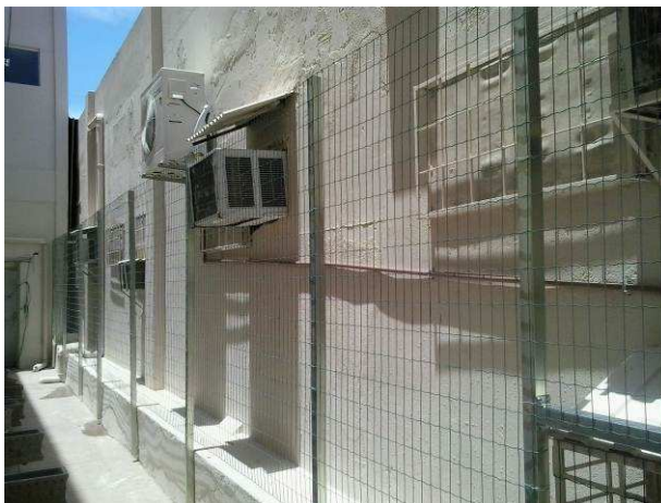
Figura 89C: Painel em tela soldada com revestimento em PVC instalado junto à divisa, no corredor lateral esquerdo do imóvel
