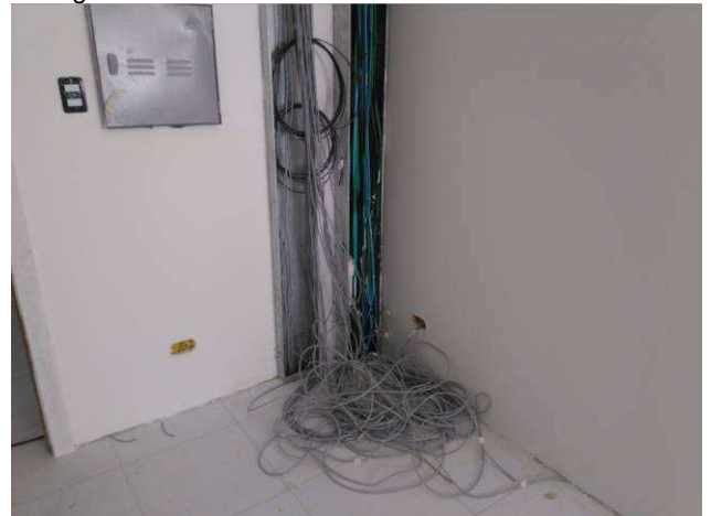
Figura 64E: cabeamento UTP e infraestrutura térreo
