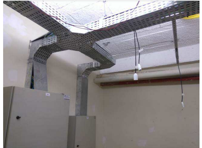
Figura 20E: eletrocalhas tampadas
