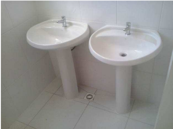
Figura 55C: Lavatórios de louça com coluna instalados em sanitário público do primeiro pavimento
