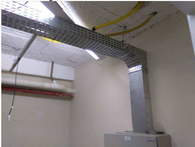
Figura 21E: eletrocalhas tampadas
