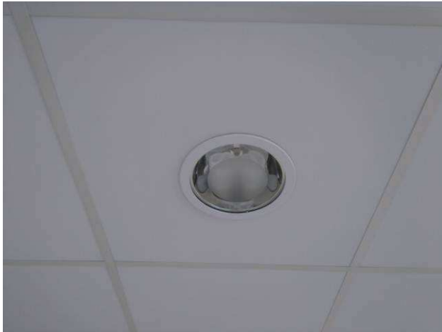
Figura 37E: luminárias 4x16 e 2x20 2º pavimento
