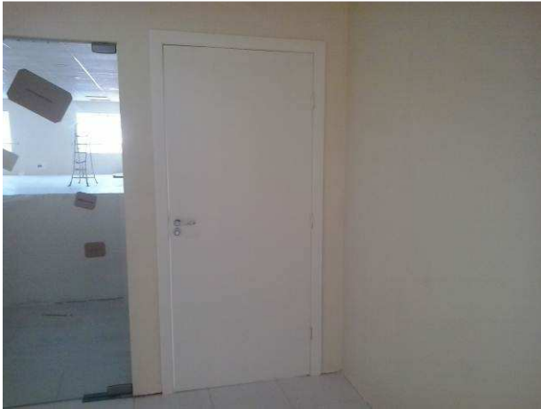
Figura 15C: Porta de madeira de acesso à sala de audiência 1, do primeiro pavimento
