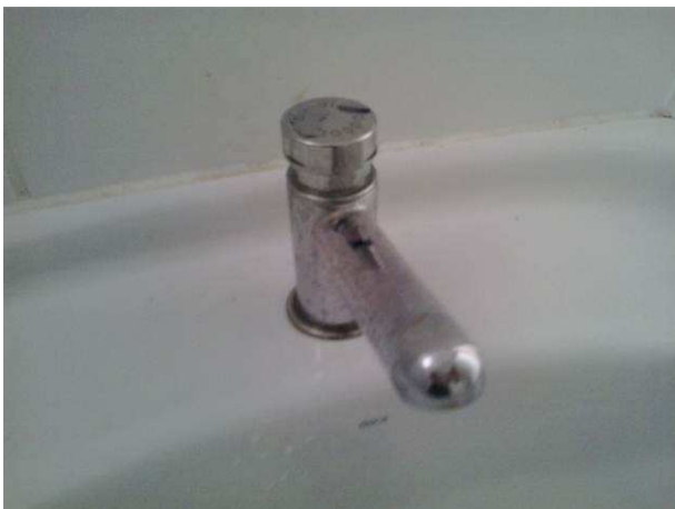
Figura 49C: Torneira metálica com fechamento automático instalada em lavatório na sala de perícia
