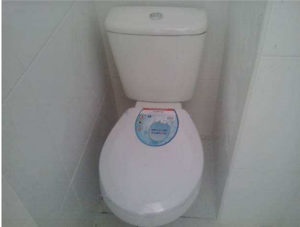
Figura 51C: Bacia de louça sanitária, com caixa acoplada instalada em sanitário público no primeiro pavimento
