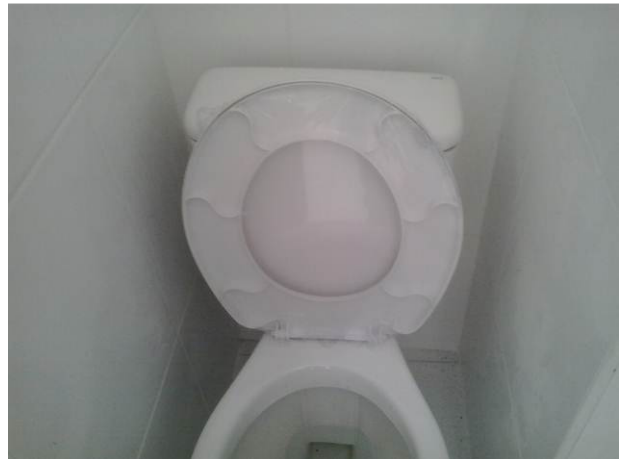
Figura 44C: Detalhe do assento sanitário instalado sobre a bacia de louça
