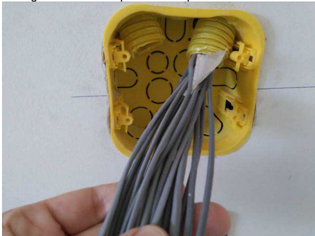
Figura 69E: cabeamento para alarme patrimonial
