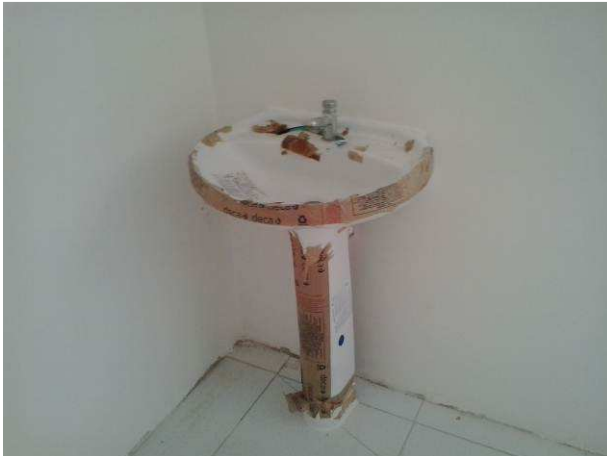
Figura 45C: Lavatório com coluna instalado na sala de perícia
