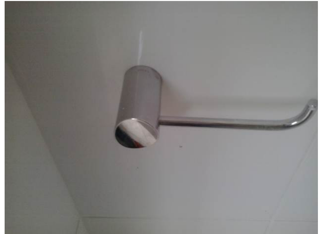
Figura 56C: Papeleira em metal cromado instalada em sanitário do primeiro pavimento
