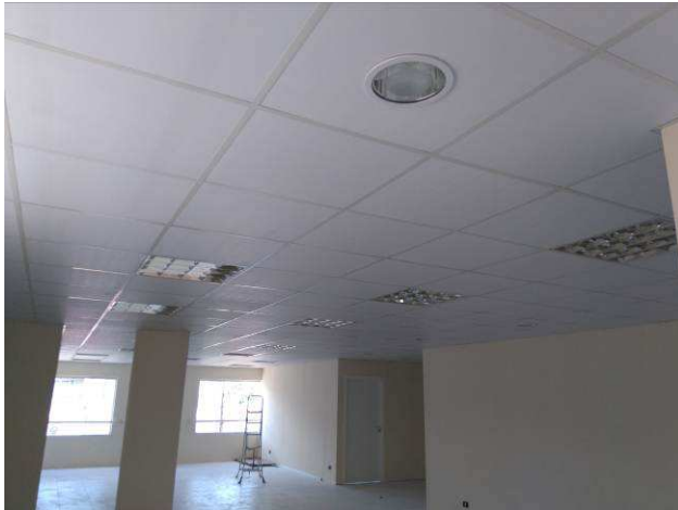
Figura 43E: luminárias 4x16 e 2x20 1º pavimento
