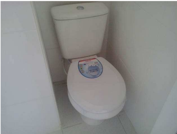
Figura 43C: Bacia de louça sanitária com acento instalada no banheiro da sala de perícia
