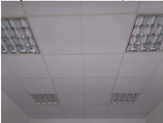
Figura 45E: luminárias 4x16 e 2x20 pavimento térreo
