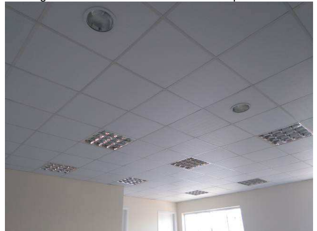
Figura 40E: luminárias 4x16 e 2x20 2º pavimento
