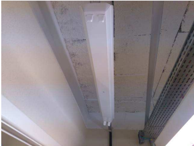
Figura 49E: luminárias 1x32 e 2x32 pavimento subsolo
