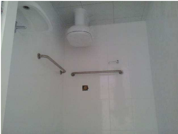
Figura 57C: barras de apoio para PNE, instaladas junto a bacia sanitária, no sanitário PNE do primeiro pavimento
