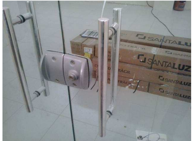
Figura 22C: Detalhe da fechadura e puxadores da porta de vidro de acesso ao balcão da secretaria
