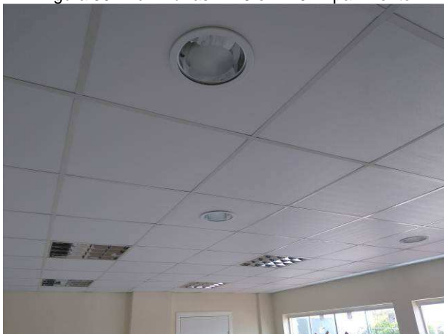
Figura 41E: luminárias 4x16 e 2x20 1º pavimento
