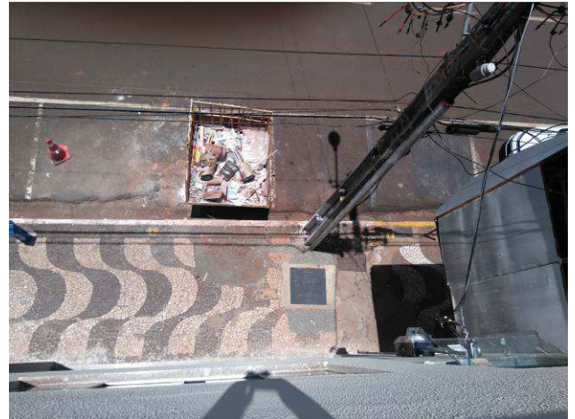
Figura 8E: entrada de energia em tensão primária - caixa 80x80cm, cabos AT 35mm²
