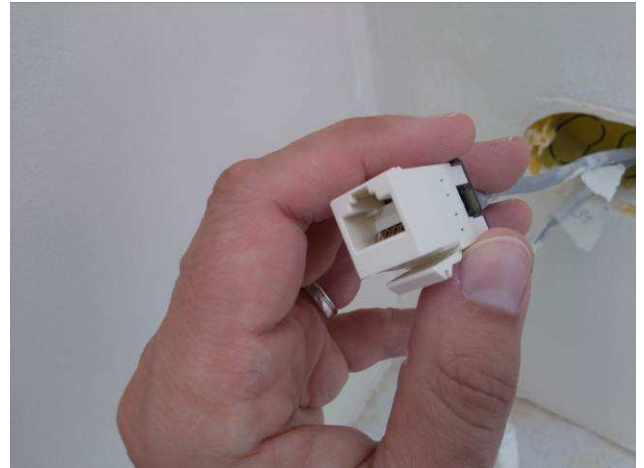
Figura 74E: conectores cat6 AMP - 2º pavimento
