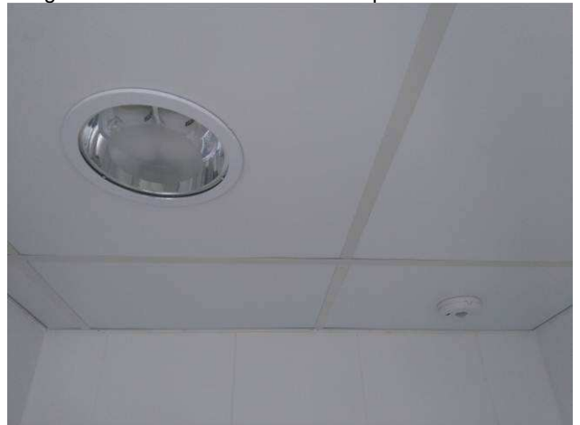
Figura 52E: sensores de presença
