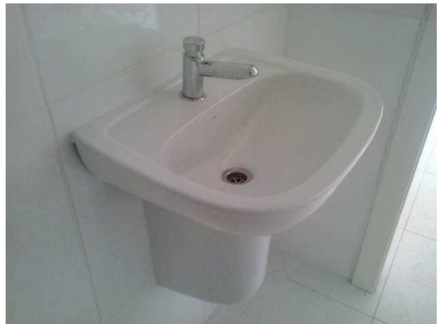
Figura 54C: Lavatório de louça para PNE, linha Deca Vogue Plus, instalado no sanitário PNE do primeiro pavimento
