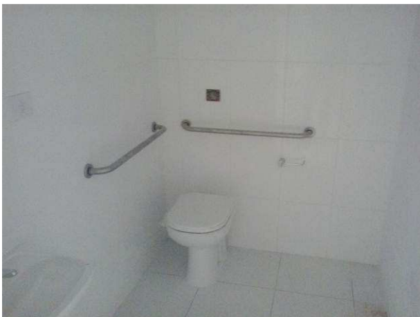
Figura 63C: Em detalhe, bacia de louça sanitária para PNE e barras de apoio instaladas no sanitário PNE do segundo pavimento
