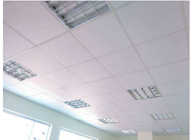
Figura 38E: luminárias 4x16 e 2x20 2º pavimento
