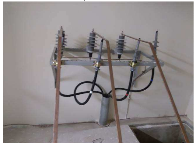
Figura 12E: entrada de energia em tensão primária - mulfas, cabos AT.
