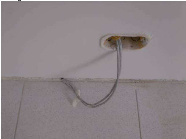
Figura 63E: cabeamento UTP e infraestrutura térreo
