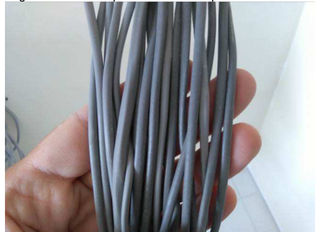
Figura 70E: cabeamento para alarme patrimonial
