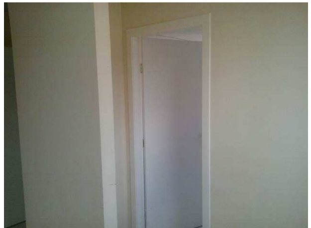
Figura 80C: Detalhe da pintura das portas de madeira do primeiro pavimento - sanitários públicos
