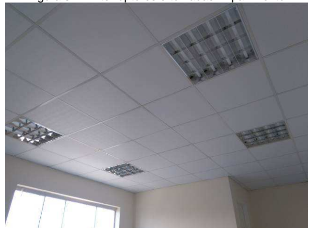
Figura 36E: luminárias 4x16 e 2x20 2º pavimento
