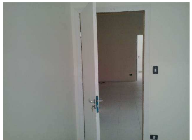
Figura 02C: Porta de madeira prevista em planilha para instalação no subsolo, mas instalada no pavimento térreo.
