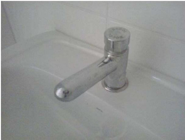
Figura 67C: Torneira de pressão, com desligamento automático, instalada em sanitário do segundo pavimento
