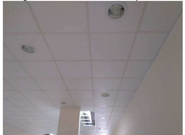
Figura 46E: luminárias 4x16 e 2x20 pavimento térreo
