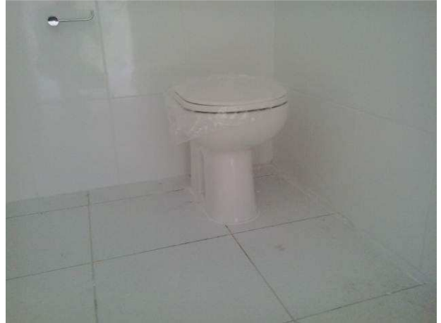
Figura 52C: Bacia de louça sanitária para PNE, linha Deca Vogue Plus instalada no sanitário PNE do primeiro pavimento
