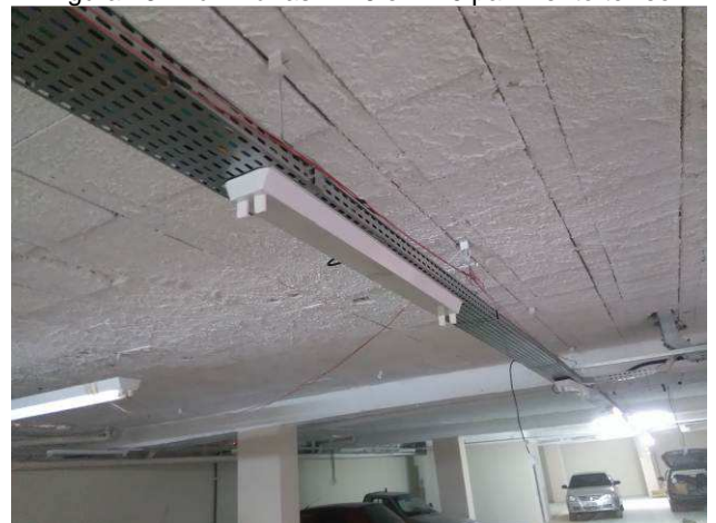
Figura 48E: luminárias 1x32 e 2x32 pavimento subsolo
