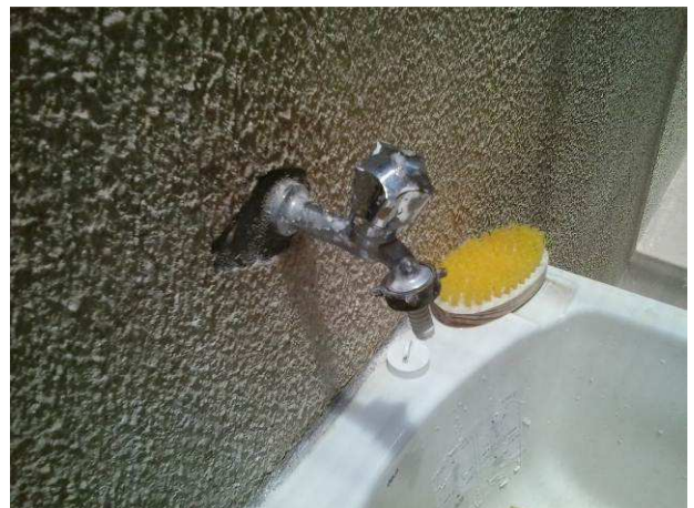
Figura 50C: torneira metálica de uso geral, instalada no tanque
