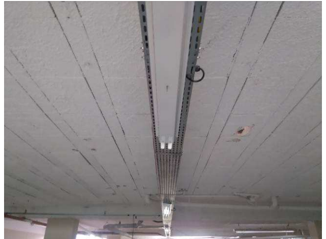
Figura 50E: luminárias 1x32 e 2x32 pavimento subsolo
