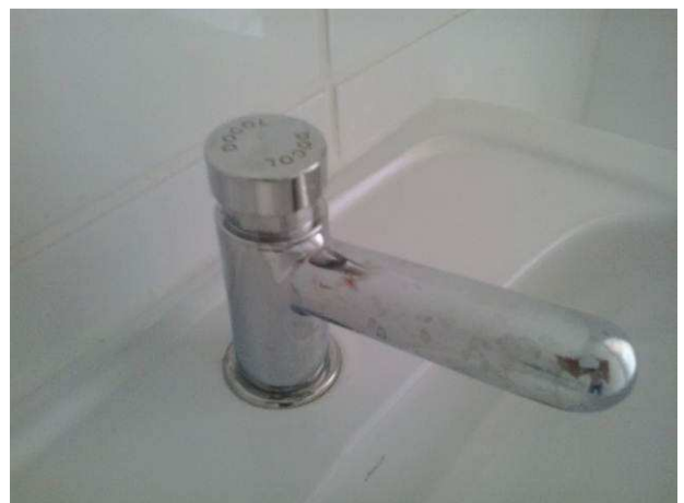
Figura 60C: Torneira de pressão cromada com fechamento automático, instalada em sanitário do primeiro pavimento
