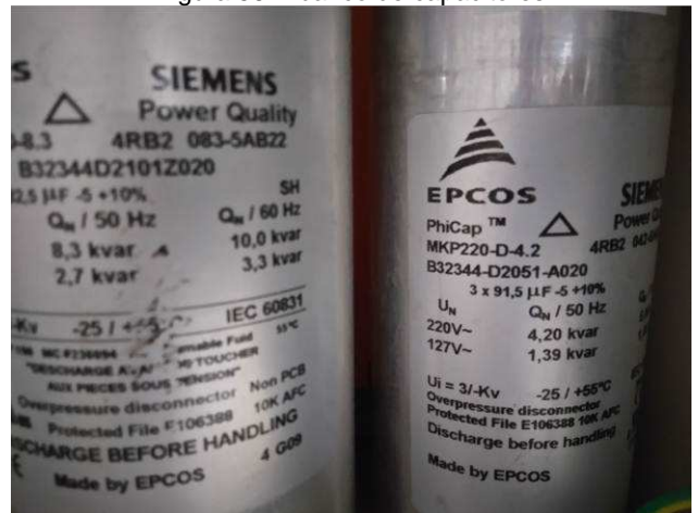
Figura 58E: banco de capacitores
