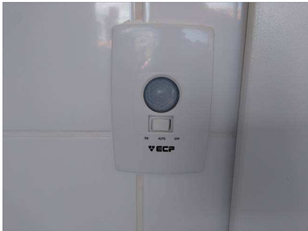
Figura 55E: sensores de presença
