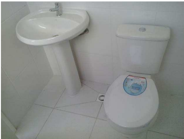
Figura 53C: Conjunto de bacia sanitária e lavatório com coluna, instalados em banheiro da secretaria, no primeiro pavimento
