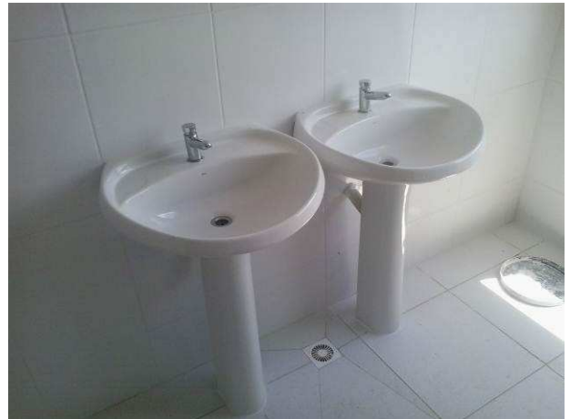
Figura 68C: Lavatórios com coluna, instalados em sanitário público do segundo pavimento
