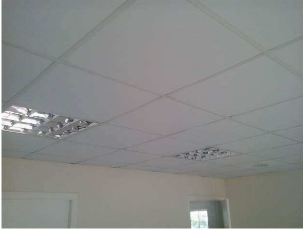
Figura 37C: Forro de gesso acartonado instalado na sala de audiência principal do segundo pavimento
