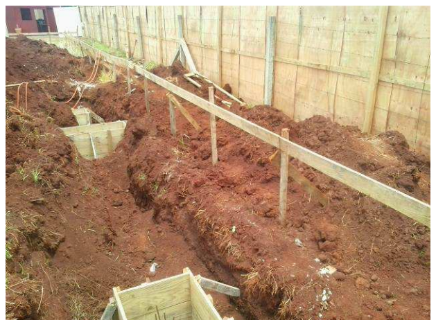
Figura 24C: Escavação de valas para execução de blocos de fundação e vigas baldrame
