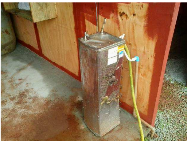
Figura 11C: Bebedouro instalado no refeitório
