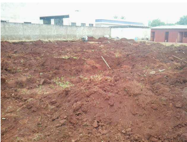
Figura 23C: Escavação de valas para execução de blocos de fundação e vigas baldrame
