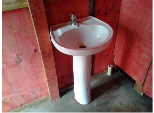
Figura 04C: Lavatório instalado nos sanitários dos funcionários
