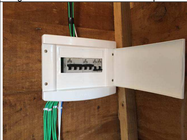
Figura 11C: Barracão de obra - quadro de disjuntores.
