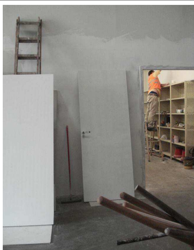
Figura 05C: Fechamento parcial de vão de porta existente na sala da informática, à esquerda da doca 05, em gesso acartonado simples.
