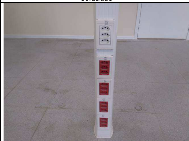
Figura 13E: tomadas padrão Dutotec.
