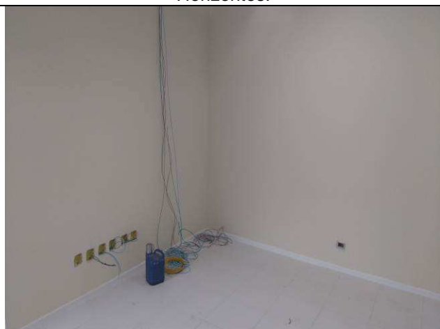
Figura 06E: Infraestrutura elétrica - caixas 2x4", 4x4" e eletrodutos.
