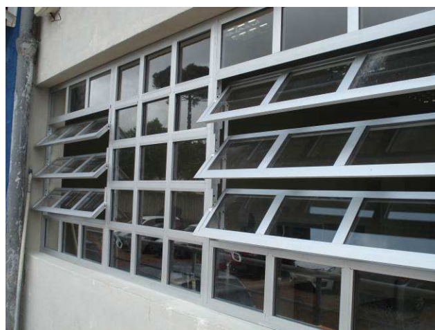
Figura 34C: Janela basculante em alumínio, instalada na Secretaria do Projeto Horizontes.
