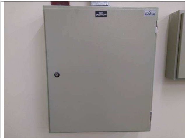
Figura 33E: Quadro QDC7 com novos circuitos.
