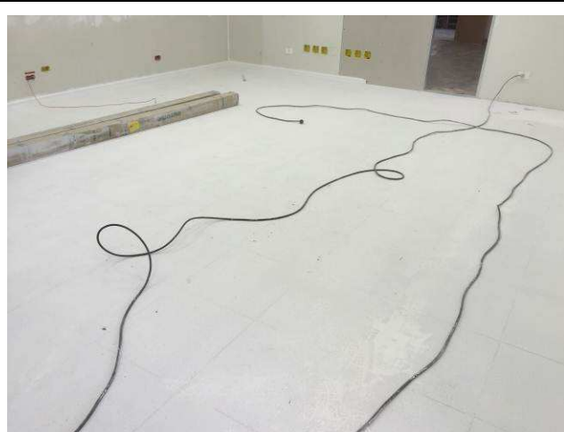
Figura 14C: Piso cerâmico Eliane, linha Cargo Plus, cor branca, assentado na secretaria do Projeto Horizontes.
