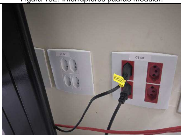
Figura 20E: tomadas elétricas.
