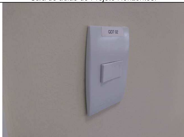
Figura 24E: alteração acionamento interruptores - Gabinete STI.
