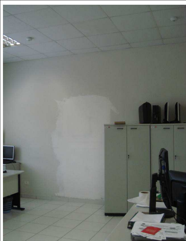
Figura 06C: Fechamento de vão de porta existente na sala da informática, divisa com Projeto Horizontes, executado em gesso acartonado simples.
