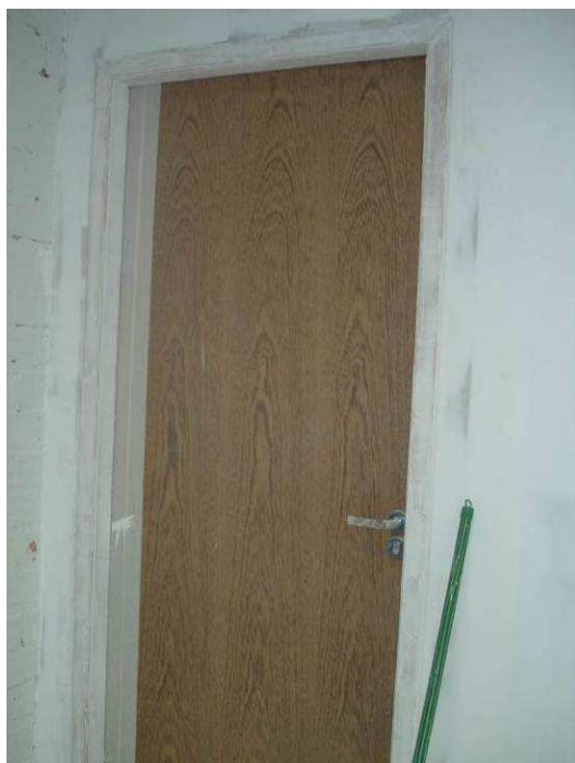
Figura 30C: Porta PM 80 instalada na Secretaria do Projeto Horizontes.
