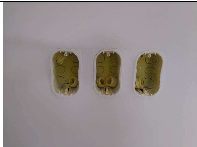
Figura 07E: Infraestrutura elétrica - caixas 2x4", 4x4" e eletrodutos.
