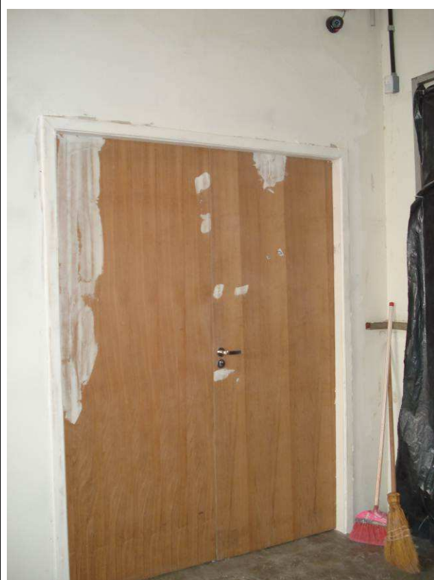
Figura 33C: Porta PM 160 instalada na sala da informática, com acesso pela doca 05.
