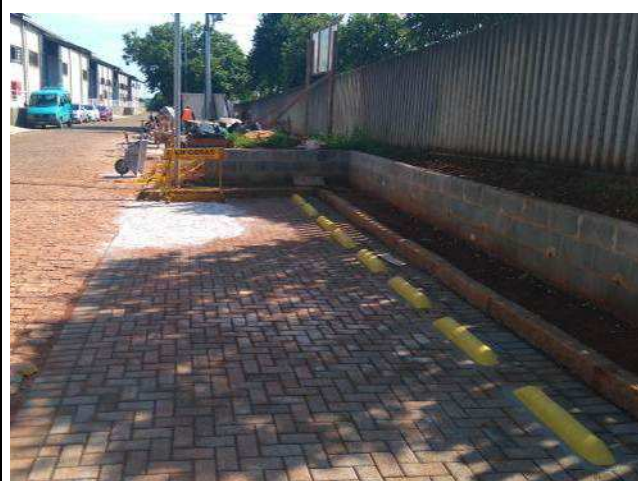
Figura 51C: Detalhe do conjunto instalado, após pintura na cor amarela.
