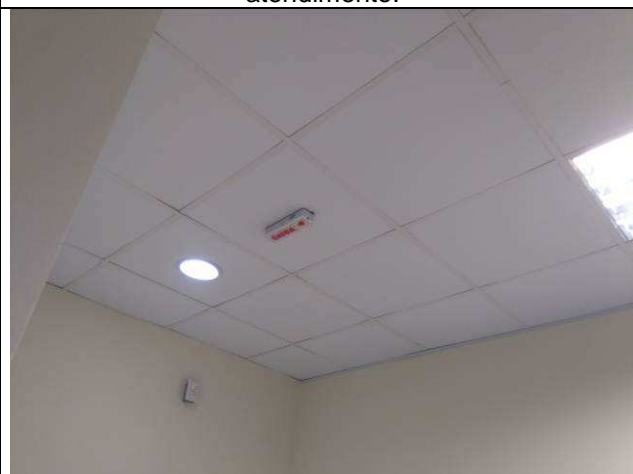
Figura 31E: blocos de emergência.
