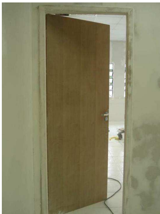
Figura 31C: Porta PM 80 instalada na Secretaria do Projeto Horizontes.
