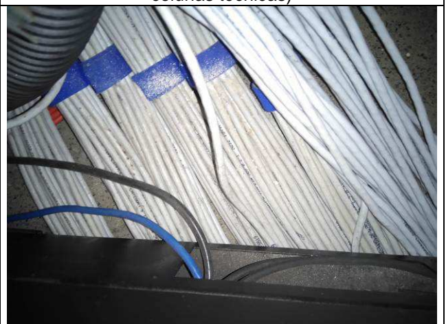
Figura 38E: cabeamento UTP cat6.
