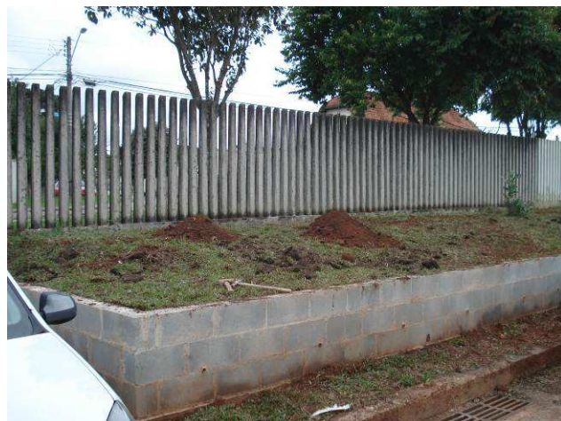
Figura 48C: Grama plantada no talude e base do muro de arrimo executado (trecho "A").
