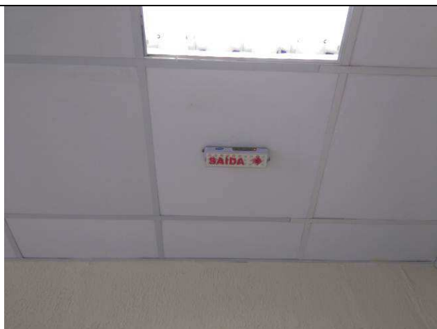
Figura 32E: blocos de emergência.
