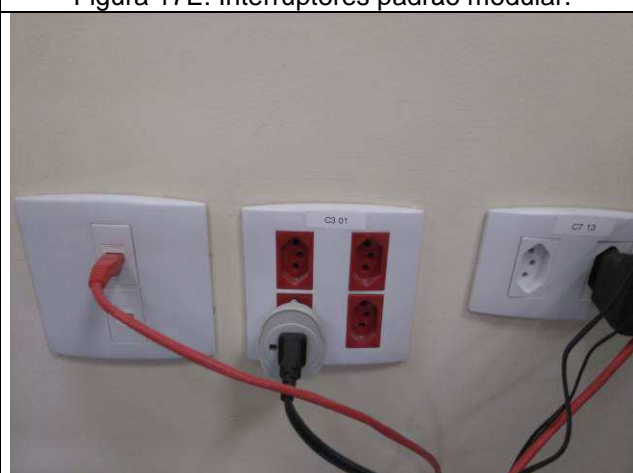
Figura 19E: tomadas elétricas.
