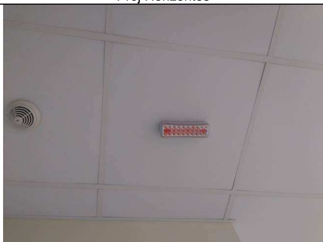
Figura 30E: blocos de emergência.
