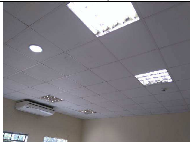
Figura 25E: alteração acionamento interruptores - Gabinete STI.
