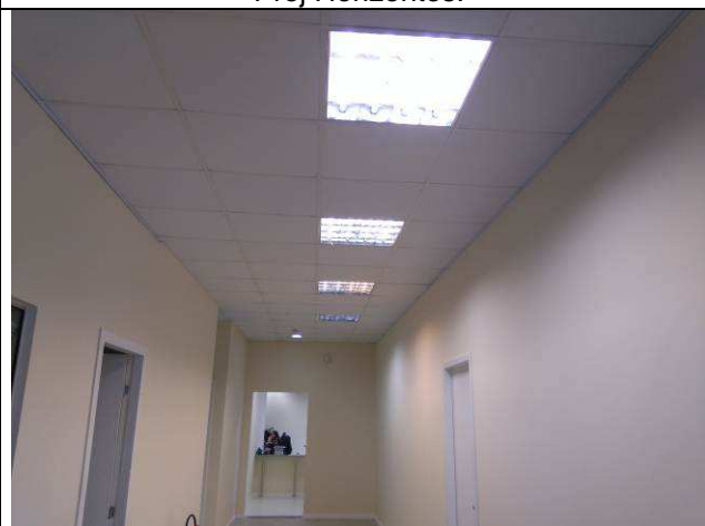
Figura 29E: Luminária 23W corredor balcão de atendimento.
