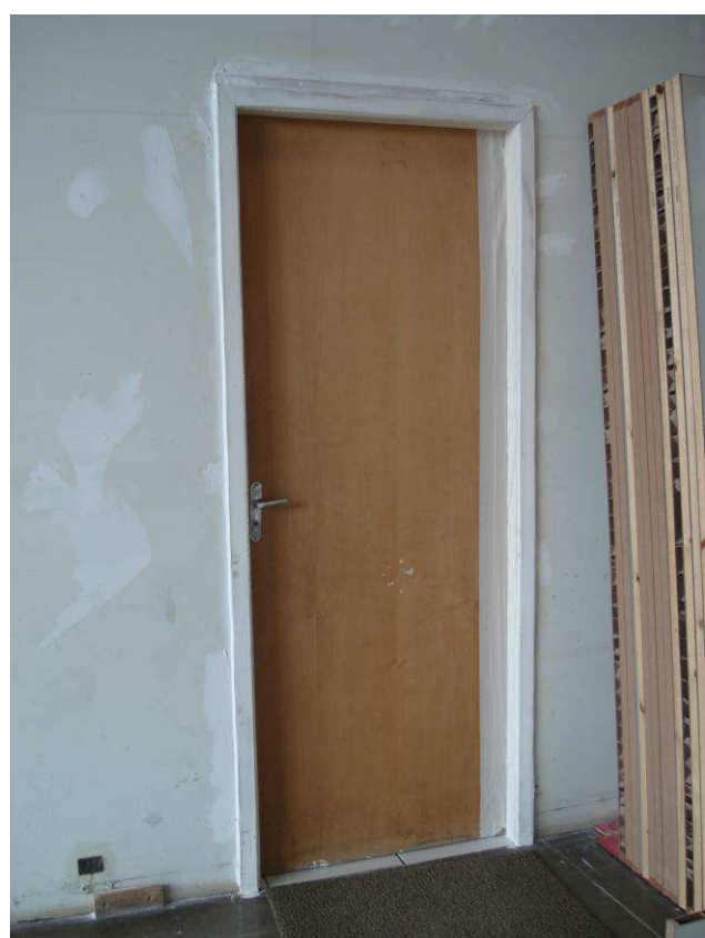
Figura 32C: Porta PM 80 instalada na sala da informática, com acesso pela doca 05.
