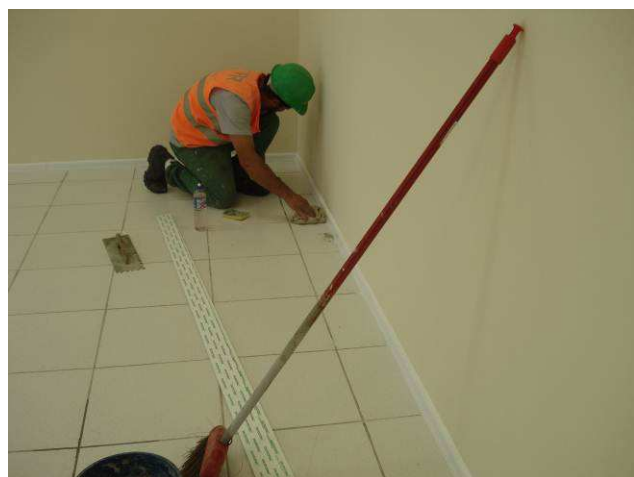
Figura 16C: Rodapé Santa Luzia (h=5cm) instalado na secretaria do Projeto Horizontes.
