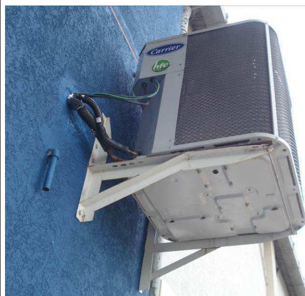
Figura 24C: Equipamento e respectivo suporte metálico instalados no lado externo do barracão.
