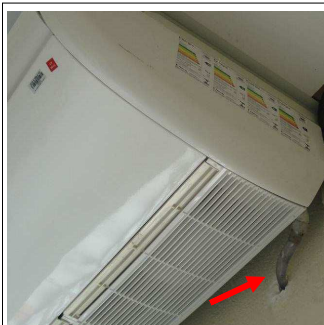
Figura 22C: Dreno de ar condicionado executado para evaporadora relocada na Secretaria do Projeto Horizontes.
