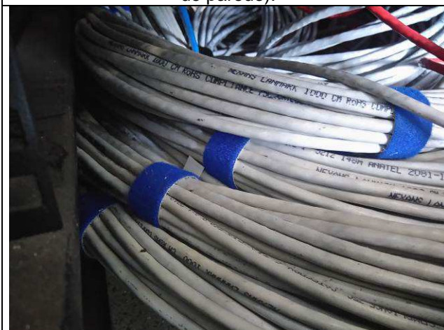
Figura 37E: cabeamento UTP cat6.
