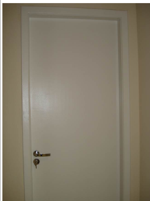
Figura 93C: Porta em madeira PM 80x210 instalada no banheiro construído da informática.
