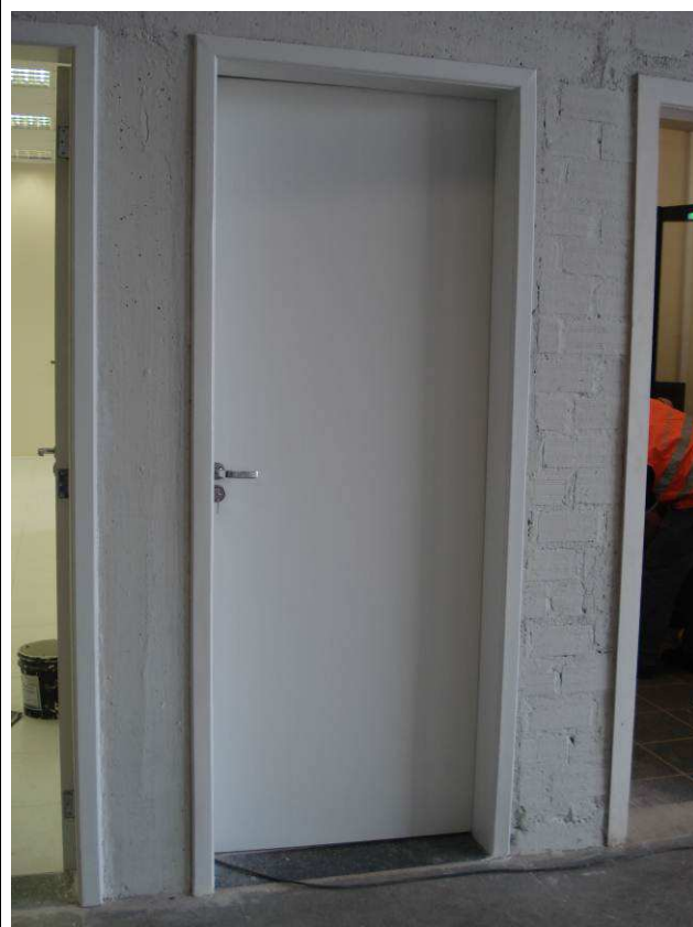
Figura 113C: Porta em madeira, no acesso ao corredor da informática, pintada com esmalte acetinado Suvinil, na cor branca.
