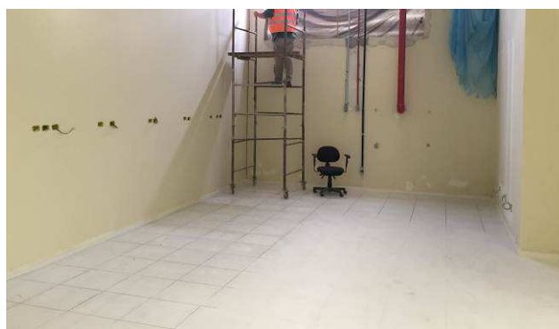
Figura 48C: Rodapé branco, marca Santa Luzia (h=5 cm), instalado no laboratório Service Desk.
