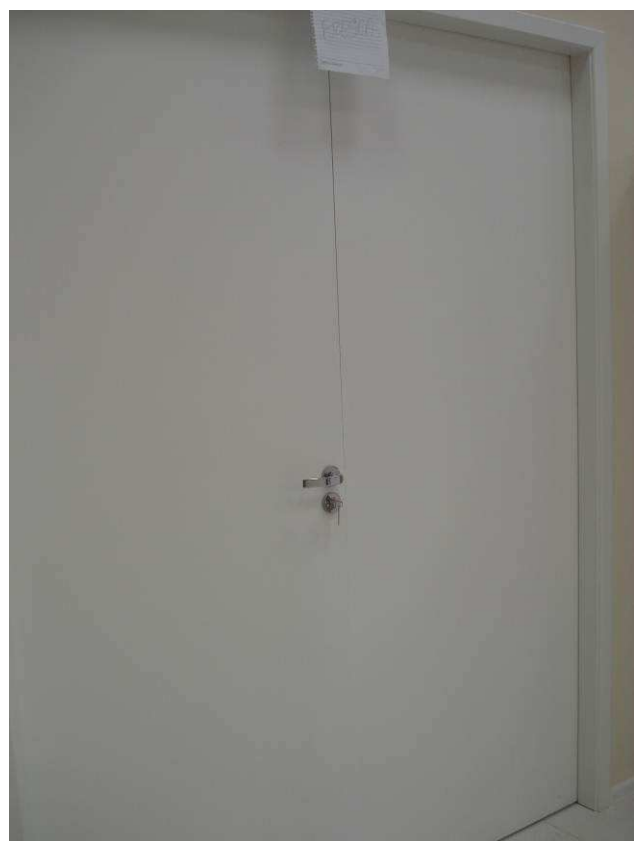
Figura 112C: Porta em madeira, no acesso ao depósito Service Desk, pintada com esmalte acetinado Suvinil, na cor branca.
