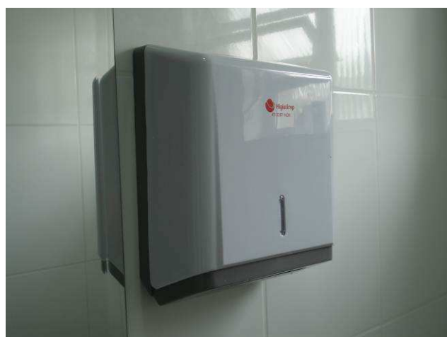
Figura 71C: Dispenser para papel toalha instalado junto ao lavatório do novo banheiro da informática. Utilizado item da marca Higielimp.
