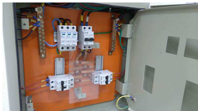
Figura 37E: Quadro elétrico QDE-5.
