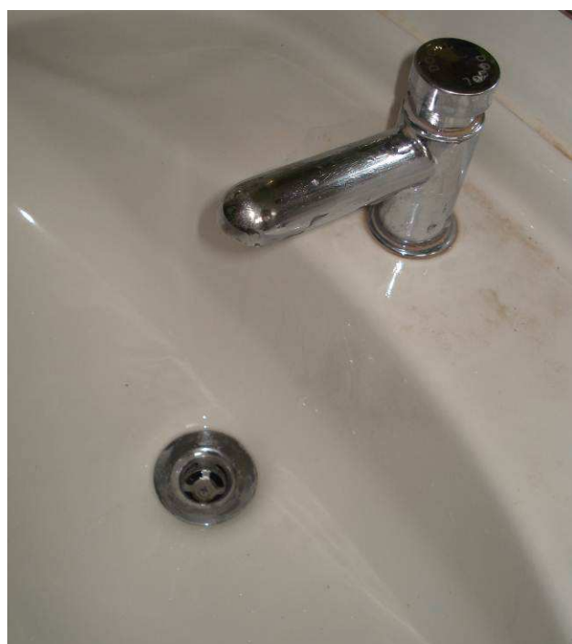
Figura 79C: Torneira de pressão cromada instalada junto ao lavatório do banheiro reformado da informática. Utilizado item da marca Docol.
