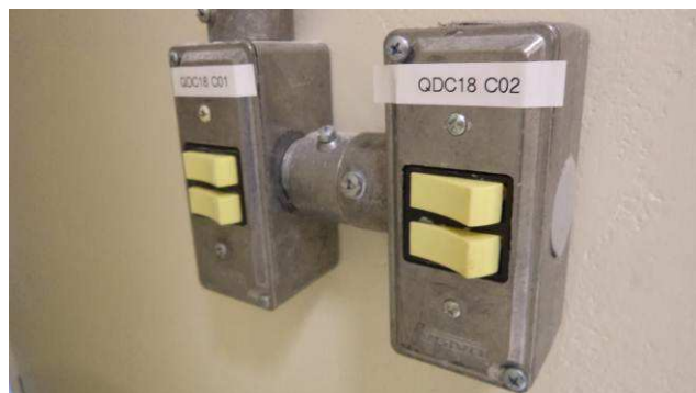
Figura 29E: interruptores - laboratório Service Desk.
