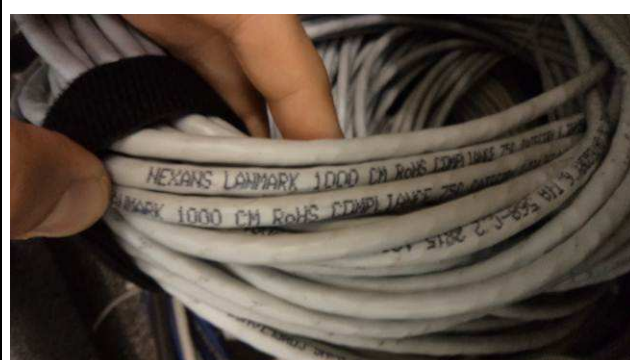
Figura 42E: cabeamento UTP cat-6.
