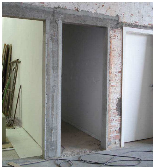
Figura 31C: Emboço paulista executado na adequação do vão da porta do corredor de acesso à copa da informática (à direita).
