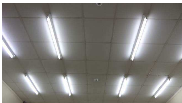
Figura 05E: remanejamento sensores presença e luminárias 32W - depósito STI.
