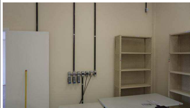
Figura 30E: tomadas elétricas - laboratório Service Desk.
