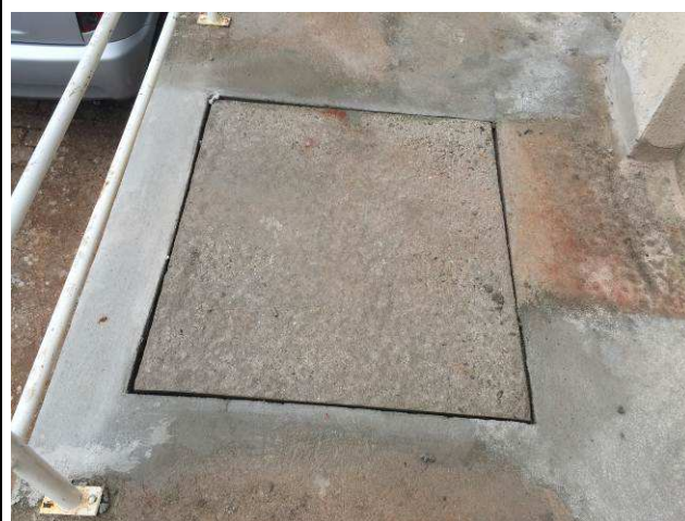
Figura 85C: Caixa de inspeção executada na passarela externa, no alinhamento dos banheiros da informática (interligada à caixa de gordura da copa).
