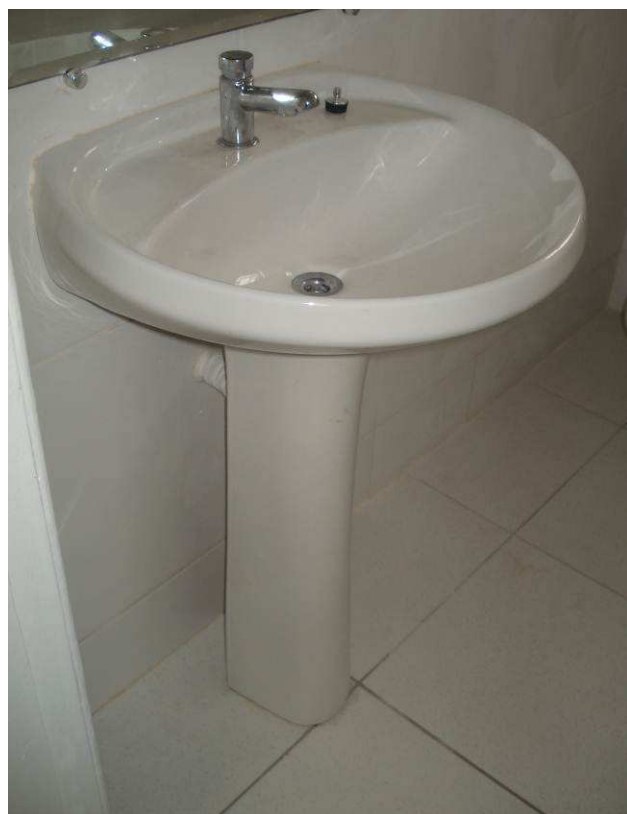
Figura 66C: Lavatório reinstalado no banheiro reformado da informática. Instalados novos acessórios de fixação, bem como engate e válvula de escoamento cromados.
