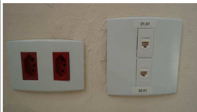
Figura 08E: infraestrutura STI - caixas 2x4", 4x4" e eletrodutos.
