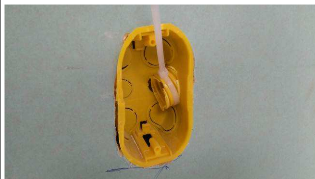
Figura 10E: infraestrutura STI - caixas 2x4", 4x4" e eletrodutos.
