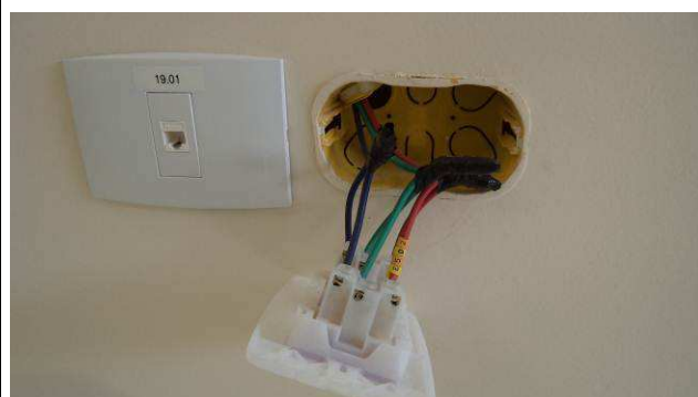
Figura 16E: cabeamento elétrico - laboratório Service Desk.
