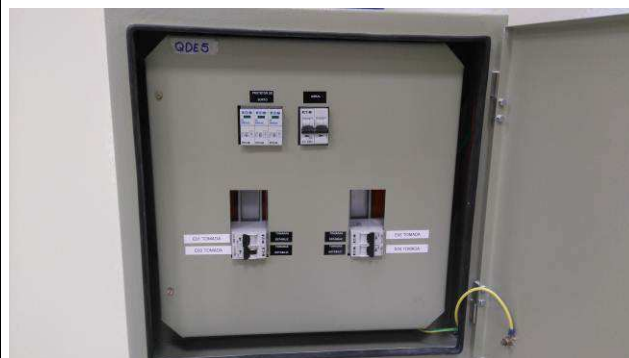
Figura 36E: Quadro elétrico QDE-5.
