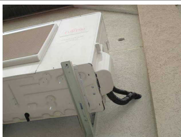
Figura 86C: Rede frigorígena de equipamento de ar condicionado instalado de 27.000 BTUs do laboratório Service Desk (trecho ligado à unidade condensadora).
