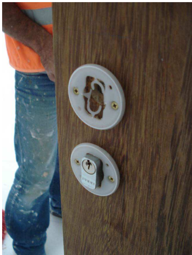
Figura 98C: Foram utilizadas fechaduras 40mm, linha ZM Copa ROS 962, marca Pado.
