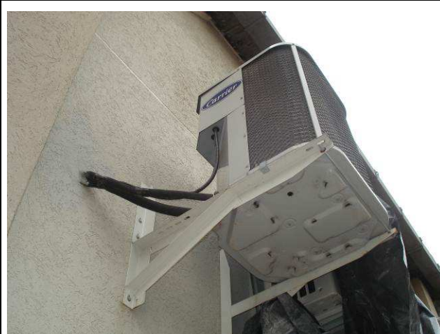
Figura 87C: Rede frigorígena de equipamento de ar condicionado instalado de 27.000 BTUs do laboratório Service Desk (trecho ligado à unidade condensadora).
