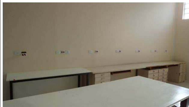
Figura 24E: tomadas elétricas - laboratório Service Desk.
