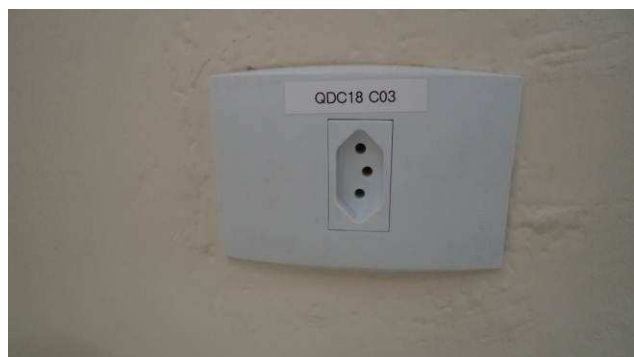
Figura 27E: tomadas elétricas - laboratório Service Desk.
