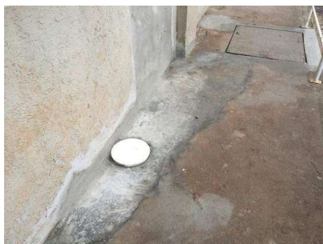
Figura 84C: Caixa de gordura em polietileno instalada na passarela externa do barracão, alinhada com a saída do esgoto da copa da informática.
