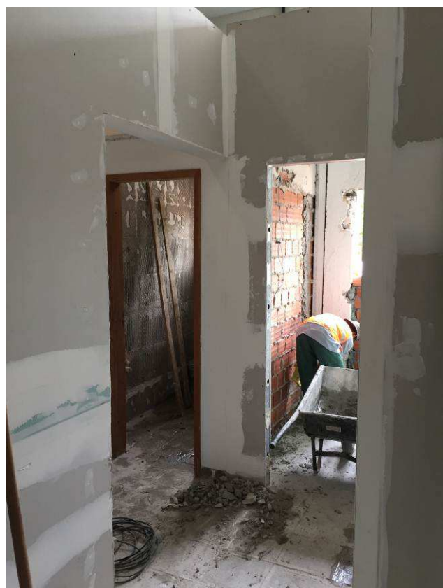
Figura 23C: Parede em gesso acartonado simples executada no corredor de acesso a banheiros e copa da informática..
