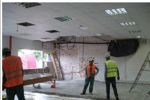
Figura 02C: Paredes em gesso acartonado removidas da copa e banheiro da antiga sala de informática.
