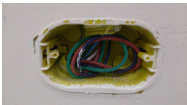
Figura 13E: cabeamento elétrico - laboratório Service Desk.
