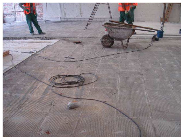
Figura 06C: Piso demolido na área a ser incorporada ao Projeto Horizontes.
