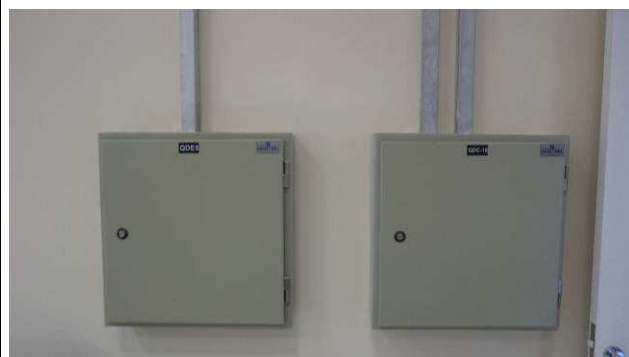
Figura 34E: Quadros elétricos QDC-18 e QDE-5.
