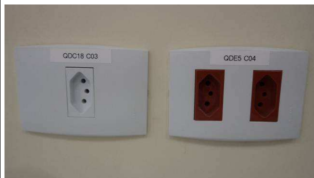
Figura 28E: tomadas elétricas - laboratório Service Desk.
