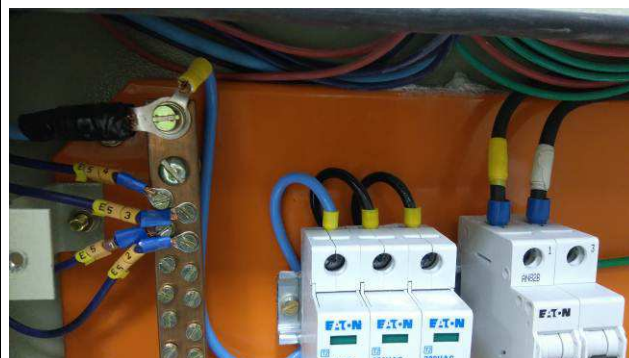
Figura 38E: Quadro elétrico QDE-5.
