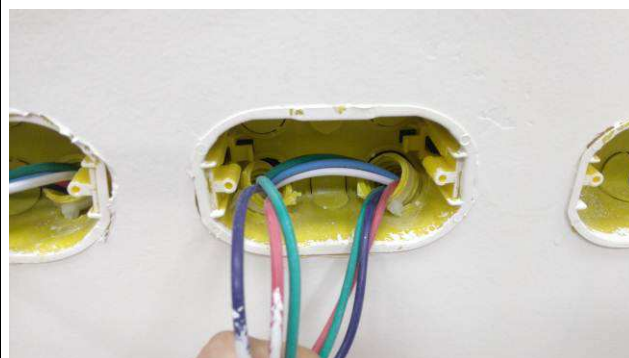
Figura 14E: cabeamento elétrico - laboratório Service Desk.
