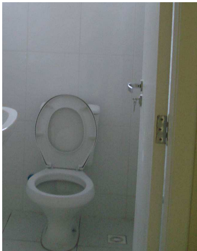
Figura 63C: Bacia sanitária com caixa acoplada Deca instalada no novo banheiro da informática.
