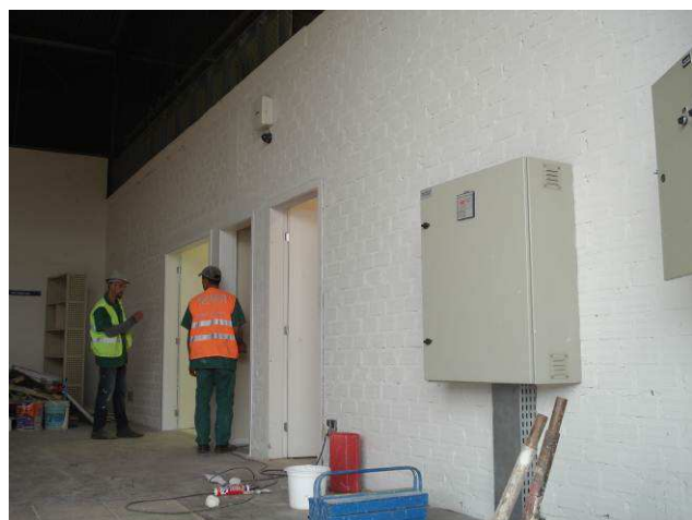
Figura 110C: Parede em alvenaria na divisa do laboratório Service Desk com a doca 05 pintada na cor branco gelo.
