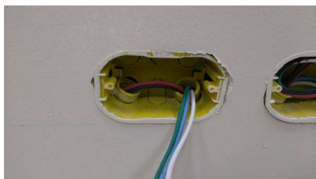
Figura 15E: cabeamento elétrico - laboratório Service Desk.
