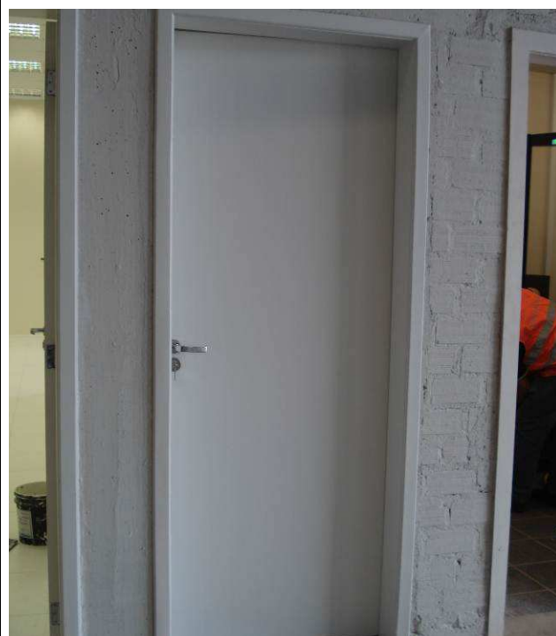
Figura 95C: Porta em madeira PM 80x210 instalada no corredor de acesso à copa da informática.
