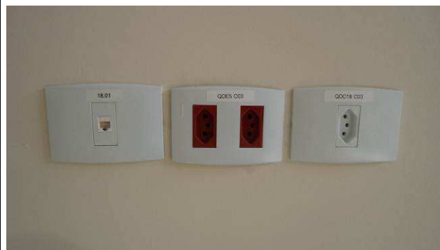
Figura 26E: tomadas elétricas - laboratório Service Desk.
