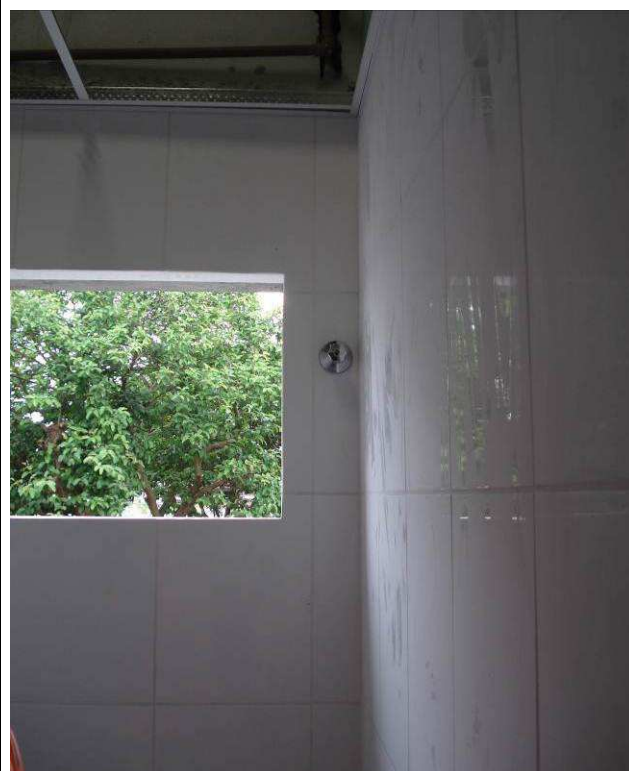
Figura 56C: Registro de gaveta 3/4" instalado no banheiro novo da informática.
