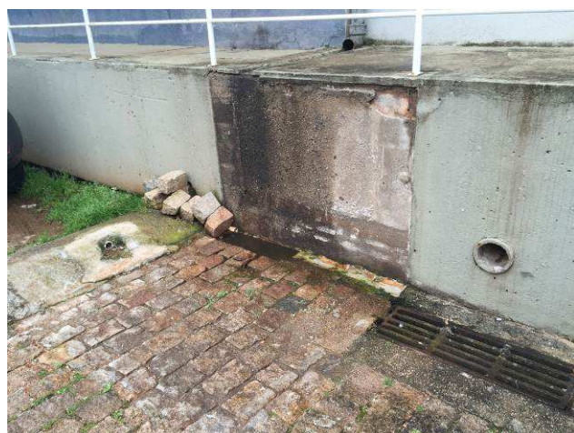
Figura 07C: Caixa em concreto demolida em área externa do barracão.
