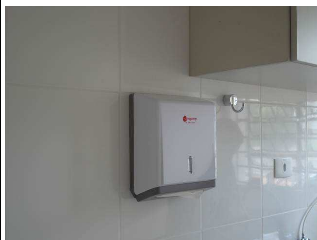
Figura 72C: Dispenser para papel toalha instalado junto à pia da copa da informática. Utilizado item da marca Higielimp.
