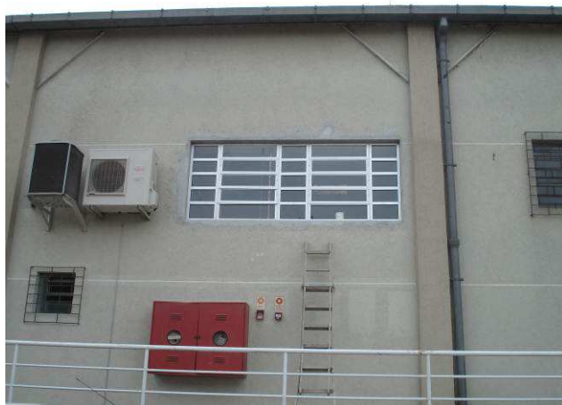
Figura 100C: Janela basculante em alumínio, instalada no laboratório Service Desk.
