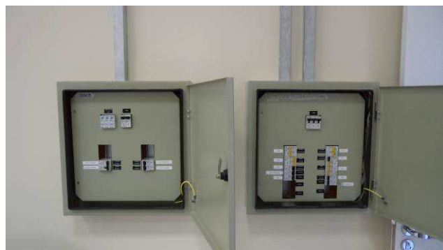
Figura 35E: Quadros elétricos QDC-18 e QDE-5.
