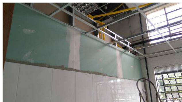
Figura 34C: Detalhe da parede da copa onde houve assentamento de azulejo, até a altura de 2 metros.
