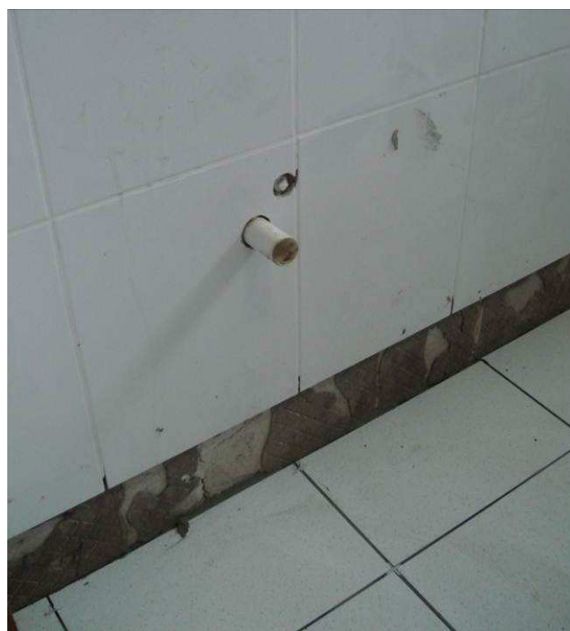
Figura 58C: Ponto de água fria Ø 25 mm e esgoto secundário referente ao lavatório do banheiro reformado da informática.
