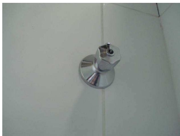
Figura 55C: Registro de gaveta 3/4" (Deca), com respectivos acabamento e canopla cromada, instalado no banheiro reformado da informática.
