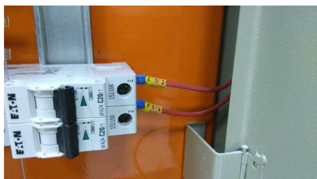
Figura 39E: Quadro elétrico QDE-5.
