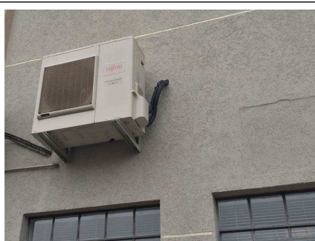
Figura 88C: Rede frigorígena de equipamento de ar condicionado instalado de 27.000 BTUs do Projeto Horizontes (trechos ligados à unidade condensadora).
