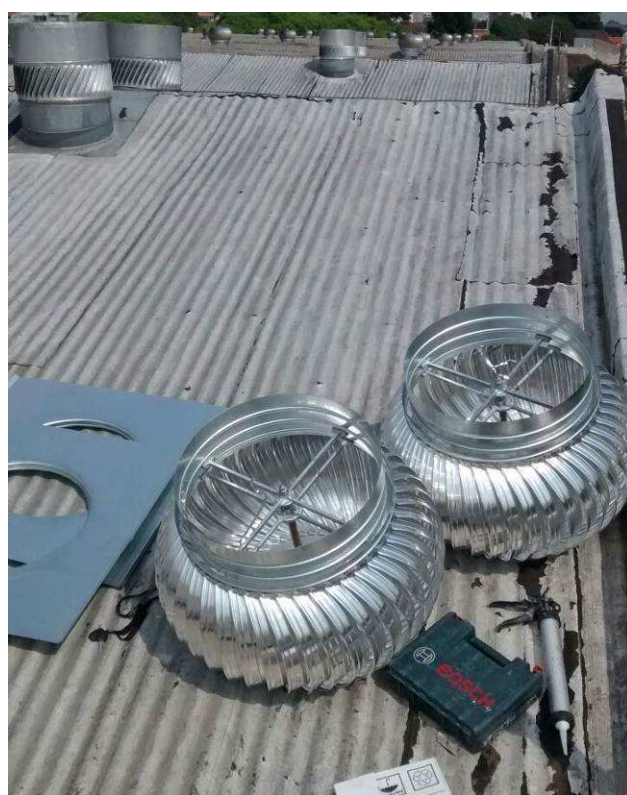
Figura 90C: Exaustores eólicos utilizados na Sala de Memória.
