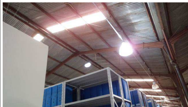
Figura 18E: cabeamento elétrico - separação iluminação arquivo.
