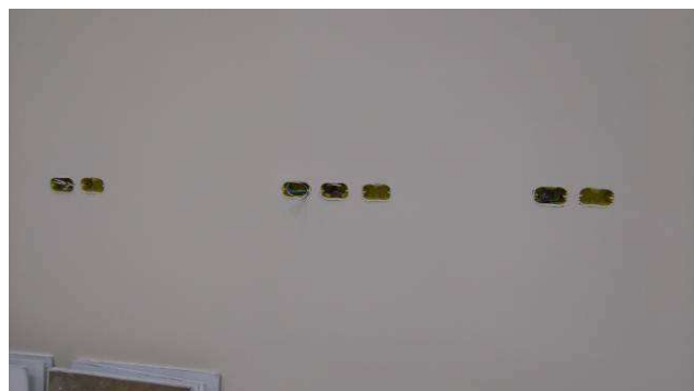
Figura 11E: infraestrutura STI - caixas 2x4", 4x4" e eletrodutos.
