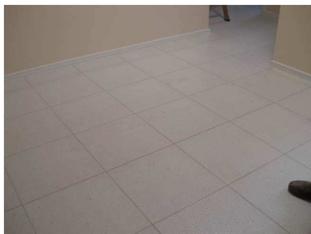
Figura 51C: Rodapé branco, marca Santa Luzia (h=5 cm), instalado no corredor de acesso à copa e banheiros da informática.
