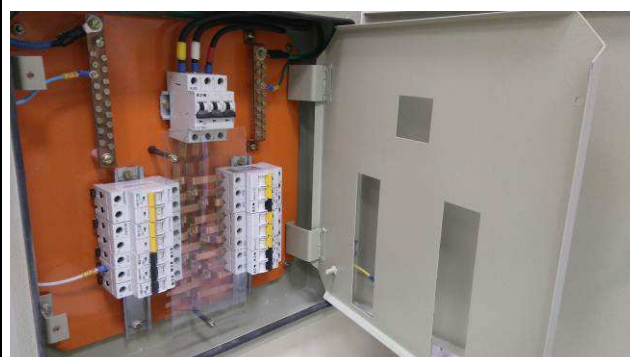
Figura 40E: Quadro elétrico QDC-18.
