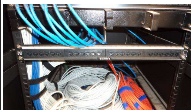
Figura 44E: rack sala técnica - patch pannel 24 portas cat6.
