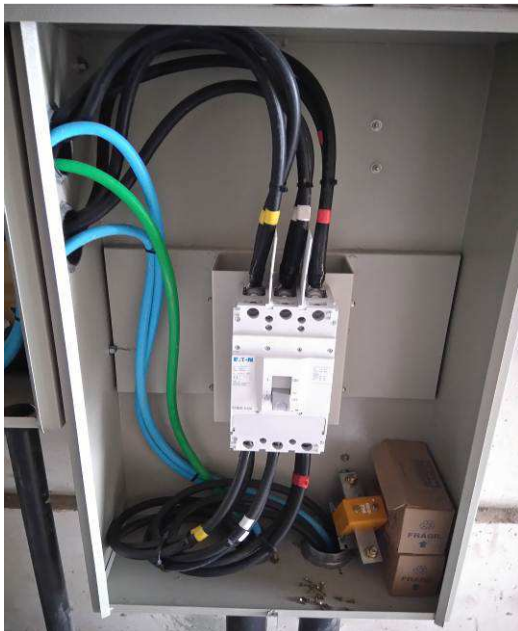
Figura 05E: Caixa NS e disjuntor 3x400A
