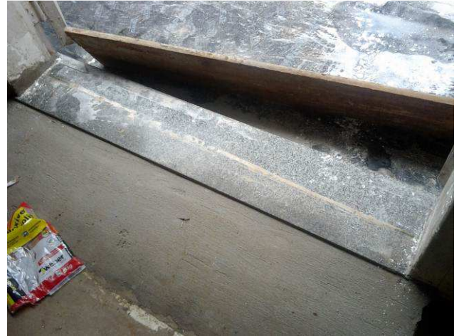
Figura 36C: Soleira instalada na porta de saída para o corredor lateral esquerdo, próxima aos sanitários públicos
