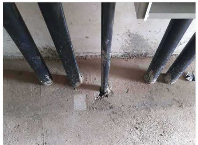
Figura 08E: eletrodutos caixas de medição
