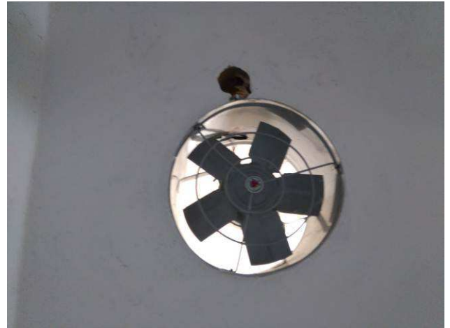
Figura 04E: exaustores ventilação forçada subestação
