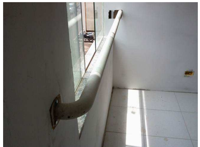
Figura 38C: barra de proteção (corrimão) das janelas, instalada em janela do primeiro pavimento
