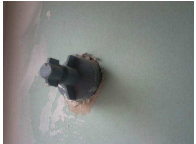
Figura 50C: Registro de 3/4", instalado no primeiro pavimento
