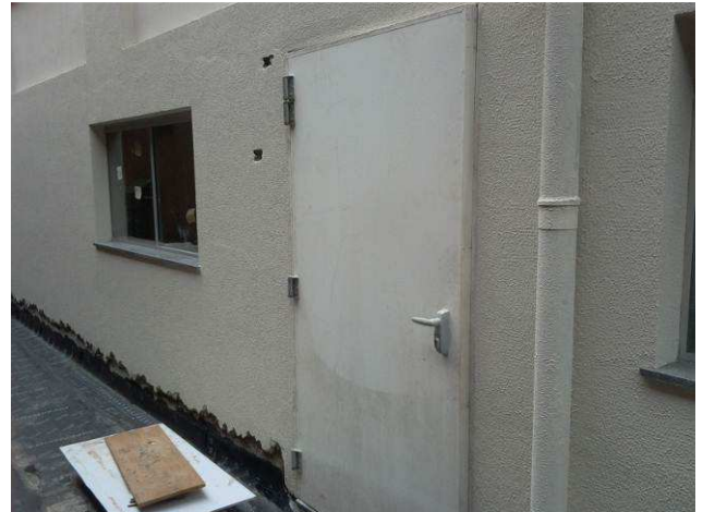
Figura 20C: Porta corta-fogo, instalada na saída da sala múltiplo uso
