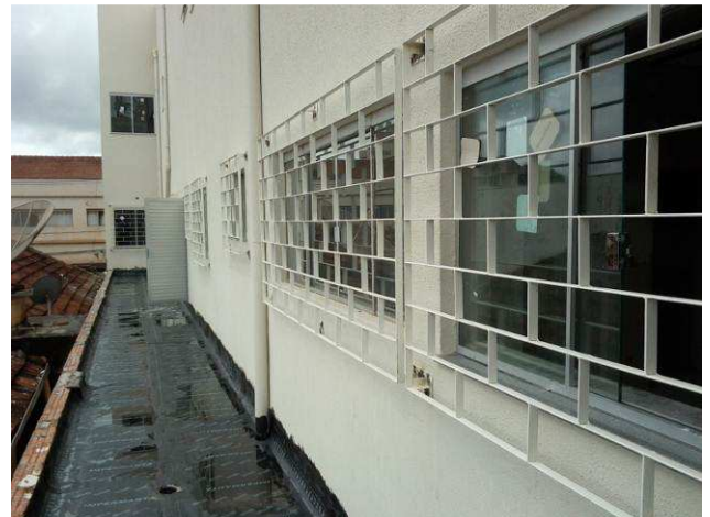
Figura 22C: Grades de proteção das janelas, instaladas no terraço do primeiro pavimento
