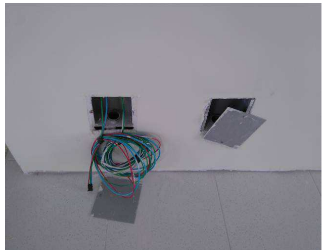
Figura 48E: infraestrutura cabeamento estruturado - caixas 15x15 salas de audiências
