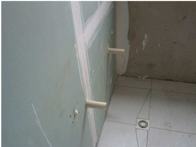
Figura 47C: Ponto de água fria, instalado no segundo pavimento
