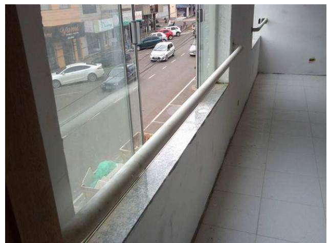
Figura 40C: barras de proteção (corrimão) das janelas, instaladas em janelas do primeiro pavimento
