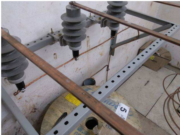
Figura 11E: aterramento subestação
