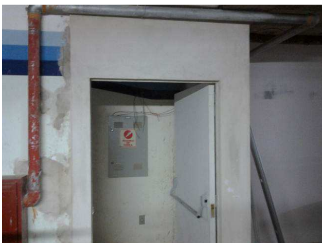
Figura 17C: Porta corta-fogo, instalada no subsolo
