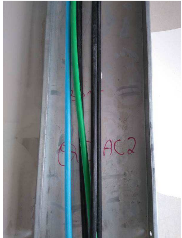
Figura 26E: alimentador QDAC 2º pavimento
