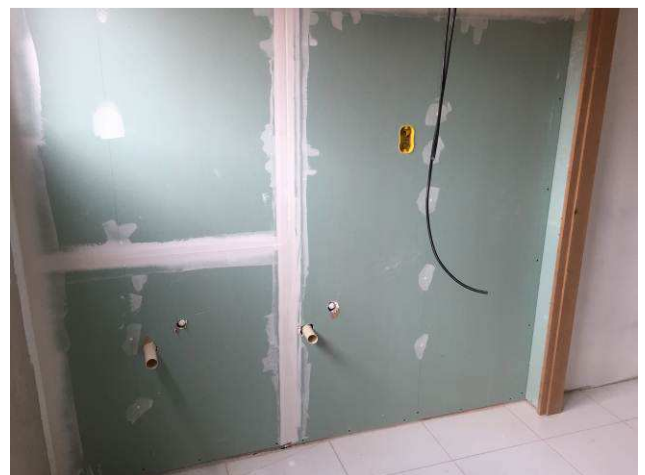
Figura 46C: Pontos de água fria, instalados no primeiro pavimento
