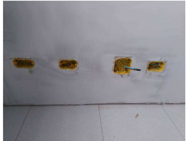
Figura 46E: infraestrutura cabeamento estruturado - eletrodutos e caixas 2x4" e 4x4"
