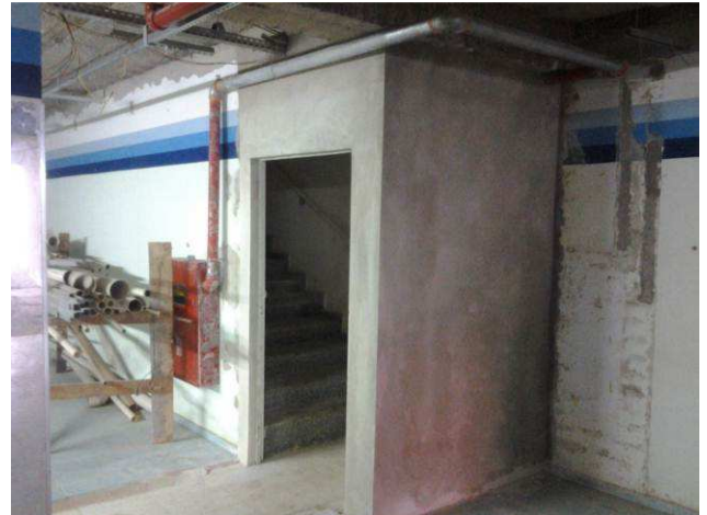
Figura 72C: detalhe do hidrante, que sofreu deslocamento para se adequar a situação da porta da escada de incêndio
