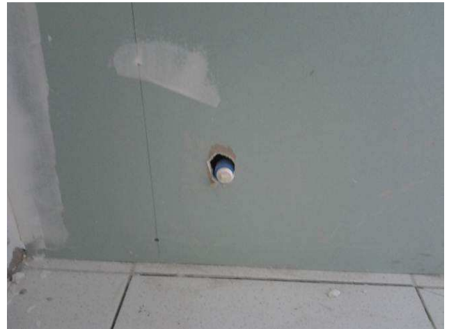
Figura 48C: Ponto de água fria, instalado no segundo pavimento
