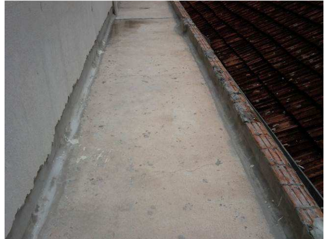
Figura 04C: Demolição das irregularidades e limpeza do piso - área externa do primeiro pavimento
