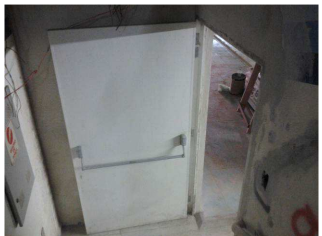
Figura 18C: Porta corta-fogo, instalada no subsolo
