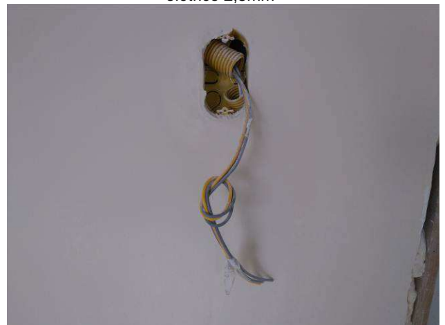
Figura 20E: cabeamento elétrico 2,5mm 2
