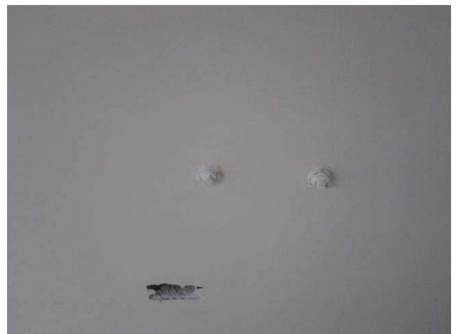
Figura 52C: Pontos de água fria, instalados no segundo pavimento
