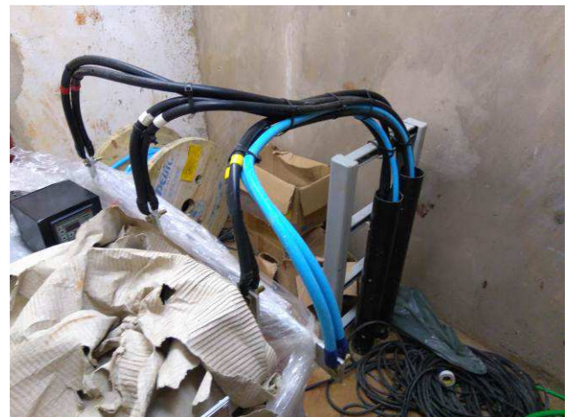
Figura 02E: ramal secundário transformador, alimentação QDG
