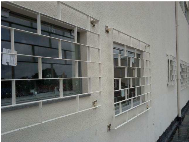
Figura 21C: Grades de proteção das janelas, instaladas no terraço do primeiro pavimento
