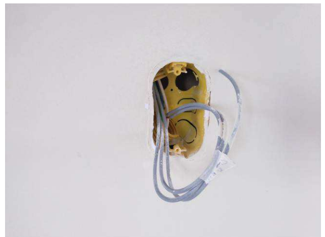
Figura 14E: infraestrutura - eletrodutos e caixas 2x4"
