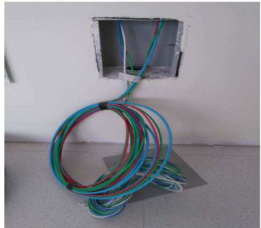
Figura 18E: caixa 15x15 salas de audiências; cabeamento elétrico 2,5mm 2
