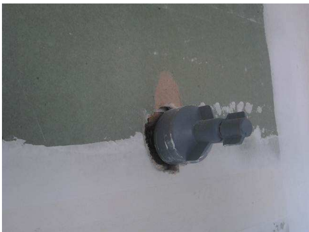
Figura 51C: Registro de 3/4", instalado no segundo pavimento
