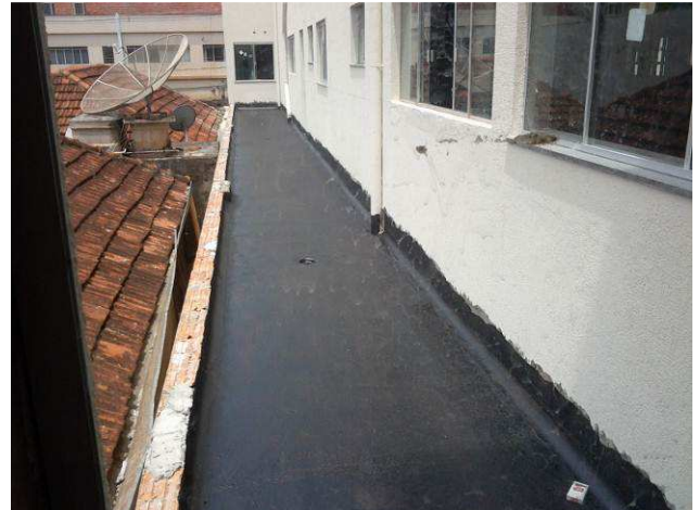
Figuras 26C: Detalhe da aplicação de emulsão asfáltica como substrato para assentamento da manta - terraço do primeiro pavimento
