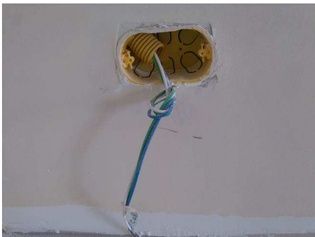
Figura 13E: infraestrutura - eletrodutos e caixas 2x4"
