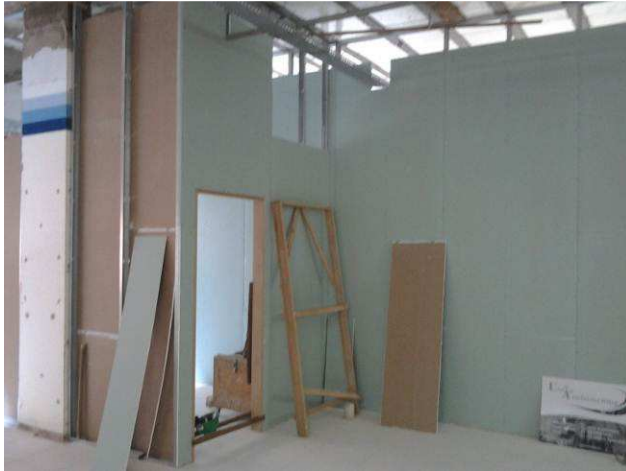
Figura 07C: Parede dos fundos dos sanitários da distribuição
