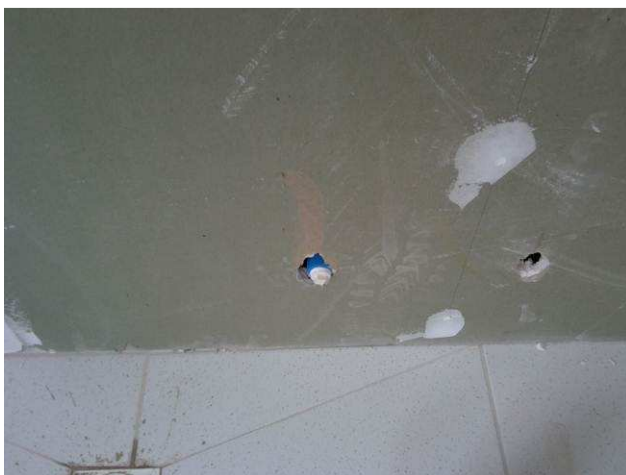
Figura 45C: Ponto de água fria, instalado no primeiro pavimento
