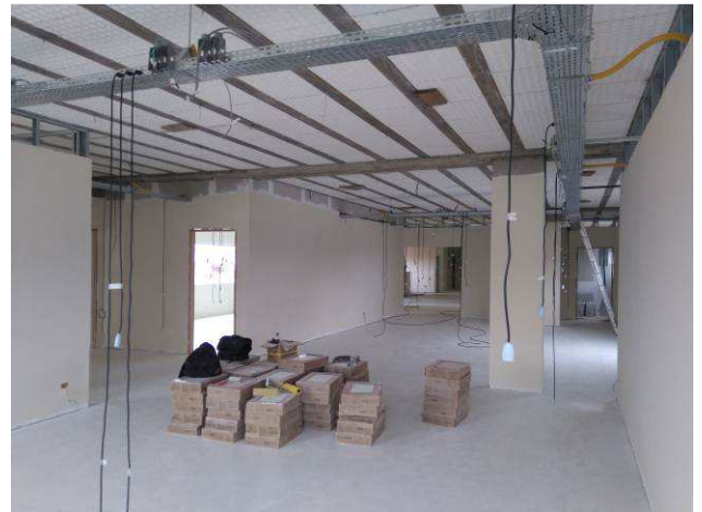
Figura 36E: cabos PP para iluminação
