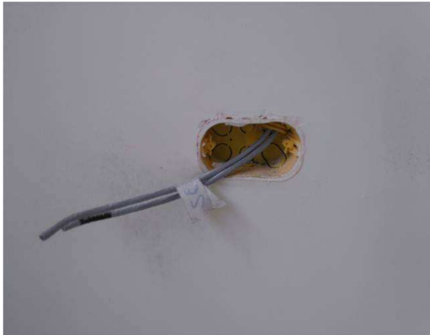
Figura 45E: infraestrutura cabeamento estruturado - eletrodutos e caixas 2x4" e 4x4"
