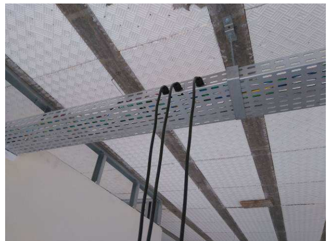
Figura 38E: cabos PP para iluminação
