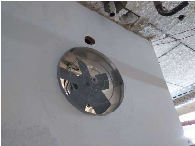
Figura 03E: exaustores ventilação forçada subestação
