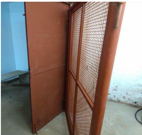
Figura 01E: porta e grade metálica - cabina subestação
