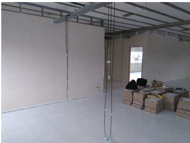
Figura 37E: cabos PP para iluminação
