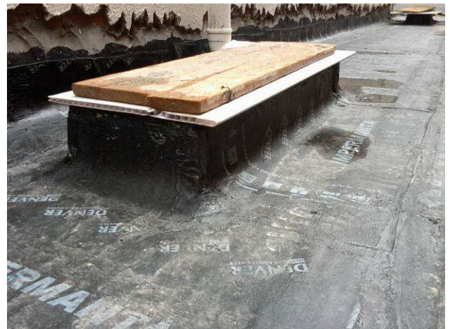
Figuras 28C: Detalhe da aplicação da manta asfáltica - corredor lateral à esquerda, pavimento térreo
