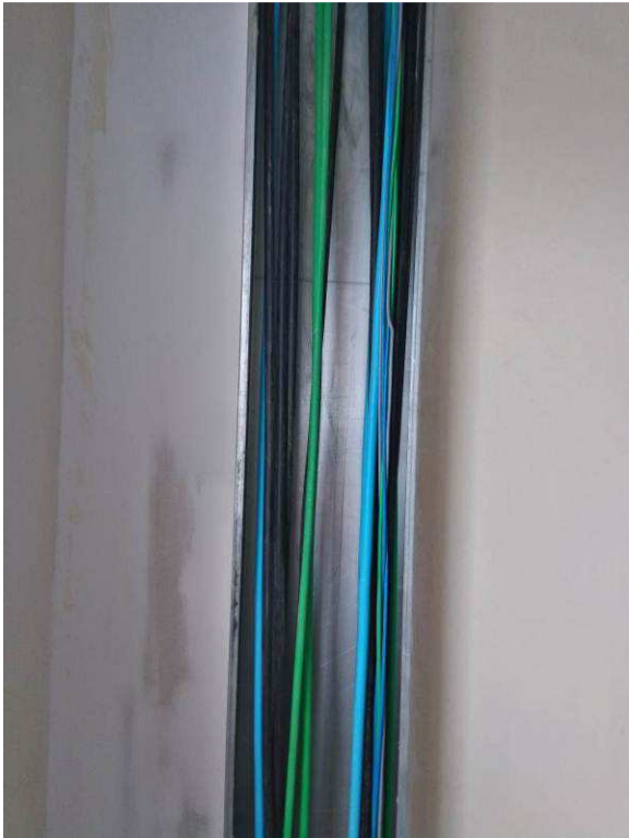
Figura 25E: ramais alimentadores sala técnica 2º pavimento
