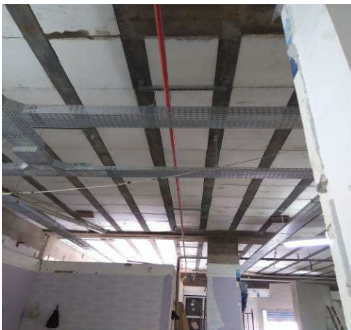
Figura 47E: Infraestrutura - eletrodutos e condutes sistema SDAI e alimentador bomba incêndio
