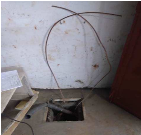
Figura 15E: caixa de inspeção de aterramento
