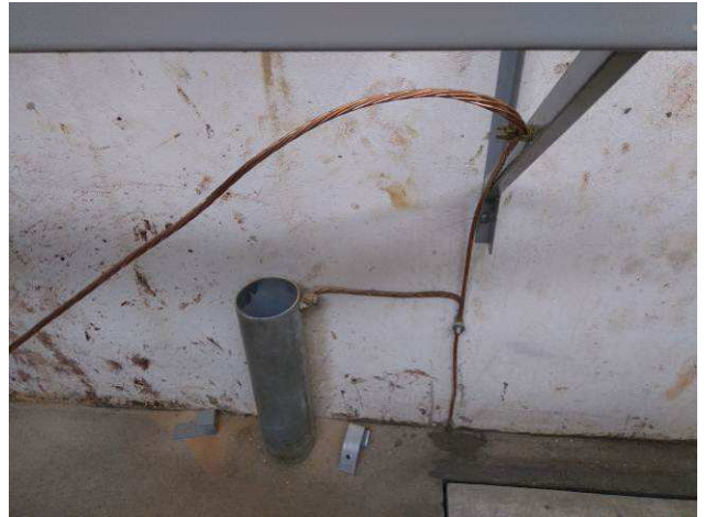
Figura 14E: aterramento partes metálicas - cabina da subestação
