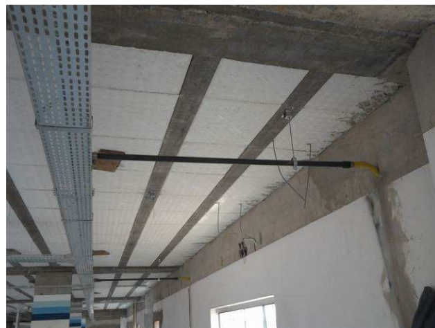
Figura 50E: eletrodutos e caixas 2x4" - pontos lógicos
