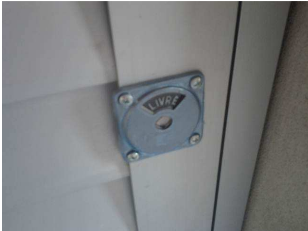
Figura 51C: Detalhe da fechadura das portas dos boxes dos banheiro públicos do segundo pavimento
