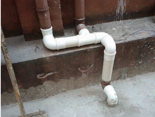
Figura 69C: Ligação das tubulações pluviais do corredor lateral esquerdo à rede coletora do subsolo
