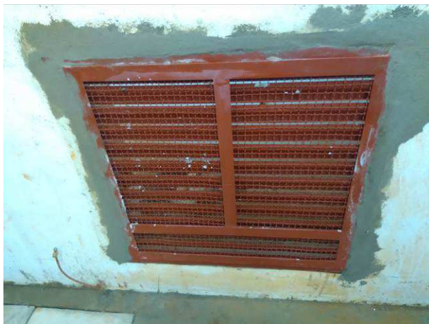
Figura 03E: janela tipo veneziana telada subestação
