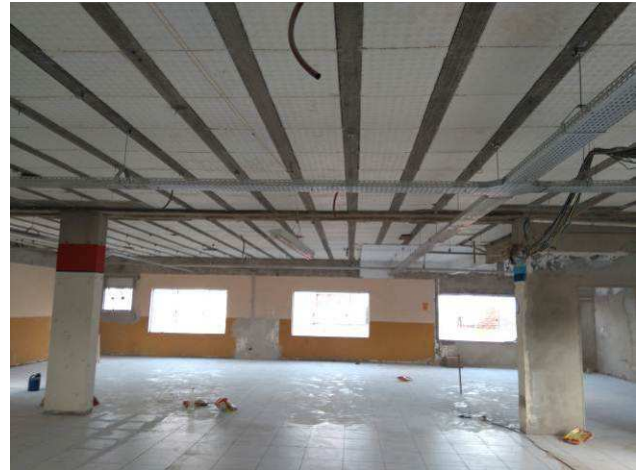
Figura 38E: eletrocalhas - 1º pavimento
