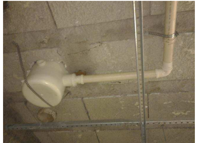
Figura 72C: Caixa de gordura, instalada na copa do segundo pavimento
