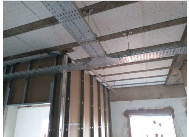
Figura 44E: eletrocalhas - 2º pavimento
