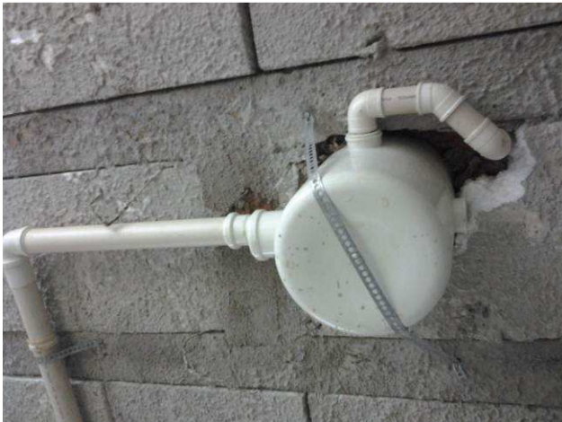
Figura 71C: Caixa de gordura, instalada na copa do primeiro pavimento
