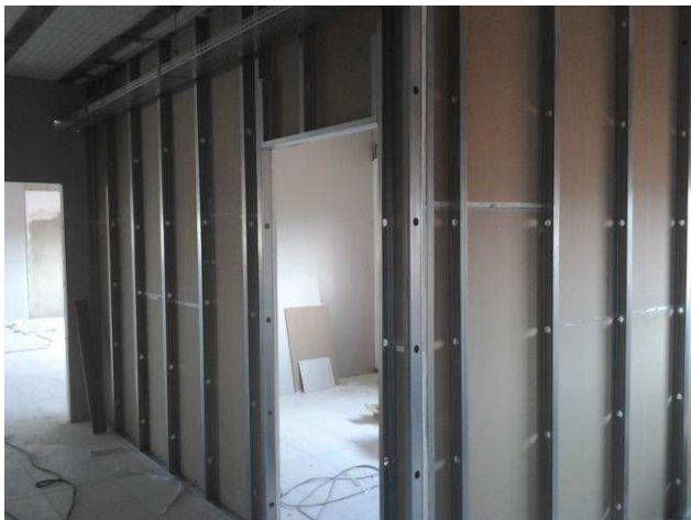
Figura 17C: Paredes acústicas de gesso acartonado duplo no segundo pavimento
