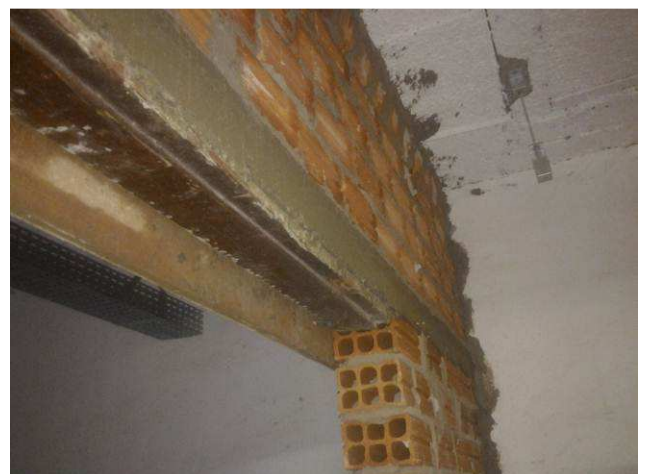
Figura 14C: Verga sobre vão de porta na sala técnica do subsolo
