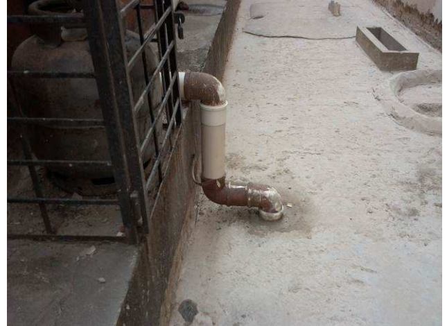
Figura 70C: Ligação das tubulações pluviais do corredor lateral esquerdo à rede coletora do subsolo
