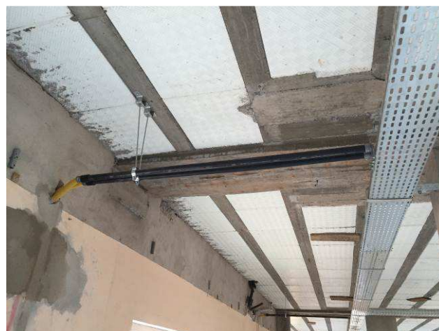
Figura 54E: eletrodutos e caixas 2x4" - pontos lógicos
