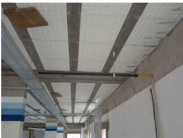
Figura 51E: eletrodutos e caixas 2x4" - pontos lógicos
