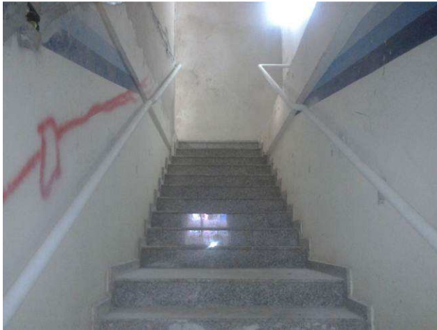
Figura 63C: Corrimão instalado na escada de acesso ao subsolo
