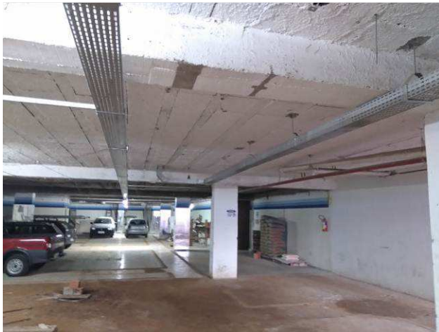
Figura 33E: eletrocalhas - Subsolo
