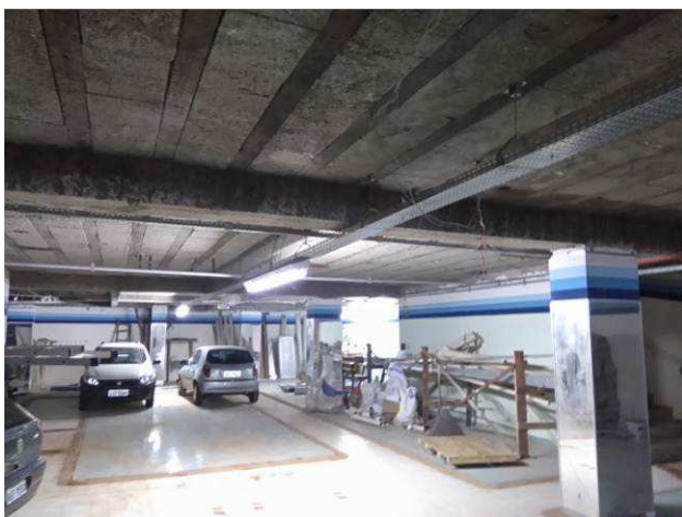
Figura 35E: eletrocalhas - Subsolo
