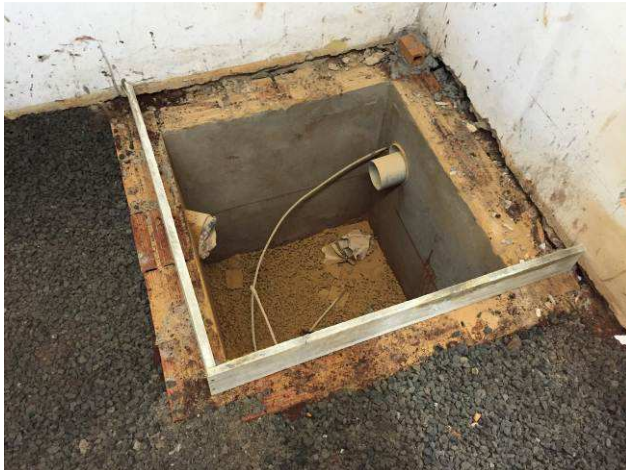
Figura 07E: caixa de passagem alta tensão 80x80cm
