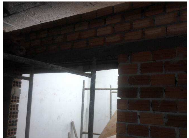
Figura 12C: Verga sobre vão de porta na cabina de transformação
