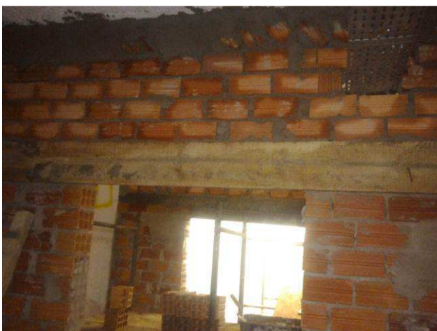
Figura 13C: Verga sobre vão de porta na cabina de transformação
