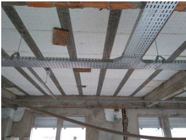
Figura 41E: eletrocalhas - 1º pavimento
