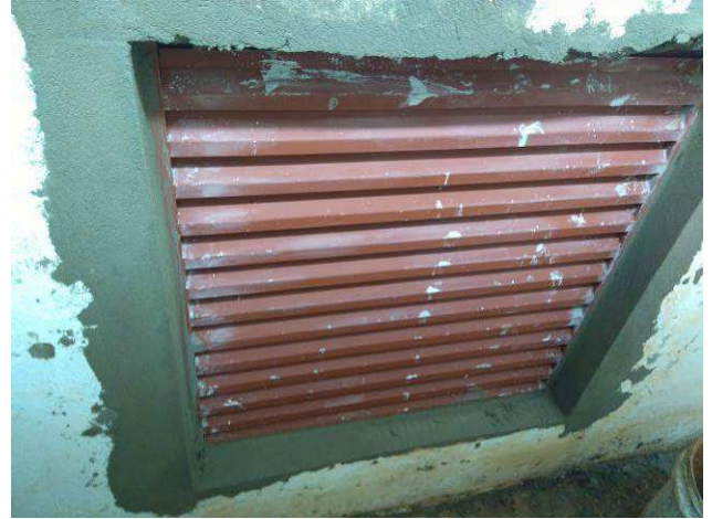
Figura 02E: janela tipo veneziana telada subestação
