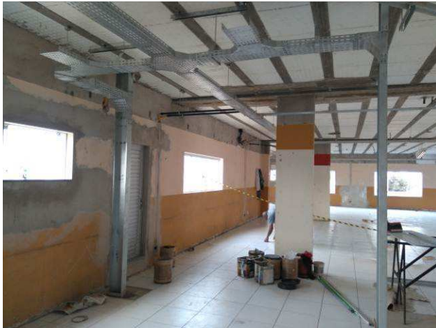
Figura 37E: eletrocalhas - 1º pavimento
