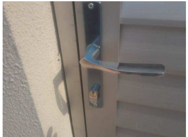
Figura 54C: Detalhe da fechadura
