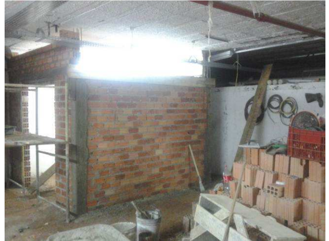
Figura 16C: Parede da cabina de transformação
