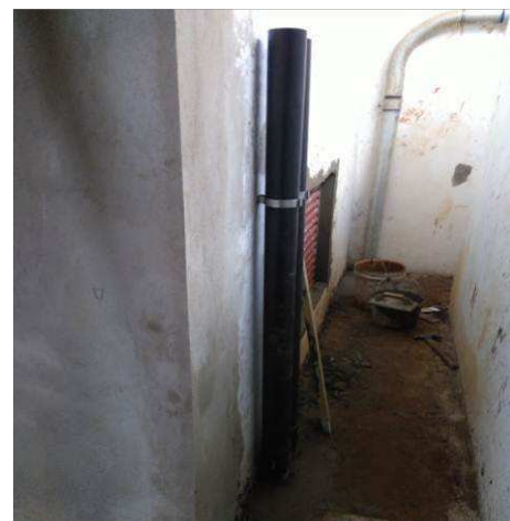
Figura 06E: eletrodutos de baixa tensão (PVC) e alta (metálico)
