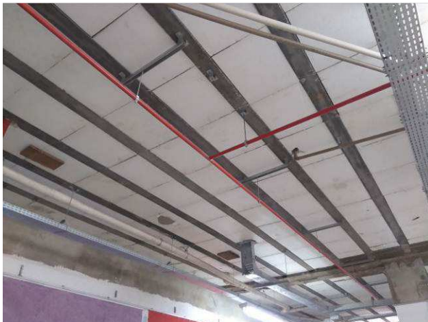
Figura 45E: Infraestrutura - eletrodutos e condutes sistema SDAI e alimentador bomba incêndio
