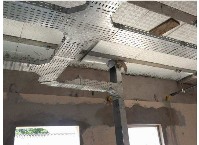
Figura 40E: eletrocalhas - 1º pavimento
