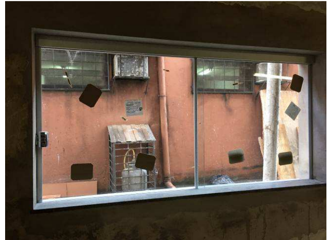
Figura 28C: Esquadrias metálicas instaladas no pavimento térreo
