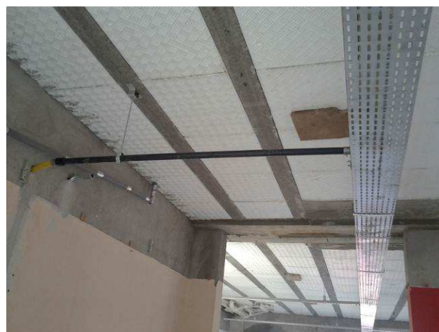
Figura 52E: eletrodutos e caixas 2x4" - pontos lógicos
