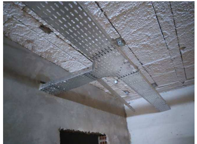
Figura 32E: eletrocalhas - Subsolo
