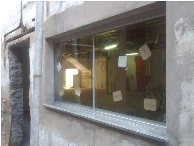
Figura 29C: Esquadrias metálicas instaladas no pavimento térreo
