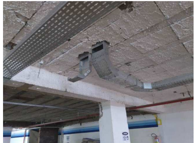
Figura 34E: eletrocalhas - Subsolo
