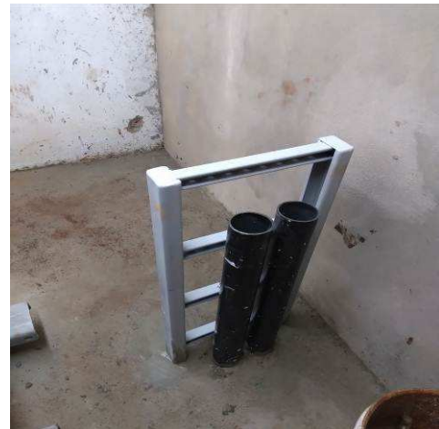
Figura 10E: eletrodutos baixa tensão e suporte
