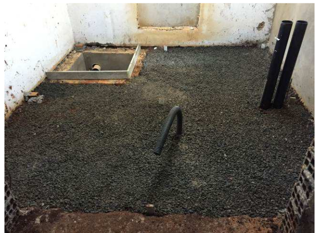
Figura 04E: base subestação
