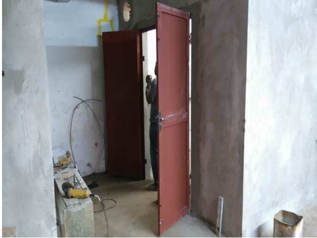
Figura 01E: porta metálica cabina subestação
