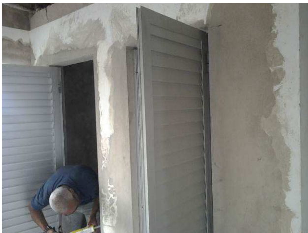
Figura 49C: Porta veneziana de alumínio, instalada nos boxes dos banheiro públicos do segundo pavimento
