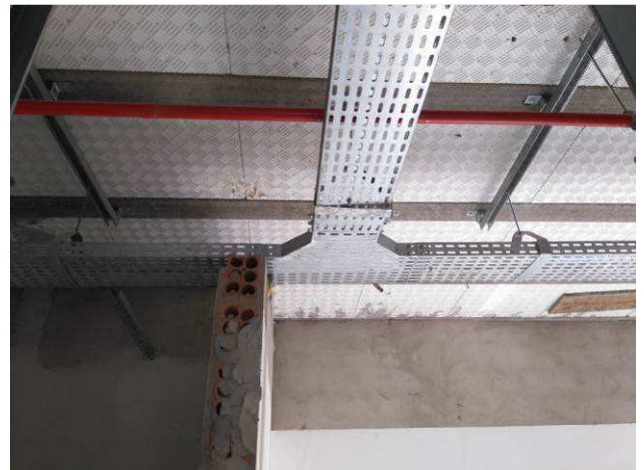
Figura 42E: eletrocalhas - 2º pavimento
