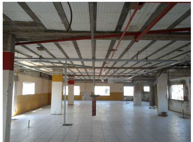
Figura 48E: Infraestrutura - eletrodutos e condutes sistema SDAI e alimentador bomba incêndio
