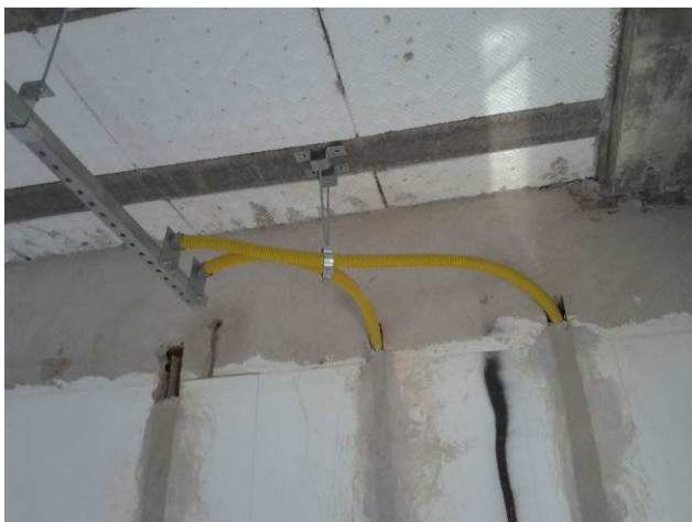
Figura 49E: eletrodutos e caixas 2x4" - pontos lógicos
