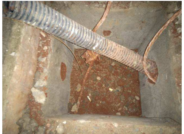
Figura 16E: caixa de inspeção de aterramento
