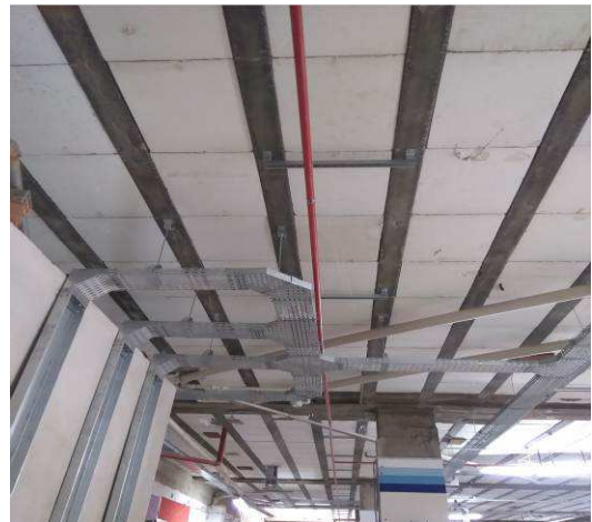
Figura 46E: Infraestrutura - eletrodutos e condutes sistema SDAI e alimentador bomba incêndio
