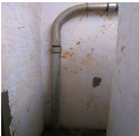
Figura 05E: eletroduto do ramal primário de alta tensão
