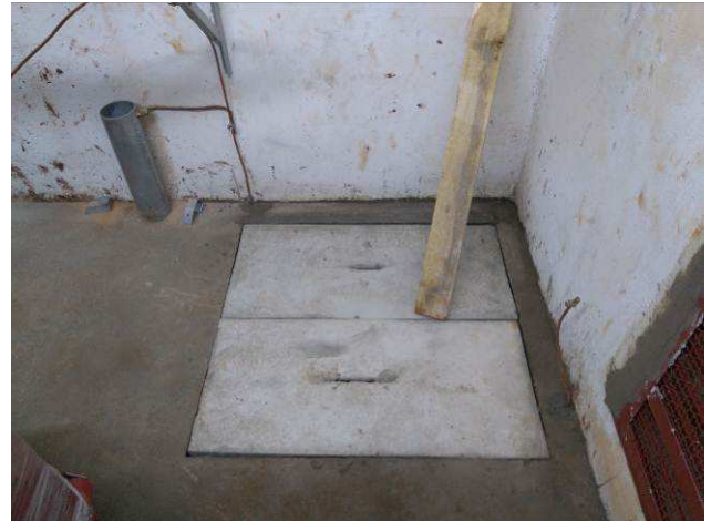
Figura 08E: caixa de passagem alta tensão 80x80cm
