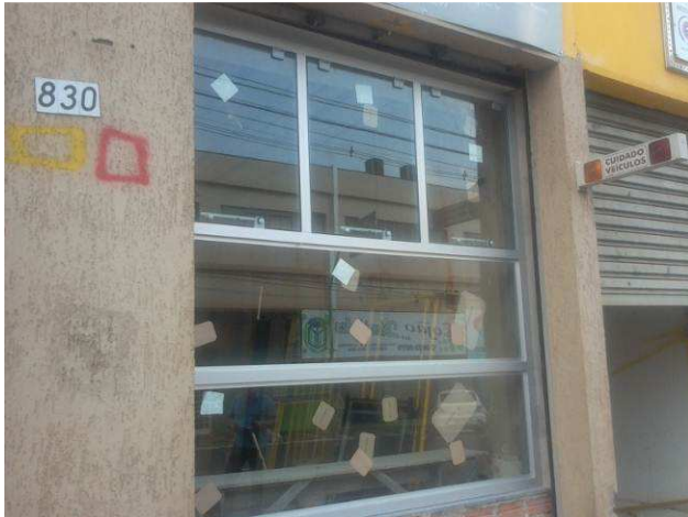
Figura 27C: Esquadrias metálicas instaladas no pavimento térreo
