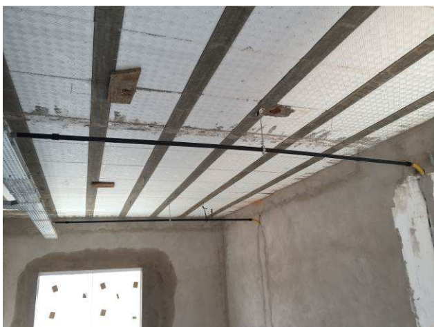
Figura 53E: eletrodutos e caixas 2x4" - pontos lógicos
