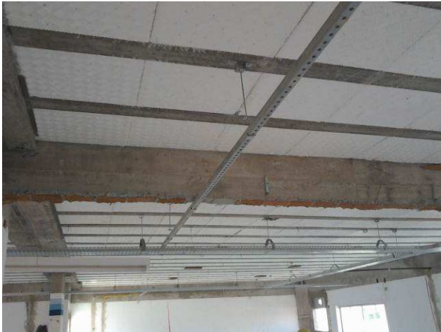
Figura 39E: eletrocalhas - 1º pavimento
