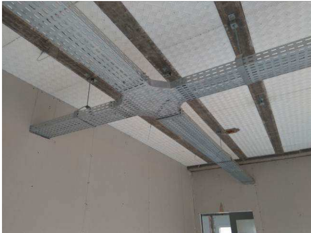
Figura 43E: eletrocalhas - 2º pavimento
