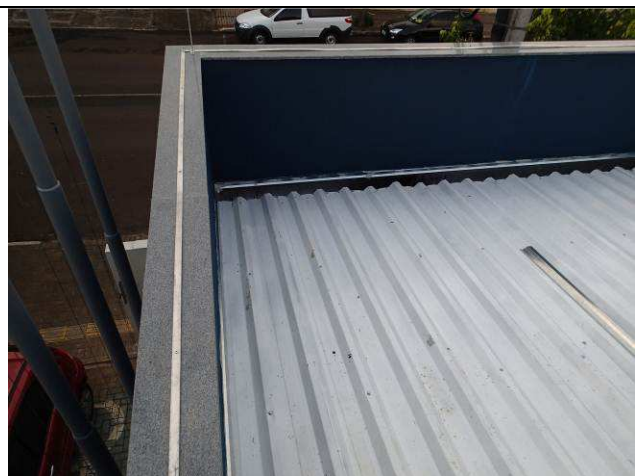
Figura 31E: fitas SPDA anexo PAB.
