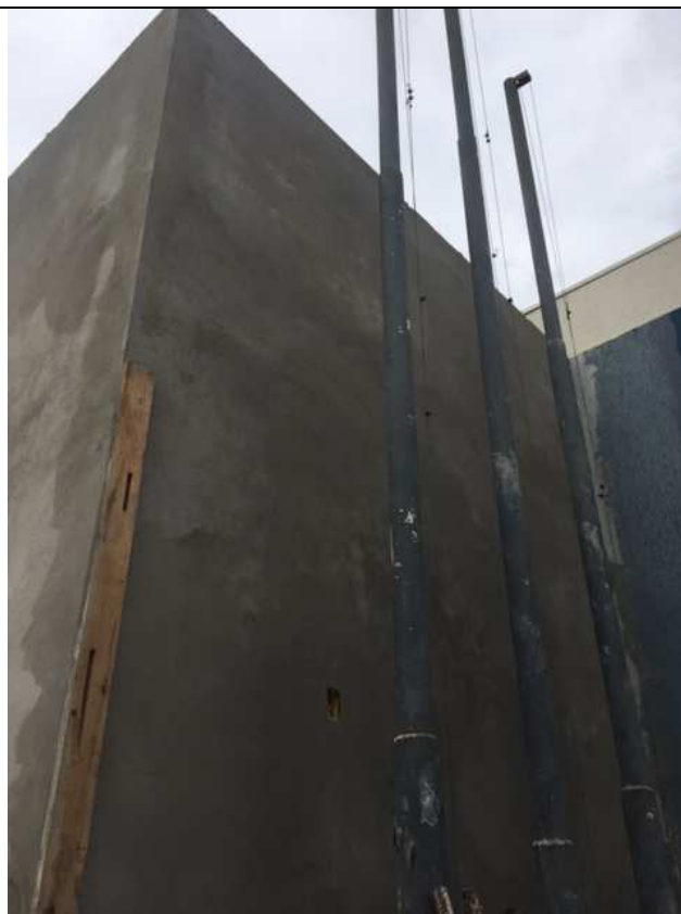
Figura 96C: Revestimento argamassado externo.
