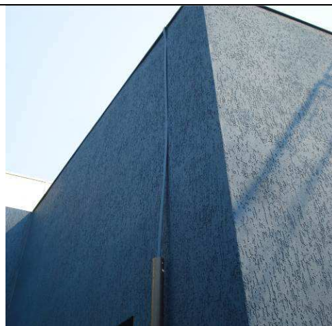
Figura 32E: descida SPDA anexo PAB.
