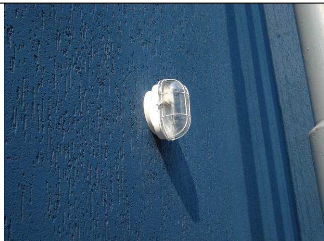
Figura 29E: luminárias externas tipo tartaruga - anexo PAB.
