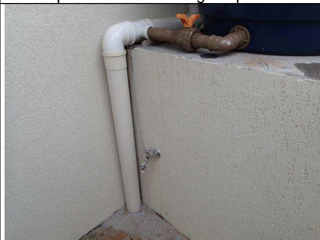
Figura 78C: Registro de limpeza e extravasor - sistema de reaproveitamento de águas pluviais.
