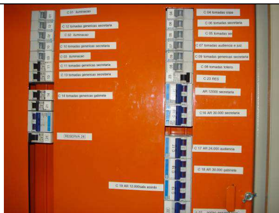
Figura 18E: Quadro elétrico QDC.
