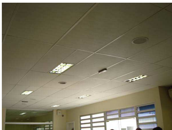
Figura 10E: Luminárias revisadas e novos blocos emergência.
