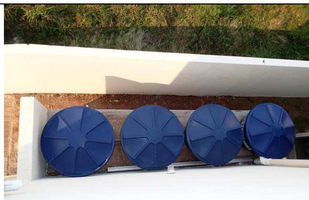
Figura 75C: Reservatórios - sistema de reaproveitamento de águas pluviais.
