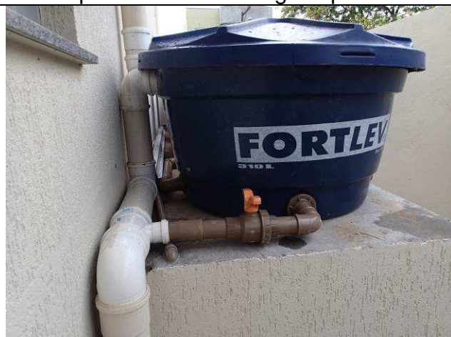
Figura 77C: Registro de limpeza e extravasor - sistema de reaproveitamento de águas pluviais.
