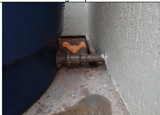
Figura 79C: Registro de distribuição das torneiras - sistema de reaproveitamento de águas pluviais.
