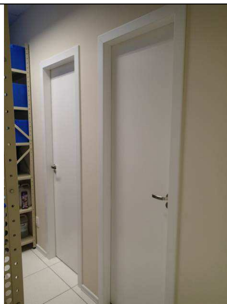
Figura 02C: Portas PM01 - entrada dos banheiros da secretaria da 2ª Vara.
