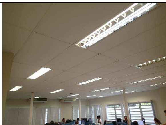
Figura 12E: Luminárias revisadas e novos blocos emergência.
