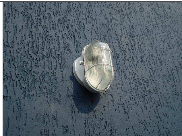
Figura 30E: luminárias externas tipo tartaruga - anexo PAB.
