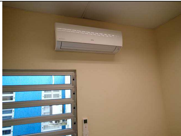
Figura 65C: Evaporadora ar condicionado - sala do assistente do juiz da 2ª Vara.
