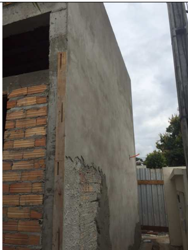
Figura 95C: Revestimento argamassado externo.
