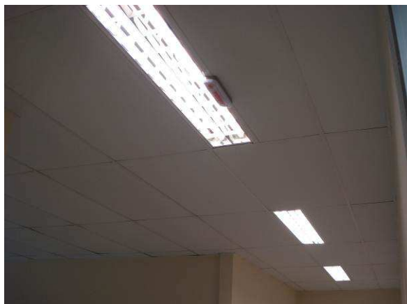
Figura 13E: Luminárias revisadas e novos blocos emergência.
