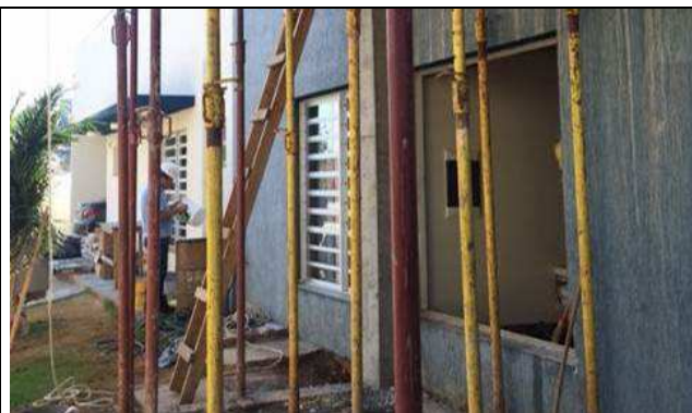
Figura 82C: Janela JA2E removida para reaproveitamento.
