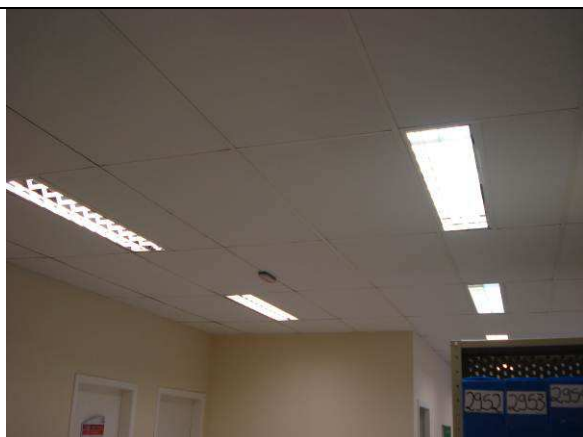
Figura 11E: Luminárias revisadas e novos blocos emergência.
