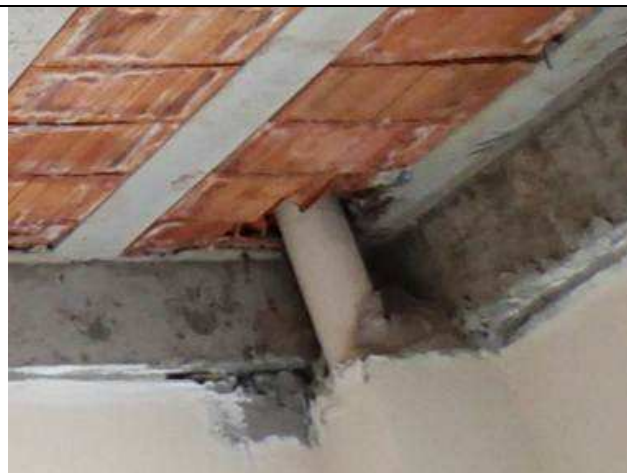
Figura 94C: Conductor de águas pluviais.
