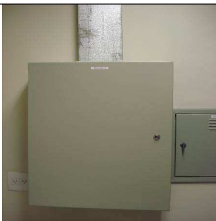
Figura 17E: Quadro elétrico QDC.
