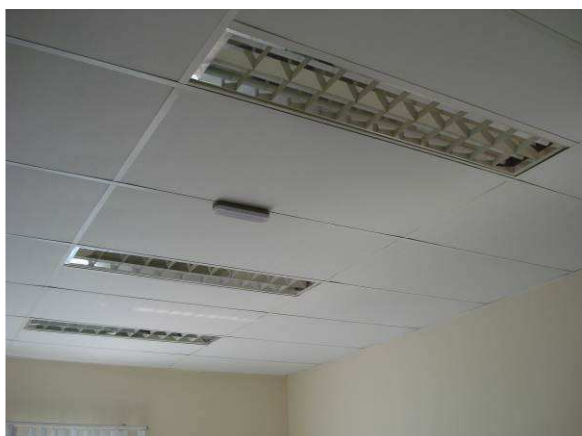
Figura 09E: Luminárias revisadas e novos blocos emergência.
