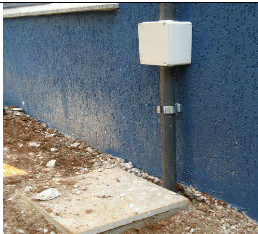
Figura 33E: descida SPDA anexo PAB.
