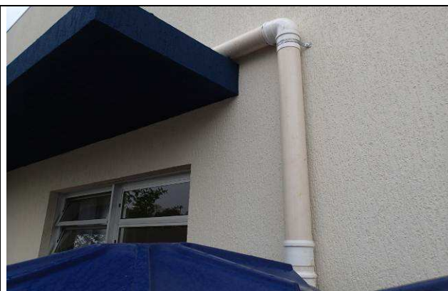
Figura 76C: Captação - sistema de reaproveitamento de águas pluviais.
