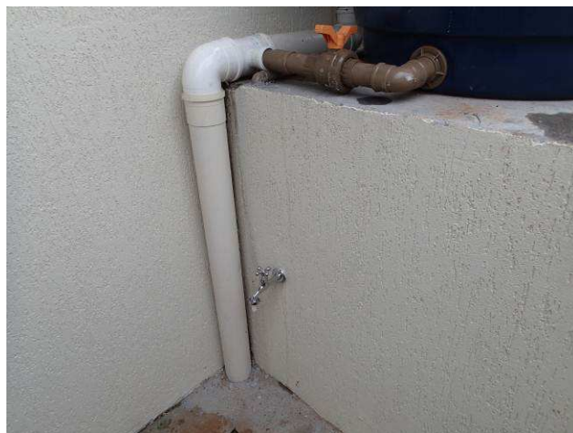
Figura 30C: Ponto de água e torneira do sistema de aproveitamento de águas pluviais.
