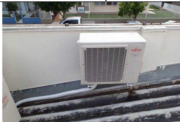
Figura 67C: Condensadora ar condicionado - sala do assistente do juiz da 2ª Vara.
