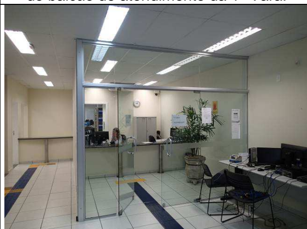
Figura 23: Esquadria em vidro temperado VT3 - balcão de atendimento da 1ª Vara.
