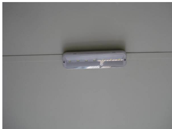
Figura 14E: Luminárias revisadas e novos blocos emergência.
