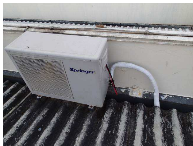
Figura 72C: Condensadora de ar condicionado Split relocada no hall público.
