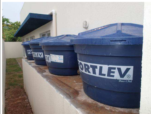
Figura 74C: Reservatórios - sistema de reaproveitamento de águas pluviais.
