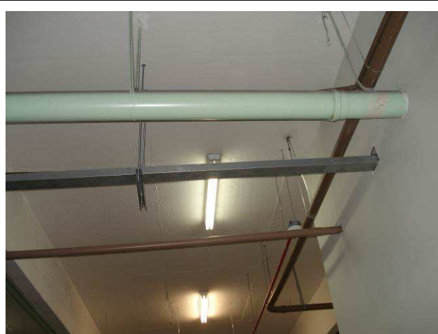
Figura 148C: Executadas as redes frigorígenas em tubos de cobre (embutida na eletrocalha) para instalação dos 2 equipamentos instalados nas salas dos motoristas I e II.
