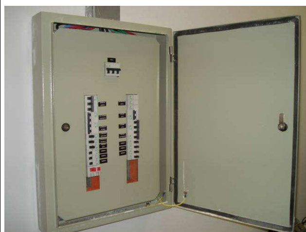
Figura 18E: Quadro elétrico QD-Transportes.
