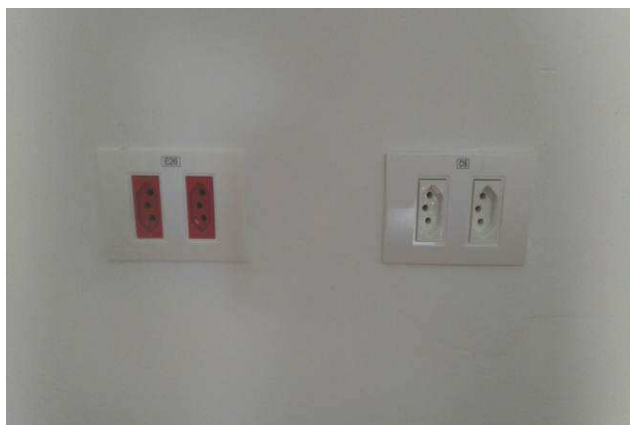
Figura 33E: tomadas elétricas e interruptores.
