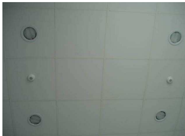
Figura 38E: luminárias 2x23W e sensores presença - banheiros públicos.
