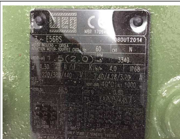
Figura 181C: Detalhe da placa de identificação das bomba.
