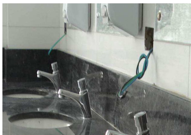
Figura 25E: circuitos elétricos iluminação, rede comum e rede estabilizada.
