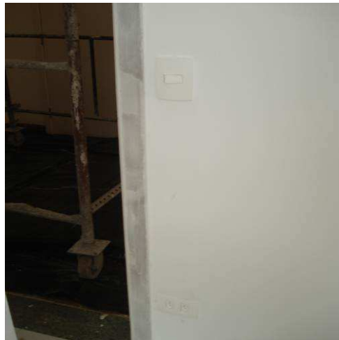
Figura 32E: tomadas elétricas e interruptores.
