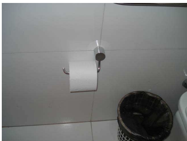
Figura 57C: Detalhe de papeleira instalada no banheiro PNE.
