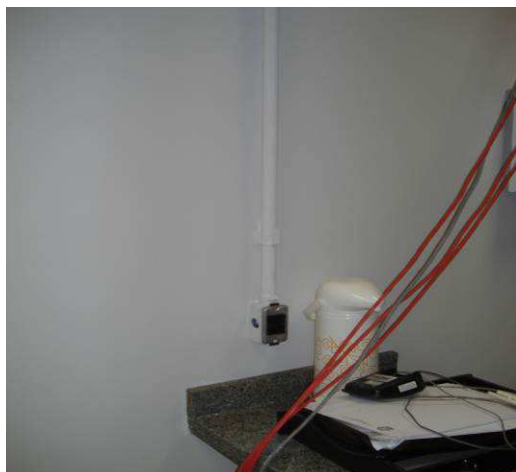
Figura 01E: infraestrutura para instalações elétricas - caixas, condutores, eletrodutos, perfilados.
