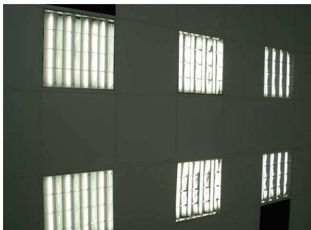
Figura 40E: luminárias 4x16W - embutir com aletas - consultório e ambulatório.
