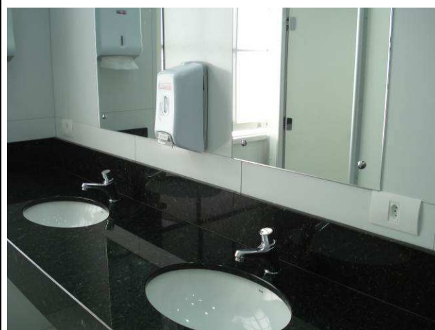
Figura 30E: tomadas elétricas e interruptores.
