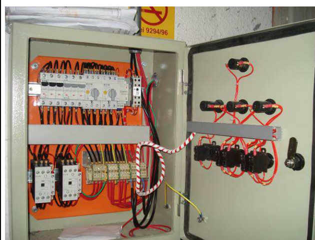
Figura 22E: Quadro elétrico comando QD-Bombas.
