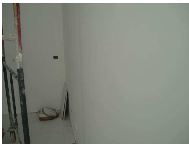
Figura 89C: Executados emassamento, lixamento e pintura em tinta látex acrílica (marca Luz & Cor), na cor branco gelo, nas paredes do ambulatório.
