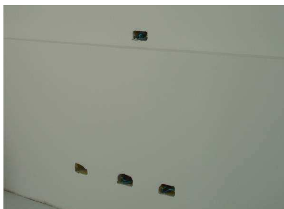
Figura 28E: circuitos elétricos iluminação, rede comum e rede estabilizada.
