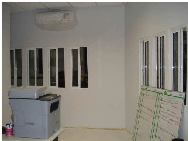
Figura 105C: Foram instaladas as janelas JA 0,50x1,10m, previstas para a área de convívio da sala dos motoristas.
