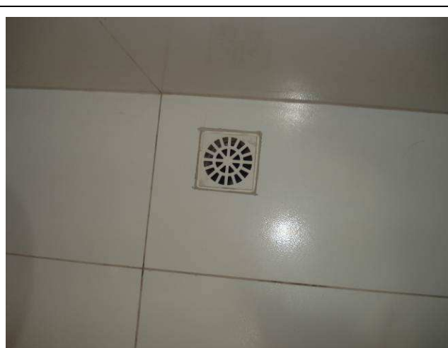
Figura 46C: Caixa sifonada instalada no banheiro PNE, com respectivo acabamento e grelha.
