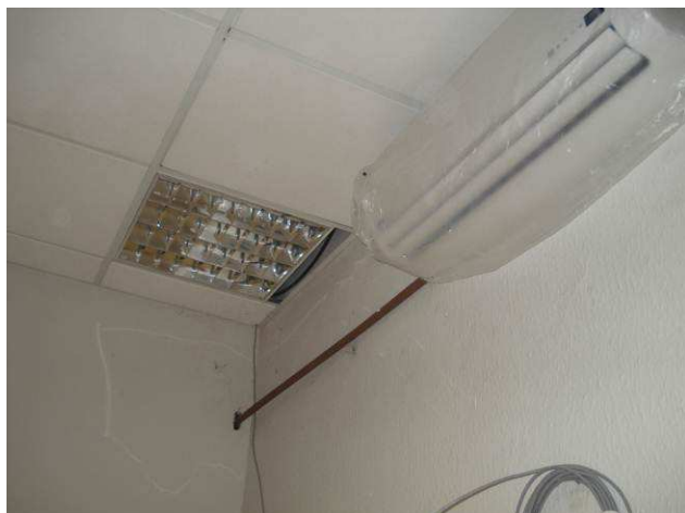
Figura 152C: Condicionador de ar tipo Split, 18.000 BTUs, instalado na sala dos motoristas I.
