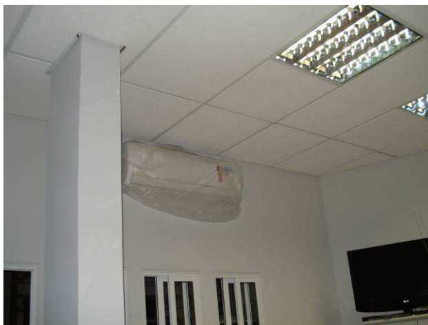
Figura 153C: Condicionador de ar tipo Split, 29.000 BTUs, instalado na sala dos motoristas II.
