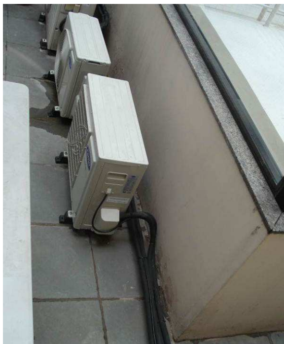
Figura 81C: Foi finalizada a rede frigorígena externa (conexão à unidade condensadora) para instalação de condicionadores de ar do consultório e ambulatório.
