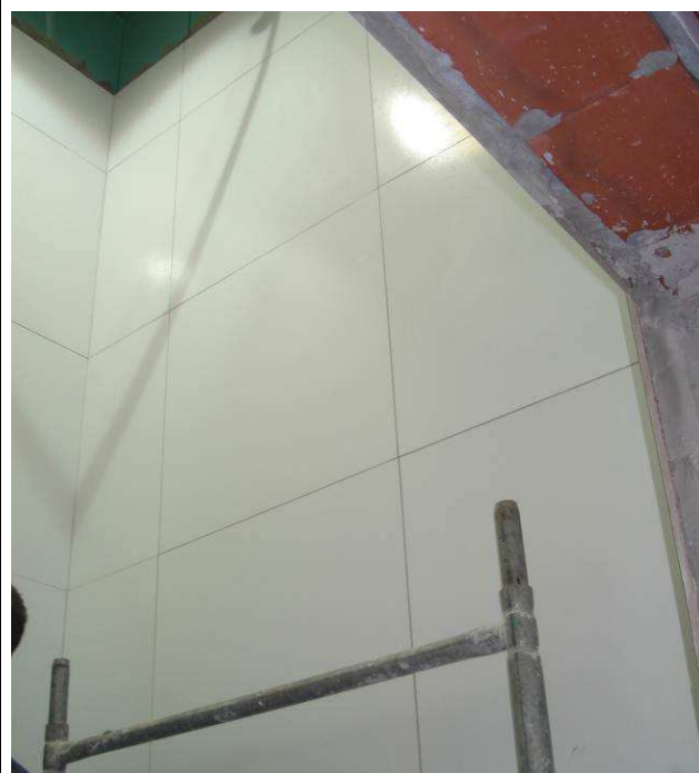
Figura 24C: Concluído assentamento e rejuntamento de porcelanato retificado Nórdico Snow, 60x60 cm, marca Incepa, nas paredes do banheiro PNE.
