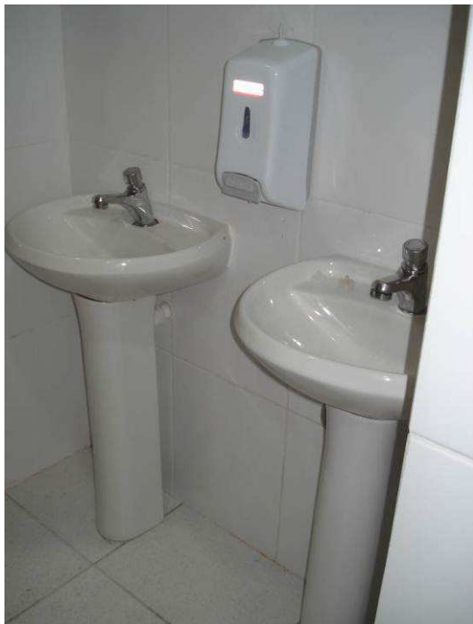
Figura 123C: Lavatórios com coluna e válvulas de escoamento cromadas, marca Deca, instalados no banheiro/vestiário masculino.
