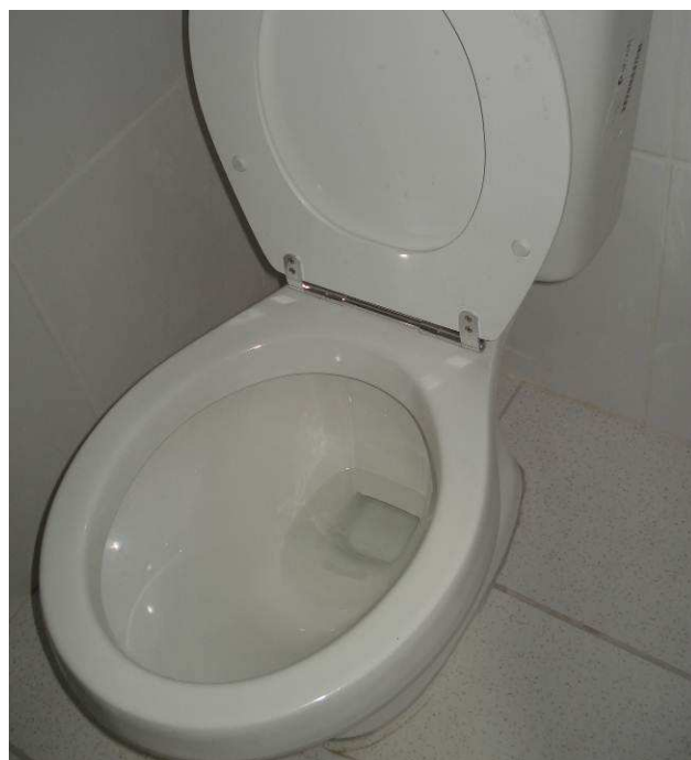
Figura 122C: Bacia sanitária com caixa acoplada, marca Deca, instalada no banheiro/sanitário masculino. Utilizados engates cromados.
