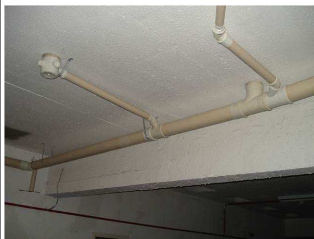
Figura 170C: Tubulação de condução dos dejetos (Ø 100 mm) até a estação elevatória de esgoto.
