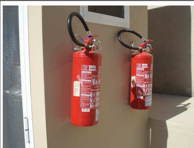
Figura 156C: Instalados 2 extintores classe ABC (6kg), junto ao abrigo da central GLP.
