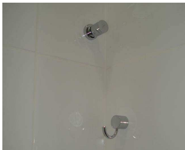
Figura 120C: Instalados canopla e acabamentos cromados para os registros de gaveta 3/4" do banheiro/vestiário feminino.
