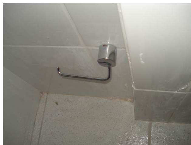
Figura 126C: Papeleira em metal cromado (marca Deca) instalada junto à bacia sanitária do banheiro feminino.
