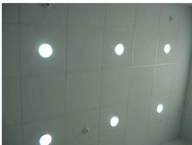
Figura 35E: luminárias 2x23W e sensores presença - banheiros públicos.
