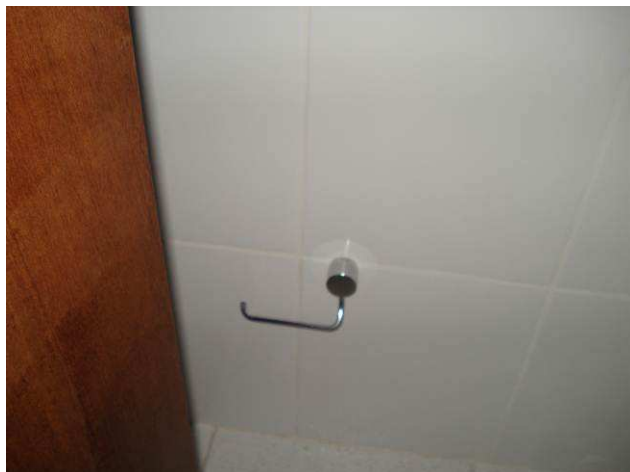
Figura 127C: Papeleira em metal cromado (marca Deca) instalada junto à bacia sanitária do banheiro masculino.
