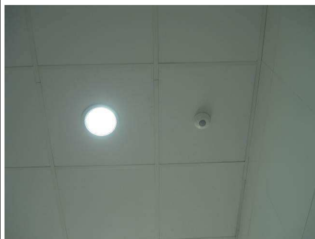
Figura 36E: luminárias 2x23W e sensores presença - banheiros públicos.
