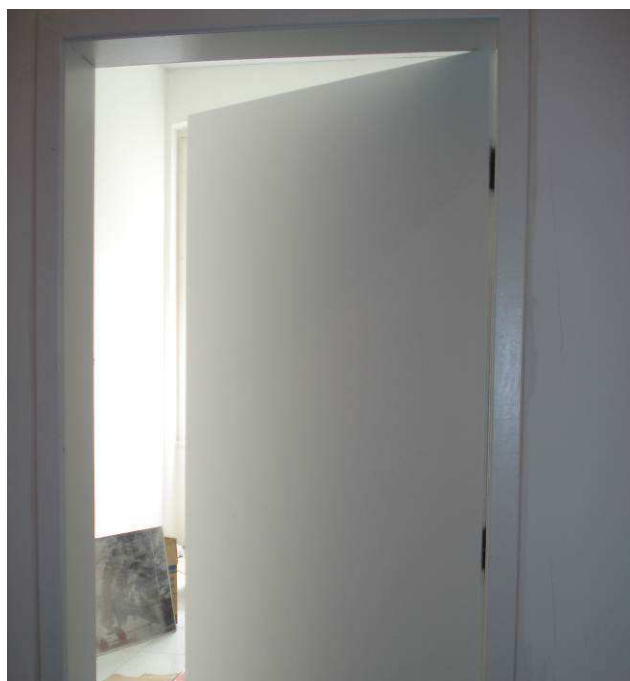
Figura 15C: Porta PM 090 instalada no acesso ao ambulatório (pela circulação).
