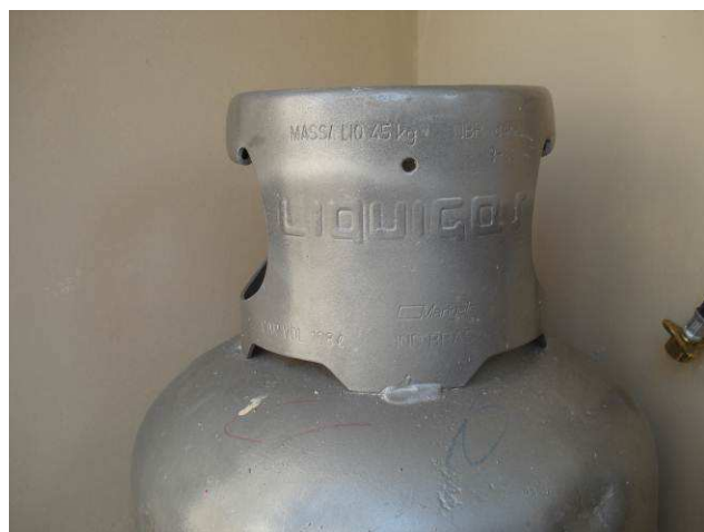
Figura 154C: Instalado Kit para instalação de gás, (2 botijões com carga, 01 regulador, 02 válvulas de retenção e 02 chicotes).
