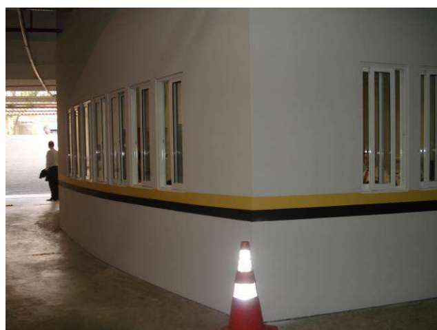
Figura 142C: Executada pintura externa da sala dos motoristas com tinta látex acrílica, cor branco gelo, marca Luz & Cor, com faixa zebraada.
