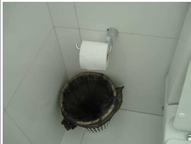
Figura 56C: Detalhe de papeleira instalada no banheiro masculino.
