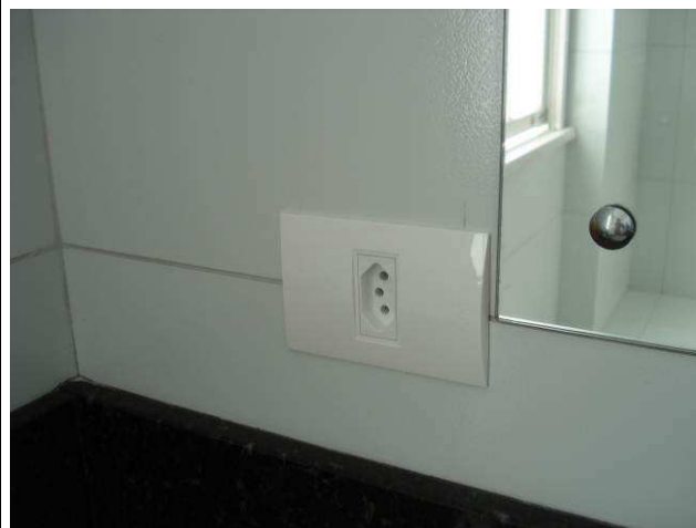
Figura 34E: tomadas elétricas e interruptores.
