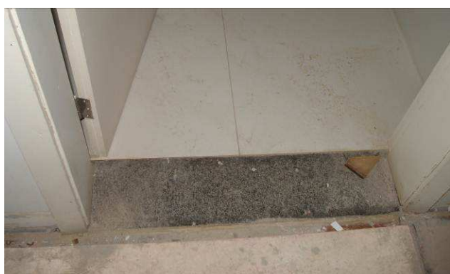
Figura 37C: Soleira em granito polido cinza andorinha, instalado junto à porta de acesso ao banheiro masculino.
