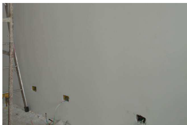
Figura 27E: circuitos elétricos iluminação, rede comum e rede estabilizada.
