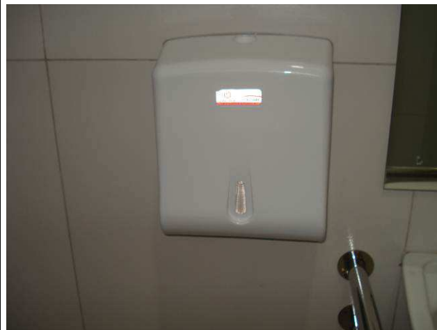
Figura 64C: Instalado 1 dispenser para papel toalha junto ao lavatório do banheiro PNE.
