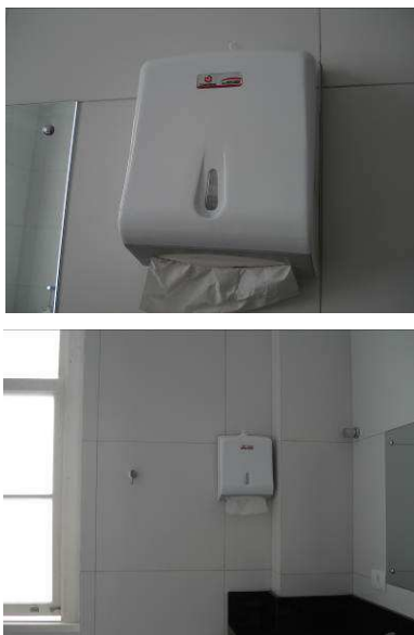
Figura 63C: Instalados 2 dispensers para papel toalha junto à bancada do banheiro masculino.
