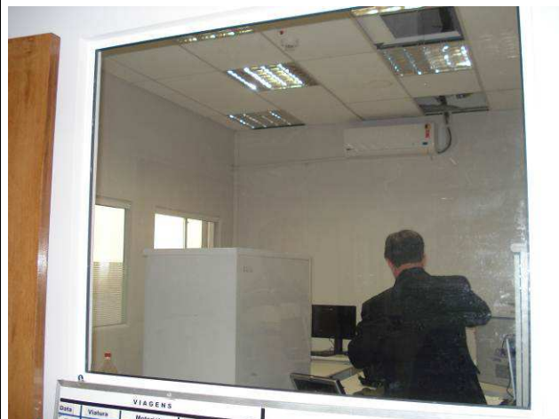
Figura 108C: Instalado caixilho e vidro fixo (4mm) incolor, na parede de divisa entre as salas de motoristas I e II.
