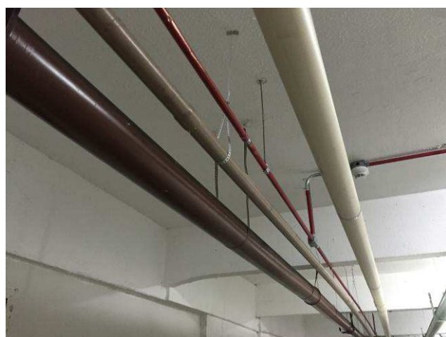
Figura 169C: Tubulação de condução dos dejetos (Ø 60 mm), e tubulação de ventilação (Ø 75 mm) da estação elevatória de esgoto.
