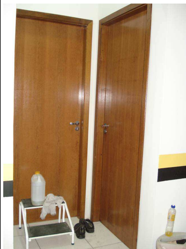
Figura 145C: Porta de acesso aos banheiros/vestiários feminino e masculino pintadas, conforme especificações da figura ao lado.
