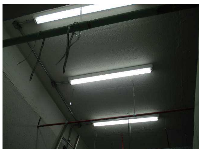
Figura 17E: luminárias tipo calha - depósito lixo.
