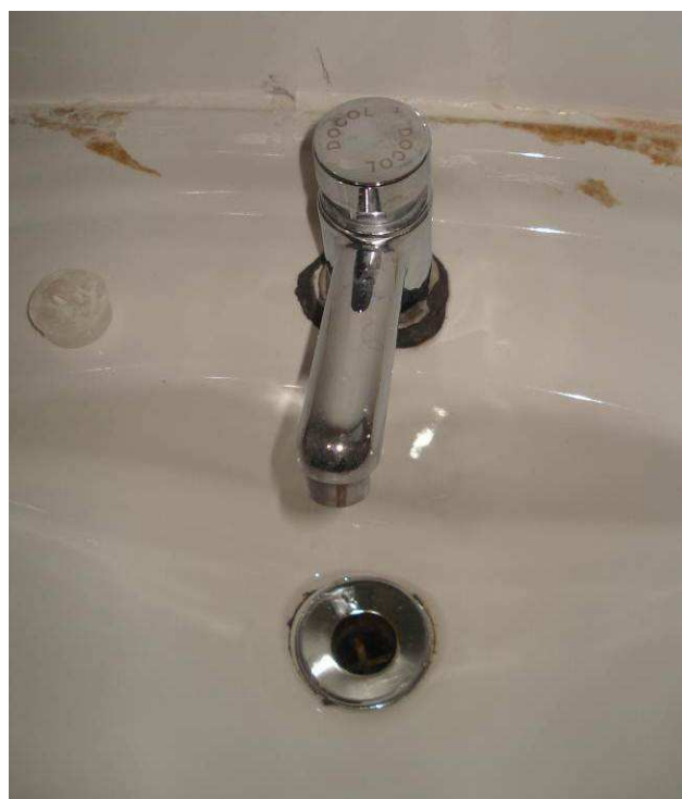
Figura 137C: Foi instalada 1 torneira de pressão cromada (marca Docol) para o lavatório do banheiro/vestiário feminino.
