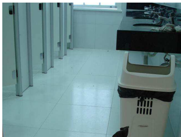
Figura 04C: Realizada limpeza final da obra, com remoção de materiais e entulho remanescentes.
