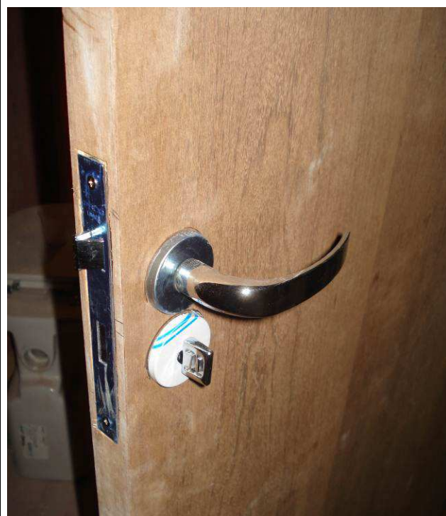
Figura 20C: Foram utilizadas fechadura 40mm, da linha ZM Copa, marca Pado e maçaneta tipo alavanca com roseta em acabamento cromado.
