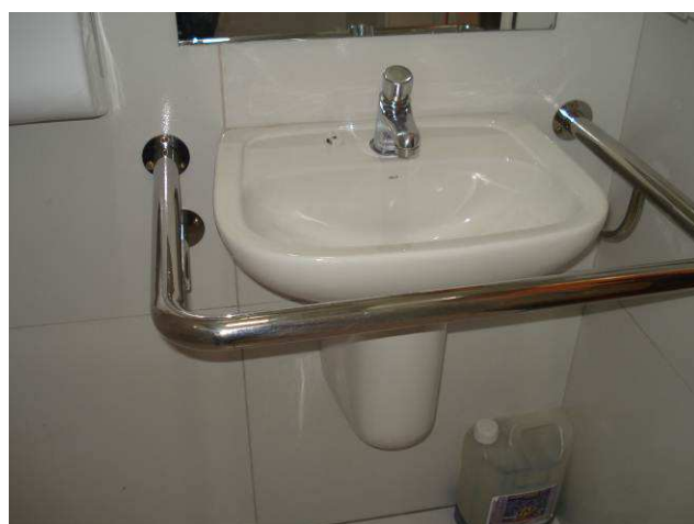
Figura 77C: Barra de apoio em aço inox escovado, instalada junto ao lavatório do banheiro PNE.
