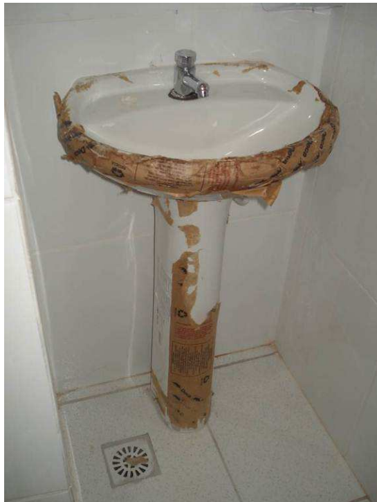
Figura 124C: Lavatório com coluna e válvula de escoamento cromada, marca Deca, instalado no banheiro/vestiário feminino.
