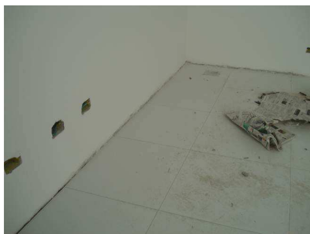
Figura 29E: circuitos elétricos iluminação, rede comum e rede estabilizada.
