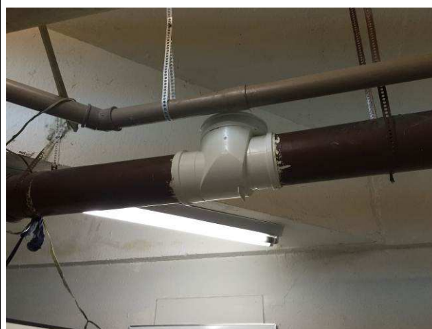
Figura 172C: Válvula de retenção horizontal (Ø 150 mm) no final da rede existente.
