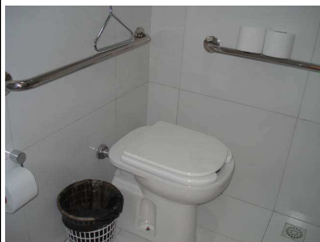
Figura 78C: Barras de apoio em aço inox escovado, instaladas junto ao vaso sanitário do banheiro PNE.
