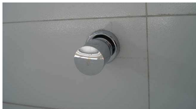
Figura 42C: Executados acabamentos e instalada canopla cromada do registro de gaveta 1.1/2" do banheiro PNE (Deca).
