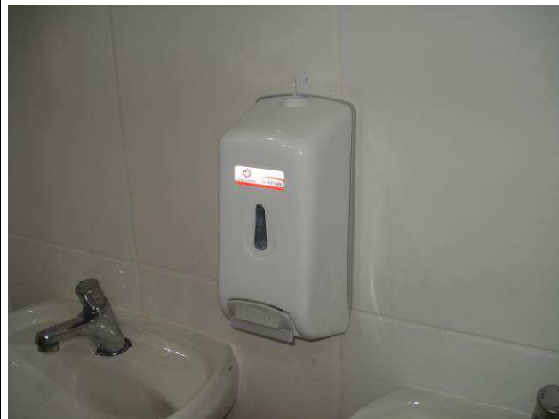
Figura 128C: Saboneteira de plástico instalada junto aos lavatórios do banheiro/vestiário masculino.
