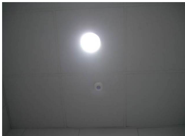
Figura 37E: luminárias 2x23W e sensores presença - banheiros públicos.
