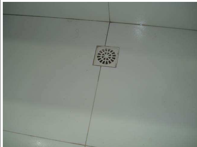
Figura 45C: Caixa sifonada instalada no banheiro masculino, com respectivo acabamento e grelha.
