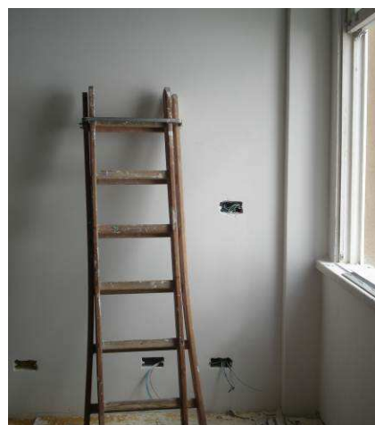
Figura 24E: infraestrutura para instalações elétricas - caixas, condutores, eletrodutos.
