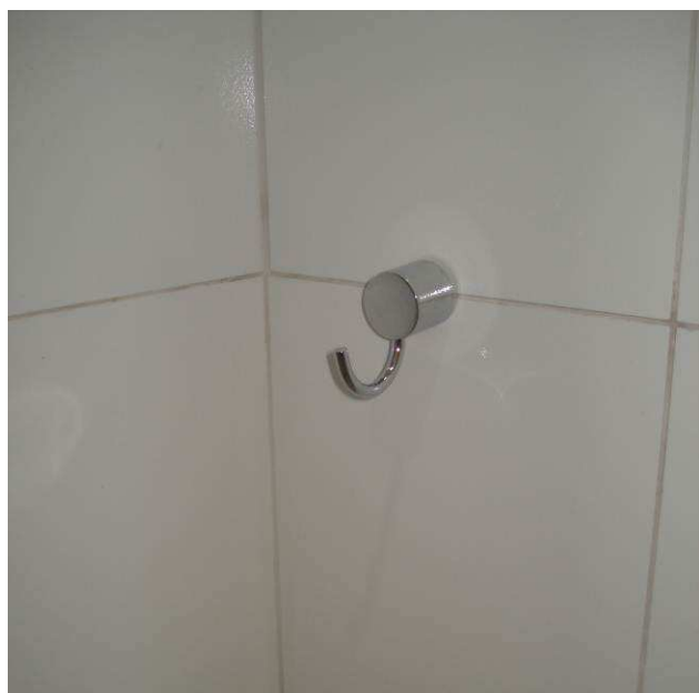
Figura 69C: Toalheiro instalado junto ao lavatório do banheiro PNE.
