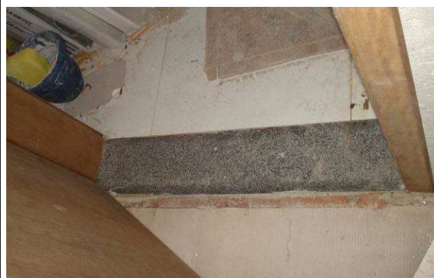
Figura 36C: Soleira em granito polido cinza andorinha, instalado junto à porta de acesso ao banheiro PNE.
