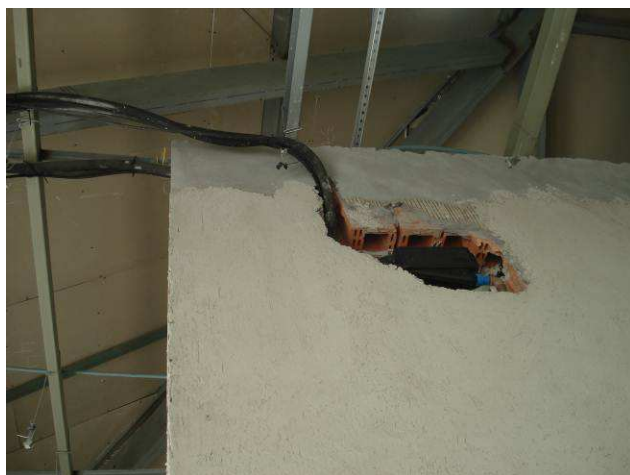
Figura 80C: Foi finalizada a rede frigorígena (conexões aos equipamentos/carga de gás) para instalação de condicionadores de ar do consultório e ambulatório.
