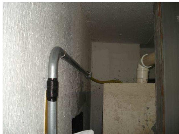
Figura 02E: infraestrutura para instalações elétricas - caixas, condutores, eletrodutos, perfilados.
