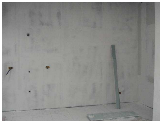
Figura 03E: infraestrutura para instalações elétricas - caixas, condutores, eletrodutos, perfilados.
