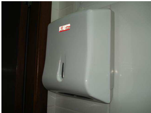
Figura 131C: Instalado 1 dispenser para papel toalha junto ao lavatório do banheiro/vestiário feminino.
