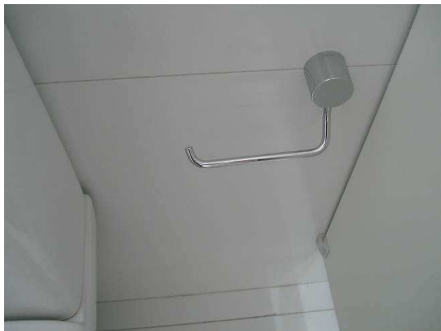
Figura 55C: Detalhe de papeleira instalada no banheiro feminino.
