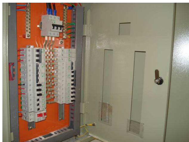
Figura 19E: Quadro elétrico QD-Transportes.
