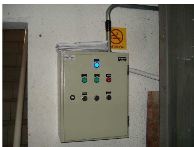
Figura 21E: Quadro elétrico comando QD-Bombas.
