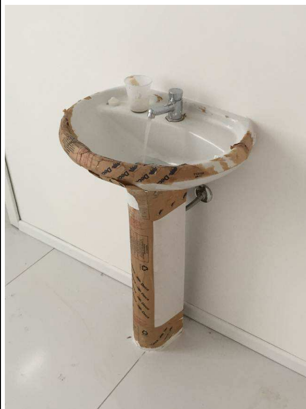
Figura 76C: Lavatório instalado no ambulatório.
