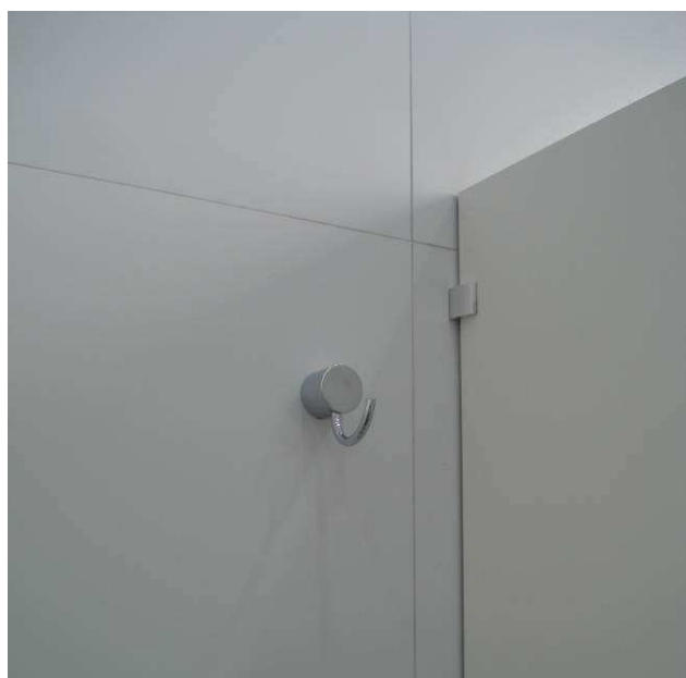
Figura 67C: Toalheiro instalado junto à vaso sanitário do banheiro feminino.
