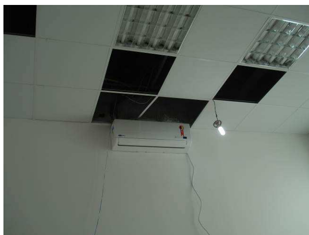
Figura 85C: Condicionador de ar tipo Split, 18.000 BTUs, sistema Inverter, instalado no consultório.
