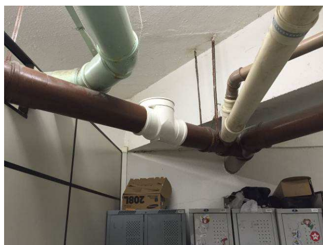
Figura 171C: Válvula de retenção horizontal (Ø 150 mm) no final da rede existente.
