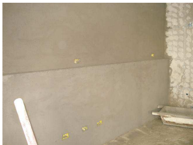
Figura 23E: infraestrutura para instalações elétricas - caixas, condutores, eletrodutos.
