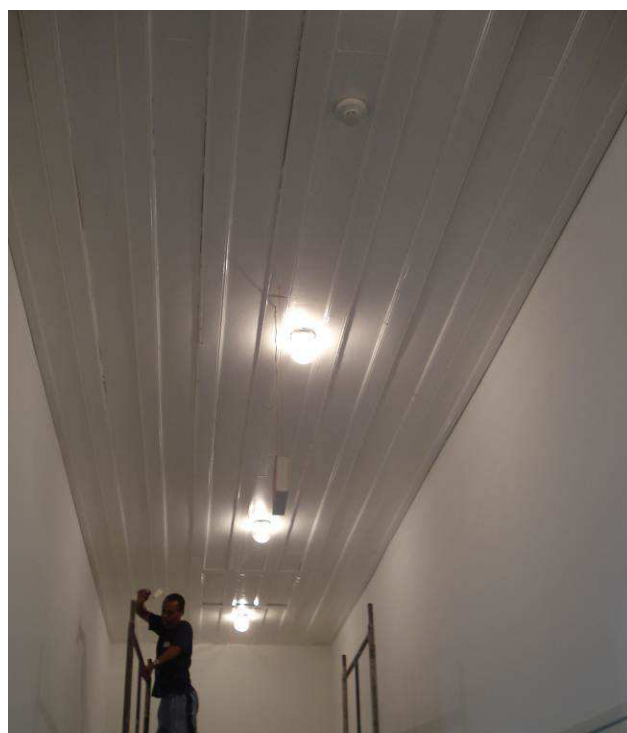
Figura 93C: Executada pintura em esmalte sintético brilhante (marca Glasurit), cor branca, no teto da circulação.
