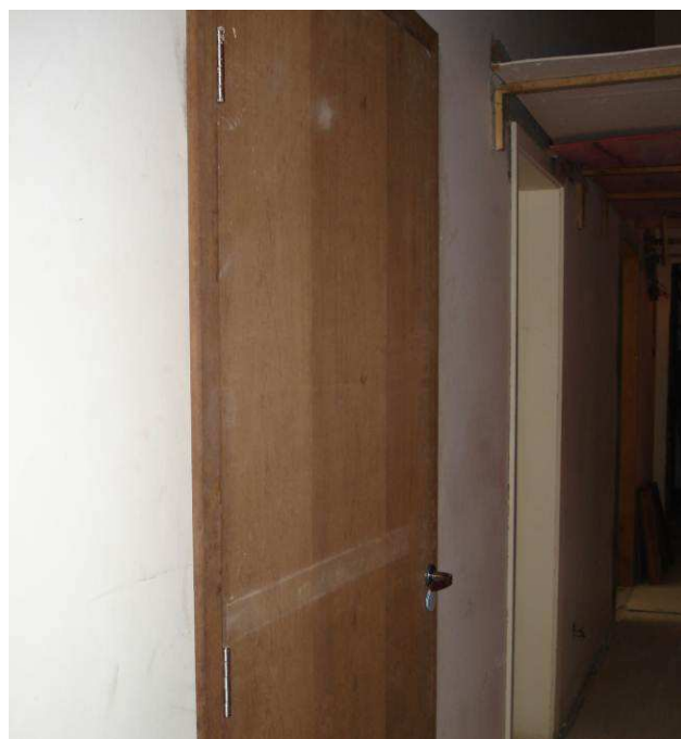
Figura 16C: Porta PM 090 instalada no banheiro PNE.
