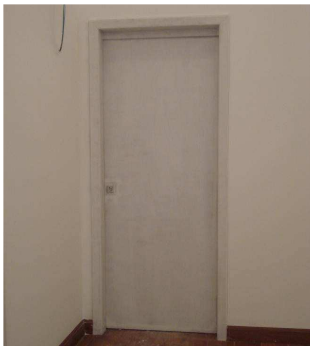
Figura 13C: Porta PM 090 instalada no acesso ao consultório (pela sala de espera).
