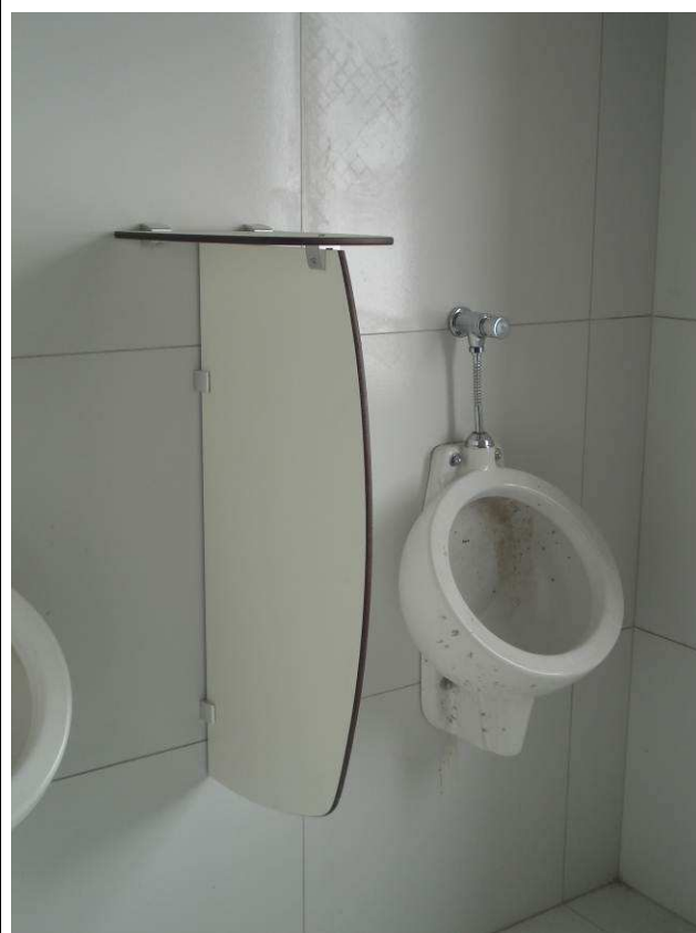
Figura 11C: Tapa-mictório instalado no banheiro masculino.
