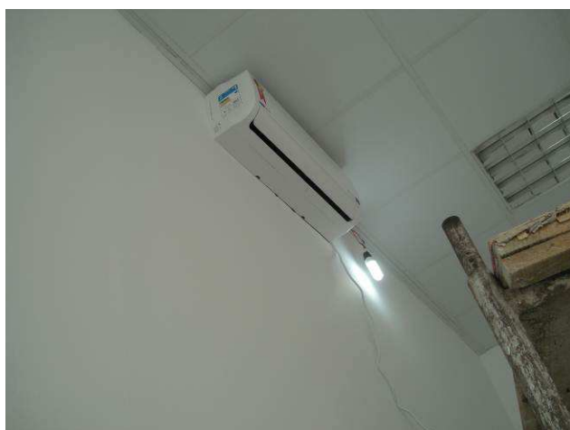
Figura 84C: Condicionador de ar tipo Split, 12.000 BTUs, marca Carrier, sistema Inverter, instalado no ambulatório.
