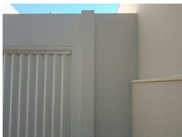
Figura 12C: Pintura do muro da entrada da garagem
