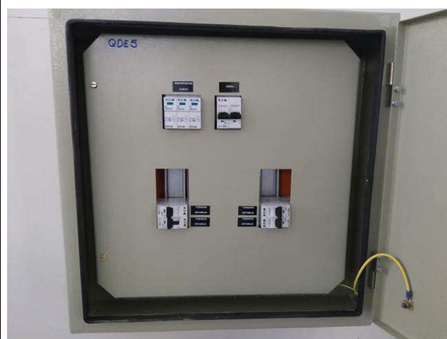
Figura 14E: Quadro elétrico QDE-5.
