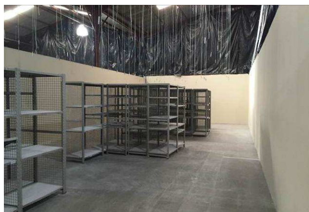
Figura 49C: Paredes pintadas - sala refrigerada.
