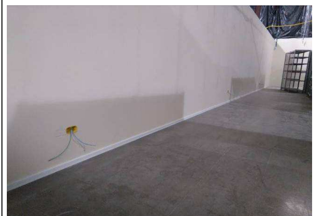
Figura 04E: Infra estrutura - caixas 2x4" e eletrodutos; cabos 2,5mm 2 .
