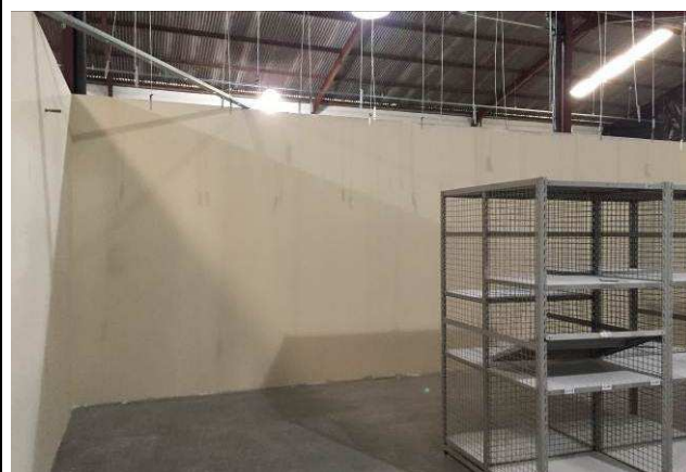
Figura 50C: Paredes pintadas - sala refrigerada.
