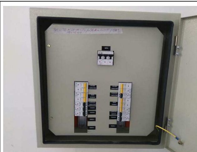
Figura 12E: Quadro elétrico QDC-18.
