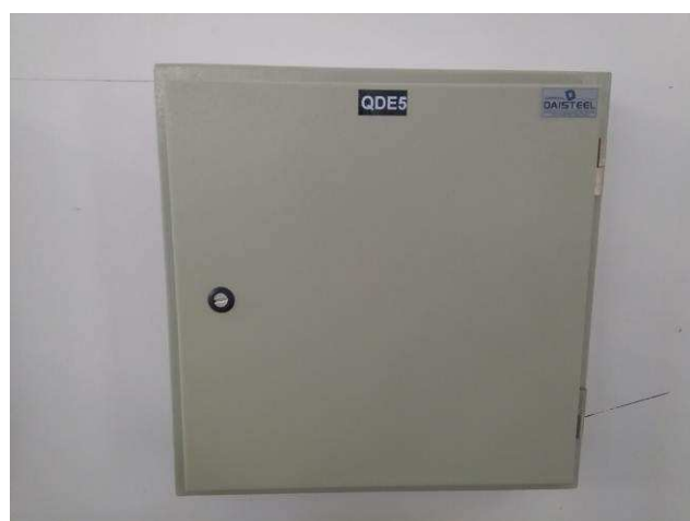
Figura 13E: Quadro elétrico QDE-5.
