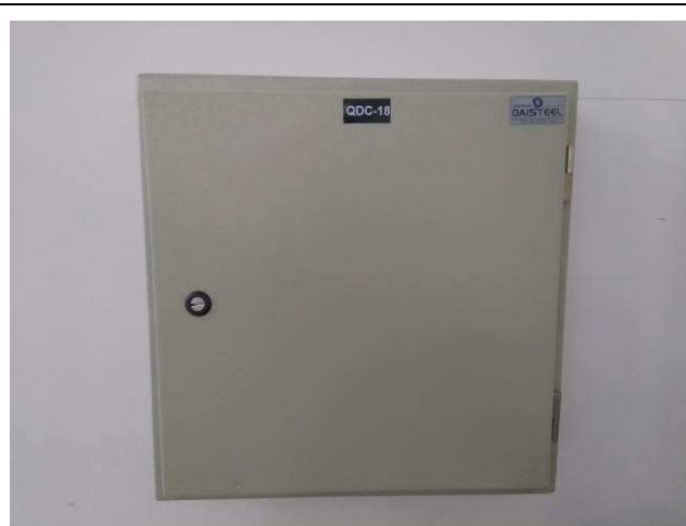
Figura 11E: Quadro elétrico QDC-18.
