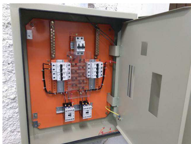
Figura 10E: Quadro elétrico QDC-17.
