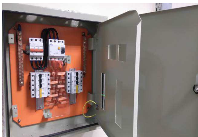
Figura 08E: Quadro elétrico QDAR-1.
