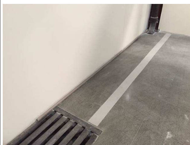
Figura 34C: Drenos em tubos de PVC - interligação à caixa de águas pluvias da sala reserva.
