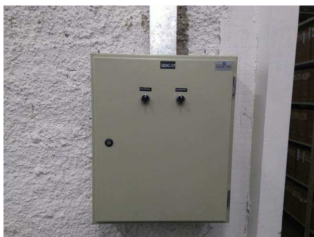
Figura 09E: Quadro elétrico QDC-17.
