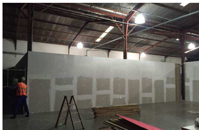
Figura 25C: Montagem das paredes de gesso acartonado - aplicação de fita e massa nas juntas.
