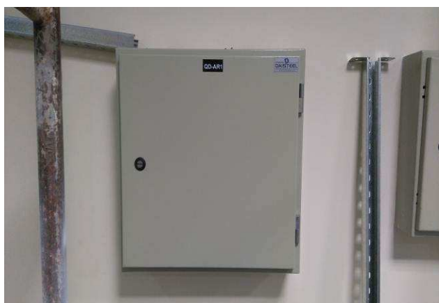
Figura 07E: Quadro elétrico QDAR-1.
