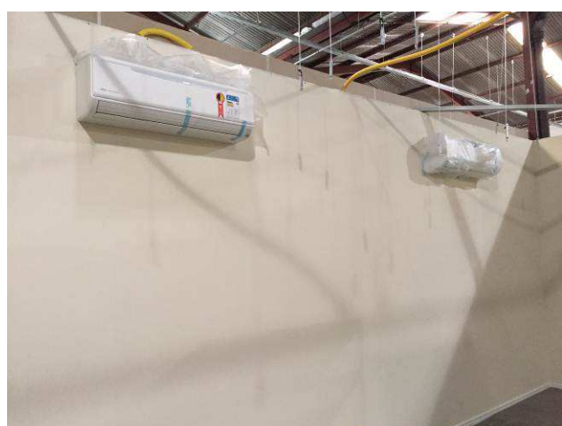
Figura 37C: Evaporadoras de 18.000 BTU's - ASBA18LEC Fujitsu.
