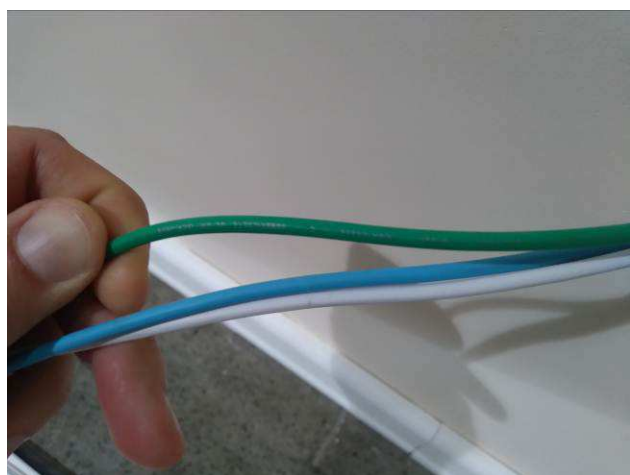
Figura 05E: Cabos 2,5mm 2 .
