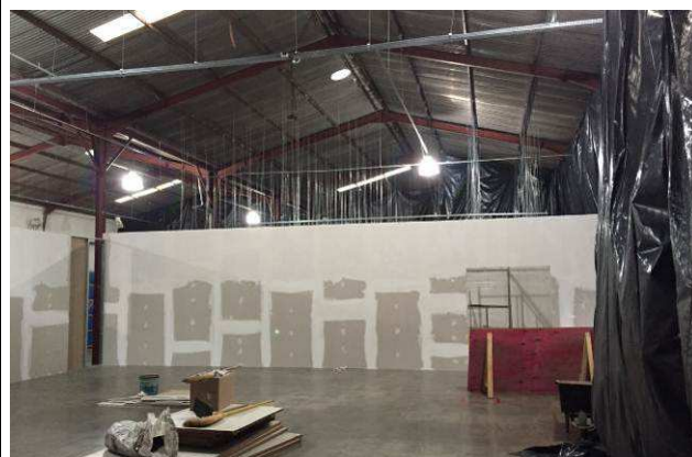
Figura 26C: Montagem das paredes de gesso acartonado - aplicação de fita e massa nas juntas.
