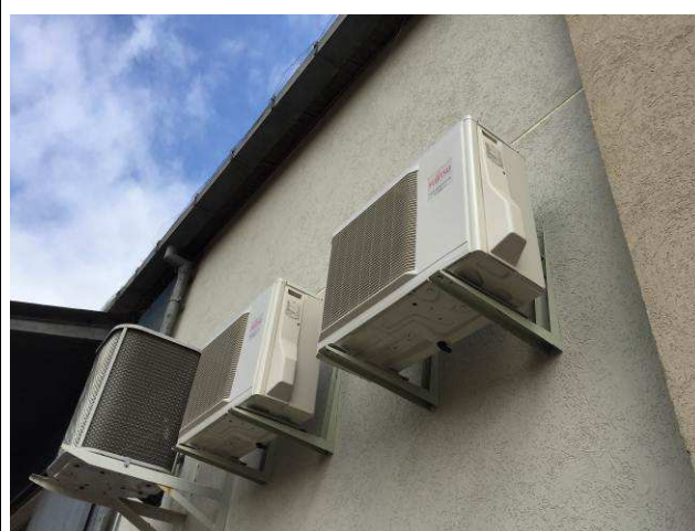
Figura 38C: Condensadoras de 18.000 BTU's - AOBR18LEC Fujitsu.
