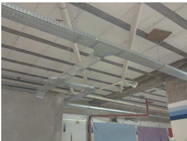
Figura 01E: Eletrocalhas (fundo #200x100, frente #200x50) instaladas no pavimento térreo
