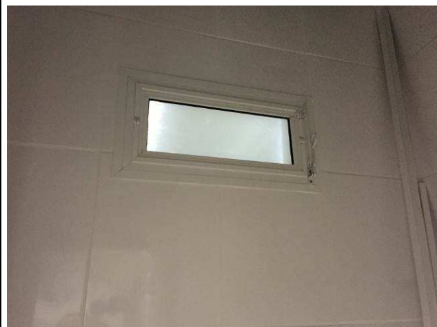
Figura 65C: Janela JA 0,60x0,30 m, instalada no banheiro masculino.
