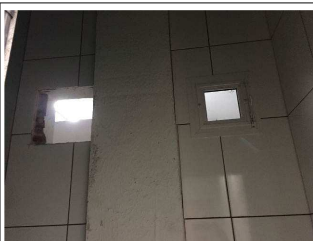
Figura 66C: Janela JA 0,30x0,30 m, instalada no banheiro feminino (à direita).
