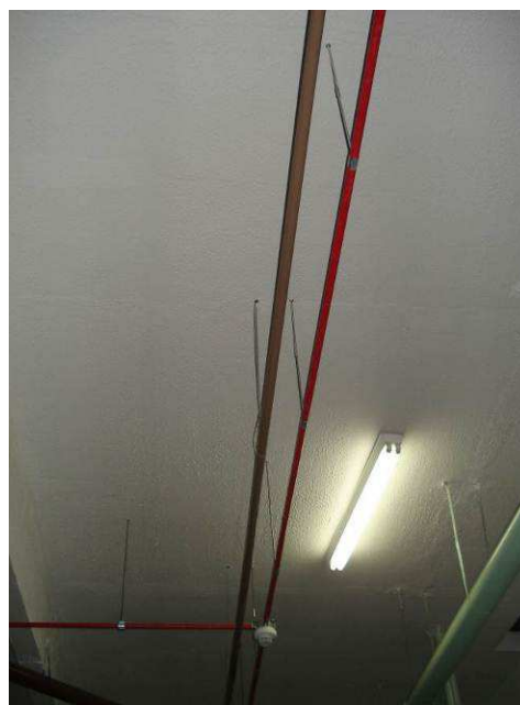
Figura 77C: Detalhe da tubulação identificada ao lado.
