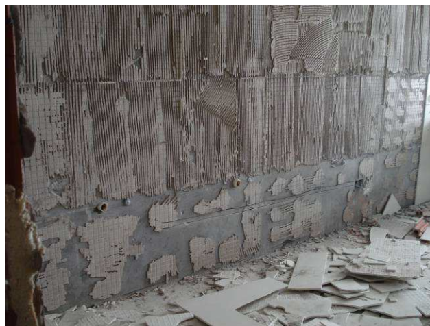
Figura 17C: Azulejo removido no banheiro masculino existente.
