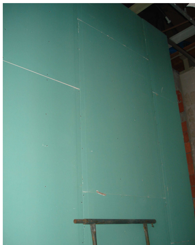
Figura 33C: Parede em gesso acartonado verde (áreas úmidas) instalada na divisa entre os banheiros feminino e masculino.
