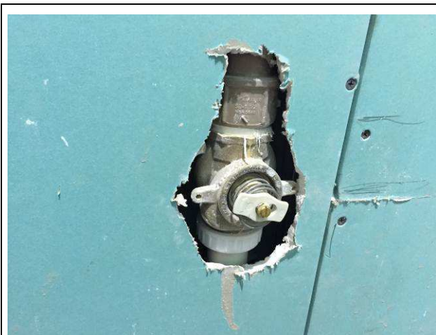
Figura 53C: Base para válvula de descarga metálica, marca Docol, instalada no banheiro PNE.
