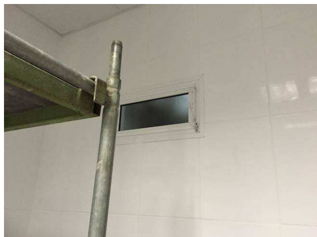
Figura 64C: Janela JA 0,60x0,30 m, instalada no banheiro masculino.
