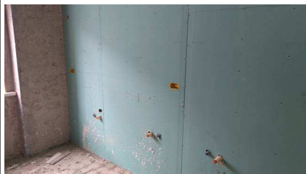
Figura 04E: caixas 2x4" e eletrodutos corrugados - banheiro feminino público 2º piso casarão.
