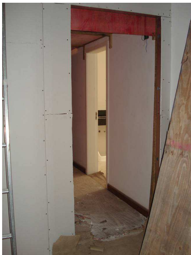
Figura 29C: Parede em gesso acartonado simples instalada no fechamento da sala da espera (vista interior sala de espera).
