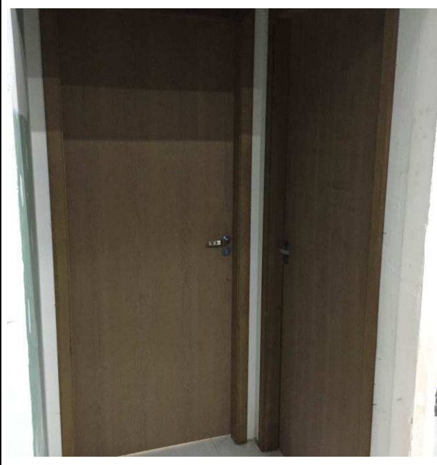
Figura 61C: Porta PM80 instalada no acesso aos banheiros feminino e masculino.
