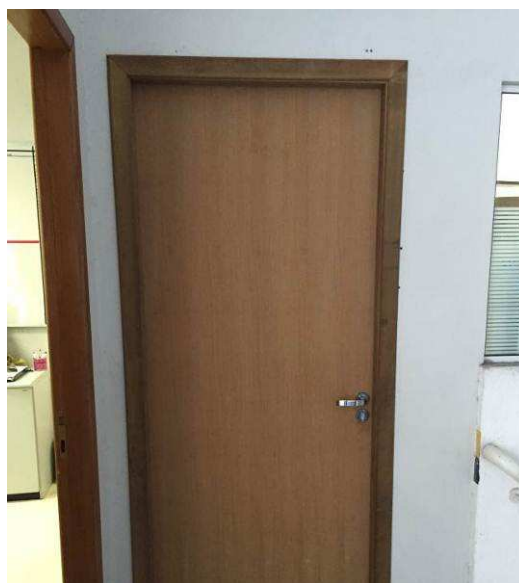
Figura 55C: Houve demolição de parede para instalação de porta, possibilitando o acesso externo à sala dos motoristas II.
