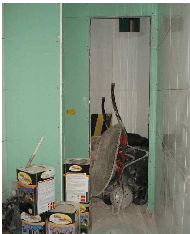
Figura 70C: Área do banheiro/vestiário feminino com assentamento parcial de azulejos Eliane, 33x45 cm, da linha Forma, na cor branca. Pendente execução de rejuntamento.
