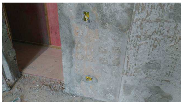
Figura 03E: caixas 2x4" e eletrodutos corrugados - banheiro feminino público 2º piso casarão.
