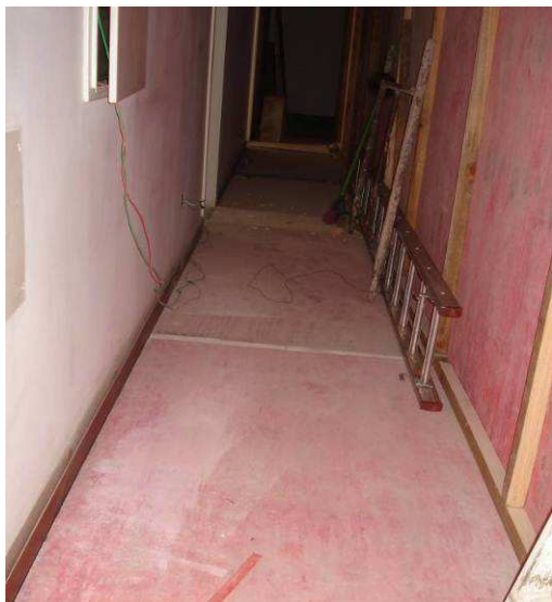
Figura 03C: Chapa de madeira compensada (e= 4mm), utilizada para proteção do piso de madeira do corredor, na sobreloja do Casarão.
