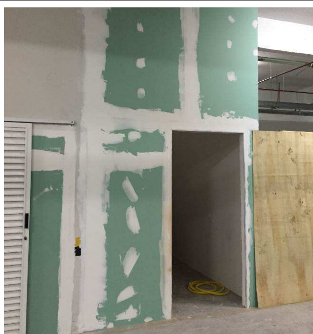
Figura 58C: Trecho instalado de parede em gesso acartonado RU, cor verde, delimitando o depósito de lixo anexo aos banheiros/vestiários dos motoristas.
