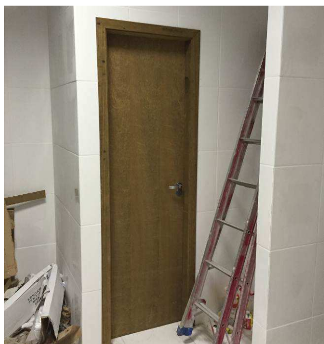
Figura 60C: Porta PM70 instalada no acesso ao cubículo do vaso sanitário do banheiro masculino.
