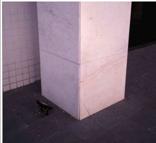
Figura 02E: luminária projetor fachada Ed. Rio Branco (última - lateral esquerda).
