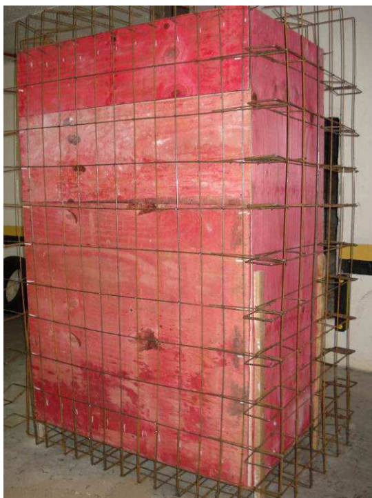
Figura 91C: Executada forma e armação da caixa elevatória de esgoto, localizada no subsolo II.
