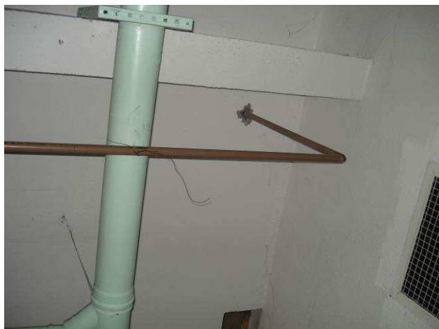
Figura 76C: Trecho da tubulação, localizado abaixo da laje de cobertura do subsolo I (tubulação revestida com tubos de PVC).
