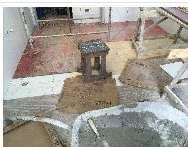
Figura 44C: Piso assentado no banheiro feminino (na foto, protegido com chapas de madeira). Utilizados espaçadores de 1,5 mm de espessura.
