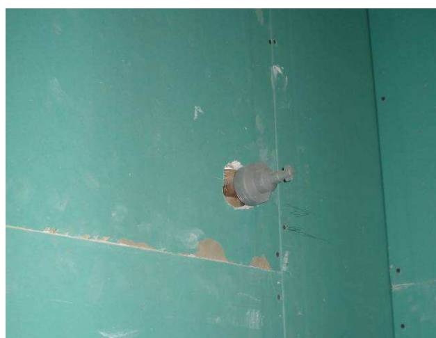
Figura 52C: Registro de gaveta 3/4"(Docol), instalado no banheiro PNE. Pendente instalação de canopla e acabamento cromado.
