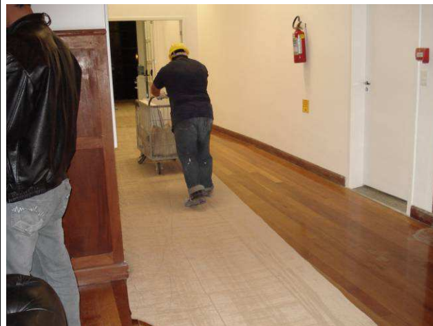
Figura 04C: Papel ondulado utilizado para proteção de piso do corredor do térreo, possibilitando transporte de materiais e entulho.
