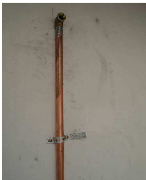
Figura 75C: Detalhe da fixação da tubulação identificada ao lado.
