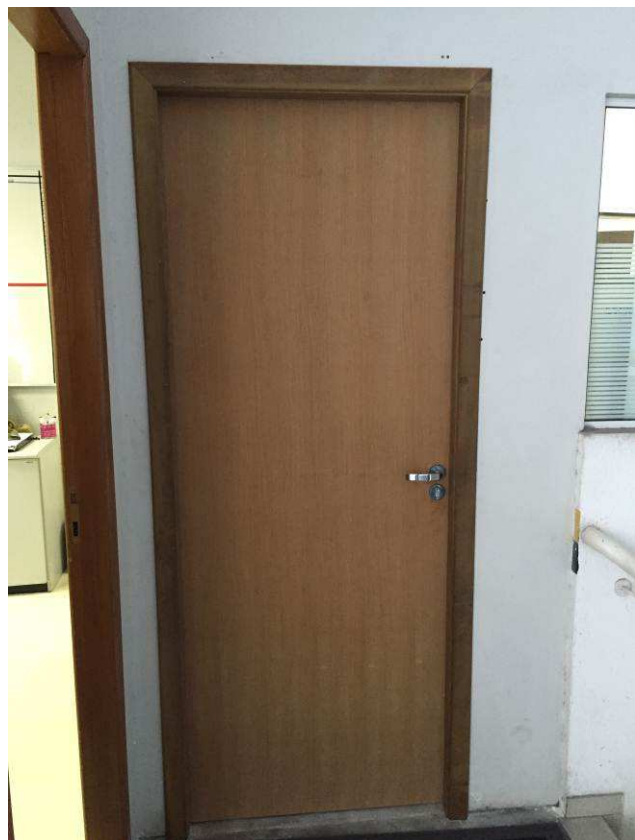
Figura 62C: Porta PM80 instalada no acesso externo à sala dos motoristas II. Foram utilizadas 3 dobradiças por porta.
