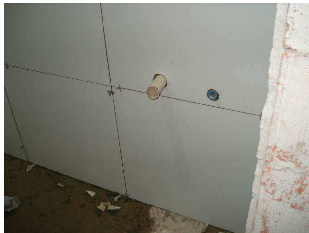
Figura 50C: Executados 1 ponto de água fria (Ø 25 mm) e esgoto secundário (Ø 50 mm) para lavatório do banheiro PNE.
