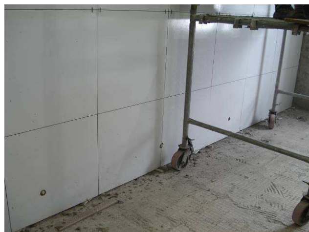
Figura 45C: Executados 3 pontos de água fria (Ø 25 mm) e esgoto primário (Ø 100 mm) para vasos sanitários do banheiro feminino.
