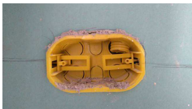
Figura 07E: caixas 2x4" e eletrodutos corrugados - banheiro feminino público 2º piso casarão.
