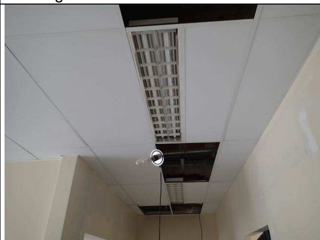
Figura 22C: Forro modular - acesso distribuição.
