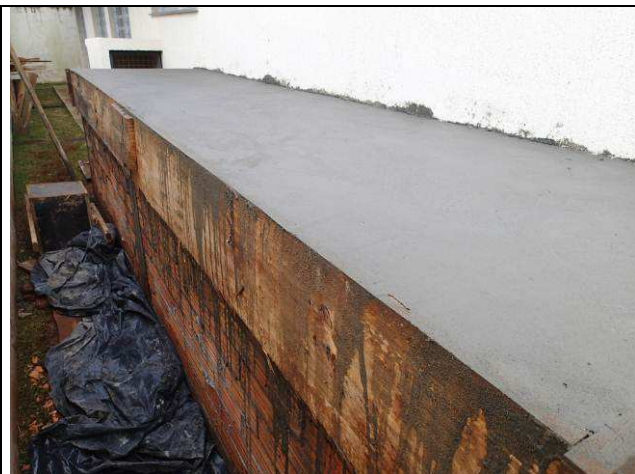
Figura 52C: Estrutura de concreto armado, e alvenaria de vedação, da base dos reservatórios de aproveitamento de águas pluviais.
