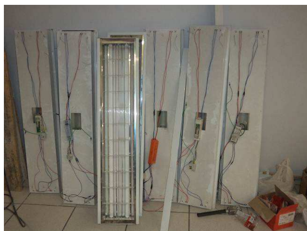
Figura 19E: luminárias em revisão.
