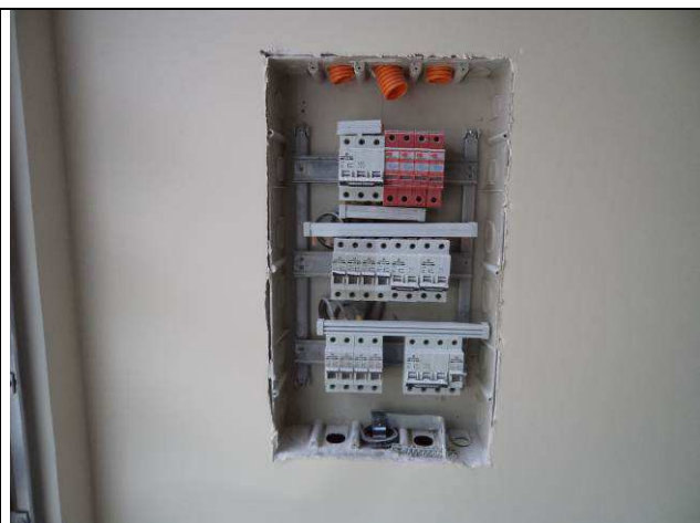
Figura 11E: quadro elétrico PAB.
