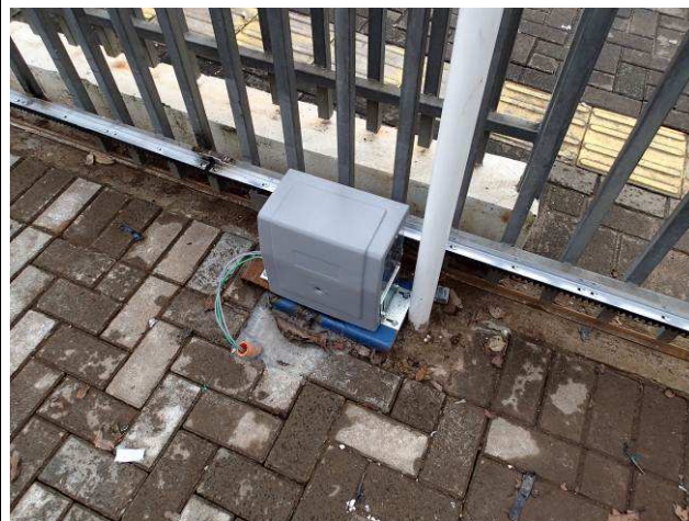
Figura 16C: Automação do portão da vaga de estacionamento coberto.
