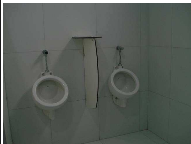
Figura 06C: Tapa-mictório instalado no banheiro masculino.
