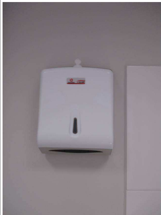
Figura 86C: Dispenser para papel toalha, marca Concorde, instalado junto ao balcão da pia.
