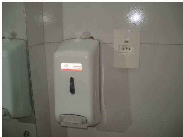
Figura 53C: Saboneteira de plástico, marca Concorde, instalada no banheiro PNE.
