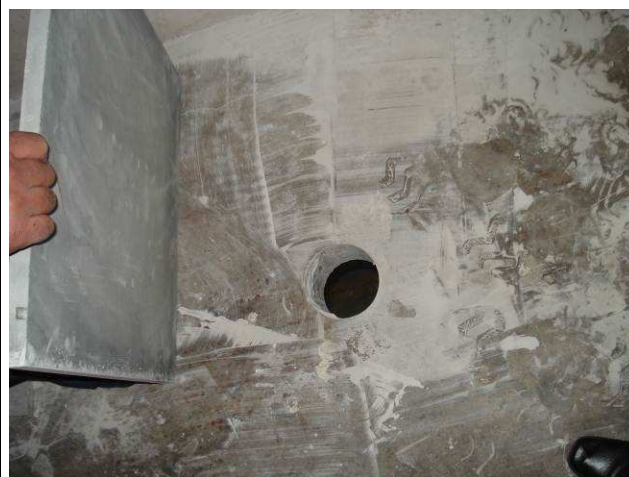
Figura 92C: Executada furação na laje do 1º subsolo para execução de pontos de esgoto primário e secundário dos banheiros feminino e masculino.
