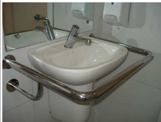
Figura 42C: Lavatório com coluna suspensa, marca Deca, instalado no banheiro PNE.
