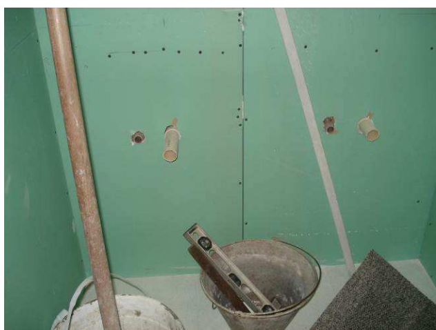
Figura 97C: Parede em gesso acartonado RU, cor verde, instalada no banheiro/vestiário masculino.
