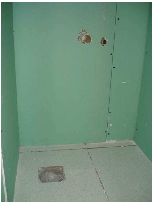
Figura 102C: Executado 1 ponto de água fria (Ø 25 mm) e 1 de esgoto secundário (Ø 50 mm) para instalação de lavatório do banheiro feminino.
