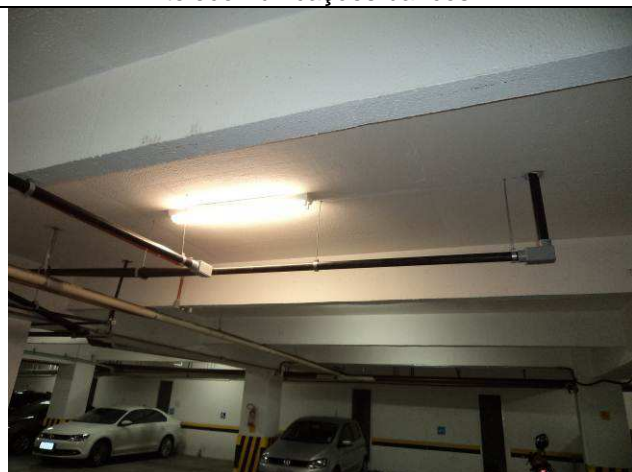
Figura 09E: infraestrutura - entrada de telecomunicações bancos.
