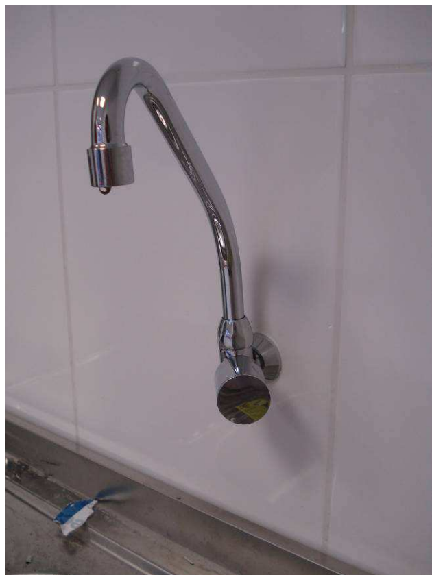
Figura 85C: Torneira para pia de parede, bica móvel, marca Deca, instalada na pia da copa.
