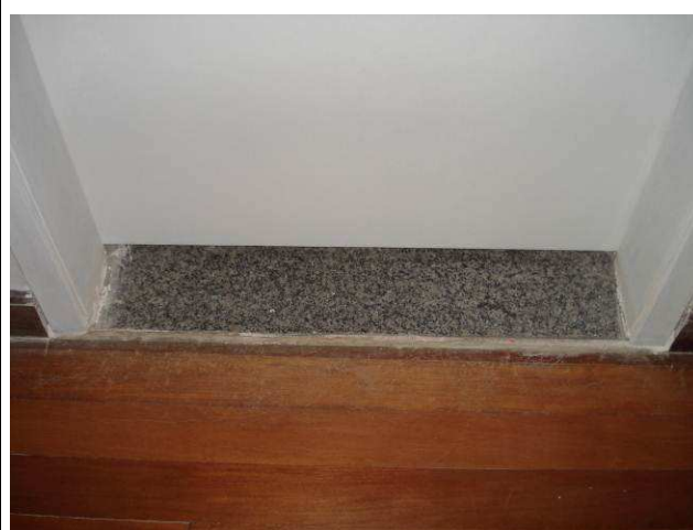
Figura 29C: Soleira em granito polido cinza andorinha, instalado na porta de acesso à copinha
