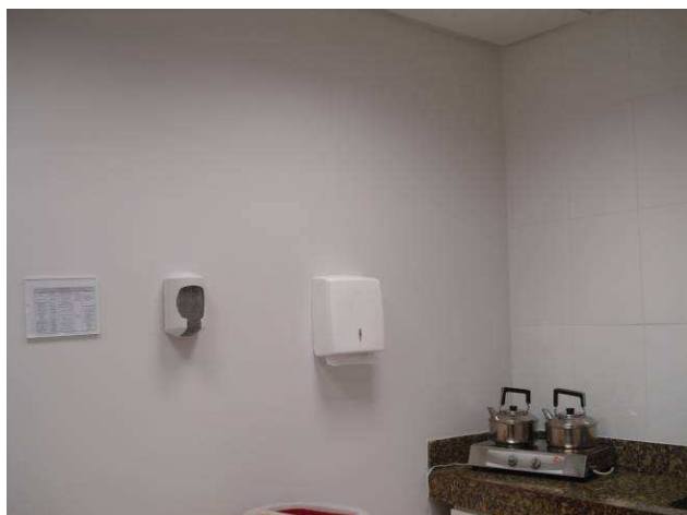
Figura 119C: Pintura executada com tinta látex acrílica, na cor branco gelo, marca Luz & Cor, em paredes da copa do 11º andar.
