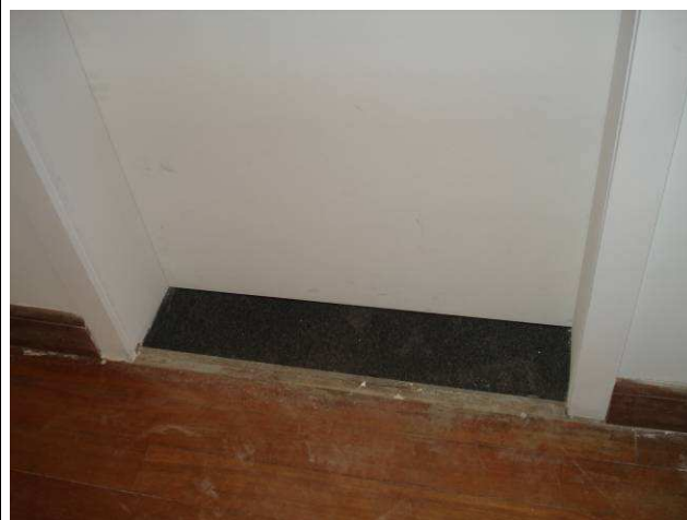
Figura 27C: Soleira em granito polido cinza andorinha, instalado na porta do banheiro masculino.
