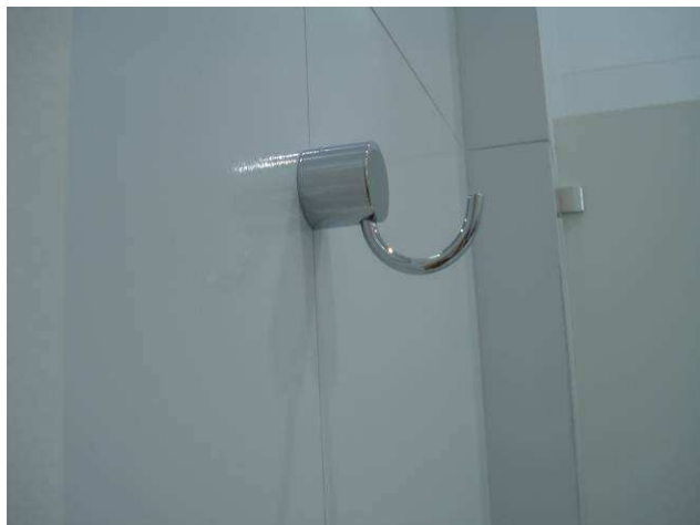
Figura 58C: Toalheiro tipo gancho, marca Deca, instalado no banheiro feminino.
