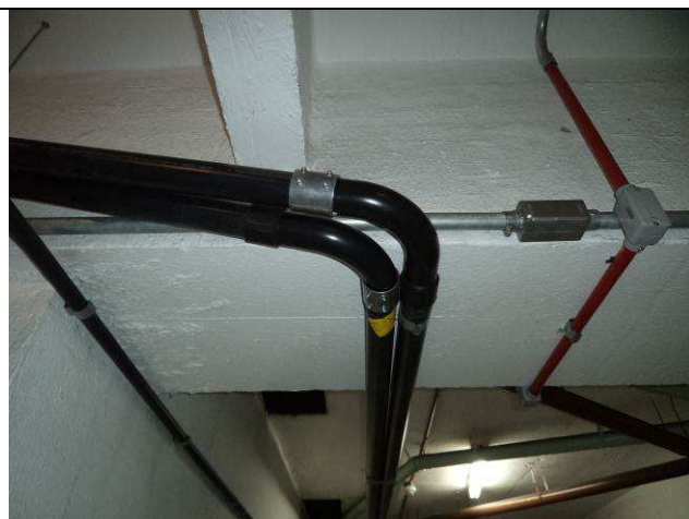
Figura 07E: infraestrutura - entrada de telecomunicações bancos.
