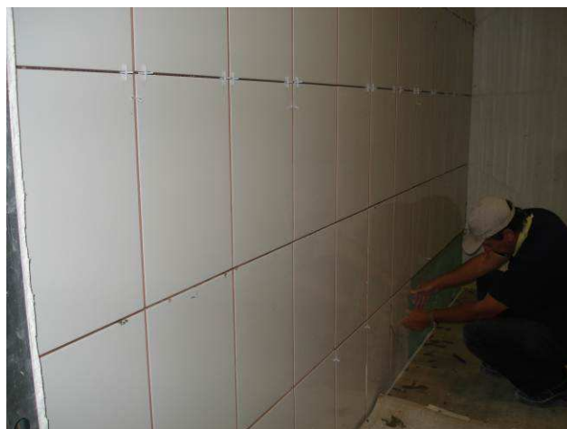
Figura 100C: Foram assentados azulejos Eliane, 33x45 cm, da linha Forma, na cor branca, no banheiro/vestiário masculino. Pendente execução de rejuntamento.
