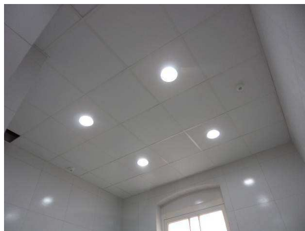
Figura 24E: luminárias 2x23W - banheiros e refeitório.
