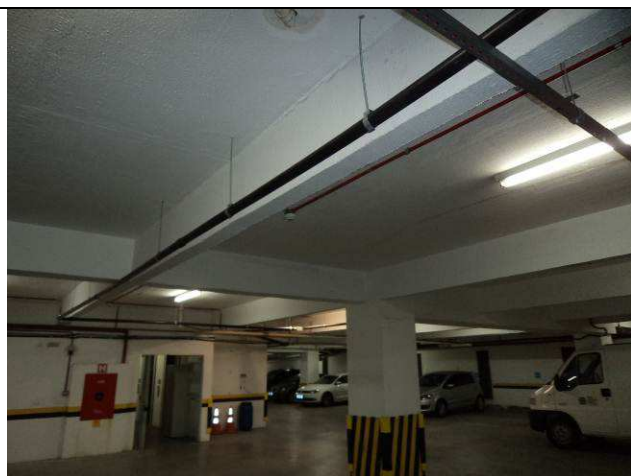
Figura 08E: infraestrutura - entrada de telecomunicações bancos.
