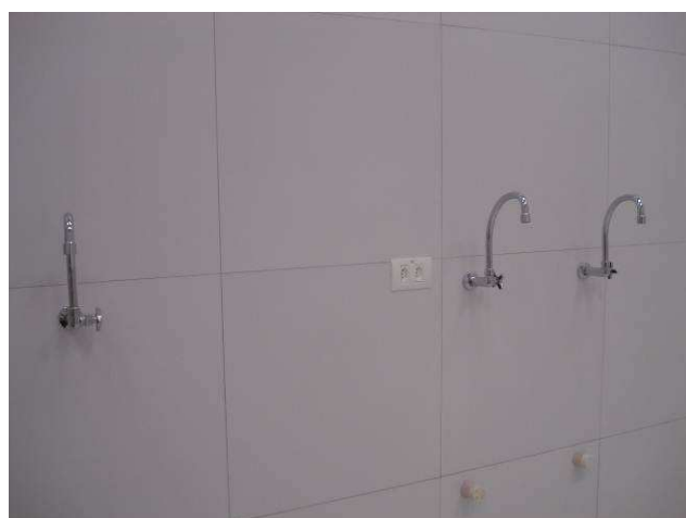
Figura 62C: Torneiras para pia de parede, bica móvel, marca Deca, instaladas na cozinha.
