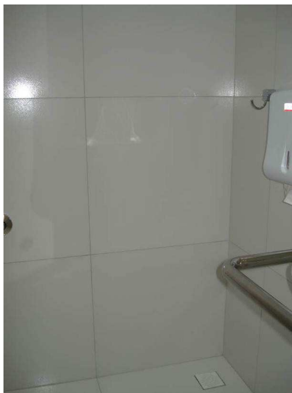
Figura 22C: Porcelanato, marca Incepa, assentado em paredes do banheiro PNE.
