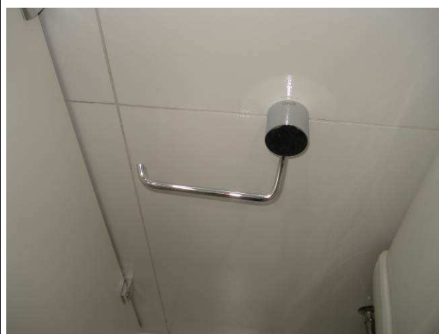
Figura 48C: Papeleira em metal cromado, marca Deca, instalada no banheiro feminino.
