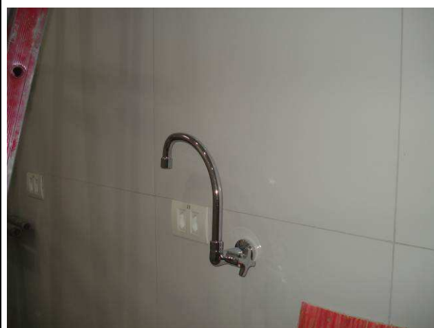
Figura 63C: Torneiras para pia de parede, bica móvel, marca Deca, instaladas na sala de apoio.
