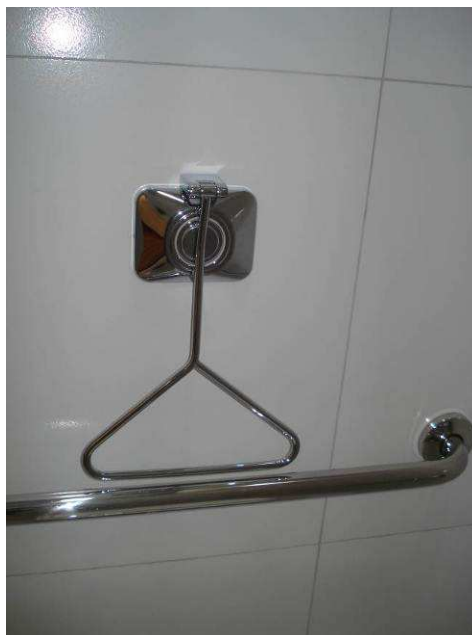
Figura 70C: Acabamento cromado para válvula de descarga tipo barra para acionamento, marca Docol, instalado no banheiro PNE.
