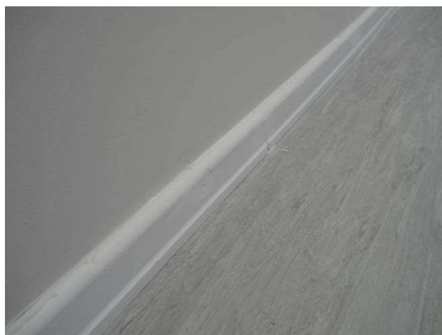
Figura 81C: Detalhe do rodapé em poliuretano (Santa Luzia), altura de 5cm, instalado no local.
