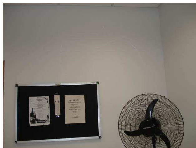
Figura 122C: Pintura executada com tinta látex acrílica, na cor branco gelo, marca Luz & Cor, em paredes da copa do 9º andar. (Padrão se repetiu do 5º ao 10º andar).
