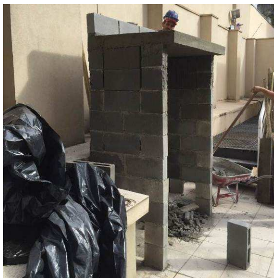
Figura 111C: Paredes laterais executadas no abrigo da central GLP. Utilizados blocos de concreto preenchidos com concreto.
