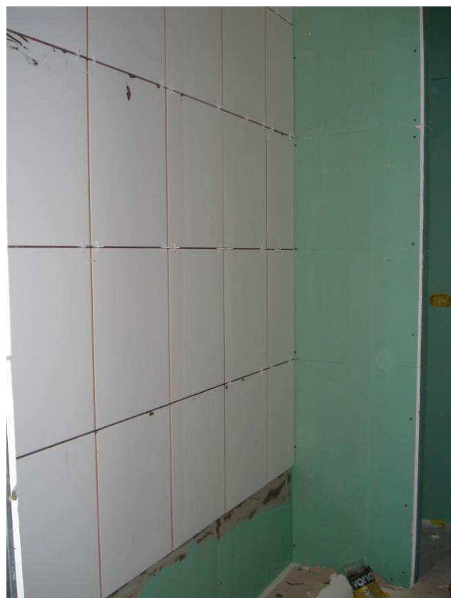
Figura 99C: Foram assentados azulejos Eliane, 33x45 cm, da linha Forma, na cor branca, no banheiro/vestiário feminino. Pendente execução de rejuntamento.
