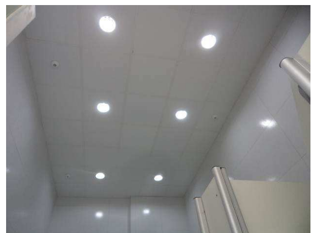
Figura 25E: luminárias 2x23W - banheiros e refeitório.
