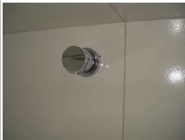
Figura 33C: Executados acabamentos e instalada canopla cromada dos registros de gaveta 3/4" (banheiro PNE).
