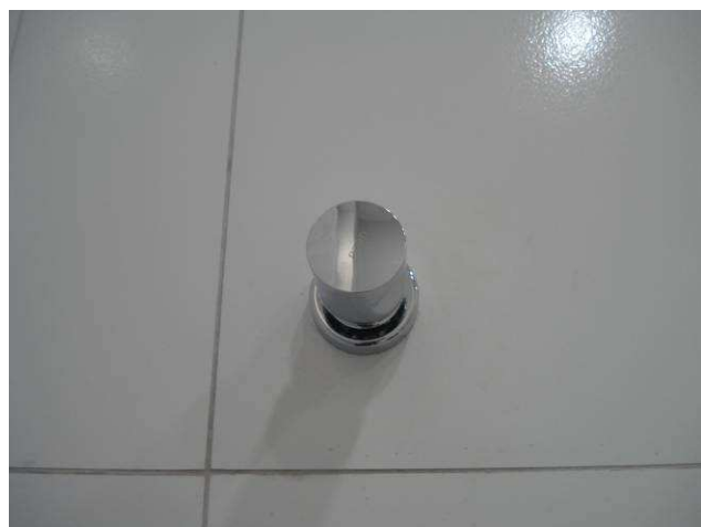
Figura 32C: Executados acabamentos e instalada canopla cromada dos registros de gaveta 3/4" (banheiro masculino).
