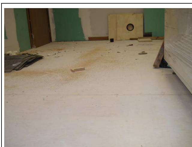
Figura 75C: Piso carpete removido na área de instalação da copa da Secretaria do Pleno (1º andar do Ed. Rio Branco). Na foto, chapa em compensado naval, instalado.
