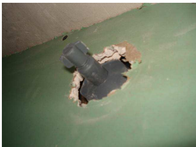
Figura 107C: Registro de gaveta 3/4", marca Deca, instalado no banheiro/vestiário feminino. Pendente instalação de acabamento cromado.
