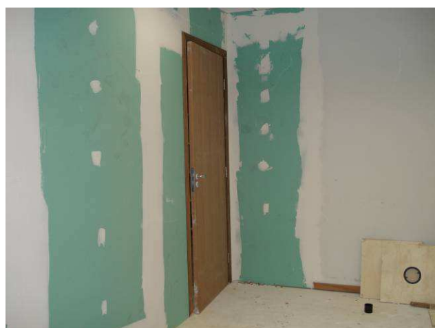
Figura 76C: Parede em gesso acartonado RU, cor verde, instalada na copa da Secretaria do Pleno.
