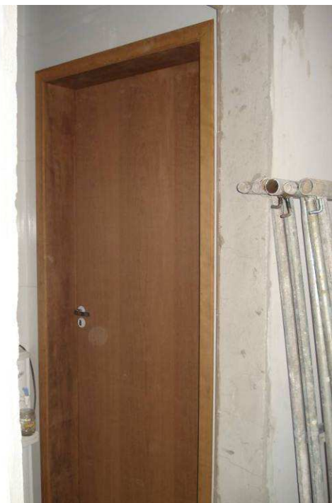
Figura 07C: Porta PM90 instalada na cozinha.
