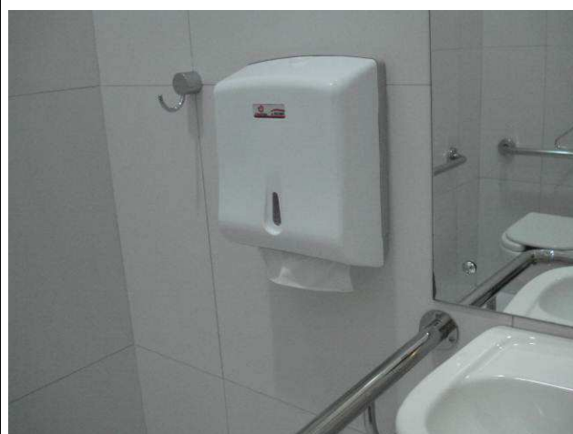
Figura 56C: Dispensers para papel toalha instalados no banheiro PNE.
