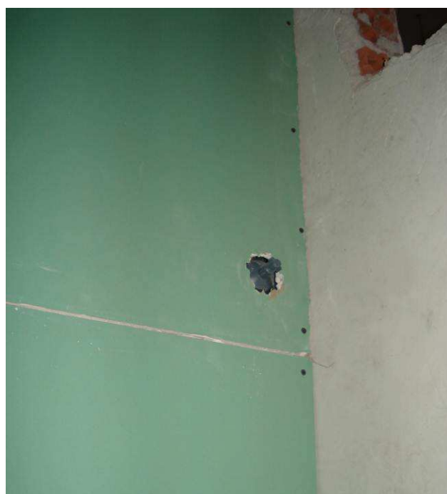
Figura 108C: Registro de gaveta 3/4", marca Deca, instalado no banheiro/vestiário masculino. Pendente instalação de acabamento cromado.
