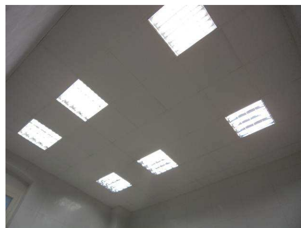
Figura 26E: luminárias 4x16W - copa térreo casarão.
