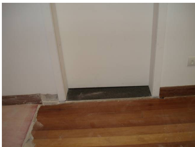
Figura 26C: Soleira em granito polido cinza andorinha, instalado na porta do banheiro feminino.
