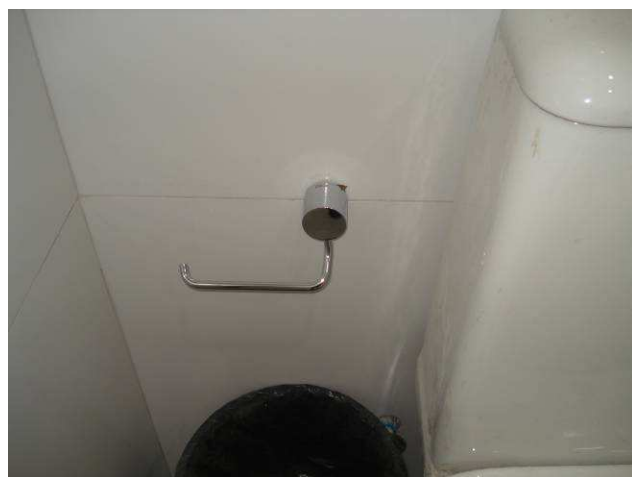
Figura 49C: Papeleira em metal cromado, marca Deca, instalada no banheiro PNE.
