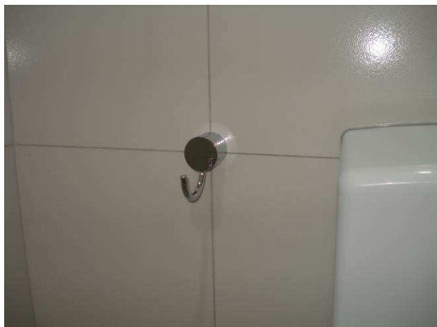
Figura 60C: Toalheiro tipo gancho, marca Deca, instalado no banheiro PNE.
