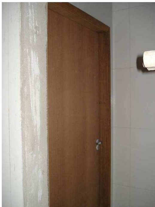
Figura 08C: Porta PM90 instalada na sala de apoio.
