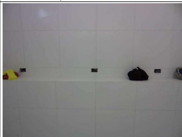
Figura 08E: infraestrutura eletrodutos e caixas 2x4".
