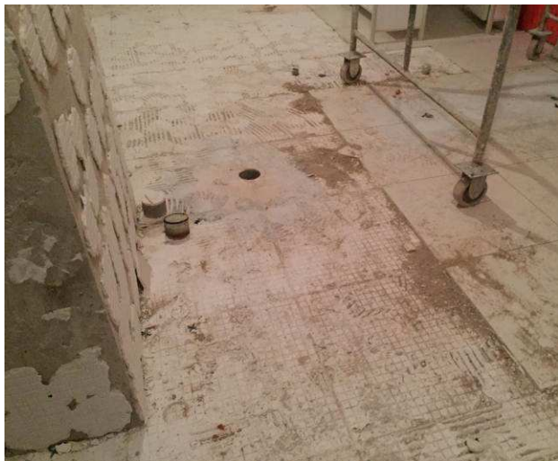
Figura 29C: Furo na laje, executado para instalação de pontos de esgoto secundário de vaso sanitário (BWC masculino).
