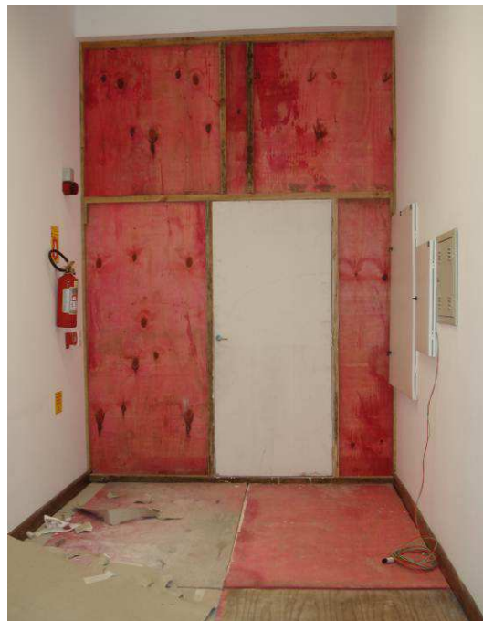
Figura 05C: Tapume de madeira compensada (e=6mm), no acesso ao corredor dos banheiros e cozinha do pavimento térreo.
