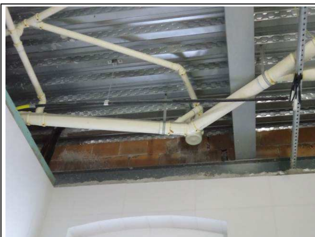
Figura 05E: infraestrutura de perfilados e eletrocalhas.
