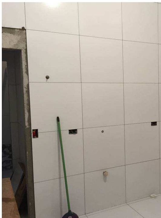
Figura 67C: Registro gaveta 3/4" (Docol) instalado na cozinha. Pendente instalação do acabamento cromado.
