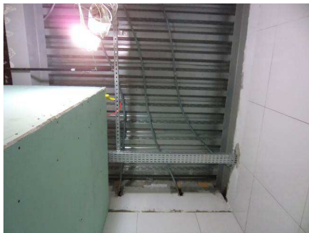
Figura 04E: infraestrutura de perfilados e eletrocalhas.
