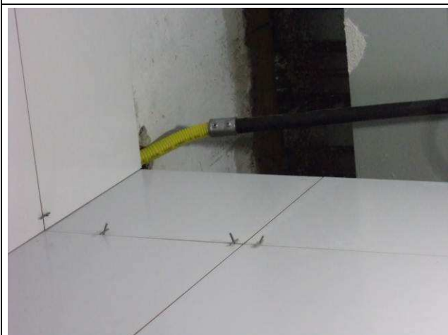
Figura 07E: infraestrutura eletrodutos acesso caixa 2x4".
