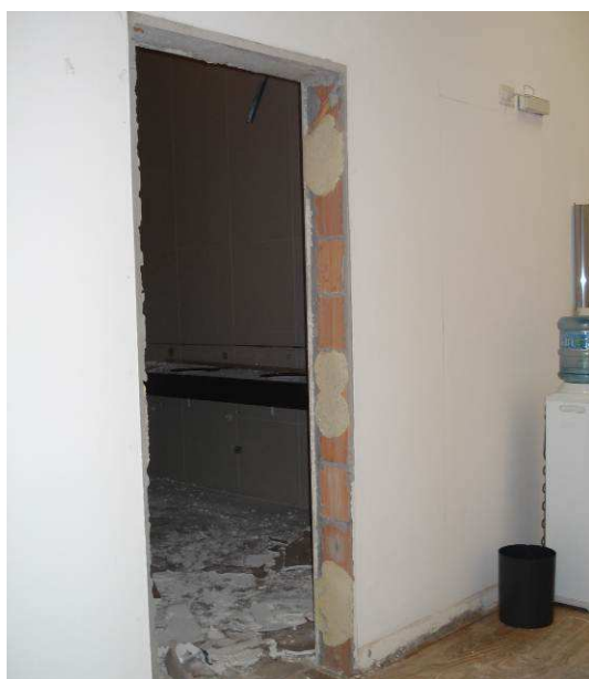
Figura 15C: Porta removida em banheiro feminino.
