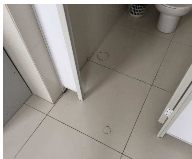
Figura 75C: Furos em diferentes espessuras no piso da sobreloja.
