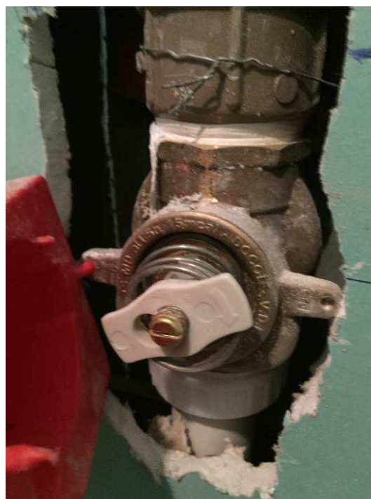
Figura 71C: Instalada base para válvula de descarga metálica Ø 32 mm (1 1/4") ou 40 mm (1 1/2"), marca Docol, no banheiro PNE.
