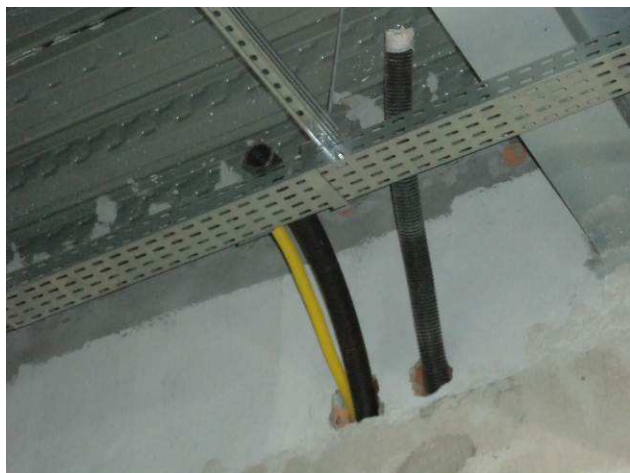
Figura 03E: infraestrutura de perfilados e eletrocalhas, eletrodutos QD-COPA.
