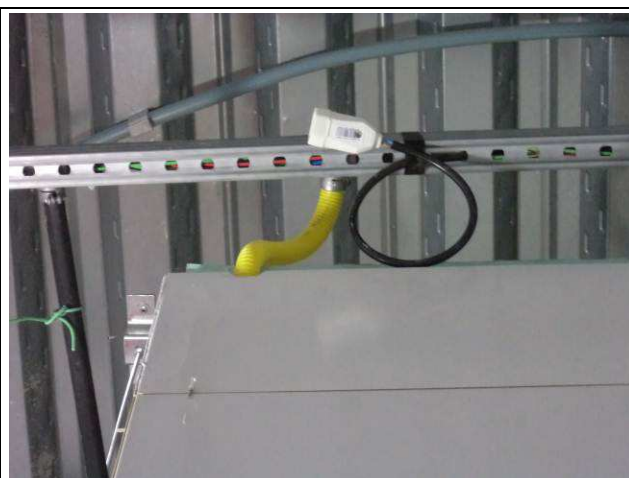
Figura 06E: infraestrutura de perfilados e eletrocalhas, eletrodutos acesso caixa 2x4".
