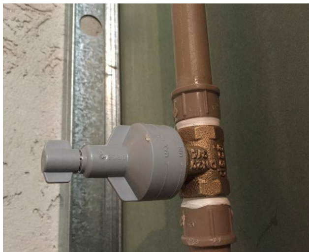
Figura 65C: Registro gaveta 3/4" (Deca) instalado no banheiro feminino. Pendente instalação do acabamento cromado.
