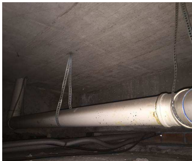
Figura 77C: Executada rede frigorígena, de ar condicionado tipo Split, em trecho abaixo da laje, próximo a saída junto à unidade condensadora.
