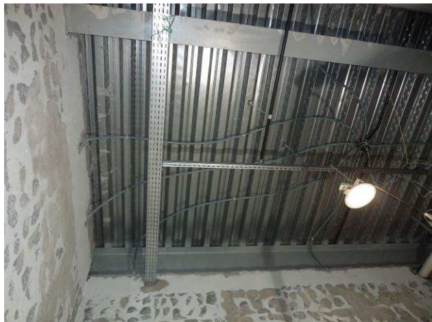
Figura 01E: infraestrutura de perfilados e eletrocalhas.
