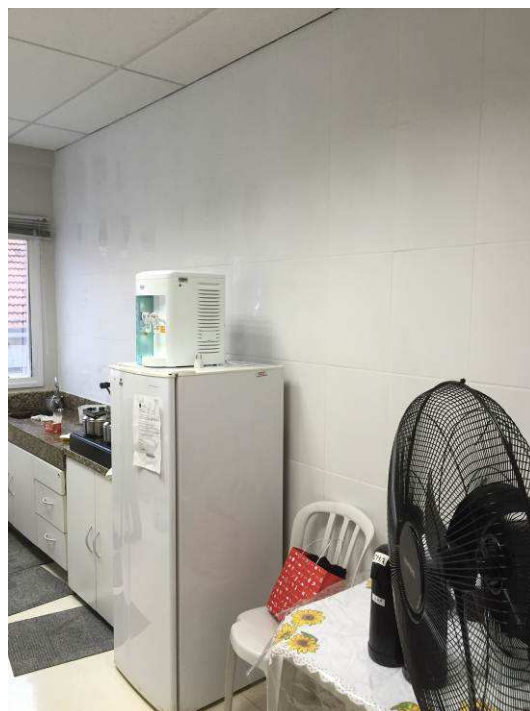
Figura 84C: Foram assentados os azulejos, marca Eliane, 33x45cm, linha Forma, cor branca, nas paredes úmidas das copas. Foto 3º andar.
