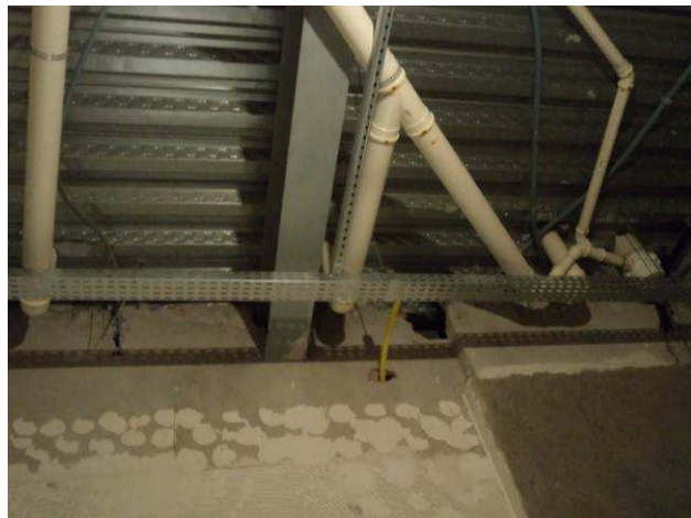
Figura 02E: infraestrutura de perfilados e eletrocalhas.
