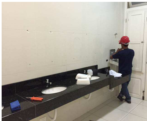
Figura 24C: Espelho removido no banheiro masculino.
