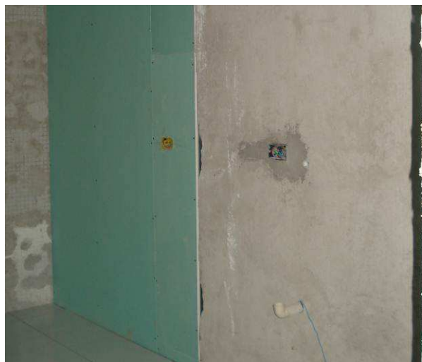
Figura 62C: Executados ponto de água fria com Ø 25 mm e respectivo esgotos secundários, na sala de apoio.
