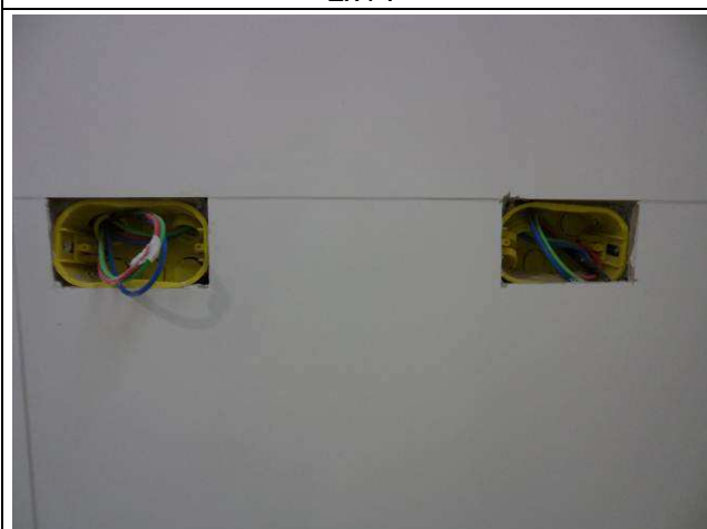
Figura 09E: infraestrutura eletrodutos e caixas 2x4".
