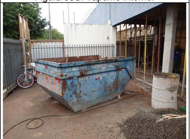
Figura 08C: Caçamba de entulhos.
