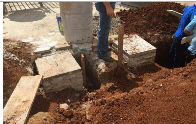
Figura 70C: Caixas de inspeção, de alvenaria, de esgoto e águas pluviais.
