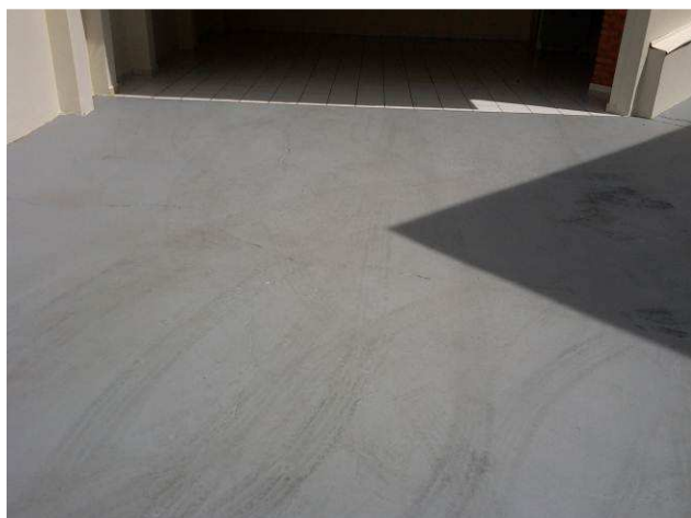
Figura 19C: Piso pintado no estacionamento
