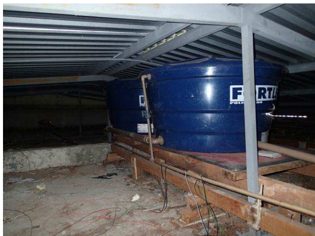
Figura 21C: Par de reservatórios instalados
