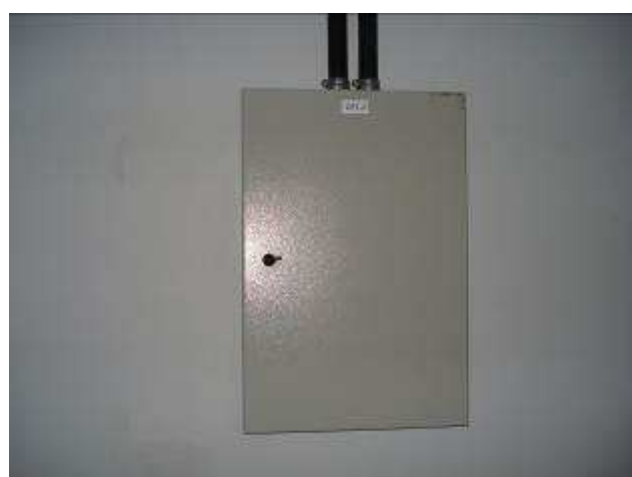
Figura 69E: instalação QFL 2.
