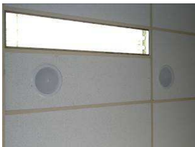
Figura 71E: instalação alto-falantes – Salas de Audiências.
