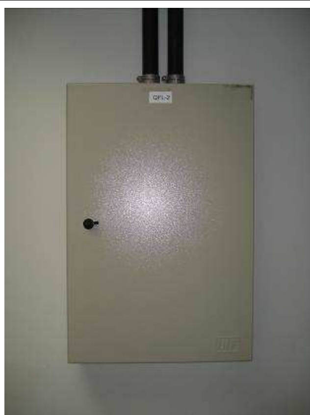
Figura 67E: instalação QFL 2.
