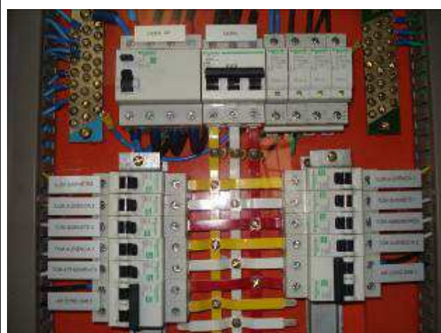
Figura 70E: instalação QFL 2.
