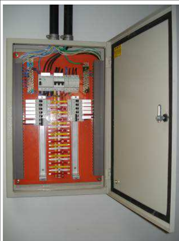
Figura 68E: instalação QFL 2.
