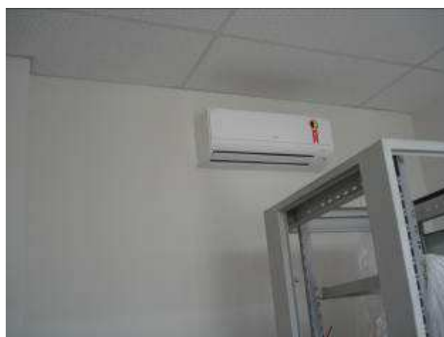
Figura 66C: instalação de ar condicionado – Sala do Assistente.
