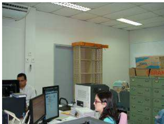
Figura 14C: parede de divisória naval substituída por parede em gesso acartonado – Gabinete 01 e Assistência.
