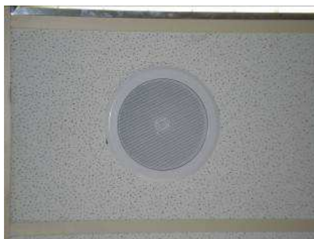
Figura 72E: instalação alto-falantes – Salas de Audiências.
