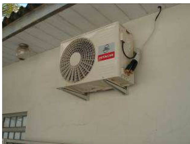
Figura 65C: instalação de ar condicionado – Sala do Assistente.
