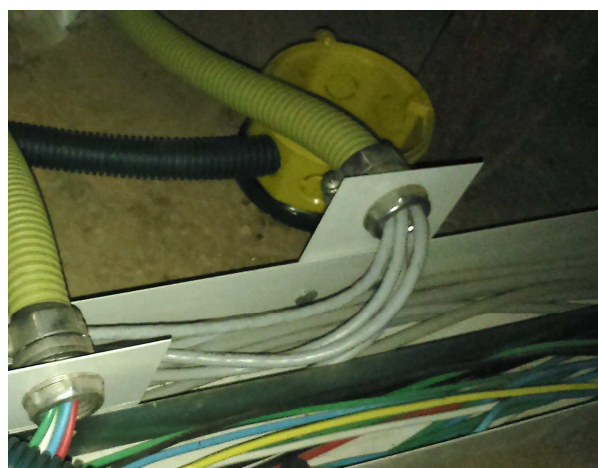
Figura 28E: Cabo UTP cat 6 em eletrocalha
