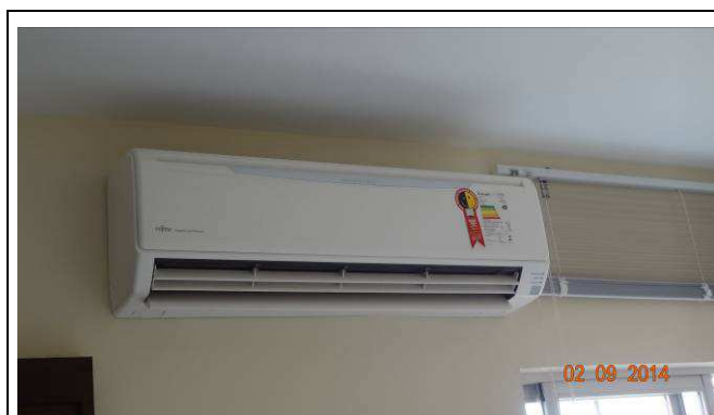
Figura 13: Instalação e equipamento de aparelho de ar condicionado na Sala de Audiência
