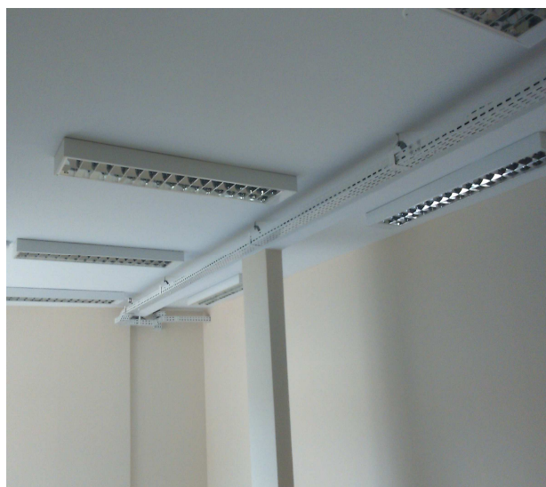
Figura 18E: Luminárias 2x32W de sobrepor.
