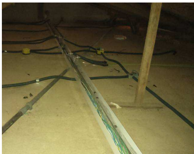
Figura 03E: Eletrocalha lisa metálica
