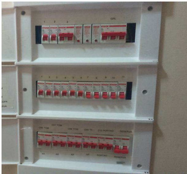
Figura 13E: Quadro elétrico
