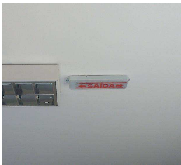
Figura 26E: Luminária de emergência
