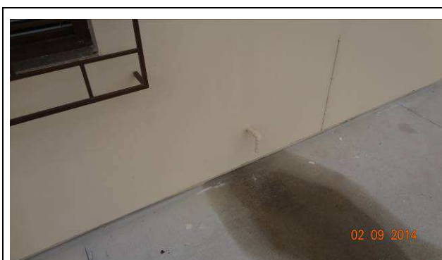
Figura 11: Dreno dos equipamentos dos condicionadores de ar
