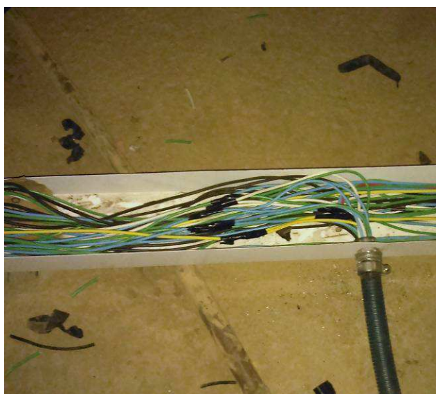
Figura 11E: Cabos flexíveis 2,5 e 4,0 mm 2 instalados em eletrocalha
