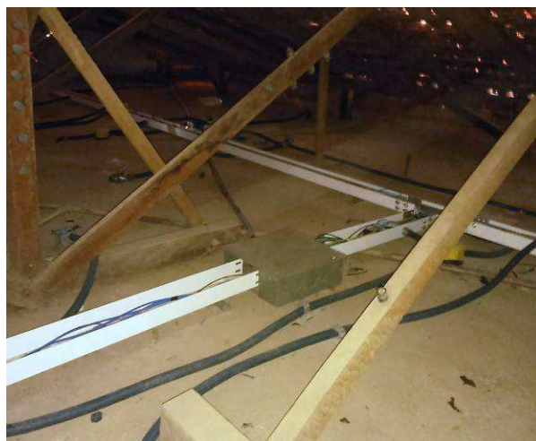
Figura 04E: Eletrocalha lisa metálica
