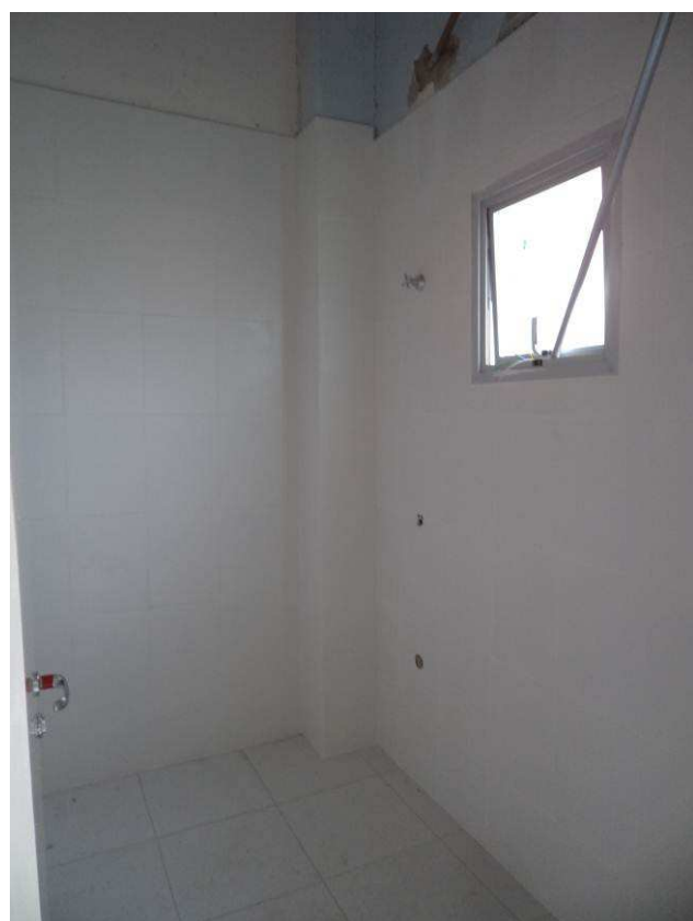
Figura 77C: Registro de gaveta, e pontos de água e esgoto da área de serviço.
