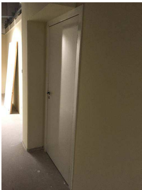
Figura 31C: Porta PM 90 da sala técnica.
