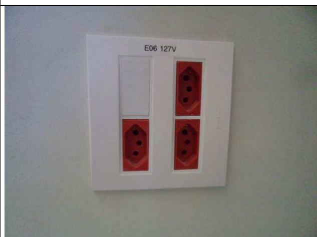
Figura 17E: Interruptores e tomadas elétricas.
