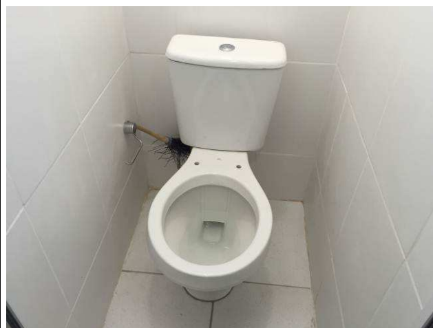
Figura 94C: Bacia sanitária com caixa acoplada, e papelreira nos banheiros dos terceirizados.
