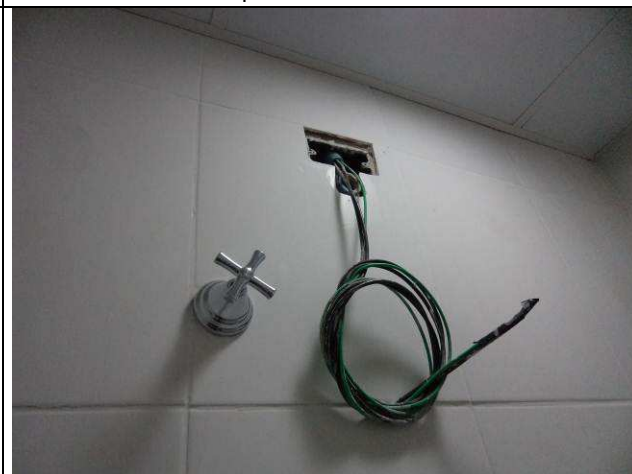
Figura 12E: cabeamento elétrico fase 1.
