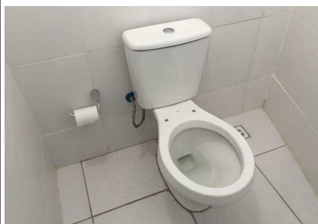
Figura 92C: Bacia sanitária com caixa acoplada, e papelreira nos banheiros dos terceirizados.
