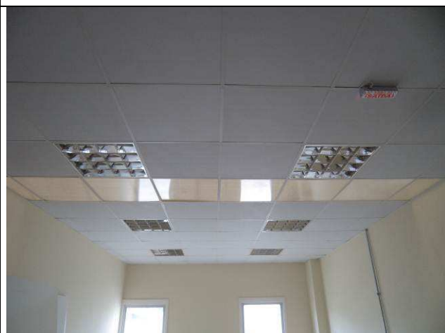
Figura 29E: Luminárias 4x16W.
