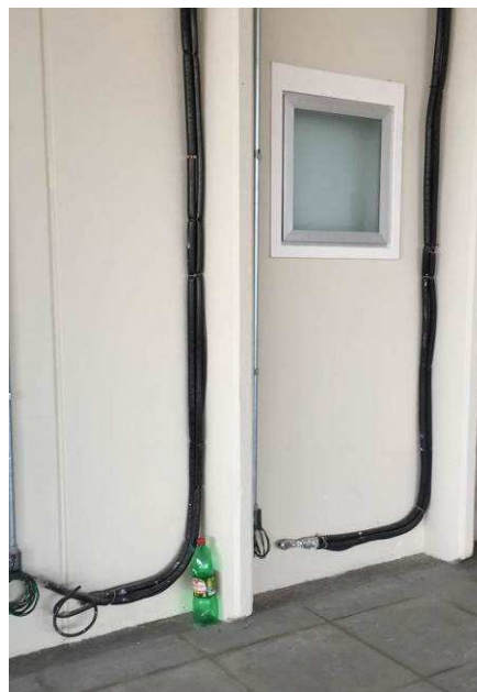
Figura 30C: J03 em banheiro do gabinete de juiz I.
