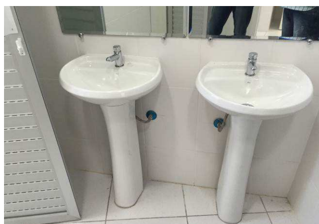
Figura 91C: Lavatórios com coluna, e espelhos nos banheiros dos terceirizados.
