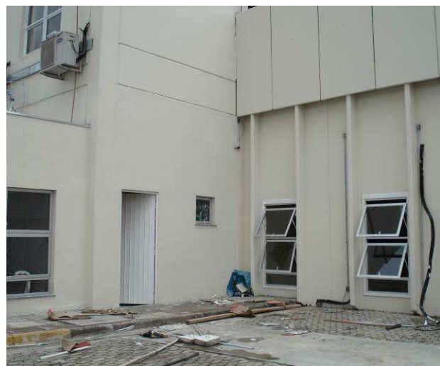
Figura 28C: Esquadrias de alumínio aplicadas na sala oficiais de justiça (J02), da direção do fórum (J02), área de serviço (J03) e copa da área de terceirizados (J04).
