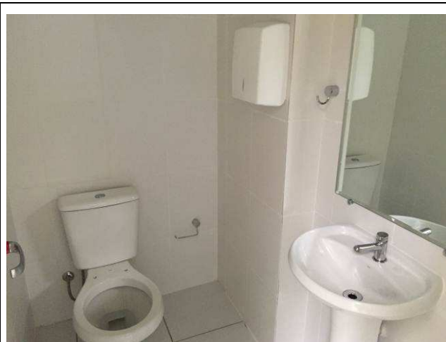
Figura 80C: Lavatório com coluna, bacia sanitária com caixa acoplada, e acessórios instalados.
