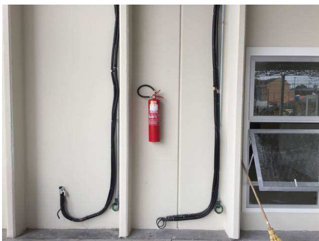
Figura 112C: Extintor ABC de 6 kg instalado no estacionamento coberto.
