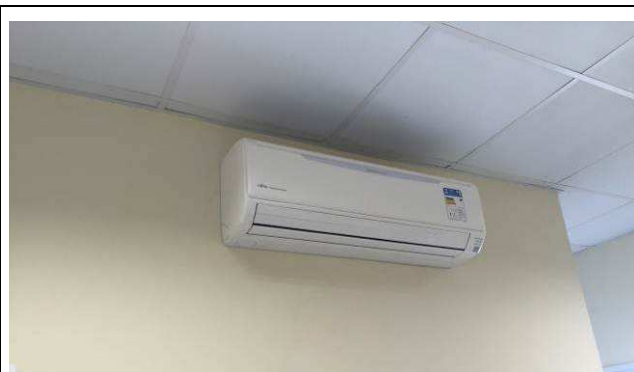
Figura 111C: Evaporadora FUJITSU 30.000 – sala de audiências II.
