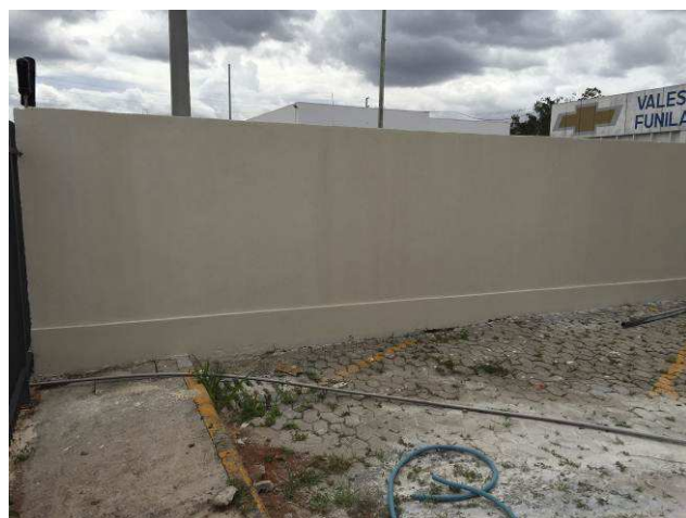
Figura 136C: Pintura no muro lateral frontal.
