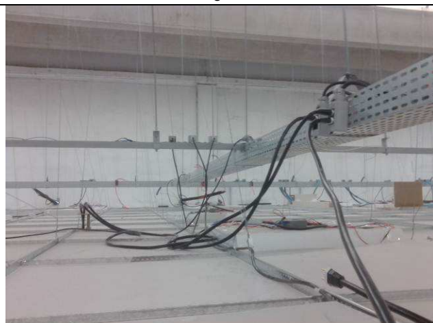
Figura 09E: pontos elétricos em condutes para alimentação dos postes Dutotec.
