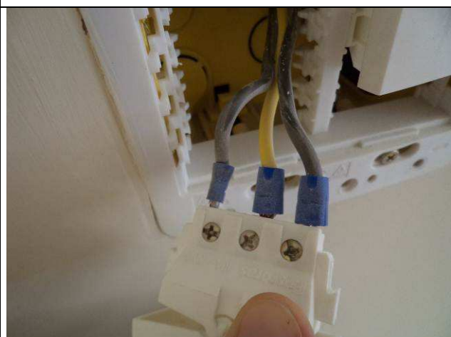
Figura 16E: Interruptores e tomadas elétricas.
