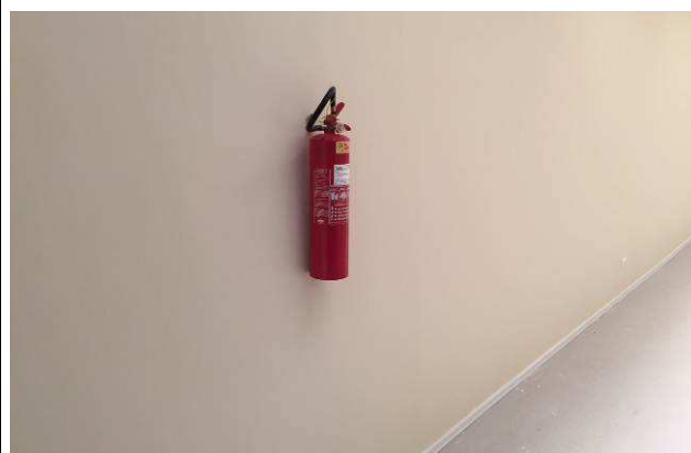
Figura 115C: Extintor ABC de 6 kg instalado na área de circulação / espera.
