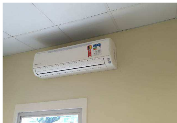
Figura 108C: Evaporadora FUJITSU 30.000 – direção do Fórum.
