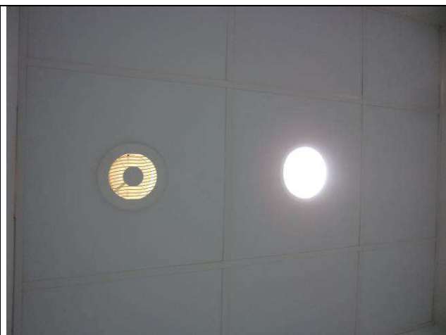
Figura 19E: exaustores de ar.
