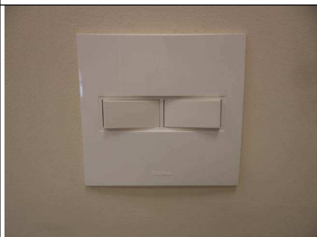
Figura 15E: Interruptores e tomadas elétricas.
