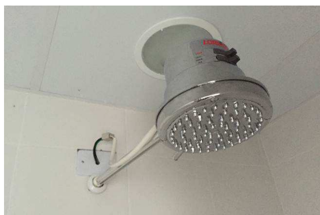
Figura 95C: Chuveiro instalado em um dos banheiros dos terceirizados.
