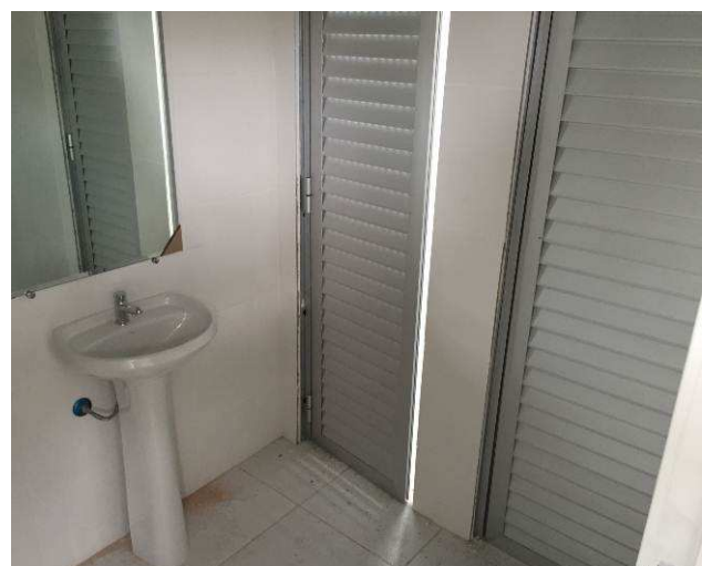
Figura 35C: Porta em veneziana de alumínio natural nos sanitários e chuveiros dos banheiros da área de terceirizados.
