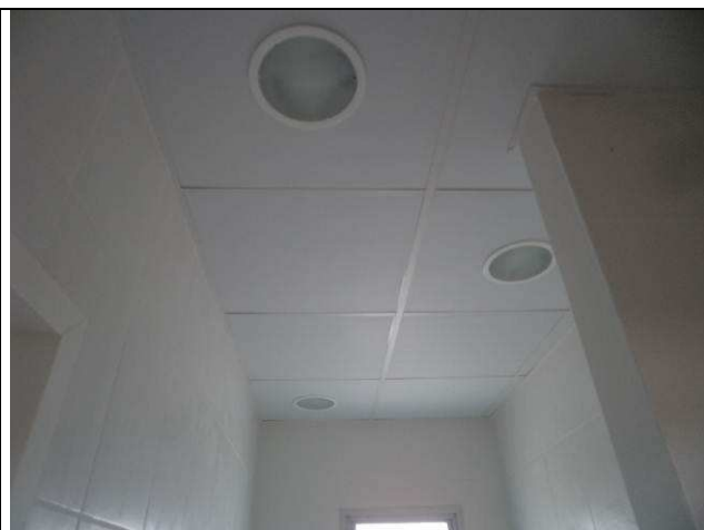
Figura 31E: luminárias 1x23W.
