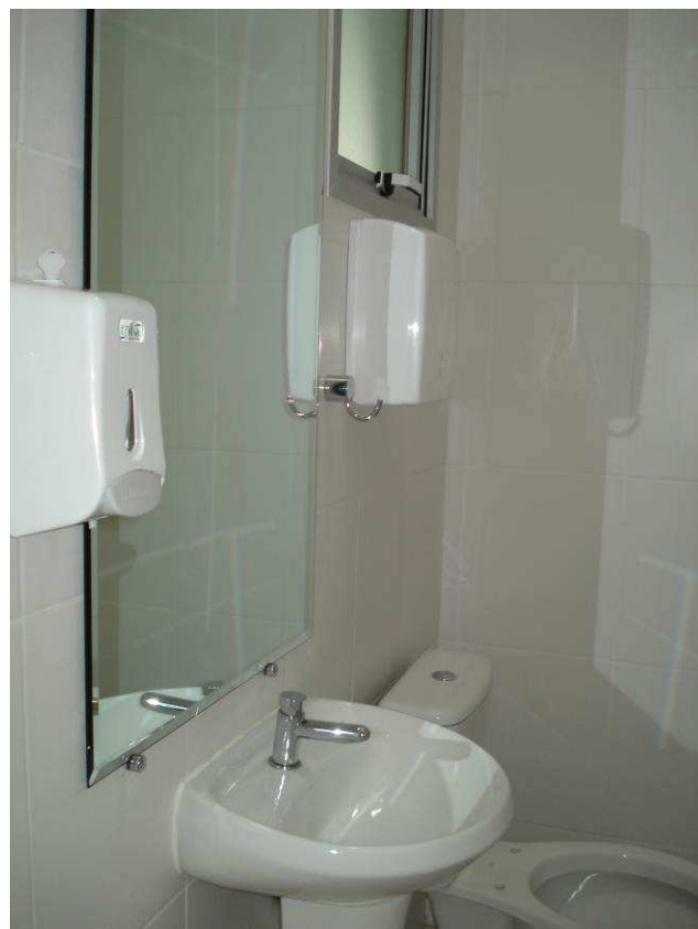
Figura 81C: Espelho e acessórios instalados.
