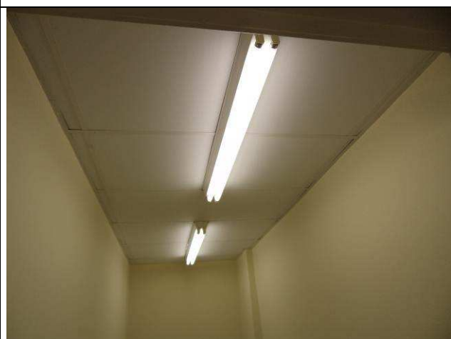
Figura 33E: luminárias 2x32W.
