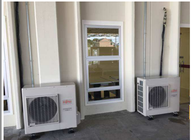
Figura 100C: Condensadoras instaladas – 2 FUJITSU 30.000 (secretaria).
