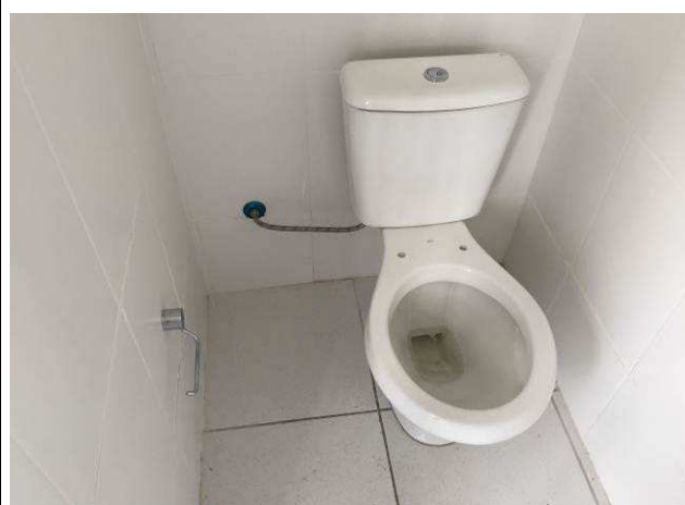
Figura 98C: Bacia sanitária com caixa acoplada, e papelreira – guarita.
