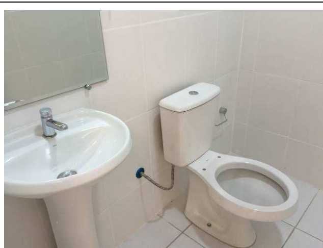
Figura 79C: Lavatório com coluna, bacia sanitária com caixa acoplada, e acessórios instalados.
