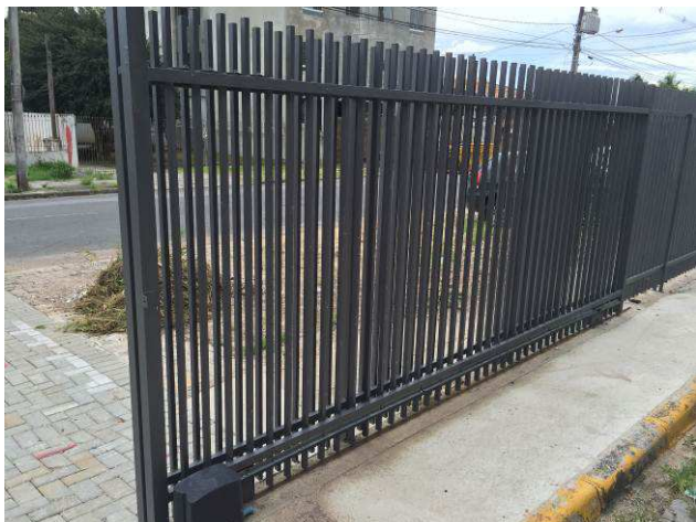
Figura 116C: Portão frontal de acesso de veículos.
