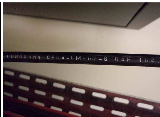
Figura 36E: Fibra óptica e DIOs - arquivo.
