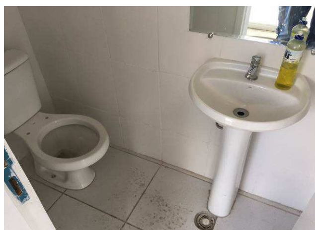
Figura 97C: Lavatório com coluna, bacia sanitária com caixa acoplada, e acessórios – guarita.
