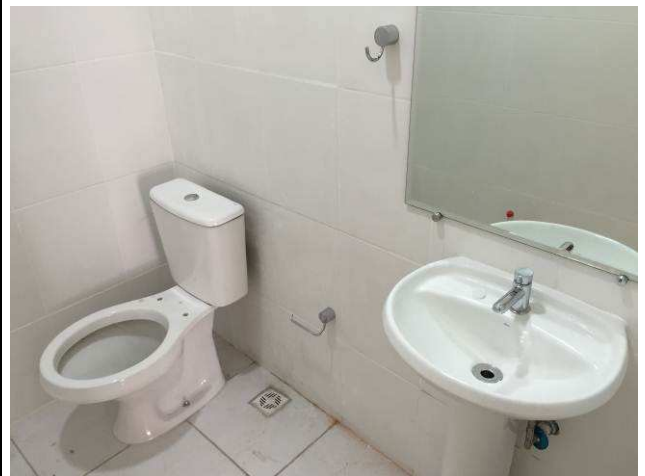
Figura 84C: Lavatório com coluna, bacia sanitária com caixa acoplada, e acessórios instalados no banheiro da secretaria.
