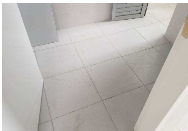
Figura 71C: Piso cerâmico no banheiro da área de terceirizados.
