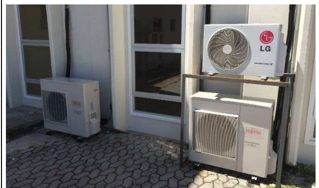
Figura 102C: Condensadoras instaladas – 2 FUJITSU 30.000 (sala dos oficiais e direção do Fórum) e 1 LG 18.000 (sala de estar).
