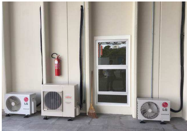
Figura 99C: Condensadoras instaladas – 1 LG 18.000 (gabinete do juiz II), 1 FUJITSU 30.000 (sala de audiências II) e 1 LG 9.000 (sala assistentes).
