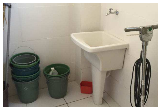
Figura 96C: Tanque e torneira instalados na área de serviço.
