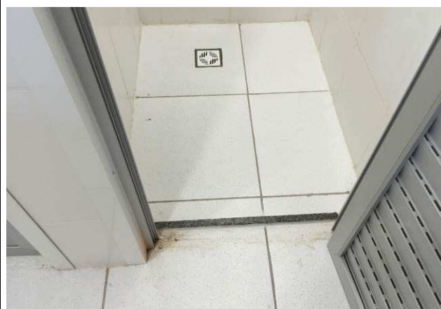
Figura 72C: Piso cerâmico no banheiro da área de terceirizados.
