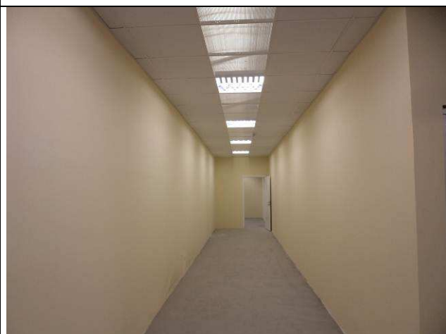
Figura 30E: Luminárias 4x16W.
