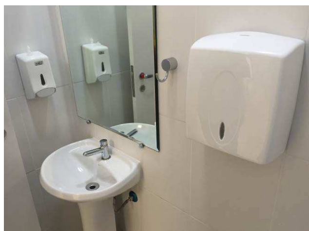
Figura 89C: Lavatório com coluna, espelho, e acessórios instalados.
