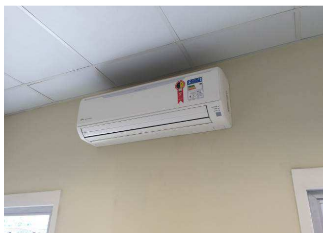
Figura 109C: Evaporadora FUJITSU 30.000 – sala dos oficiais.
