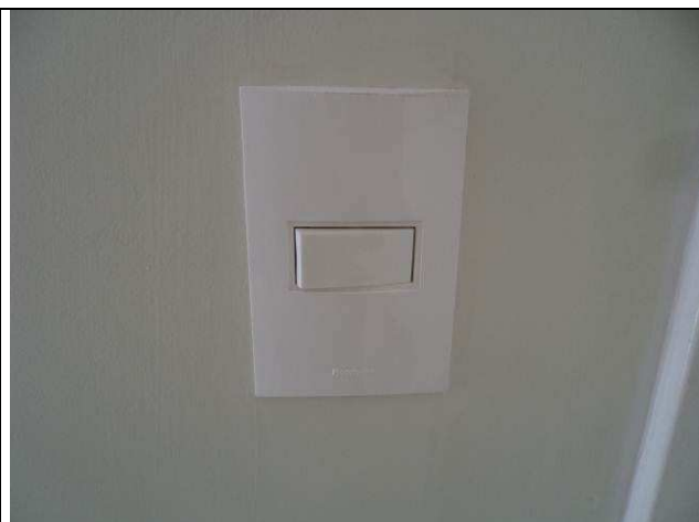
Figura 13E: Interruptores e tomadas elétricas.
