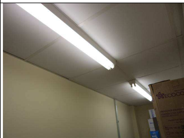
Figura 34E: luminárias 2x32W.
