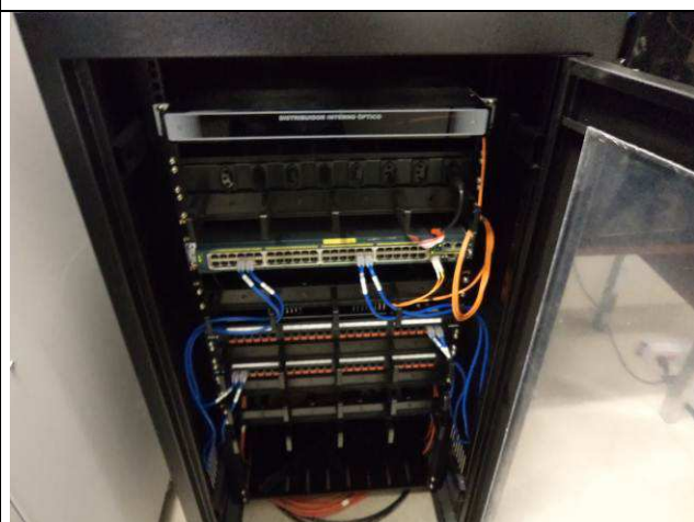
Figura 41E: rack 24U instalado no site.
