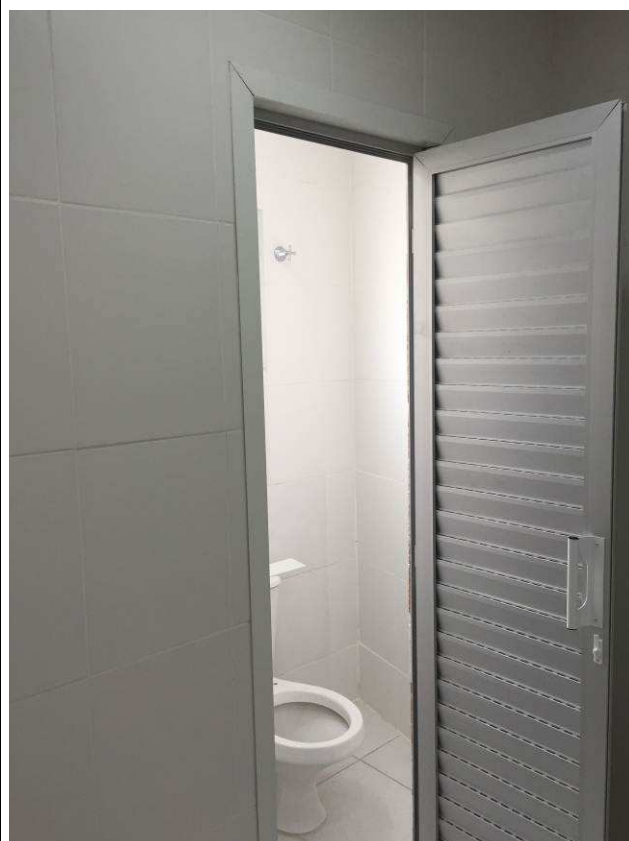
Figura 34C: Porta em veneziana de alumínio natural nos sanitários e chuveiros dos banheiros da área de terceirizados.
