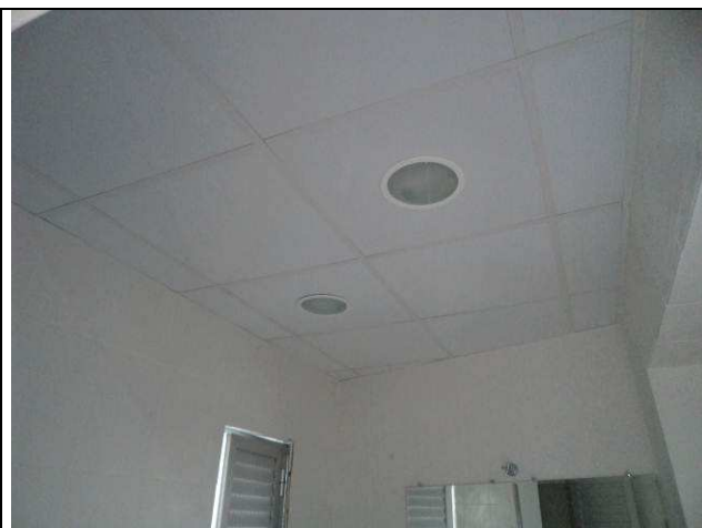
Figura 32E: luminárias 1x23W.
