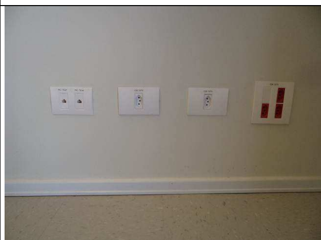
Figura 18E: Interruptores e tomadas elétricas.
