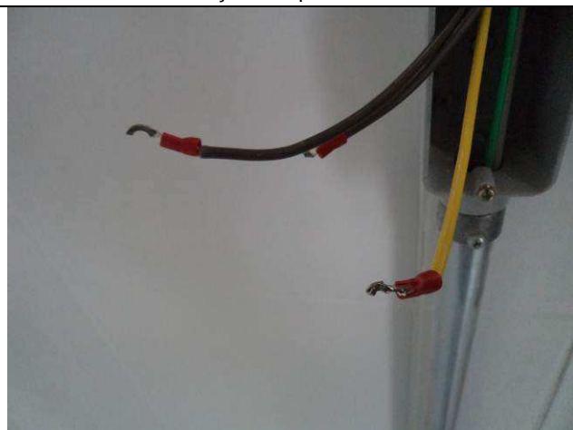
Figura 11E: cabeamento elétrico fase 1.
