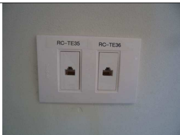
Figura 45E: conectores RJ45 cat6.
