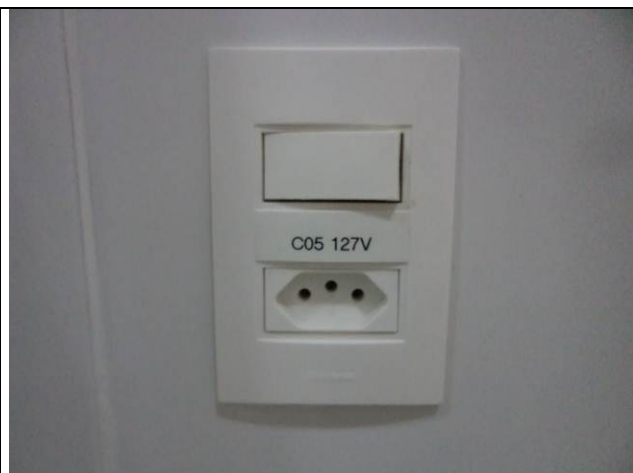
Figura 14E: Interruptores e tomadas elétricas.
