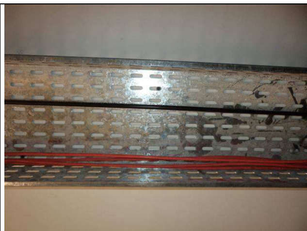
Figura 38E: Fibra óptica e DIOs - site.
