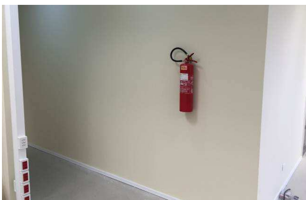
Figura 114C: Extintor ABC de 6 kg instalado na secretaria.
