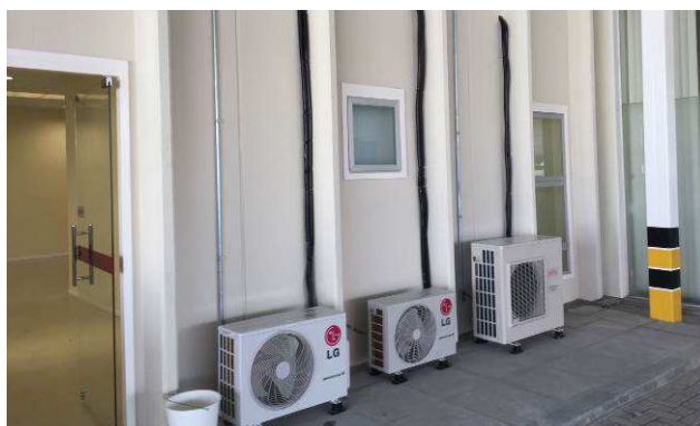
Figura 101C: Condensadoras instaladas – 1 LG 18.000 (gabinete do juiz I), 1 LG 9.000 (conciliação) e 1 FUJITSU 30.000 (sala de audiências I).
