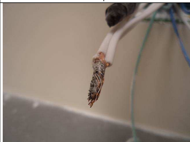
Figura 21E: Cabeamento elétrico – emendas com estanho.
