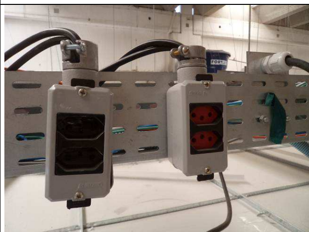
Figura 39E: Tomadas elétricas para postes Dutotec.
