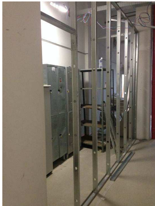
Figura 12C: Montagem de estrutura de paredes de gesso acartonado ST- simples da Sala de Segurança.
