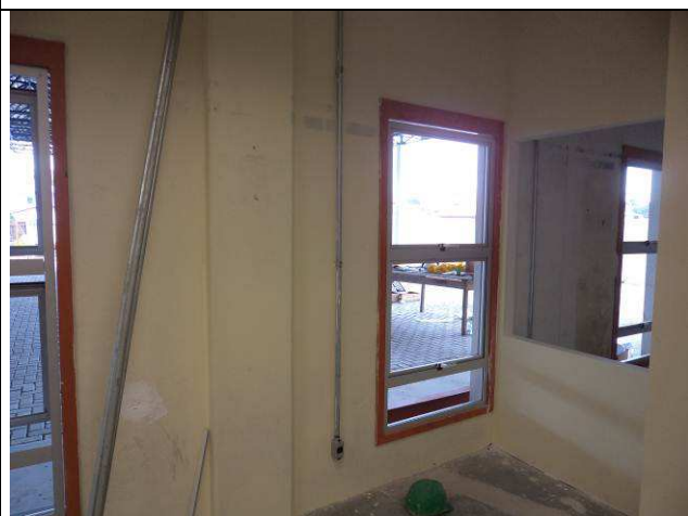
Figura 16E: Infraestrutura elétrica – caixas 2x4, 4x4 e condutes.
