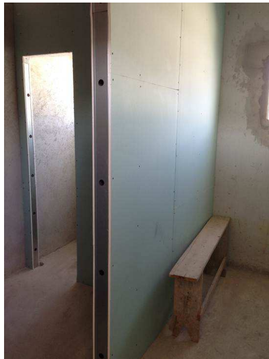
Figura 08C: Parede de gesso acartonado RU-verde na passagem de vestiário para banheiro da área de terceirizados.
