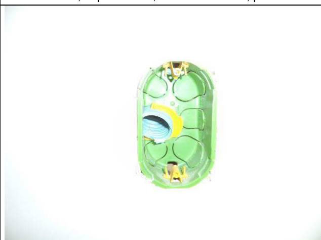
Figura 14E: Infraestrutura elétrica – caixas 2x4, 4x4 e condutes.
