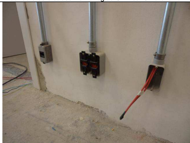
Figura 79E: Infra-estrutura lógica – caixas 2x4", 4x4" e condutes e cabeamento lógico UTP cat 6 Furukawa.
