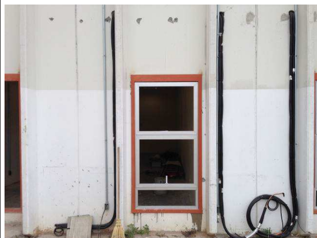
Figura 142C: Instalação da rede frigorígena – sala de estar, sala dos oficiais e sala da Direção do Fórum.
