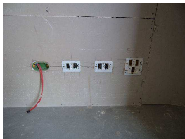
Figura 37E: Interruptores e tomadas elétricas.
