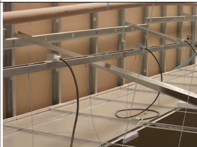
Figura 07 E: Infraestrutura elétrica – eletrocalhas, eletrodutos, septo divisor, derivador lateral, perfilados.
