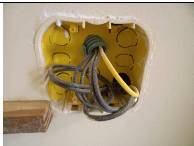
Figura 23E: Cabeamento elétrico – padrão de cores iluminação.
