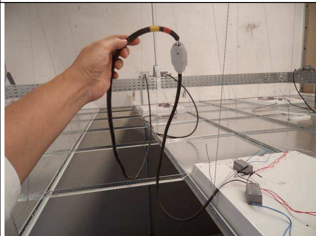
Figura 43E: Iluminação – derivadores laterais, cabos PP, plugues conexão.
