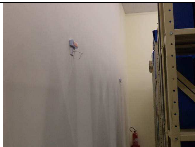
Figura 54E: iluminação – blocos de emergência.
