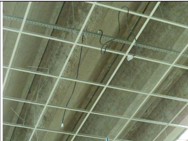
Figura 41E: Iluminação – derivadores laterais, cabos PP, plugues conexão.
