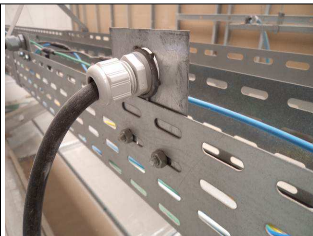
Figura 06E: Infraestrutura elétrica – eletrocalhas, eletrodutos, septo divisor, derivador lateral, perfilados.
