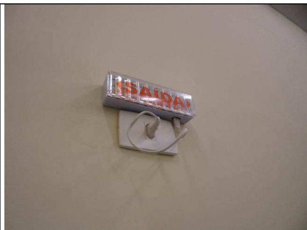
Figura 53E: iluminação – blocos de emergência.
