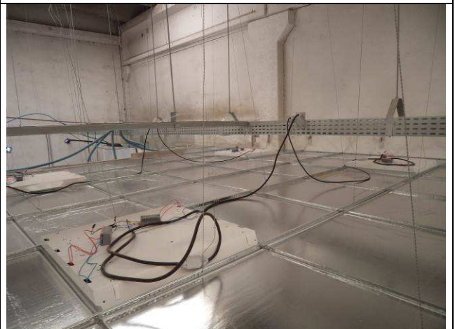
Figura 44E: Iluminação – derivadores laterais, cabos PP, plugues conexão.
