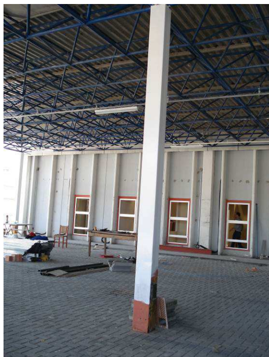
Figura 165C: Aplicação de esmalte sintético acetinado (marca Suvinil) nos pilares metálicos do estacionamento.
