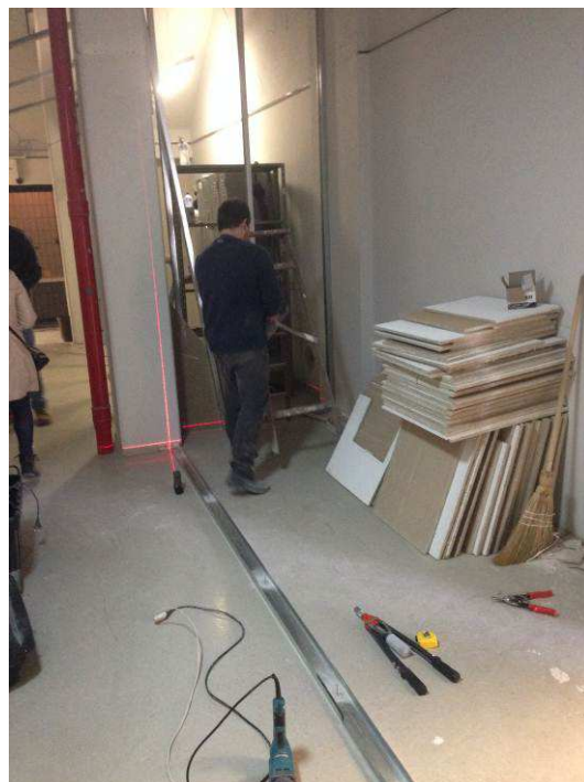
Figura 14C: Montagem de estrutura de paredes de gesso acartonado ST- simples do depósito SG.
