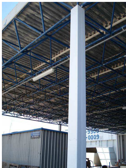
Figura 166C: Aplicação de esmalte sintético acetinado (marca Suvinil) nos pilares metálicos do estacionamento.
