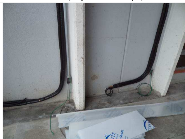
Figura 26E: Cabeamento elétrico – ar-condicionado.
