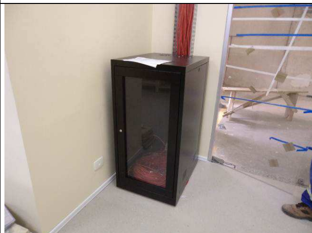
Figura 83E: rack 24U instalado no arquivo.
