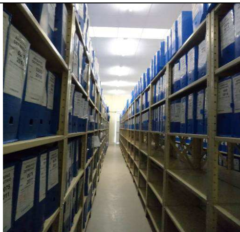
Figura 47E: iluminação – luminárias 1x32W arquivo.
