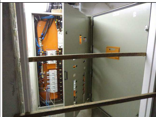
Figura 62E: Quadro QDG.
