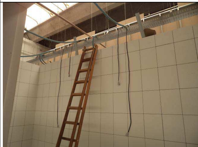
Figura 04E: Infraestrutura elétrica – eletrocalhas, eletrodutos, septo divisor, derivador lateral, perfilados.
