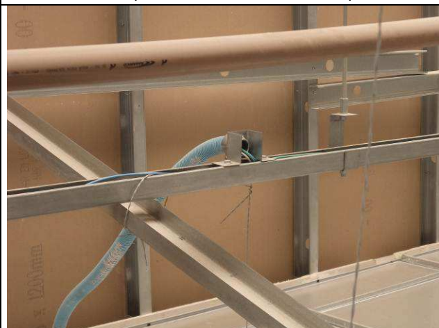
Figura 08E: Infraestrutura elétrica – eletrocalhas, eletrodutos, septo divisor, derivador lateral, perfilados.
