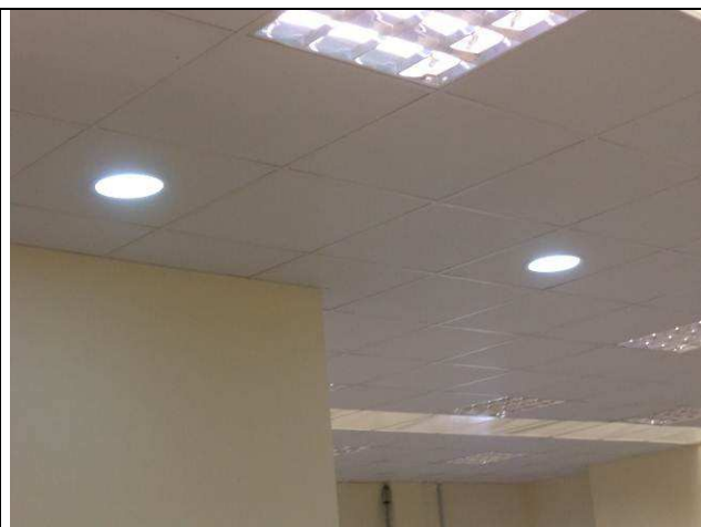
Figura 59E: iluminação – luminárias 23W.
