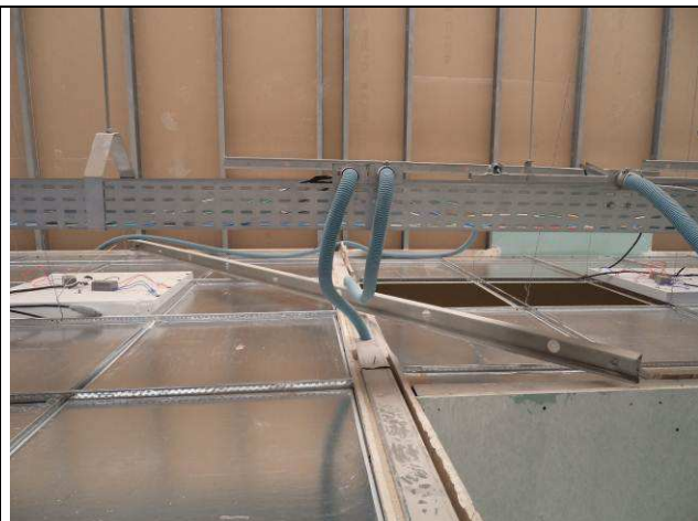
Figura 02E: Infraestrutura elétrica – eletrocalhas, eletrodutos, septo divisor, derivador lateral, perfilados.
