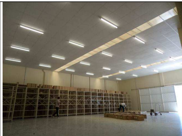
Figura 48E: iluminação – luminárias 1x32W arquivo.
