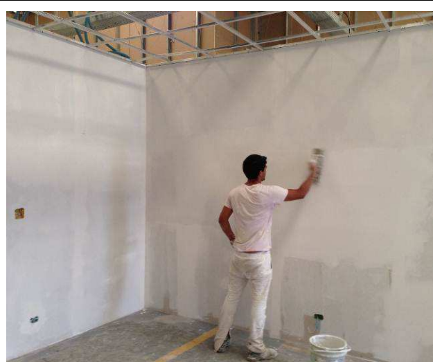
Figura 146C: 1ª demão de massa corrida PVA aplicada em parede de gesso acartonado da 5ª Vara.
