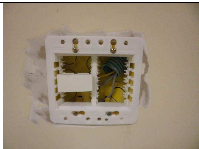
Figura 36E: Interruptores e tomadas elétricas.
