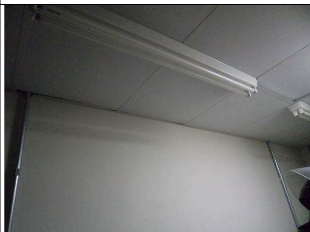
Figura 52E: iluminação – luminárias 2x32W corredor.
