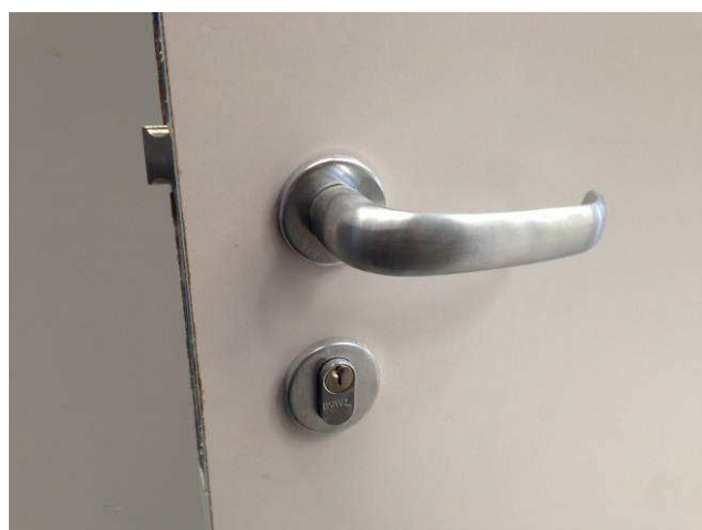
Figura 25C: Fechaduras instaladas – marca Papaiz.
