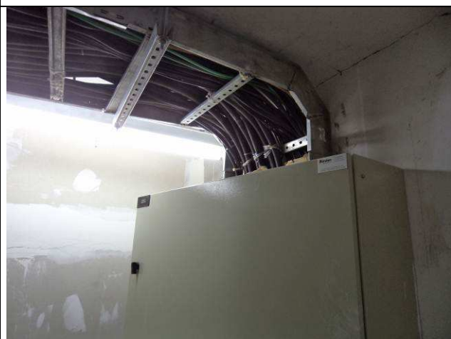
Figura 63E: Quadro QDG.
