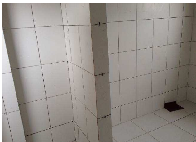
Figura 89C: Azulejos assentados em vestiário da área de terceirizados.
