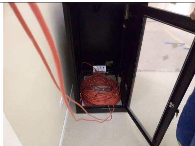
Figura 84E: rack 24U instalado no arquivo.
