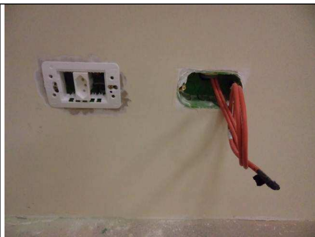
Figura 76E: Infra-estrutura lógica – caixas 2x4", 4x4" e condutes e cabeamento lógico UTP cat 6 Furukawa.
