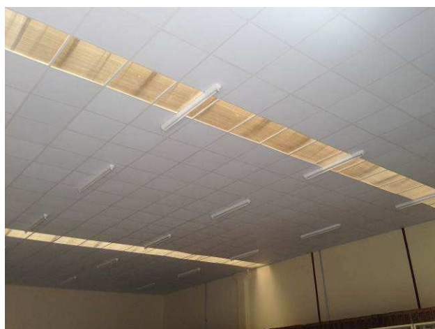
Figura 65C: Linha de forro em policarbonato alveolar cristal (6 mm) instalado em área do arquivo.
