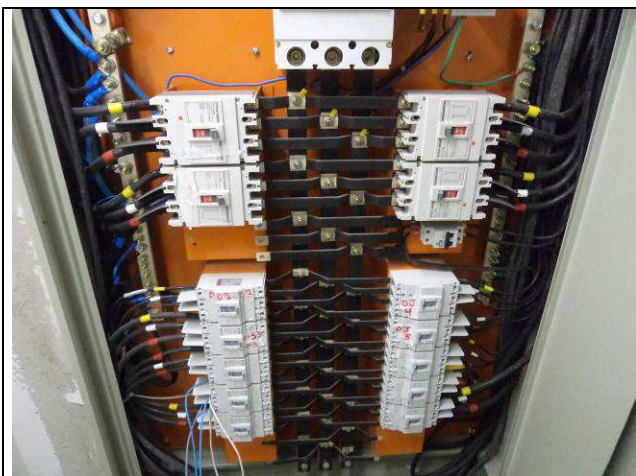
Figura 65E: Quadro QDG – disjuntores alimentadores quadros de distribuição parciais.
