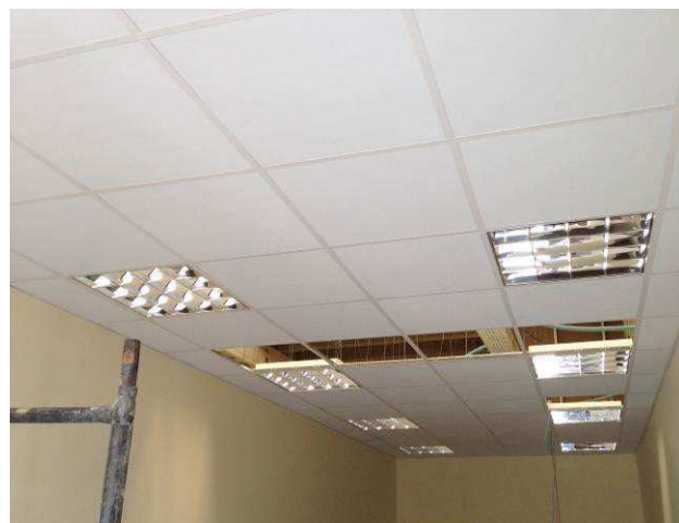
Figura 64C: Detalhe do forro de gesso com luminárias de embutir instaladas.
