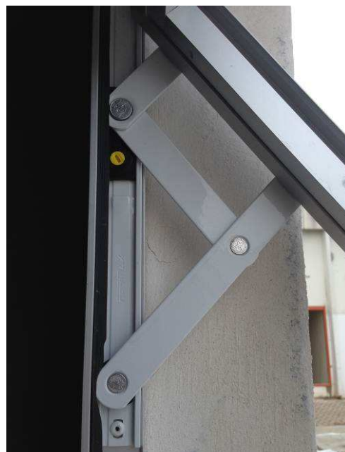
Figura 40C: Janelas J02 – sistema progressivo de abertura (marca Fermax).
