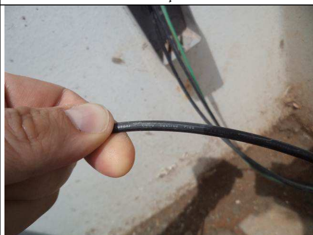
Figura 25E: Cabeamento elétrico – ar-condicionado.
