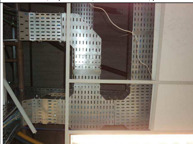
Figura 09E: Infraestrutura elétrica – eletrocalhas, eletrodutos, septo divisor, derivador lateral, perfilados.
