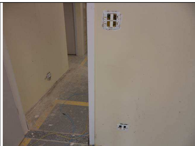
Figura 35E: Interruptores e tomadas elétricas.
