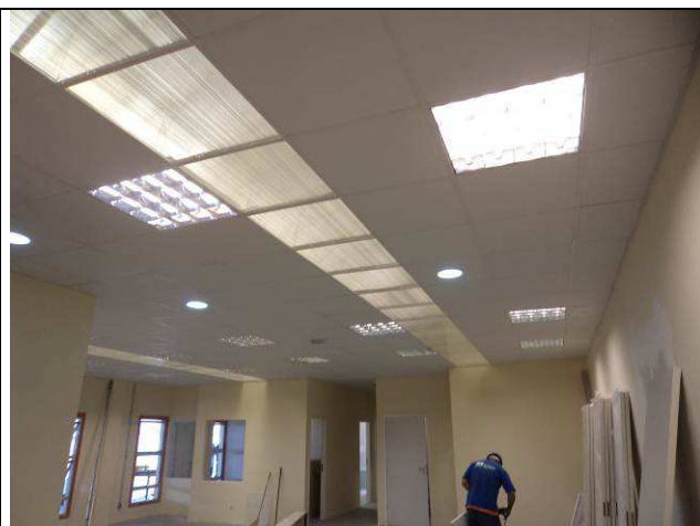
Figura 60E: iluminação – luminárias 23W.
