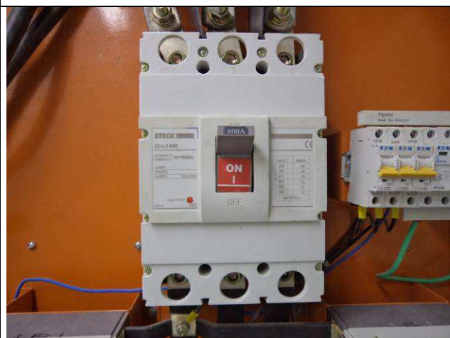
Figura 64E: Quadro QDG – disjuntor geral.
