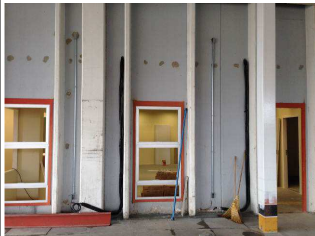
Figura 140C: Instalação da rede frigorígena – secretaria da 5ª Vara.
