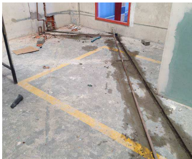
Figura 133C: Dreno com sifão, em tubos de PVC soldável, para evaporadoras do gabinete de juiz, sala de audiências e conciliação.
