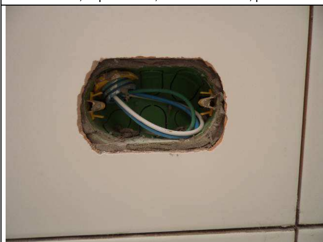
Figura 13E: Infraestrutura elétrica – caixas 2x4, 4x4 e condutes.
