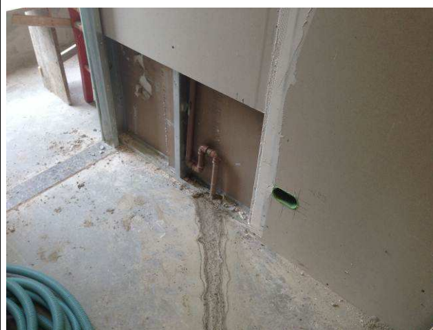
Figura 136C: Dreno com sifão, em tubos de PVC soldável, para evaporadoras da 5ª Vara.
