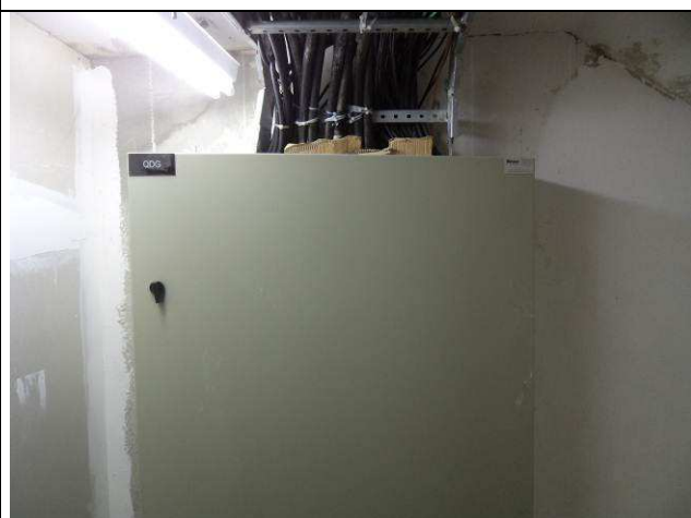
Figura 61E: Quadro QDG.
