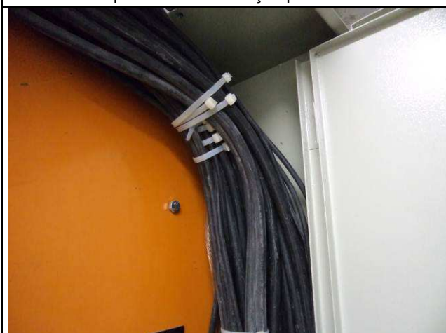
Figura 67E: Quadro QDG – ramais alimentadores.
