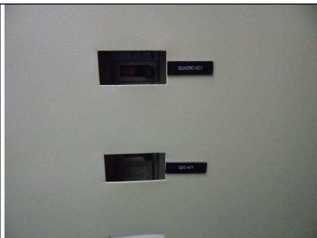
Figura 66 E: Quadro QDG - identificação.
