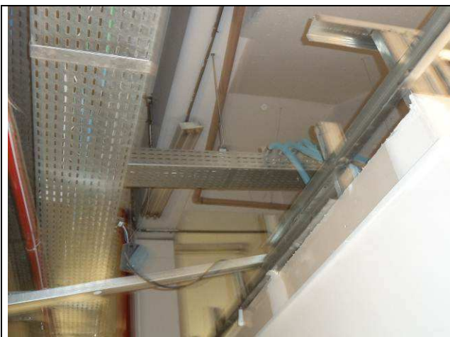
Figura 11E: Infraestrutura elétrica – eletrocalhas, eletrodutos, septo divisor, derivador lateral, perfilados.
