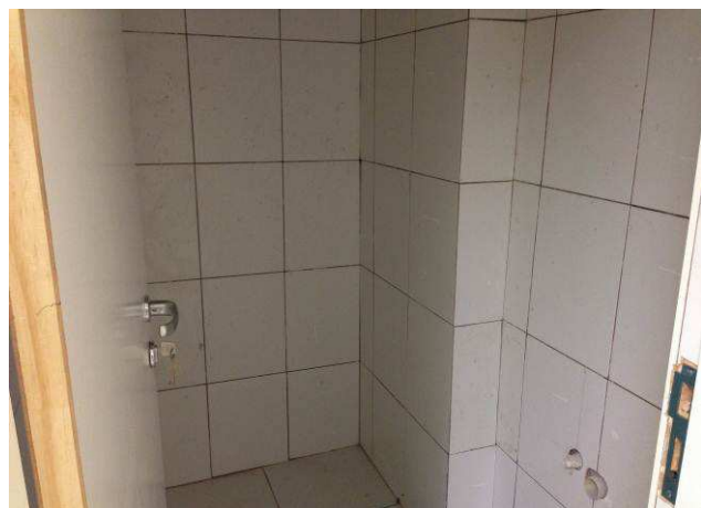
Figura 83C: Azulejos assentados no BWC 1 da sala de estar da Direção do Fórum.
