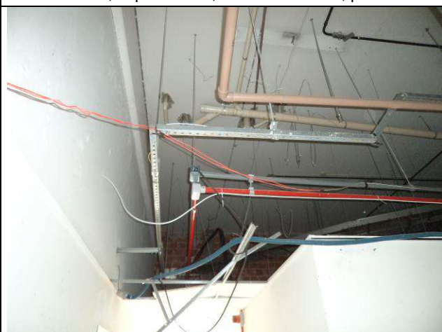
Figura 10E: Infraestrutura elétrica – eletrocalhas, eletrodutos, septo divisor, derivador lateral, perfilados.
