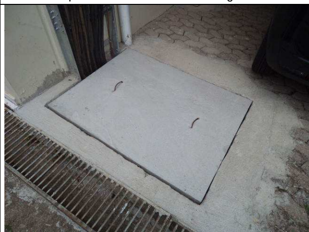
Figura 70E: Quadro QDG/ quadro barramento – novo leito para ramal de entrada de energia.
