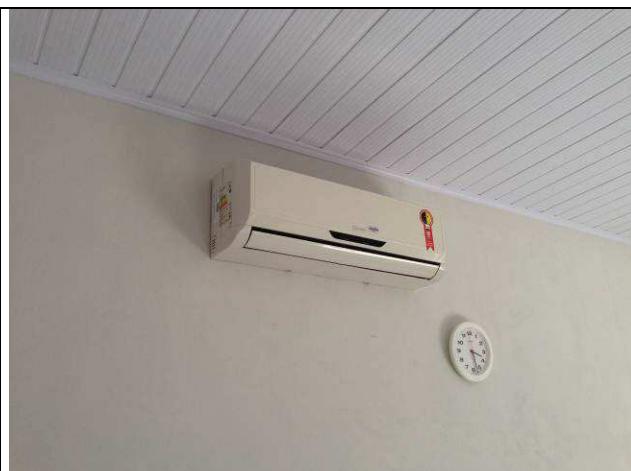
Figura 66C: Aparelho de ar condicionado nas instalações provisórias – sala de audiências.
