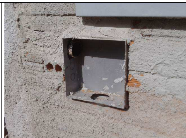
Figura 14E: Nova entrada de energia e telecomunicações – mureta, eletrodutos, caixas gne e de passagem.
