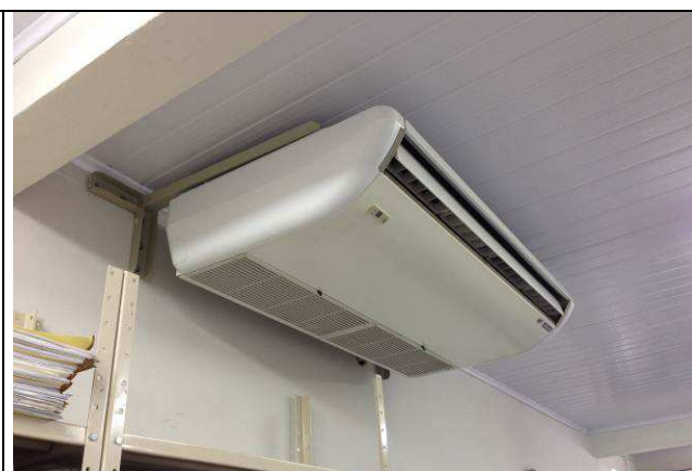
Figura 64C: Aparelho de ar condicionado nas instalações provisórias – secretaria.
