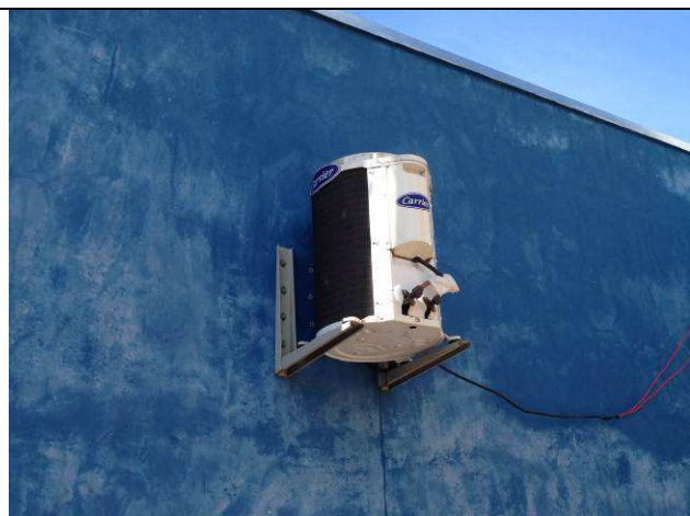
Figura 65C: Aparelho de ar condicionado nas instalações provisórias – sala de audiências.
