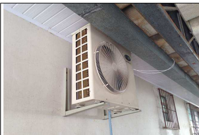
Figura 63C: Aparelho de ar condicionado nas instalações provisórias – secretaria.
