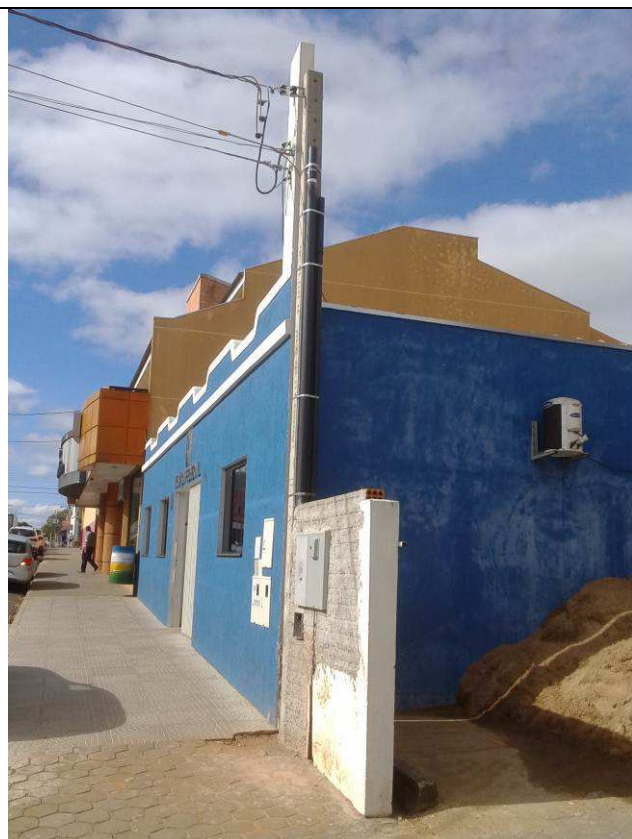
Figura 09E: Nova entrada de energia e telecomunicações – mureta, poste, eletrodutos, caixas gne e de passagem.
